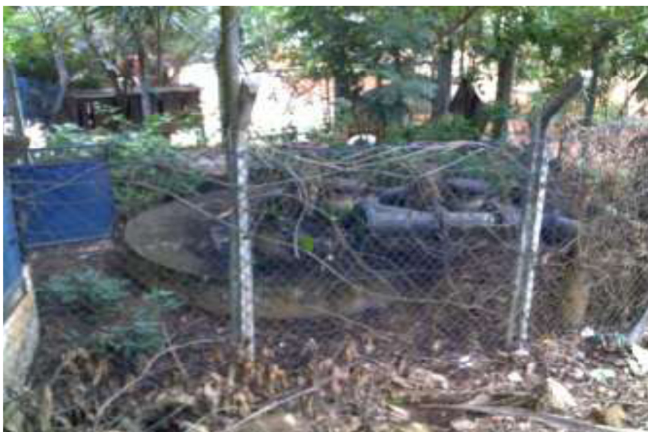
Figura 28: Vista geral da EB6.
