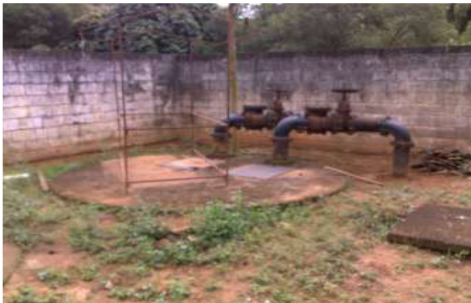
Figura 27: Vista geral da EB5.
