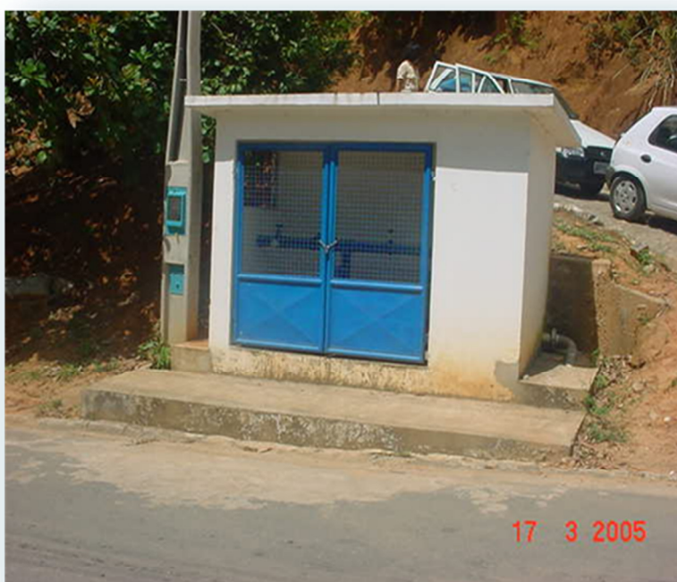
Figura 21: Estação Elevatória de Água Bruta (EEAB).
