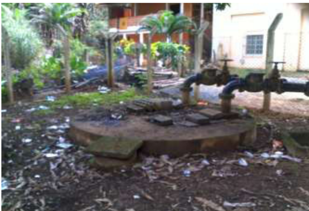
Figura 26: Vista geral da EB2.
