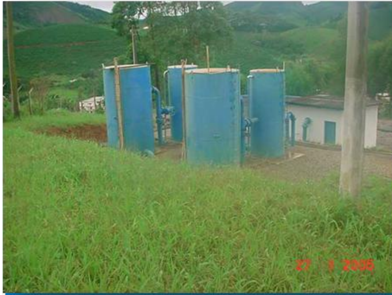
Figura 12: Estação de tratamento de água.
