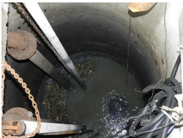
Figura 3 - Interior do poço de sucção.
