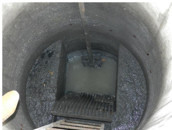
Figura 4 - Gradeamento da unidade.
