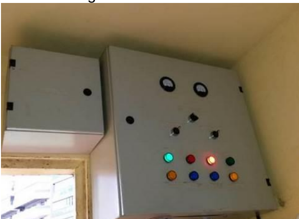
Figura 71 - EE Drenagem PMV.
