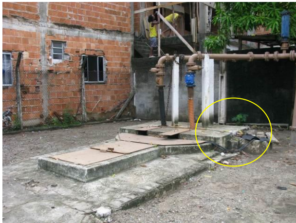
Figura 34 - EEEB Resistência II.
