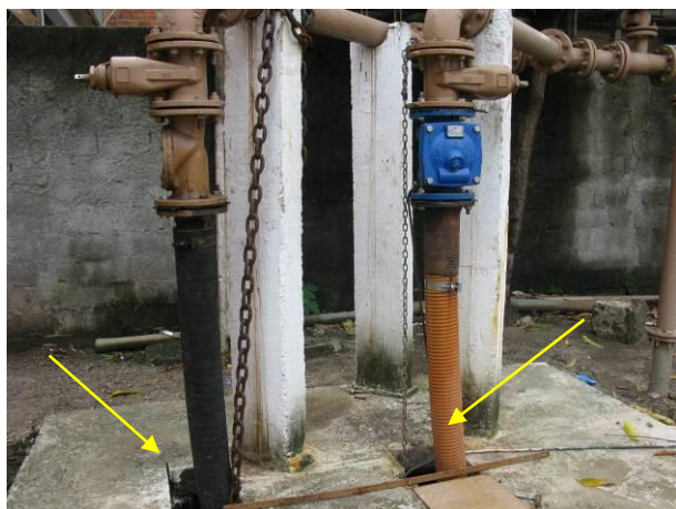
Figura 25 - EEEB Resistência II.
