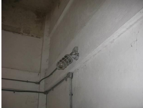
Figura 93 - Iluminação deficiente na EEEB 3 Bonfim.
