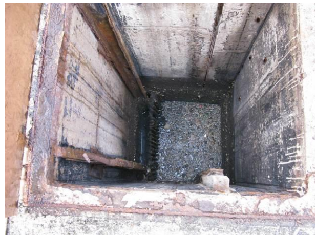
Figura 2 - EEEB Resistência II.
