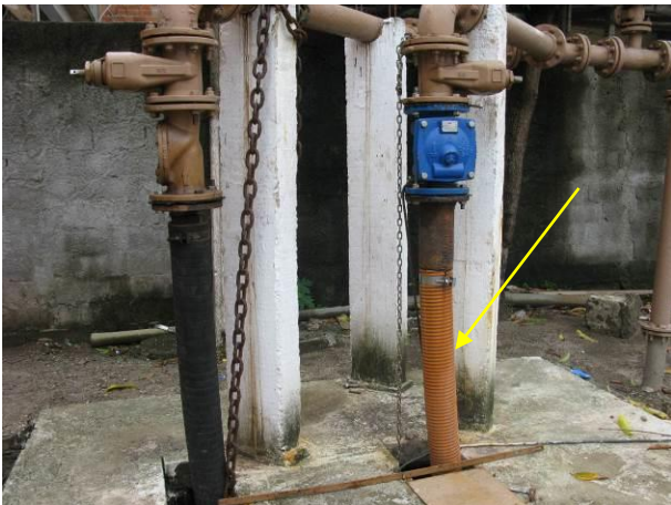
Figura 46 - EEEB Resistência II.
