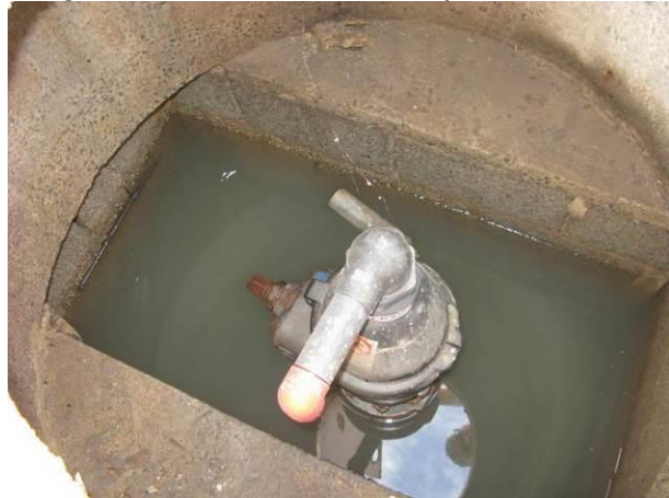
Figura 51 - Caixa de inspeção da Ventosa na EEEB EEVT-03A Horto.
