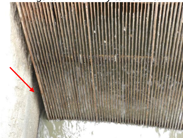
Figura 3 - Folga excessiva no Gradeamento da EEEB Goiabeiras
