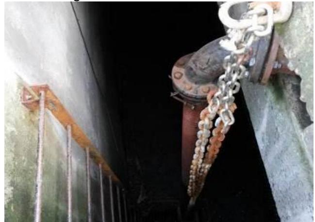
Figura 61 - EE Drenagem PMV.
