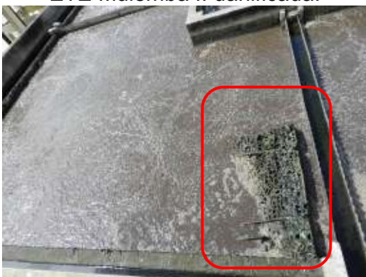
Figura 96 - Tanque de aeração/decantação da ETE Mulembá I danificado.
