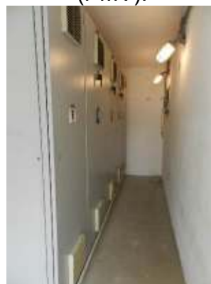
Figura 105 - Ausência de sinalização de risco na EEEB 5 (Joana D'Arc).
