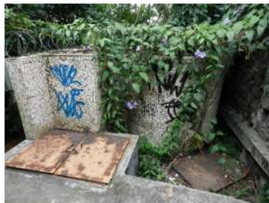
Figura 2 - EEEB Ilha do Frade 01 sem identificação.
