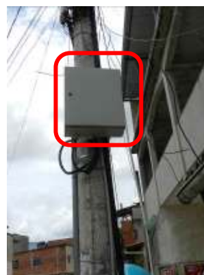
Figura 119 - Ausência de sinalização de risco na EEEB A1.
