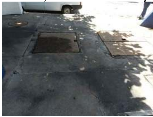
Figura 67 - Tampas da EEEB EEVT 02 (Praça do Papa) necessitando manutenção.
