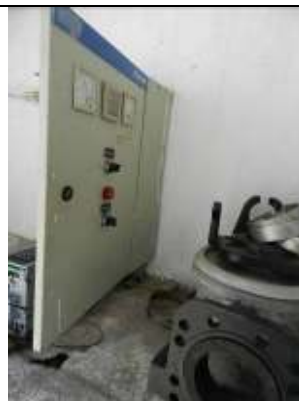
Figura 115 - Ausência de sinalização de risco na EEEB Jesus de Nazaré II (PMV).
