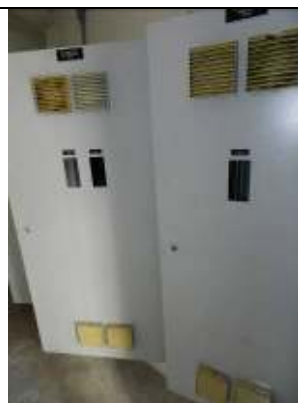
Figura 109 - Ausência de sinalização de risco na EEEB D (Fames).
