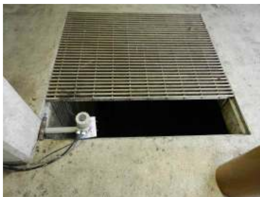
Figura 97 - Ausência de parte da grade ou guarda-corpo no tanque de efluentes oriundos da etapa do tratamento do lodo na ETE Mulembá II.
