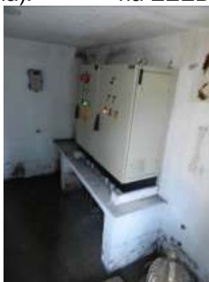
Figura 141 - Ausência de iluminação adequada na EEEB EEVT 03C (Praia do Canto).
