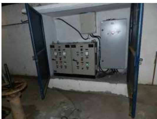
Figura 98 - Ausência de sinalização de risco na EEEB EEVT 04 (Ayrton Senna).
