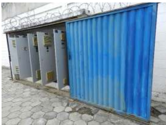
Figura 102 – Ausência de sinalização de risco na EEEB 4A.
