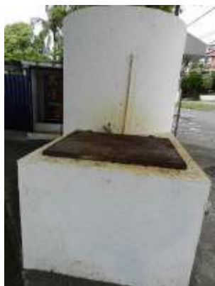
Figura 50 - Tampa de proteção do biofiltro da EEEB Ilha do Boi 02 demandando manutenção.
