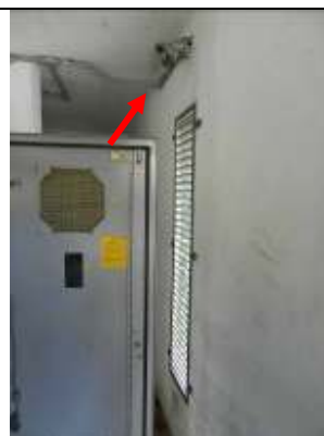
Figura 132 - Ausência de iluminação adequada na EEEB C (Parque Moscoso).
