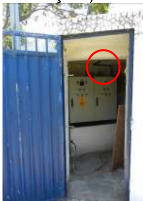
Figura 139 - Ausência de iluminação adequada na EEEB EEVT 03B (Peixaria).
