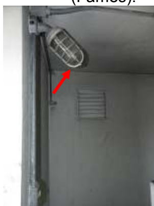
Figura 135 - Ausência de iluminação adequada na EEEB 2 (Jucutuquara).
