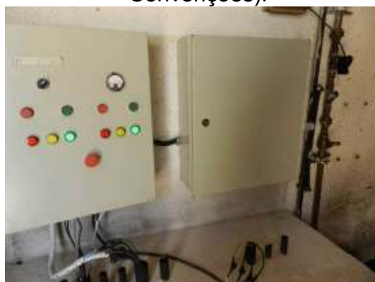
Figura 118 - Ausência de sinalização de risco na EEEB EEVT 02 (Praça do Papa).
