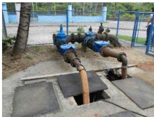
Figura 61 - Poço de sucção sem fechamento/tampa adequado na EEEB Santa Marta - Mangue Seco (PMV).
