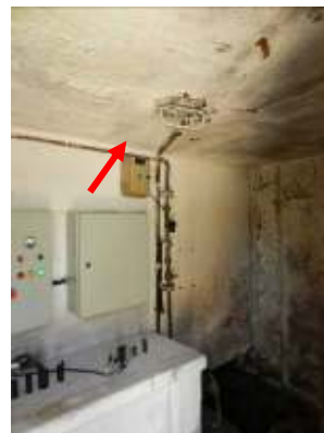
Figura 140 - Ausência de iluminação adequada na EEEB EEVT 02 (Praça do Papa).
