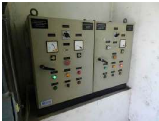
Figura 113 - Ausência de sinalização de risco na EEEB EEVT 03A (Horto-Consolação).
