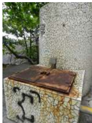
Figura 35 - Facilidade de acesso ao motor do biofiltro da EEEB Ilha do Frade 02.
