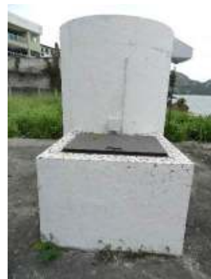
Figura 31 - Facilitade de acesso ao motor do biofiltro da EEEB Ilha do Boi 03.
