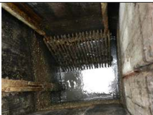
Figura 125 - Gradeamento da EEEB Resistência II (PMV) necessitando substituição.
