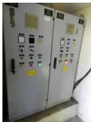
Figura 117 - Ausência de sinalização de risco na EEEB EEVT 03 (CREA).
