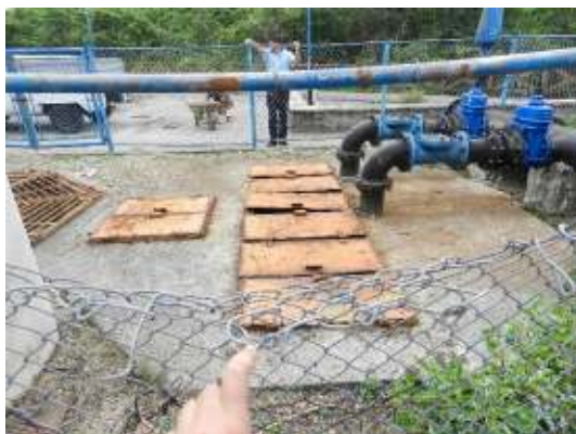
Figura 40 - EEEB Joana D'Arc (PMV) com cercamento insatisfatório (baixo e com grades comprometidas).
