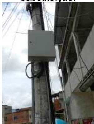
Figura 127 - Dificuldade de acesso ao painel de comando da EEEB A1.
