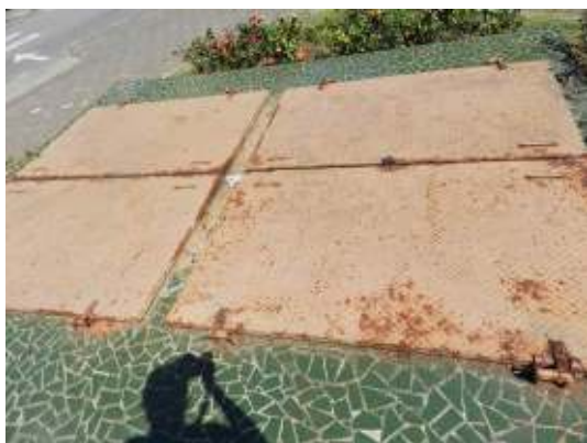
Figura 66 - Tampas da EEEB C (Parque Moscoso) necessitando manutenção.
