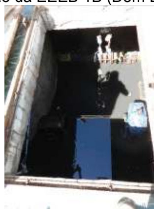
Figura 85 - Vazamento no barrilete da EEEB C (Parque Moscoso).
