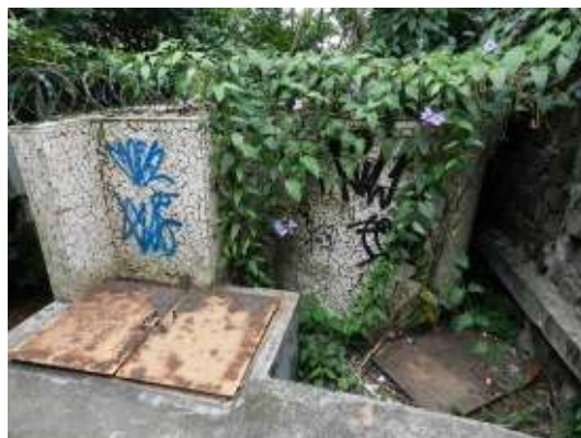
Figura 51 – Tampas demandando manutenção na EEEB Ilha do Frade 01.
