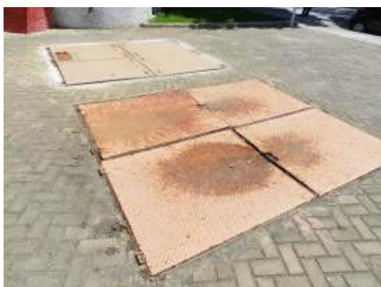
Figura 68 - Tampas da EEEB EEVT 03 (CREA) necessitando manutenção.
