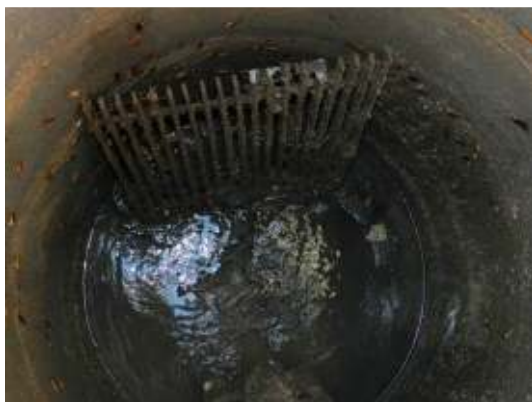
Figura 123 - Gradeamento na EEEB B (Flexibrás) necessitando substituição.
