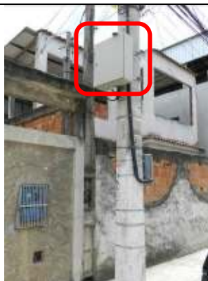
Figura 120 - Ausência de sinalização de risco na EEEB B1.
