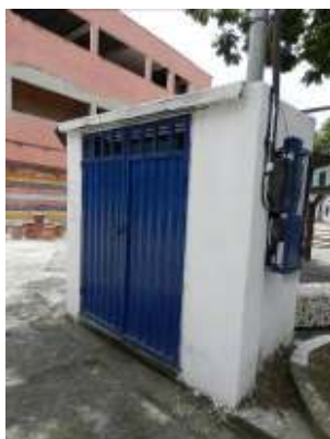
Figura 21 - EEEB A2 sem identificação.
