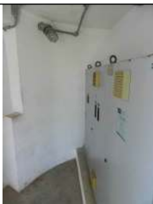
Figura 131 - Ausência de iluminação adequada na EEEB A (Tancredão).
