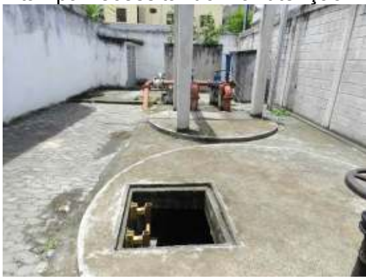
Figura 74 - Ausência de tampa no poço da EEEB 7.5.
