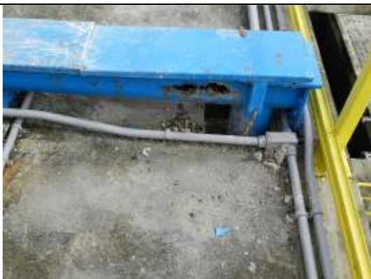
Figura 94 - Calha transportadora de resíduos do tratamento preliminar (rosca) da ETE Mulembá II danificada.
