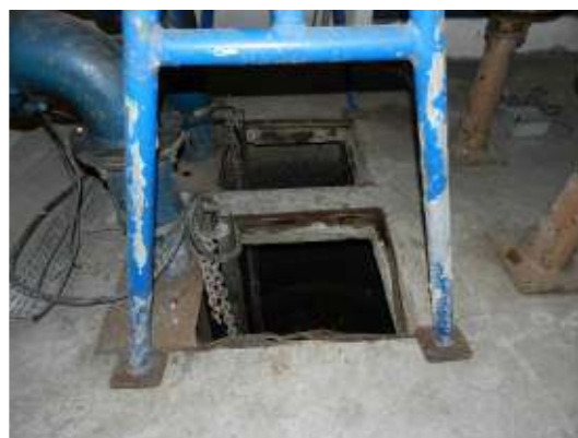
Figura 59 - Ausência de tampas no poço de sucção da EEEB EEVT 04 (Ayrton Senna).
