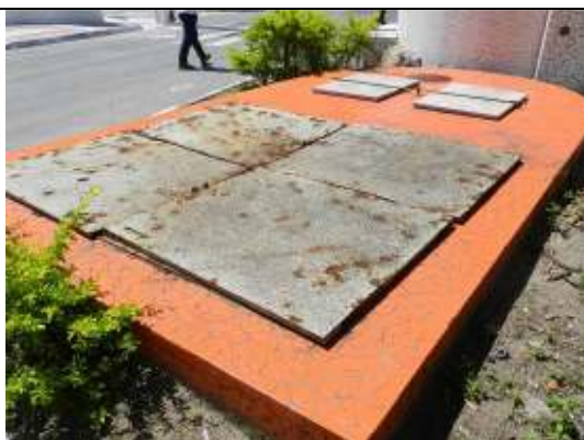
Figura 44 - Facilidade de acesso à EEEB 1B (Dom Bosco).
