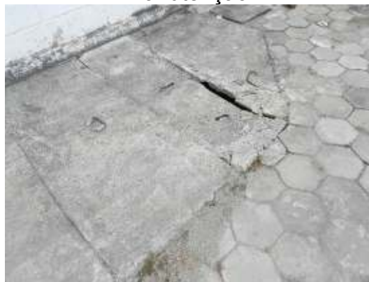
Figura 75 - Tampas da caixa de passagem da EEEB 4A necessitando manutenção.
