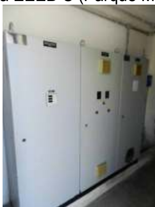
Figura 110 - Ausência de sinalização de risco na EEEB 1B (Dom Bosco).
