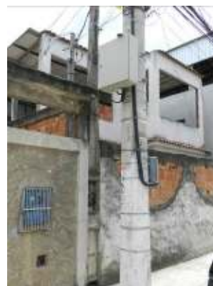
Figura 128 - Dificuldade de acesso ao painel de comando da EEEB B1.
