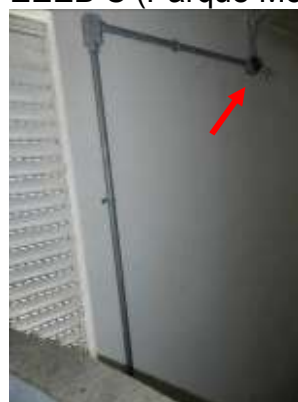
Figura 134 - Ausência de iluminação adequada na EEEB 1B (Dom Bosco).
