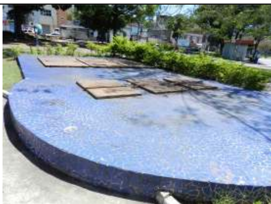
Figura 64 - Tampas da EEEB 2 (Jucutuquara) necessitando manutenção.
