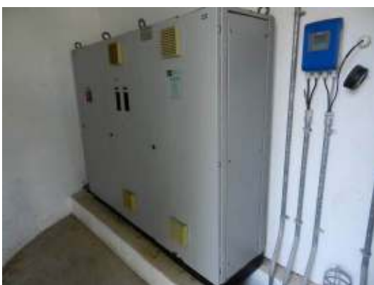
Figura 106 - Ausência de sinalização de risco na EEEB A (Tancredão).
