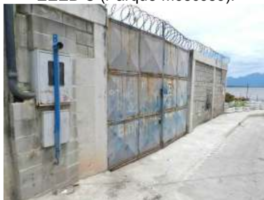
Figura 87 - Portão da EEEB 7.4 necessita manutenção.
