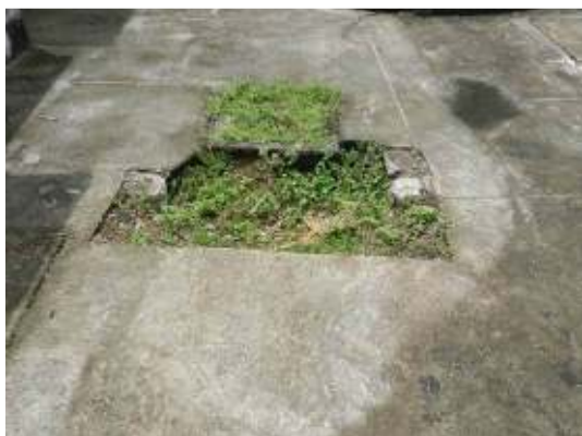
Figura 86 - Piso deteriorado na EEEB 7.6.
