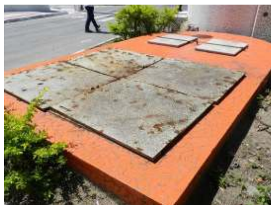
Figura 63 - Tampas da EEEB 1B (Dom Bosco) necessitando de manutenção.
