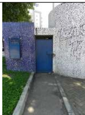
Figura 138 - Ausência de iluminação adequada na EEEB EEVT 03 (CREA).
