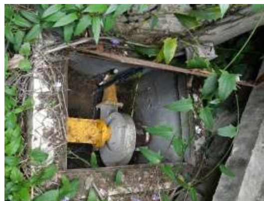
Figura 33 - Facilidade de acesso ao motor do biofiltro da EEEB Ilha do Frade 01.
