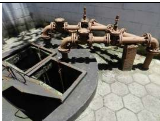
Figura 71 - Tampa da EEEB Jesus de Nazaré I (PMV) necessitando manutenção.
