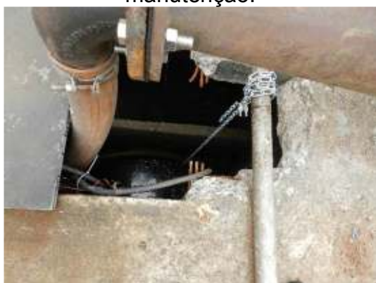
Figura 62 - Poço de sucção sem fechamento/tampa adequado na EEEB Santa Marta - Mangue Seco (PMV).
