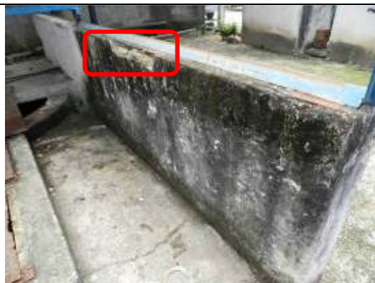
Figura 77 - EEEB Resistência (Pintura e Reboco deteriorado, além de armadura exposta).
