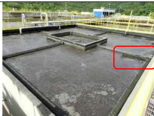
Figura 95 - Tanque de aeração/decantação da ETE Mulembá I danificado.
