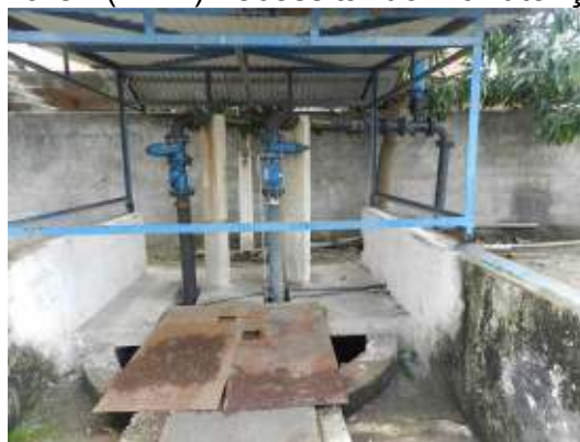
Figura 73 - Tampa do poço de sucção da EEEB Resistência II (PMV) necessitando manutenção.
