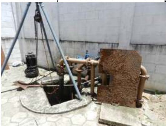
Figura 72 - Poço de sucção da EEEB Jesus de Nazaré II (PMV) destampado e com tampa necessitando manutenção.
