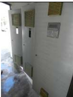
Figura 108 - Ausência de sinalização de risco na EEEB C (Parque Moscoso).
