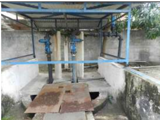
Figura 76 - EEEB Resistência (Pintura e Reboco deteriorado, além de armadura exposta).
