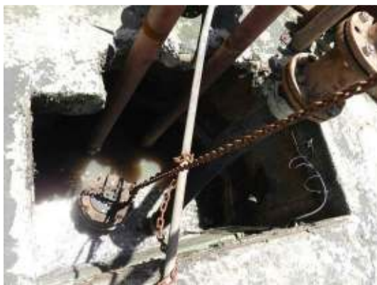
Figura 121 - Ausência de bomba reserva na EEEB Jesus de Nazaré II (PMV).
