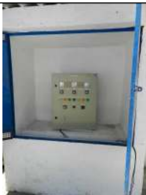
Figura 114 - Ausência de sinalização de risco na EEEB Jesus de Nazaré I (PMV).
