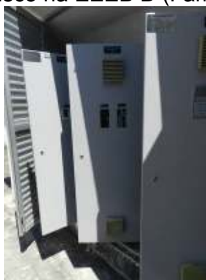
Figura 111 - Ausência de sinalização de risco na EEEB 1A (Ilha de Santa Maria).
