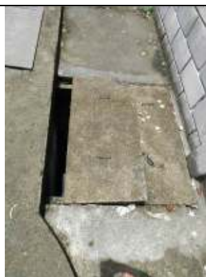
Figura 89 - Tapa de inspeção deslocada na EEEB 7.6.
