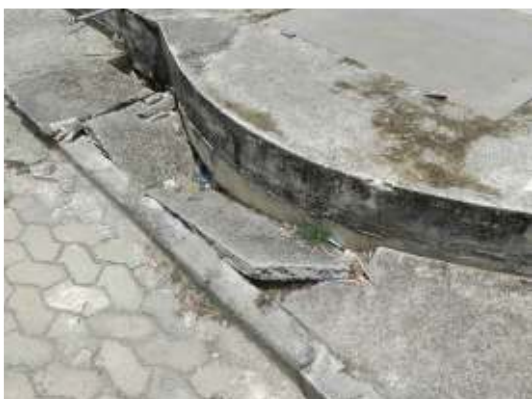
Figura 78 - Piso com sinais de recalque na EEEB 7.4.
