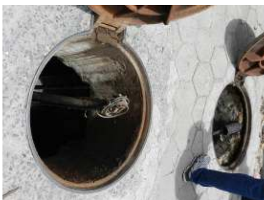
Figura 23 - EEEB A1 sem identificação.
