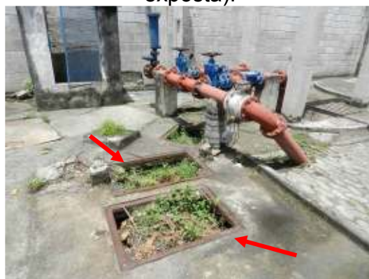
Figura 79 - Abertura no piso da EEEB 7.5.
