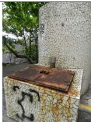
Figura 53 - Tampas de proteção do biofiltro da EEEB Ilha do Frade 02 demandando manutenção.
