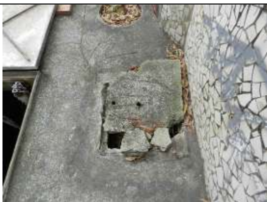
Figura 58 - Tampa anexa ao biofiltro da EEEB Ilha do Frade 04 demandando manutenção.
