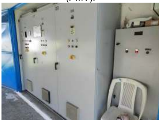
Figura 116 - Ausência de sinalização de risco na EEEB EEVT 05 (Centro de Convenções).
