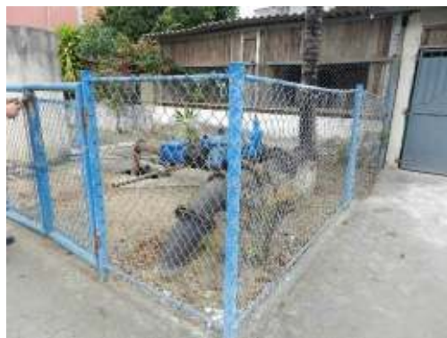
Figura 39 - EEEB Santa Marta - Mangue Seco (PMV) com cercamento insatisfatório (baixo).
