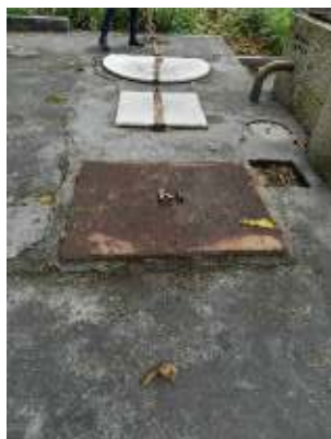
Figura 52 - Tampa de proteção da EEEB Ilha do Frade 02 demandando manutenção.
