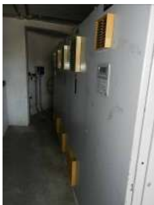
Figura 112 - Ausência de sinalização de risco na EEEB 2 (Jucutuquara).
