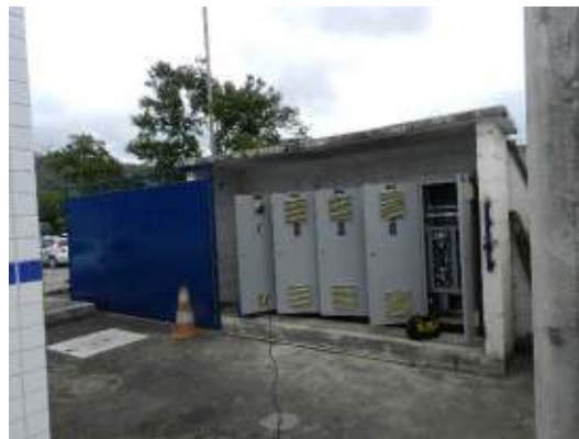
Figura 101 – Ausência de sinalização de risco na EEEB 3 (Bonfim).
