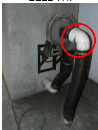
Figura 80 - Trecho de tubulação do biofiltro da EEEB EEVT 04 (Ayrton Senna) demandando manutenção.
