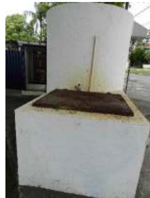
Figura 29 - Facilitade de acesso ao motor do biofiltro da EEEB Ilha do Boi 02.
