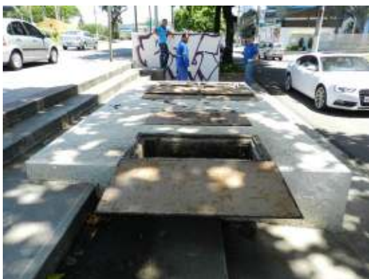
Figura 15 - EEEB EEVT 03C (Praia do Canto) sem identificação.
