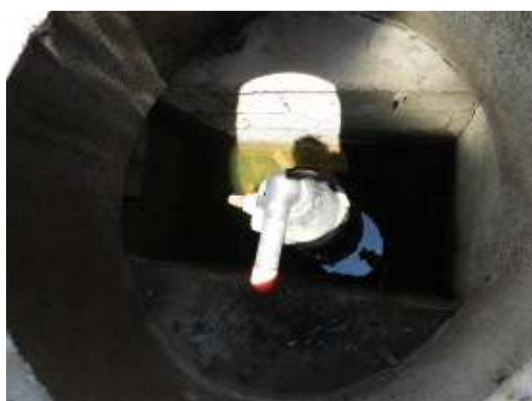
Figura 90 - Acúmulo de água pluvial (EEEB Horto - Consolação).
