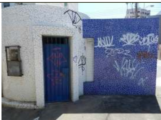
Figura 82 - Porta da EEEB 1B (Dom Bosco) necessitando manutenção.
