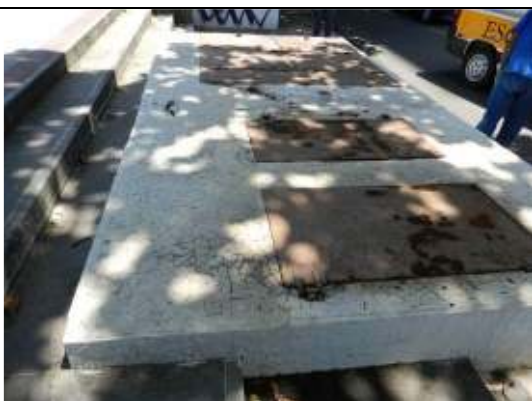
Figura 70 - Tampas da EEEB EEVT 03C (Praia do Canto) necessitando manutenção.
