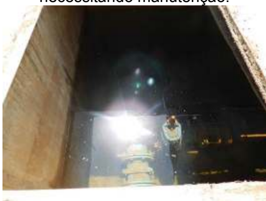
Figura 84 – Acúmulo de água pluvial na EEEB 1B (Dom Bosco).
