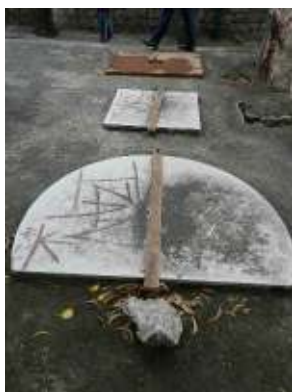
Figura 56 - Tampa de proteção da EEEB Ilha do Frade 04 demandando manutenção.
