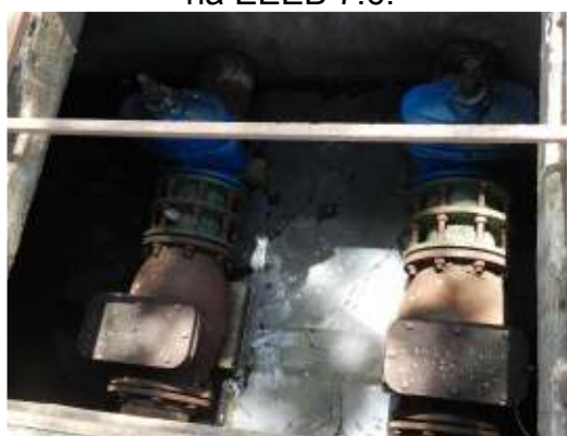
Figura 91 - Acúmulo de água pluvial (EEEB EEVT 03B - Peixaria).
