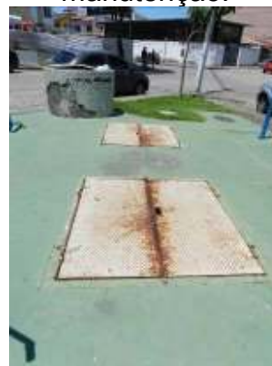
Figura 69 - Tampas da EEEB EEVT 03A (Horto-Consolação) necessitando manutenção.
