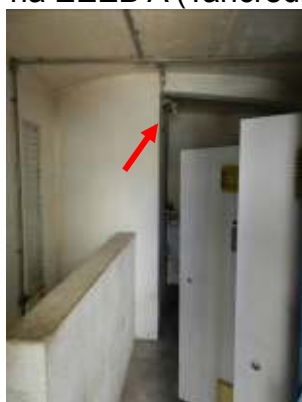
Figura 133 - Ausência de iluminação adequada na EEEB D (Fames).
