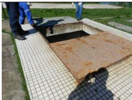
Figura 65 - Tampas da EEEB A (Tancredão) necessitando manutenção.
