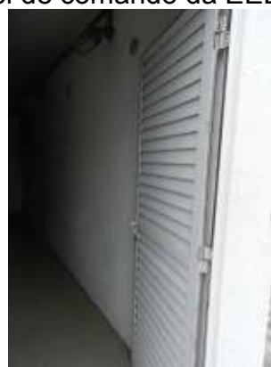
Figura 130 - Ausência de iluminação adequada na EEEB 5 (Joanna D'Arc).
