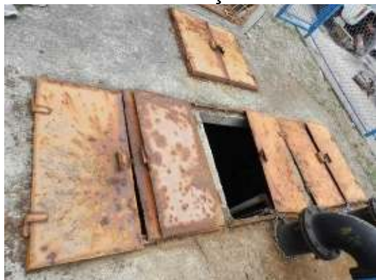
Figura 60 - Tampas do poço de sucção da EEEB Joana D'Arc (PMV) necessitando manutenção.
