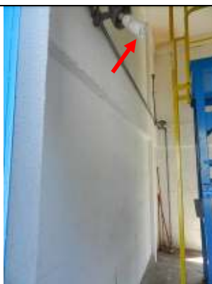
Figura 137 - Ausência de iluminação adequada na EEEB EEVT 05 (Centro de Convenções).
