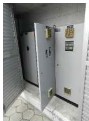
Figura 99 - Ausência de sinalização de risco na EEEB 4C.
