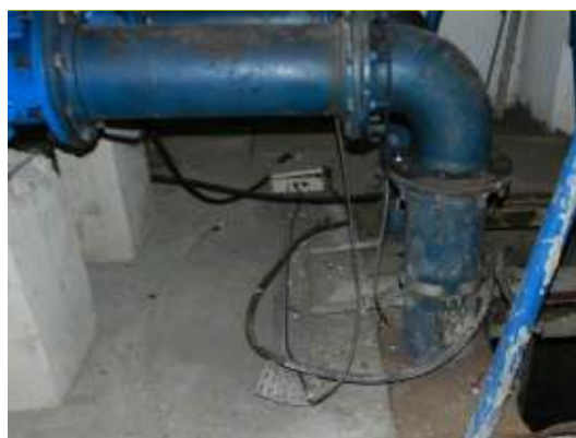
Figura 81 - Presença de fiação exposta na EEEB EEVT 04 (Ayrton Senna).
