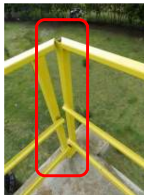
Figura 93 - Guarda-corpo da caixa de distribuição da ETE Mulembá danificado.
