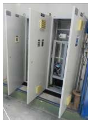
Figura 107 - Ausência de sinalização de risco na EEEB B (Flexibrás).
