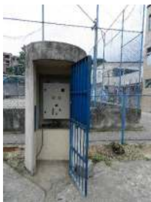
Figura 104 – Ausência de sinalização de risco na EEEB Joana D'Arc (PMV).
