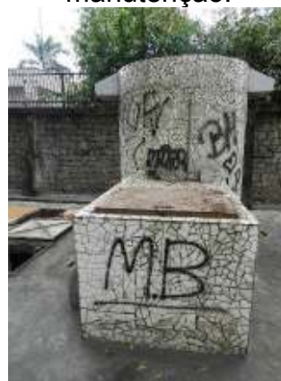
Figura 57 - Tampa de proteção do biofiltro da EEEB Ilha do Frade 04 demandando manutenção.
