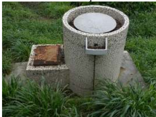
Figura 55 - Tampa de proteção do biofiltro da EEEB Ilha do Frade 03 demandando manutenção.
