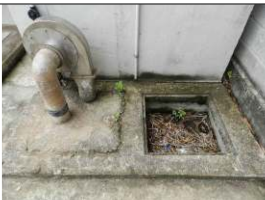
Figura 88 - Abertura no piso da EEEB 7.8.
