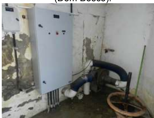
Figura 136 - Ausência de iluminação adequada na EEEB 3A (Horto - Consolação).
