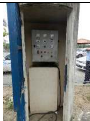
Figura 103 – Ausência de sinalização de risco na EEEB Santa Marta – Mangue Seco (PMV).
