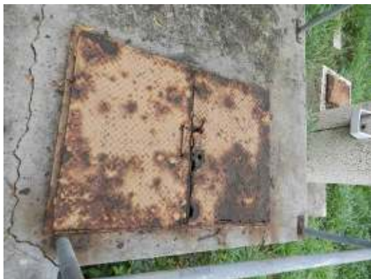
Figura 54 - Tampa de proteção da EEEB Ilha do Frade 03 demandando manutenção.
