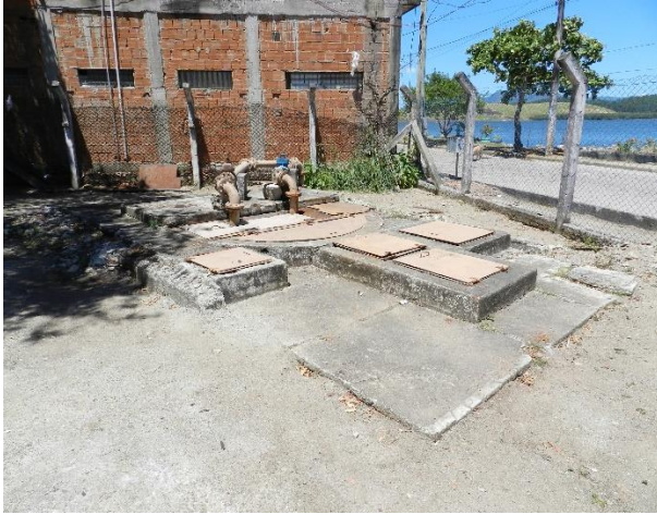
Figura 1 – Tampas do poço de sucção da EEEB Prainha.
