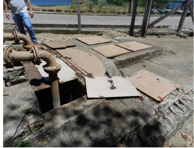
Figura 2 – Tampas do poço de sucção da EEEB Prainha.
