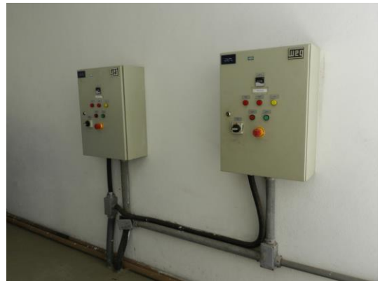
Figura 38 - Ausência de sinalização de risco nas salas da centrífuga (ETE Grande Vitória).
