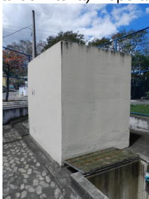
Figura 27 - Biofiltro da EEEB 6.1 (Grande Vitória) inoperante.
