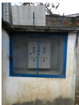
Figura 33 - Ausência de sinalização de risco na EEEB Itabira.
