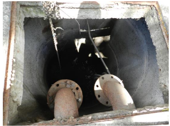
Figura 40 - Ausência de bomba reserva na EEEB Santa Tereza (ETE Desativada).
