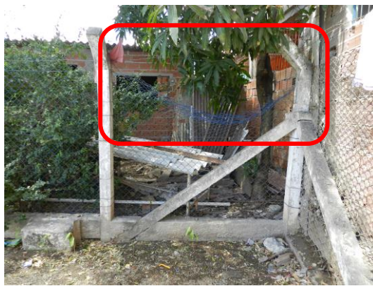
Figura 10 - Isolamento comprometido na EEEB Prainha.
