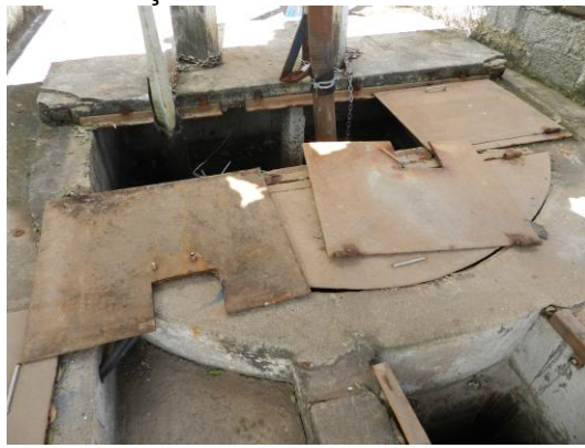
Figura 17 - Tampas do poço de sucção da ETEB Prainha necessitando de manutenção.
