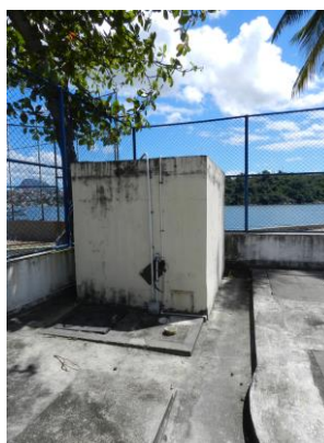
Figura 26 - Biofiltro da EEEB 6.2 (Grande Vitória) inoperante.
