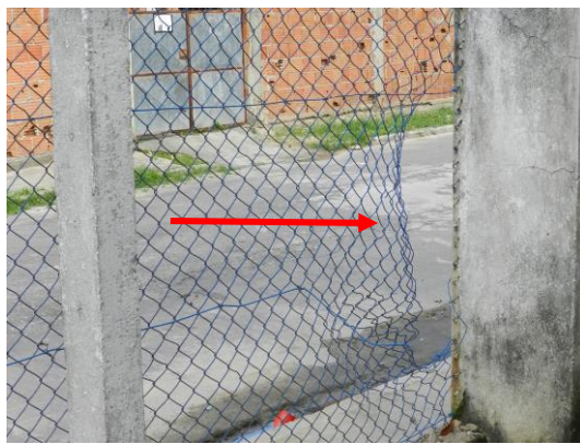
Figura 9 - Isolamento comprometido na EEEB Itabira.
