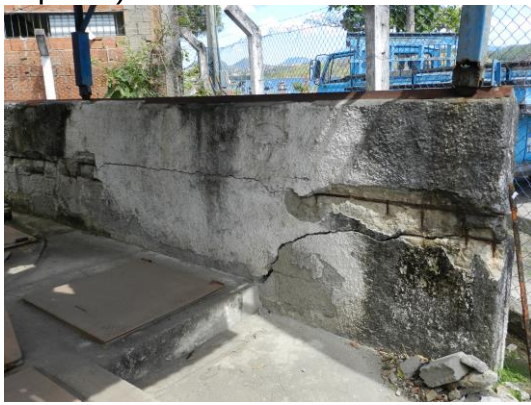
Figura 16 - ETEB Prainha (Pintura e Reboco deteriorado, além de armadura exposta).
