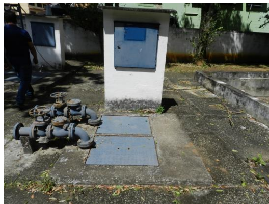
Figura 36 - Ausência de sinalização de risco na EEEB Santa Tereza (ETE Desativada).
