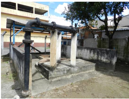
Figura 14 - ETEB Itabira (Pintura e Reboco deteriorado, além de armadura exposta).
