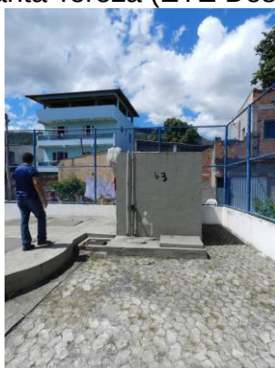
Figura 25 - Biofiltro da EEEB 6.3 (Grande Vitória) inoperante.
