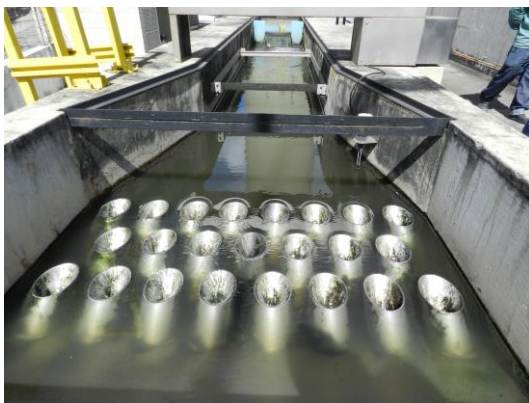
Figura 31 - Ausência de tratamento UV na ETE Grande Vitória.
