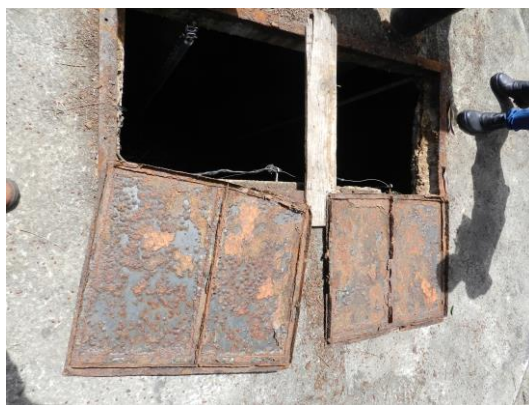
Figura 19 - Tampas do poço de sucção da EEEB 6.3.1 necessitando de substituição.
