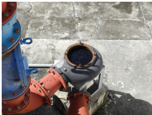
Figura 30 - Ausência de bomba e acúmulo de água pluvial (Etapa responsável pela recirculação interna do lodo da ETE Grande Vitória).
