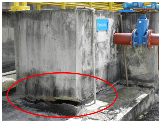
Figura 32 - Estrutura Física do floculador comprometida na base (ETE Grande Vitória).
