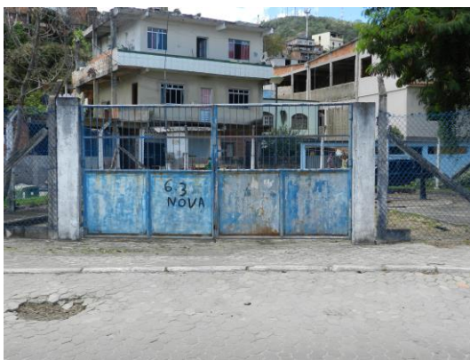
Figura 18 - EEEB 6.3.1 (Pintura deteriorada).
