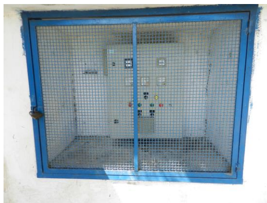
Figura 34 - Ausência de sinalização de risco na EEEB Prainha.
