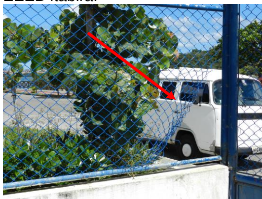
Figura 11 - Isolamento comprometido na EEEB 6.3 (Gde Vitória).
