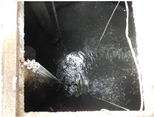
Figura 39 - Ausência de bomba reserva e mecanismo de remoção de sólidos grosseiros na EEEB 6.3.1.
