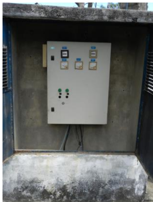
Figura 35 - Ausência de sinalização de risco na EEEB 6.3.1.
