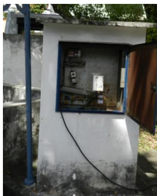
Figura 23 – Painel de controle da EEEB Santa Tereza (ETE Desativada).
