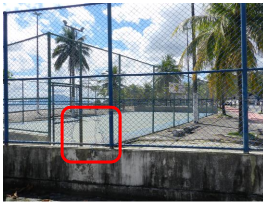
Figura 13 - Isolamento comprometido na EEEB 6.2 (Gde Vitória).
