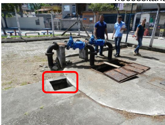
Figura 21 - Abertura no piso próximo ao poço de sucção da EEEB 6.3.1.
