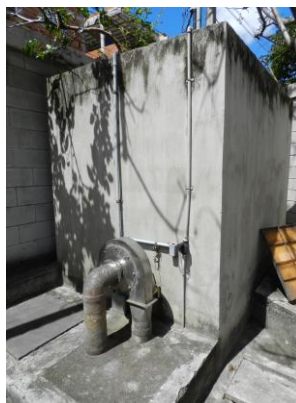
Figura 28 - Biofiltro da EEEB 7.2 (Grande Vitória) inoperante.
