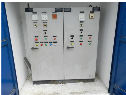
Figura 18 - Ausência da Sinalização de risco na EEEB Santa Terezinha/Jardim Camburi III (Norte Sul).
