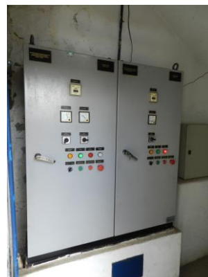
Figura 19 - Ausência da Sinalização de risco na EEEB Jardim Camburi I (Praia).
