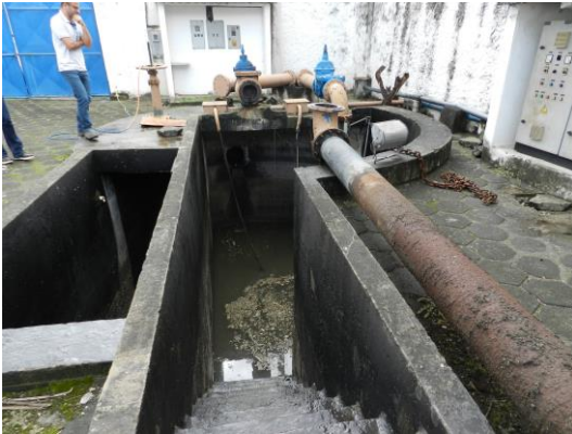
Figura 12 - Barrilete danificado na EEEB Maria Ortiz.
