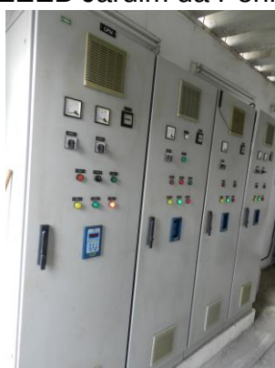
Figura 16 - Ausência da Sinalização de risco na EEEB Goiabeiras.
