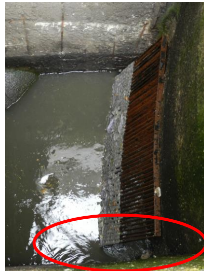
Figura 22 - Gradeamento da EEEB Jardim da Penha necessitando de substituição.
