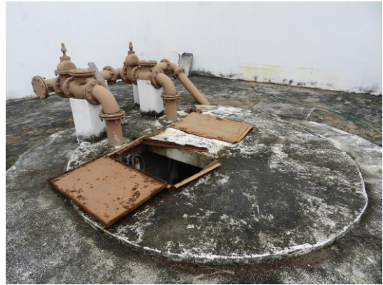
Figura 13 - Tampas do poço de sucção da EEEB Santa Terezinha/Jardim Camburi III (Norte Sul) necessitando substituição/manutenção.
