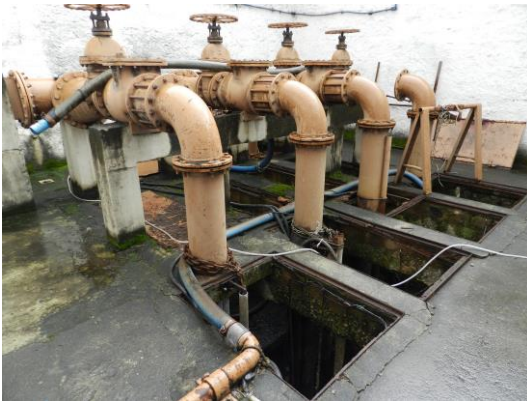
Figura 8 - Ausência de tampas e tampas deterioradas no poço de sucção da EEEB Jardim da Penha.
