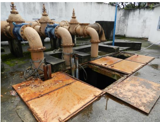
Figura 10 - Ausência de tampas e tampas deterioradas no poço de sucção da EEEB Goiabeiras.
