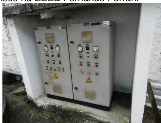
Figura 17 - Ausência da Sinalização de risco na EEEB Maria Ortiz.
