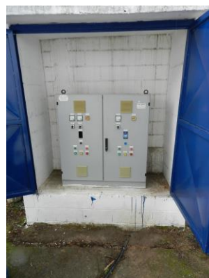
Figura 15 - Ausência de sinalização de risco na EEEB Fernando Ferrari.
