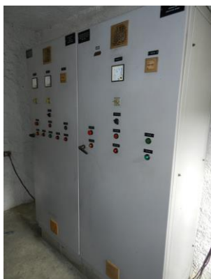
Figura 14 - Ausência de sinalização de risco na EEEB Jardim da Penha.
