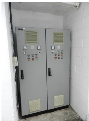
Figura 20 - Ausência da Sinalização de risco na EEEB Jardim Camburi II (Residencial).
