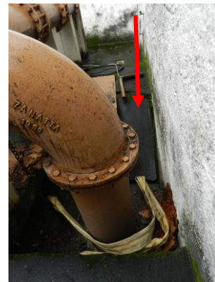
Figura 9 - Estrutura física (cobertura) do poço de sucção da EEEB Jardim da Penha comprometida.
