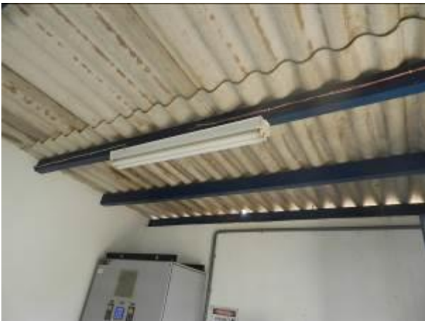
Figura 14 - Booster Vila Pavão.
