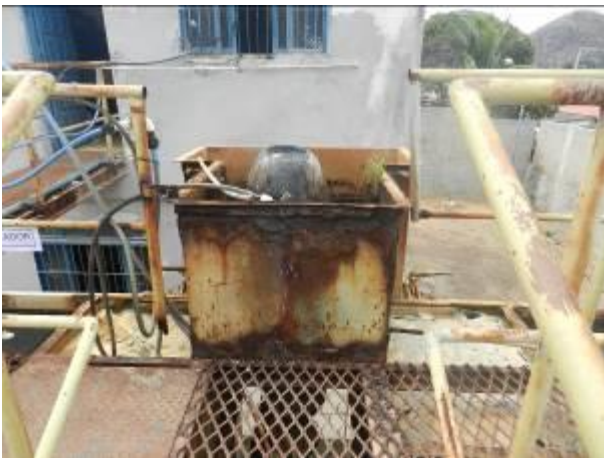
Figura 5 - ETA Vila Pavão.
