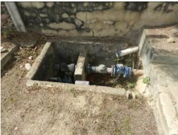
Figura 11 - Barrilete do booster Vila Pavão.
