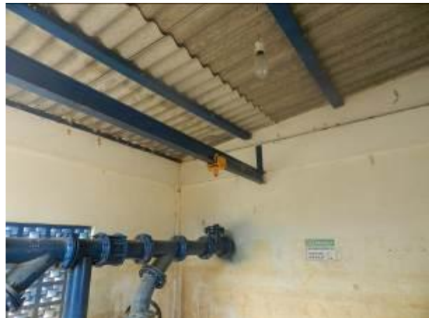
Figura 15 - Captação em operação de Vila Pavão.
