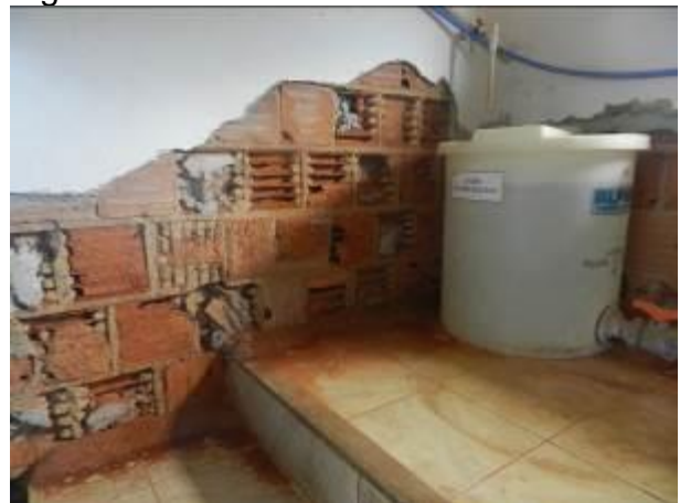
Figura 8 - ETA Vila Pavão.
