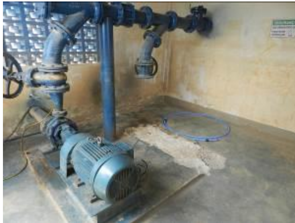
Figura 17 - Captação em operação.
