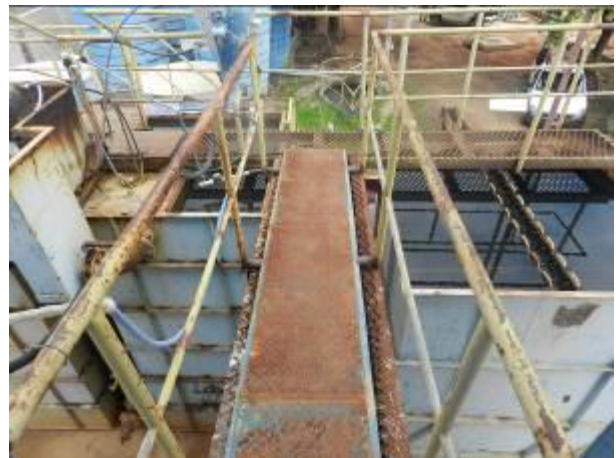
Figura 6 - ETA Vila Pavão.
