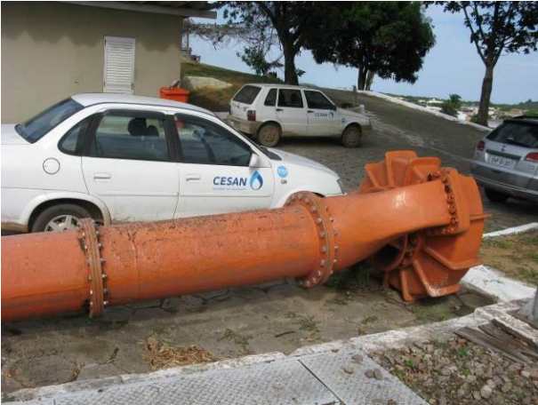
Figura 45 - EEAB Alto Recalque.
