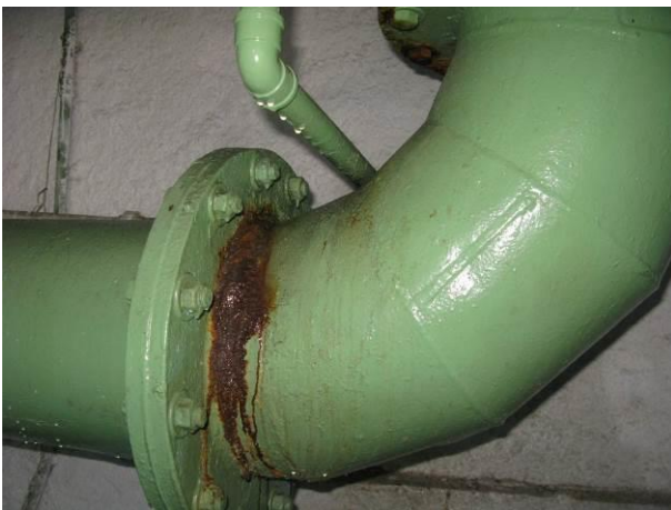
Figura 11 - Tubulações da EEAT do Reservatório de lavagem de filtros da ETA Cobi.
