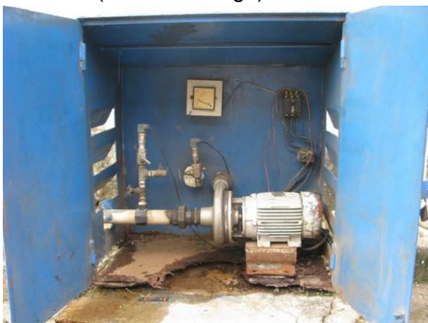
Figura 18 - EEAT Alvorada abrigo em mau estado de conservação e ausência de quadro elétrico.
