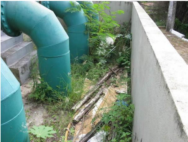
Figura 31 - Caixa de inspeção do barrilete do Sistema de Proteção de Transientes Hidráulicos da EEAB Alto Recalque.
