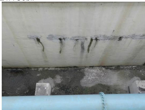
Figura 24 - Tanque de contato da ETA Caçaroca.
