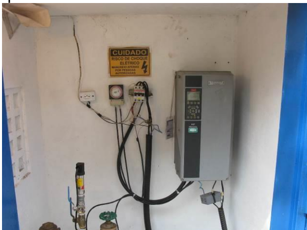
Figura 20 - Ausência do quadro elétrico da EEAT Brisamar.
