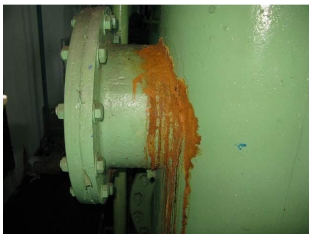
Figura 1 - Toco de interligação flangeado da tubulação de descida do reservatório de lavagem de filtros da ETA Cobi.
