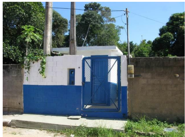
Figura 54 - EEAT Morro da Lagoa.
