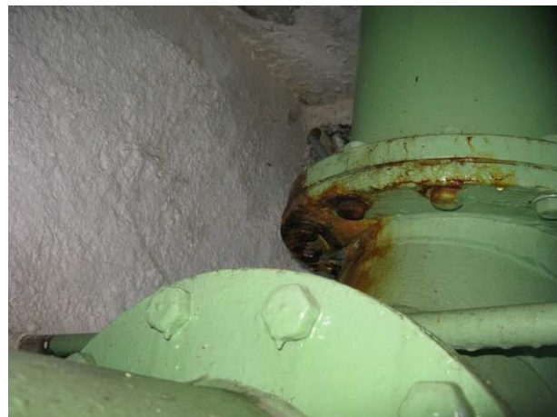
Figura 12 - Tubulações da EEAT do Reservatório de lavagem de filtros da ETA Cobi.
