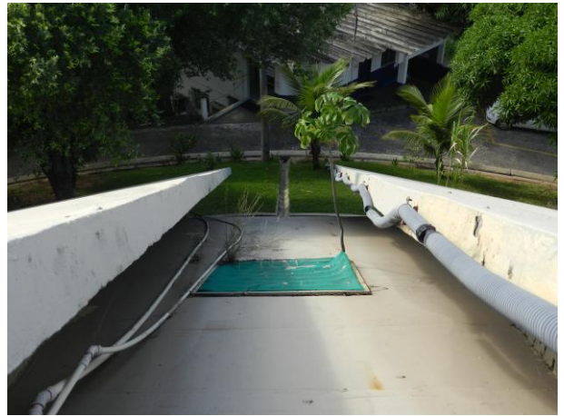
Figura 32 - Reservatório Boa Vista – vegetação na abertura de ventilação.
