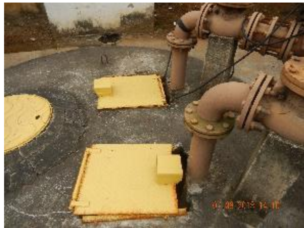
Figura 132 - Ausência de bomba reserva na EEEB01-COLINAS I
