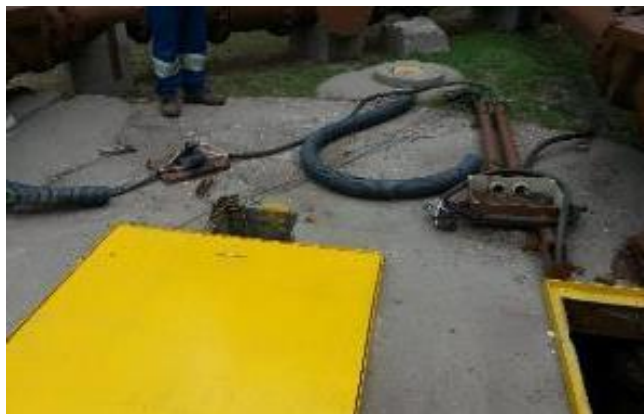
Figura 123 - Condições elétricas inadequadas na elevatória EEEB VV C – Terceira Ponte.
