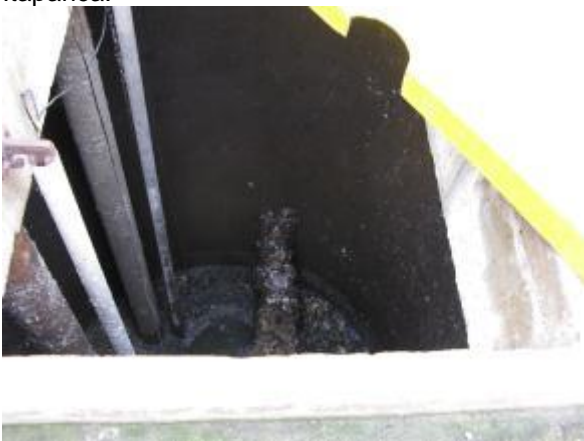
Figura 143 - Ausência de bomba reserva na EEEB 1 Guaranhus I.
