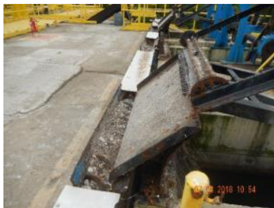
Figura 184 - Rosca de limpeza da calha coletora do material retido no gradeamento com defeito na ETE Araçás.
