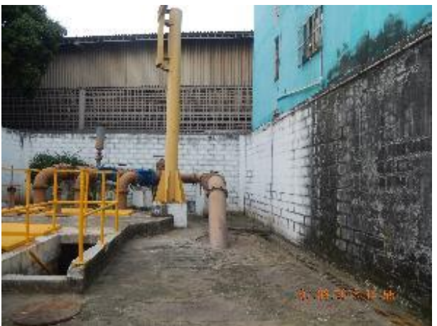
Figura 162 - Biofiltro com defeito na EEEB D.
