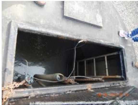
Figura 35 - Ausência de conjunto motobomba na elevatória interna a ETE do sistema Riviera Park.
