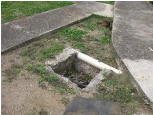
Figura 99 - Sujeira excessiva na caixa da EEEB F DIVINO ES.
