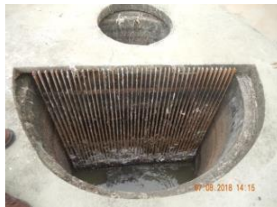
Figura 167 - EEEB 01 - Colinas II - Gradeamento com conservação e limpeza inadequada.
