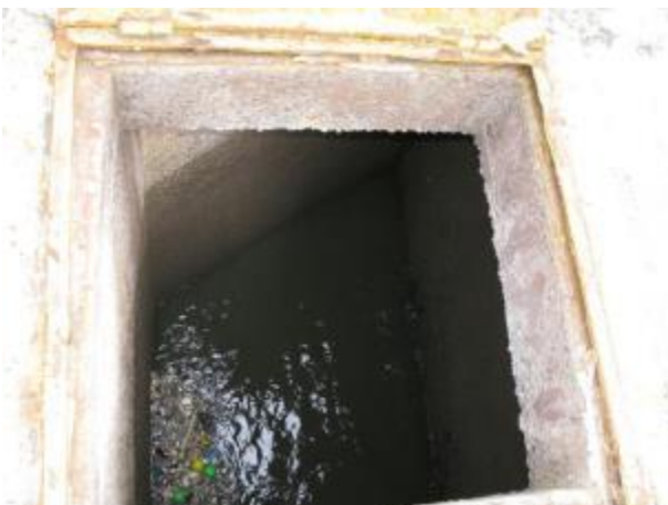
Figura 121 - Líquido retido em caixa EEEB J Itapuã.
