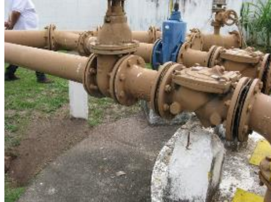
Figura 105 - Ausência de bloco de apoio no barrilete da Elevatória EEEB F Divino ES.
