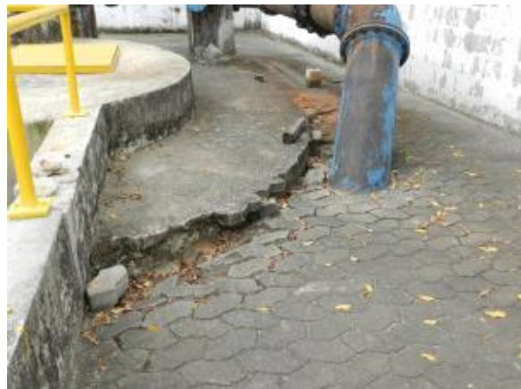
Figura 109 - Deformidade na estrutura do poço de sucção, piso cedendo na EEEB Q IBES do SES Araças
