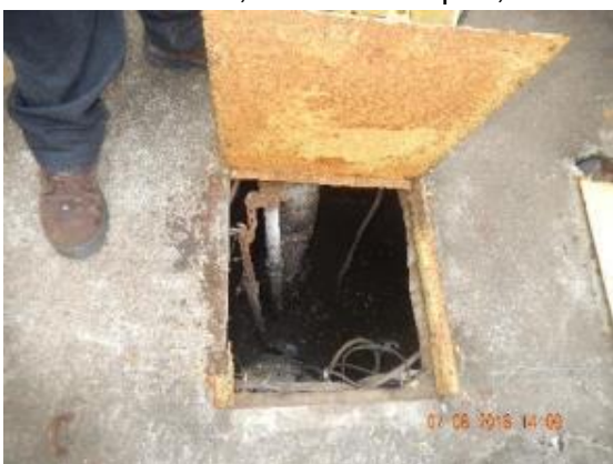
Figura 93 - Tampa em mau estado de conservação na EEEB COLINAS I do SES Araças.
