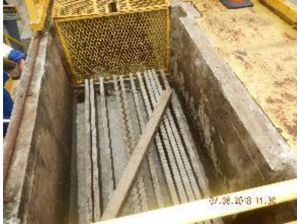
Figura 192 - Sistema de Desinfecção Ultravioleta não está funcionando na ETE Araçás.
