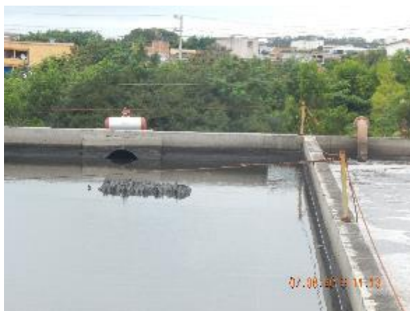
Figura 190 - Elementos flutuantes na ETE Araçás.
