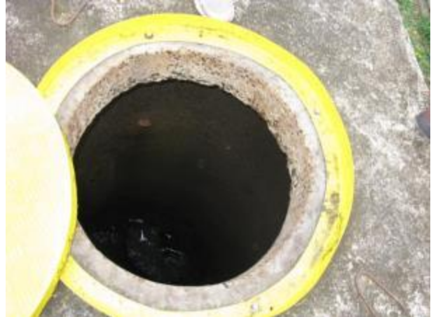
Figura 179 - Poço de visita de chegada à EEEB Guaranhuns I necessita manutenção e limpeza.
