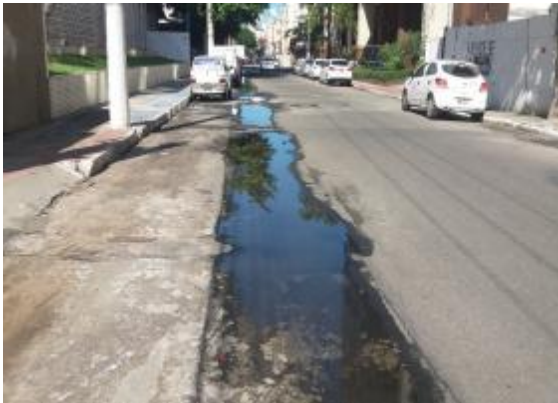
Figura 223 - Abaulamento do Asfalto em vários trechos da Rua Afonso Pena, Praia da Costa
