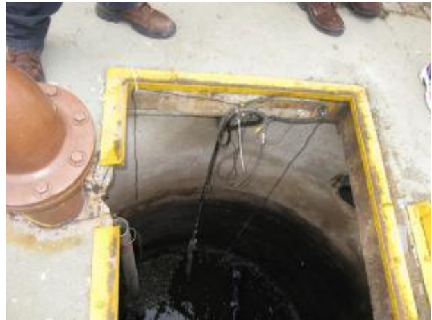
Figura 142 - Ausência de bomba reserva na EEEB Parque das Gaivotas.
