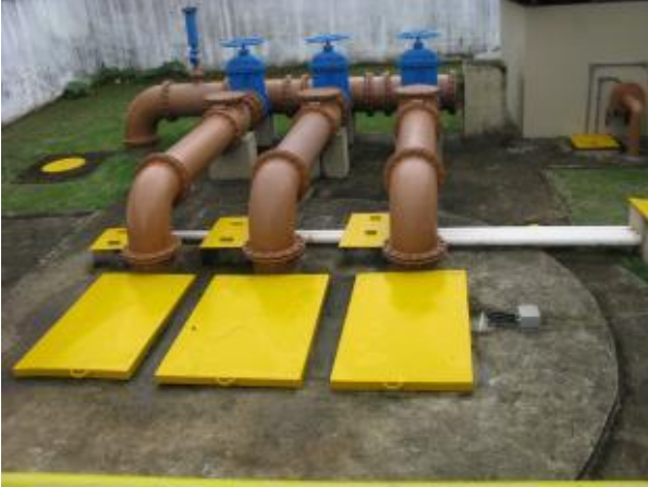
Figura 154 - Biofiltro sem funcionamento na EEEB 5 do SES Araçás.
