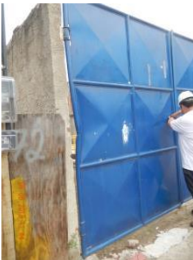
Figura 44 - Portão metálico da elevatória João Goulart 02 amassado.
