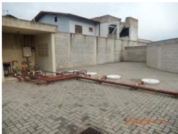
Figura 27 - Sistema UV inoperante na ETE Mar D'Ulé.
