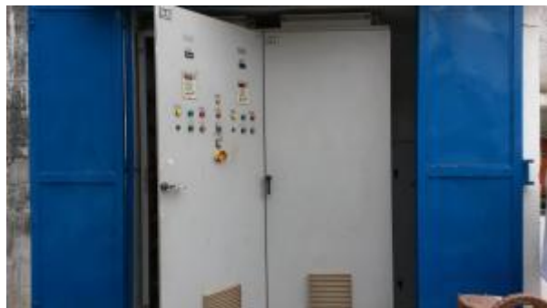
Figura 90 - Elevatória EEEB VV C – Terceira Ponte sem sinalização de risco.
