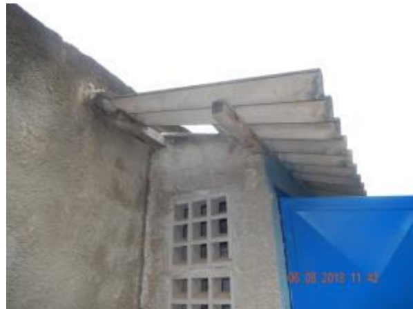
Figura 43 - Estrutura do abrigo do quadro elétrico da elevatória João Goulart 02.
