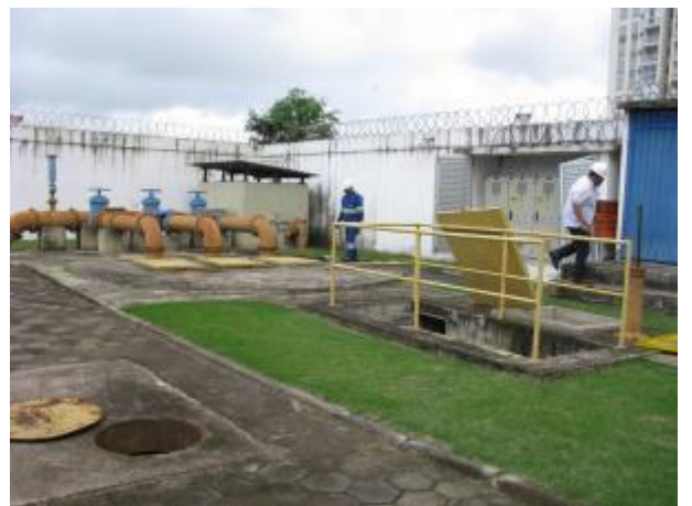
Figura 163 - Biofiltro com defeito na EEEB Itaparica.
