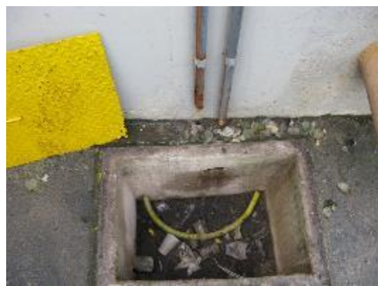
Figura 94 - Sujeira excessiva na caixa da EEEB 03.
