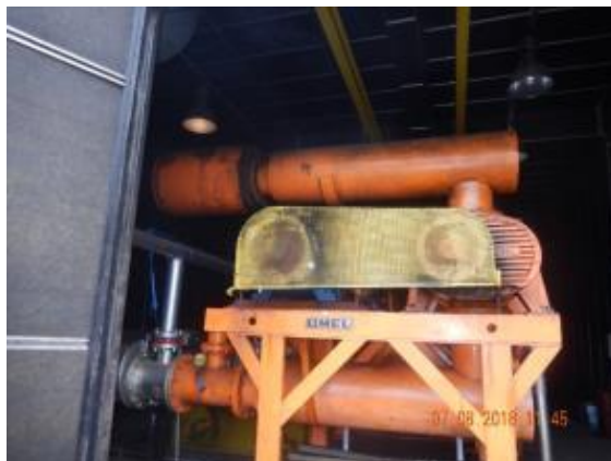
Figura 194 - Iluminação insuficiente na sala de sopradores da ETE Araçás
