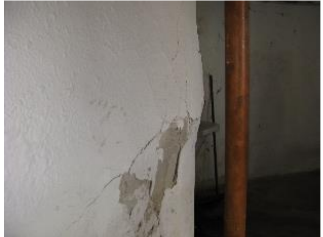
Figura 111 - Estruturas civis da EEEB WP Coqueiral de Itaparica comprometidas.
