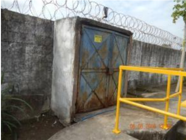
Figura 8 - Falta de manutenção nas estruturas civis na Elevatória Jabaeté I.
