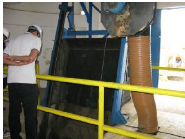
Figura 157 - Biofiltro sem funcionamento na EEEB WP Coqueiral de Itaparica.
