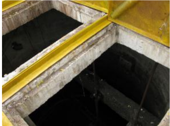
Figura 146 - Ausência de bomba reserva na EEEB F Divino Espírito Santo.
