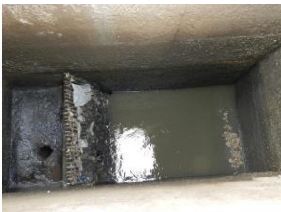
Figura 166 - EEEB Q - IBES- Gradeamento com conservação e limpeza inadequada.
