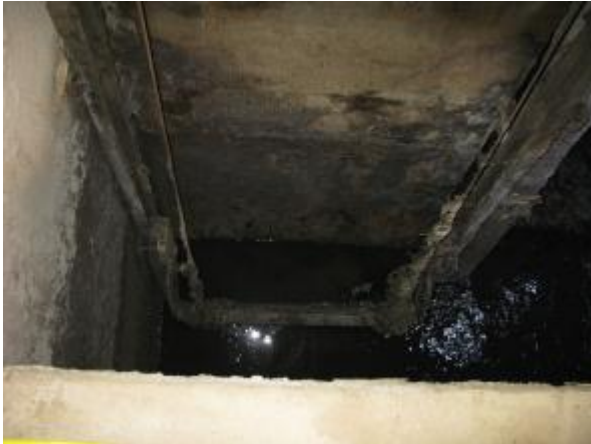
Figura 175 - Gradeamento afogado na EEEB WP Coqueiral.
