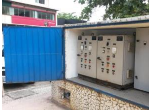
Figura 92 - Elevatória EEEB Praia do Ribeiro / sem sinalização de risco.
