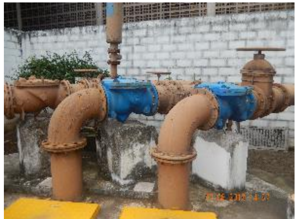
Figura 107 - Estrutura do bloco de concreto deteriorada da Elevatória EEEB D / Pimpolho.
