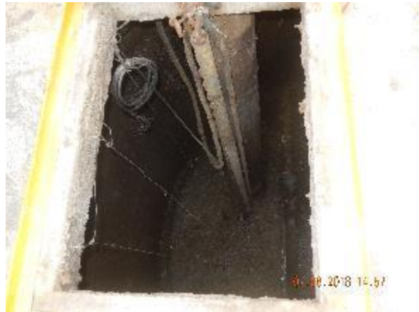
Figura 136 - Ausência de bomba reserva na EEEB D.
