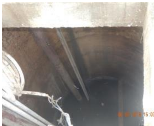
Figura 19 - Ausência de bomba reserva na EEBB 03 da ETE Jardins Veneza.
