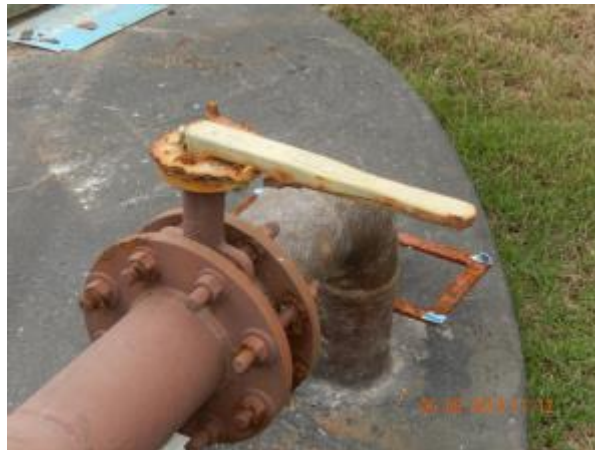
Figura 58 - Registro na elevatória interna à ETE Ulisses Guimarães com corrosão
