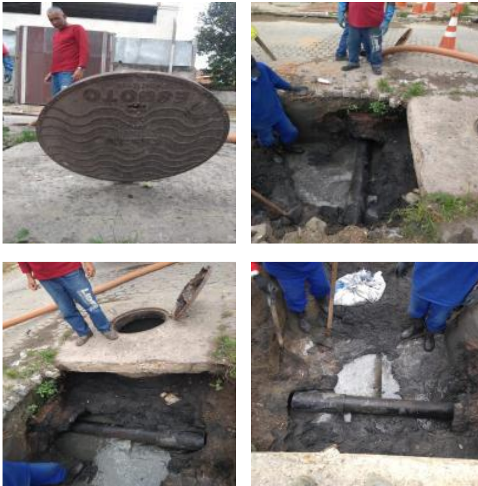
Figuras 198 - Rede de esgotamento sanitário atravessando galeria de drenagem, Rua Cravo Vermelho x Macieira, Bairro Vila Nova, fonte Prefeitura Municipal de Vila Velha.
