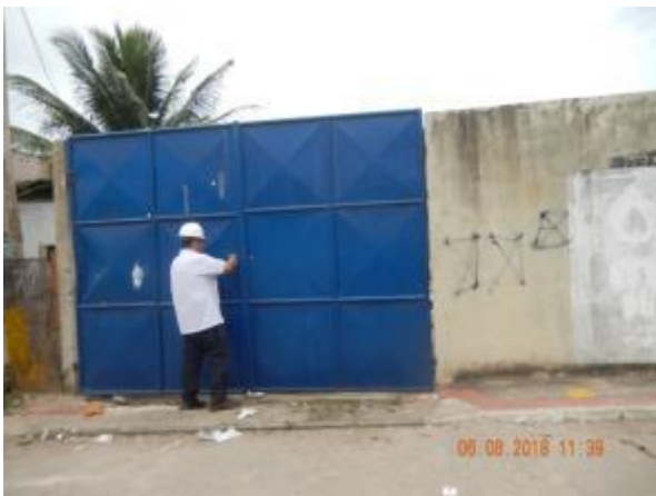
Figura 38 - Elevatória João Goulart 02 com identificação apagada.
