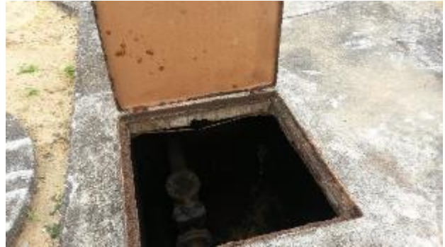
Figura 96 - Tampa em mau estado de conservação na EEEB MARINHA do SES Araças.
