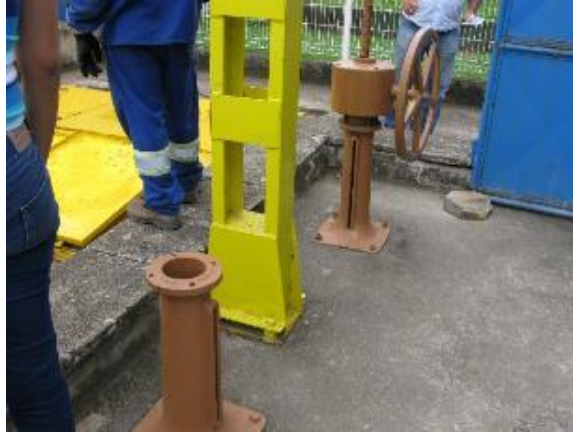
Figura 124 - Ausência da Comporta Central na Elevatória WP - Coqueiral de Itaparica.
