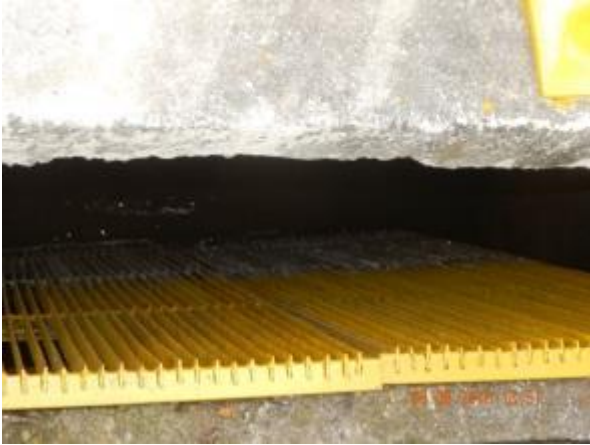
Figura 6 - Gradeamento sem função na elevatória Jabaeté I.
