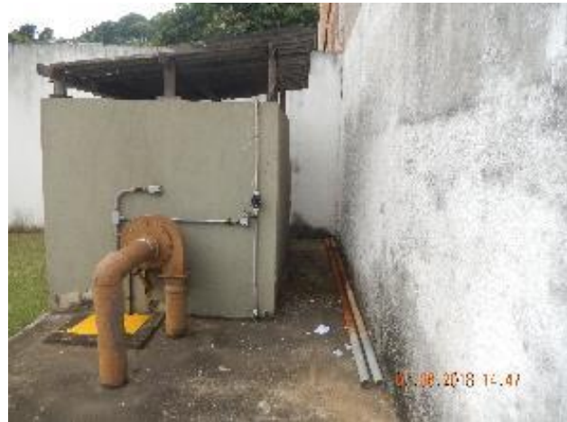
Figura 161 - Biofiltro sem funcionamento na EEEB R. z
