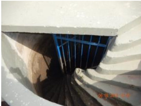
Figura 54 - Escada de acesso ao gradeamento em desacordo com a NBR 12208/1992 na elevatória Ulisses Guimarães II / Terra Vermelha 01
