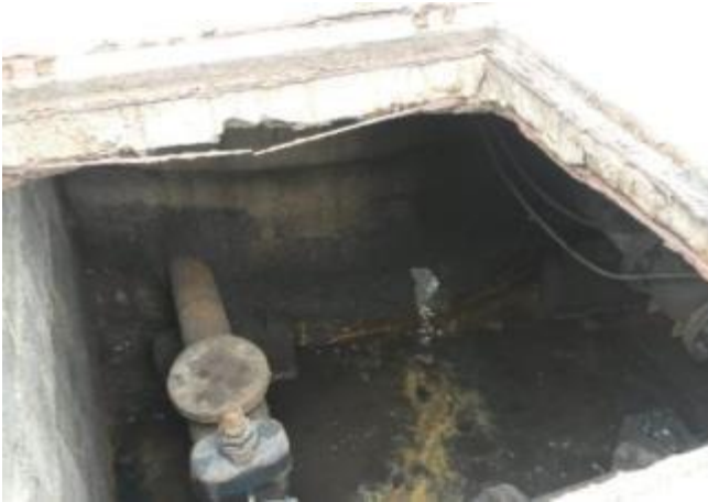
Figura 112 - Abertura no concreto na caixa que comporta barriletes da EEEB Marinha do SES Araçás.
