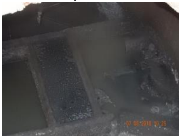
Figura 208 - Gradeamento afogado na EEEB 4 / Rio Marinho.
