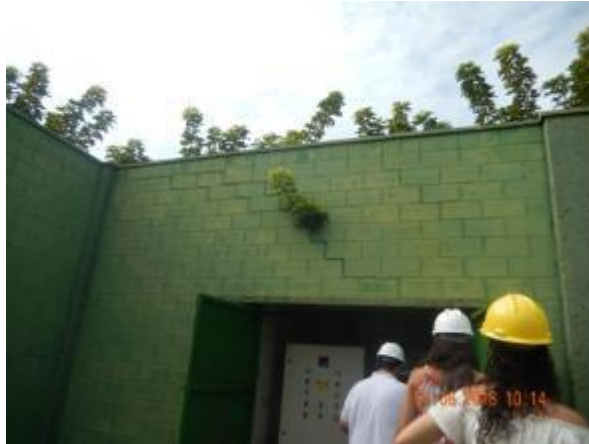
Figura 36 - Trincas com vegetação no muro da EEEB B do sistema Riviera Park.
