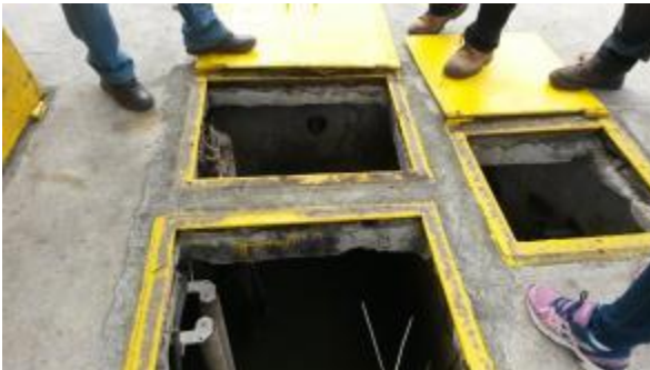
Figura 149 - Ausência de bomba reserva na EEEB A - Praia do Ribeiro.
