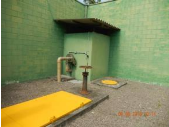
Figura 31 - Biofiltro existente sem funcionamento na EEEB B do sistema Riviera Park.
