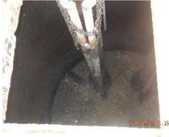
Figura 134 - Ausência de bomba reserva na EEEB 04 / DOM JOÃO BATISTA.
