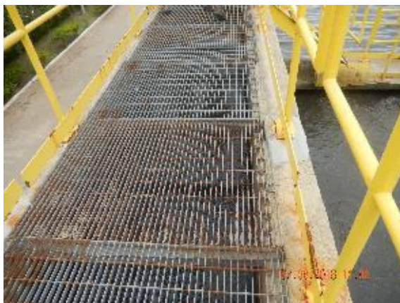
Figura 188 - Plataforma de acesso com corrosão e sem apoio em alguns pontos.
