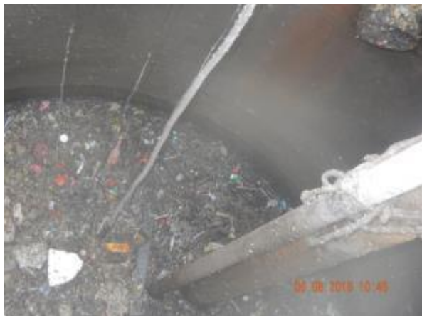
Figura 52 - Material passante devido a retirada do gradeamento na elevatória Ulisses Guimarães II / Terra Vermelha 01.
