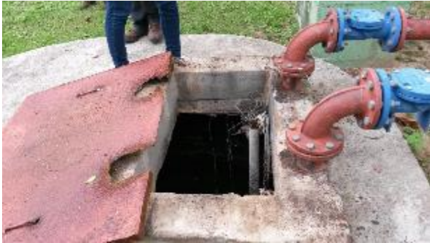
Figura 95 - Tampa em mau estado de conservação na EEEB EXÉRCITO do SES Araças.
