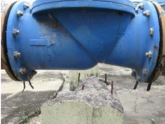
Figura 104 - Ausência de bloco de apoio no barrilete da Elevatória EEEB Itaparica.
