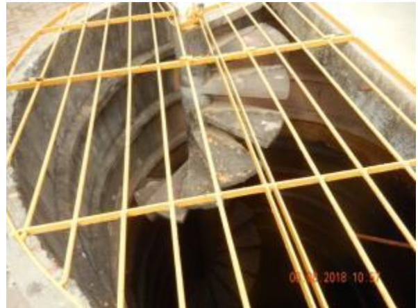
Figura 55 - Escada de acesso ao gradeamento em desacordo com a NBR 12208/1992 na elevatória Ulisses Guimarães I/Terra Vermelha 02.
