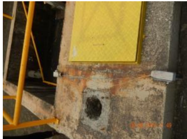
Figura 46 - Fiação exposta da elevatória João Goulart 02.
