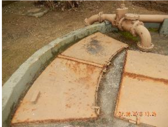
Figura 206 - Tampas com corrosão na EEEB 4 / Rio Marinho.
