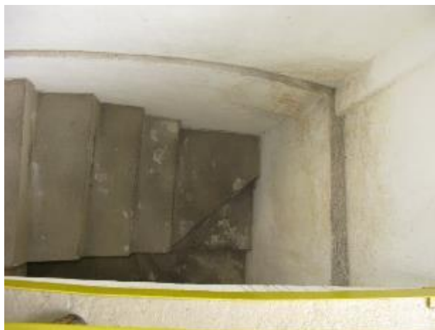
Figura 127 - Falta corrimão na escada interna da EEEB WP Coqueiral de Itaparica.
