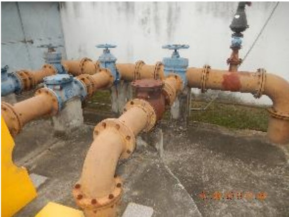
Figura 135 - Ausência de bomba reserva na EEEB R.
