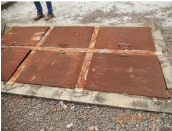
Figura 42 - Tampas do poço de entrada da elevatória João Goulart 02 em processo de corrosão.
