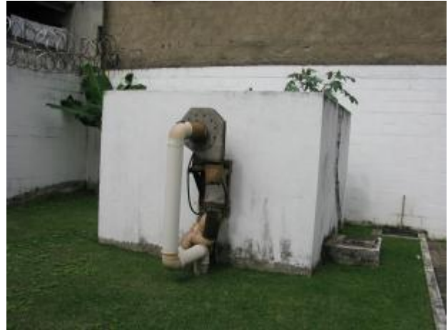
Figura 159 - Biofiltro sem funcionamento na EEEB S - Soteco.
