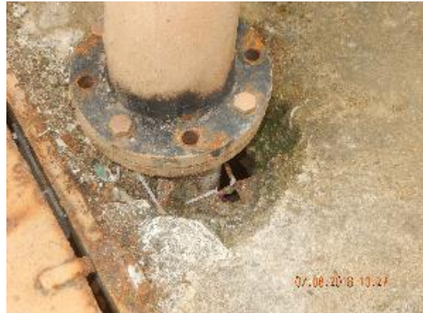
Figura 203 - Estado da estrutura civil da tubulação de sucção da elevatória EEEB 04/Rio Marinho.
