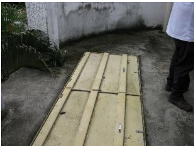
Figura 126 - Falta guarda-corpo na EEEB WP Coqueiral de Itaparica.
