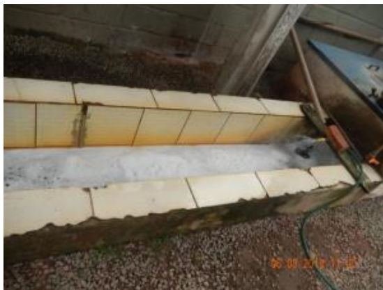
Figura 61 - Presença de espuma excessiva no efluente final da ETE Ulisses Guimarães.
