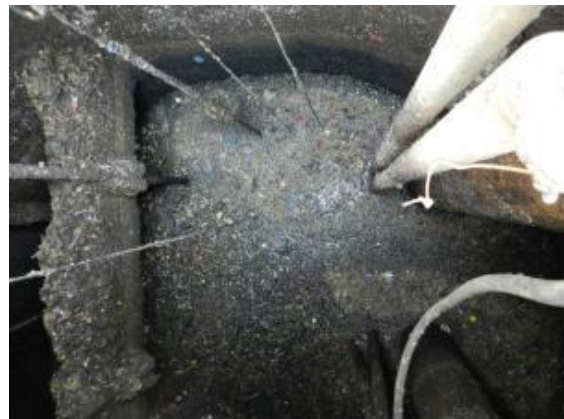
Figura 172 - Excesso de sólidos grosseiros na EEEB Q – IBES.
