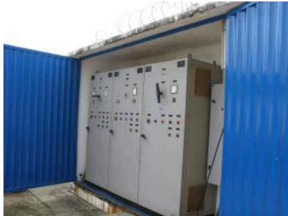
Figura 88 - Elevatória EEEB J / Itapuã sem sinalização de risco.
