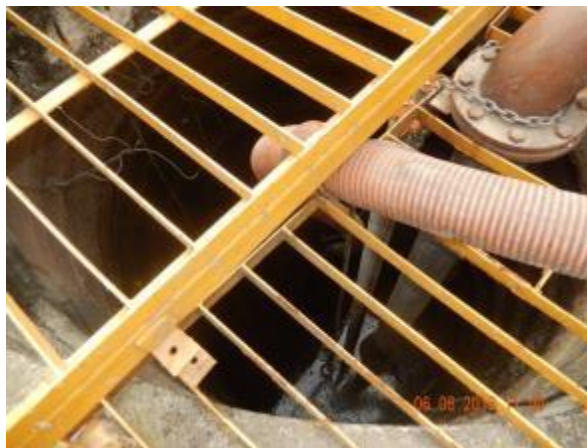
Figura 49 - Ausência de 01 (uma) bomba na elevatória Ulisses Guimarães I / Terra Vermelha 02.
