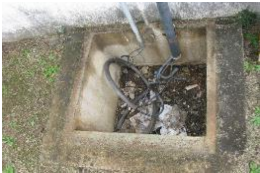
Figura 97 - Sujeira excessiva na caixa da EEEB Itaparica.
