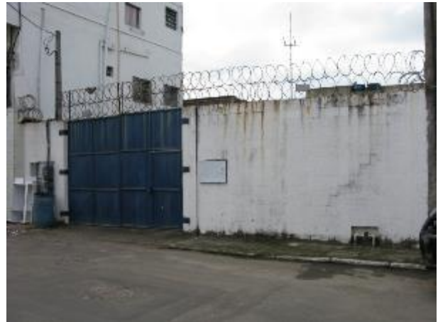
Figura 85 - Identificação da elevatória EEEB S SOTECO do SES Araças deteriorada.
