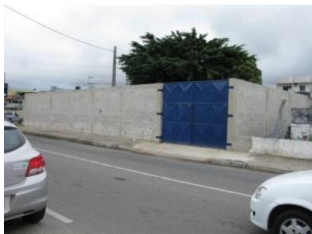
Figura 72 - Elevatória EEEB - Parque das Gaivotas do SES Araçás sem identificação.
