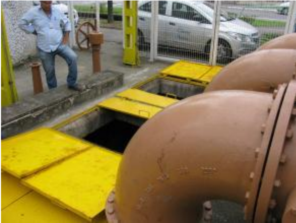
Figura 145 - Ausência de bomba reserva na EEEB WP - Coqueiral de Itaparica.
