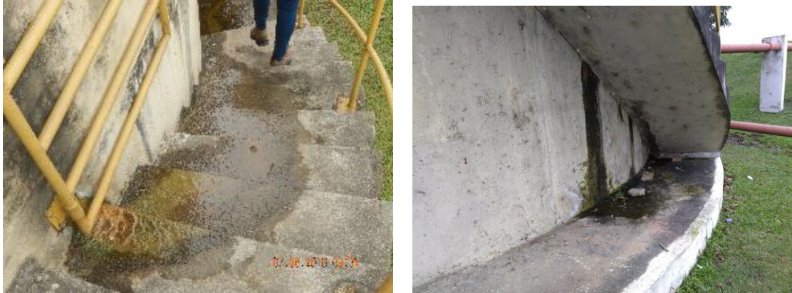
Figura 209 – Vazamentos/infiltrações no tanque do Reator UASB da ETE Vale Encantado.
