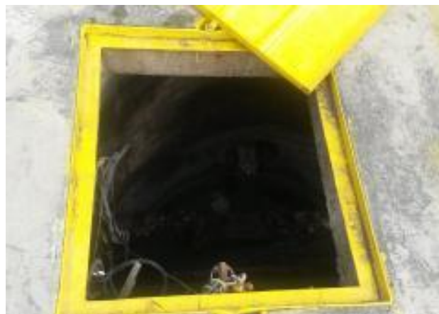
Figura 138 - Ausência de bomba reserva na EEEB B - Prainha.
