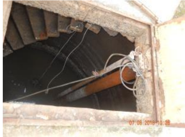
Figura 205 - Ausência de bomba reserva na EEEB 4 - Rio Marinho
