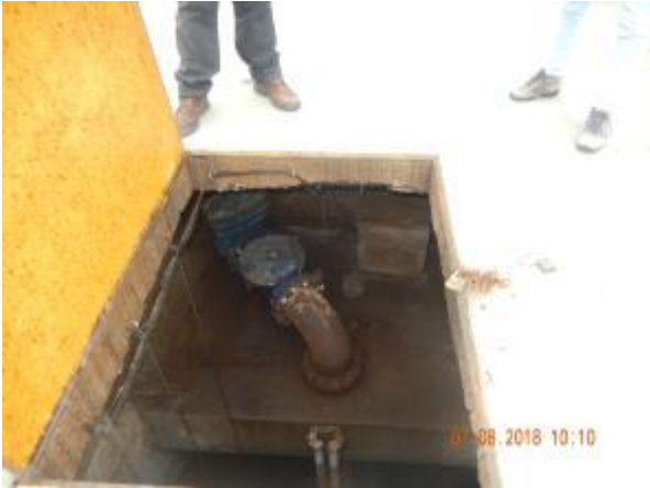
Figura 204 - Ausência de bomba reserva na EEEB 5 / Vale Encantado
