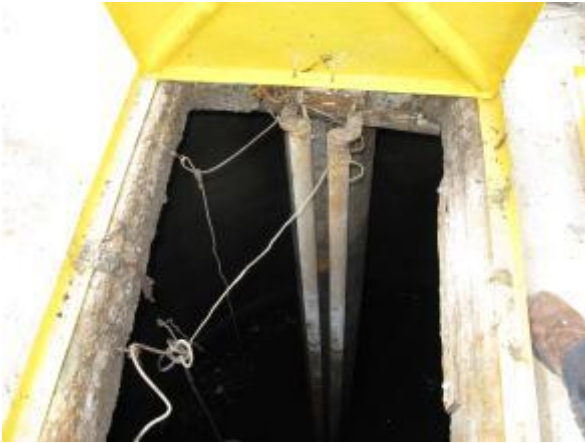
Figura 147 - Ausência de bomba reserva na EEEB S - Soteco.
