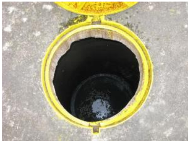
Figura 180 - Poço de visita de chegada à EEEB EEEB 02 necessita manutenção.
