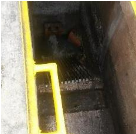
Figura 128 - Espaçamento inadequado no Gradeamento da EEEB B Prainha.
