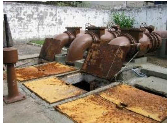
Figura 100 - Tampa em mau estado de conservação na EEEB J Itapua do SES Araças.
