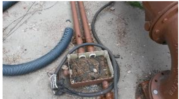
Figura 98 - Sujeira excessiva na caixa da EEEB VV C - Terceira Ponte.
