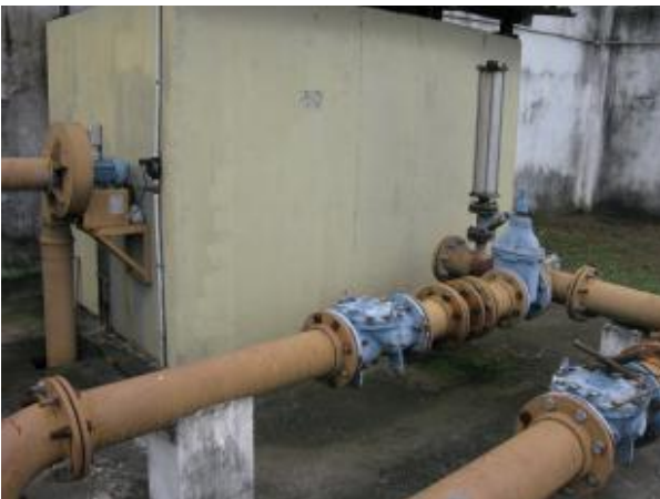
Figura 156 - Biofiltro sem funcionamento na EEEB 02 Guaranhos II.
