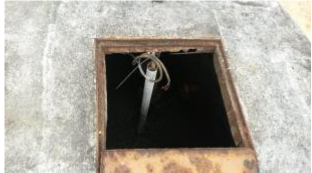
Figura 152 - Ausência de bomba reserva na EEEB Marinha.
