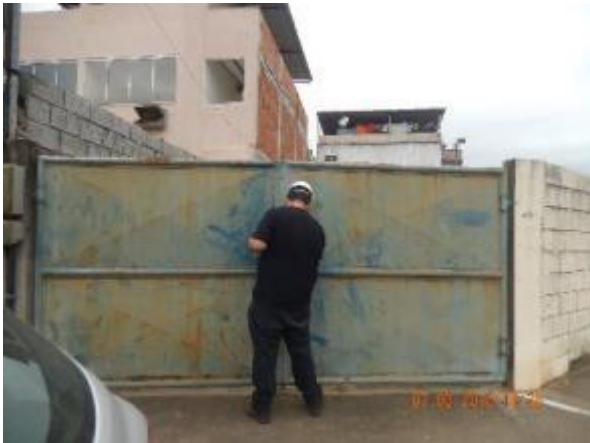
Figura 69 - Elevatória EEEB Parque das Esmeraldas do SES Araçás sem identificação.
