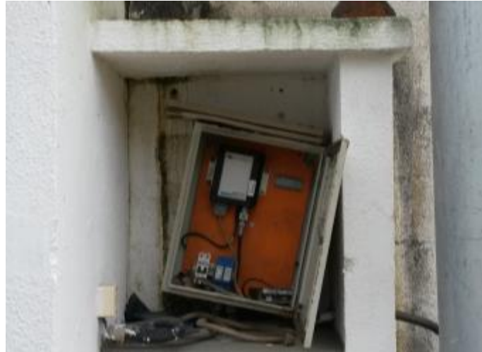
Figura 181 - Tampa do painel estava quase se soltando na EEEB VV C – Terceira Ponte.
