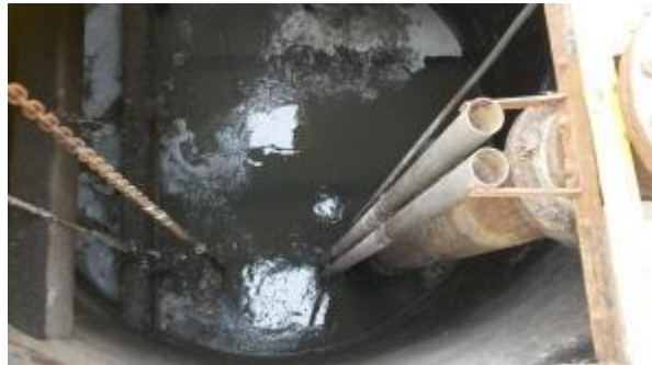
Figura 150 - Ausência de bomba reserva na EEEB VV C Terceira Ponte.
