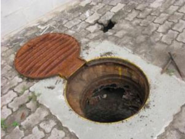
Figura 178 - Poço de visita de chegada à EEEB Parque das Gaivotas necessita manutenção.
