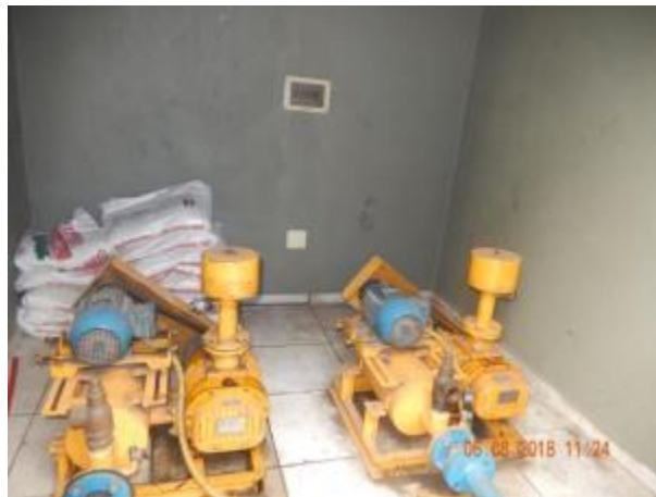
Figura 62 - Ausência de sinalização risco contra choque elétrico na sala de sopradores da ETE Ulisses Guimarães.
