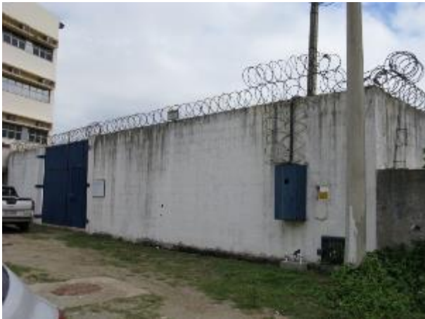
Figura 84 - Identificação da elevatória EEEB F/ Divino ES do SES Araças deteriorada
