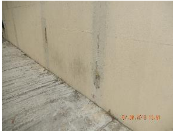
Figura 186 - Fissuras no tanque da ETE Araçás
