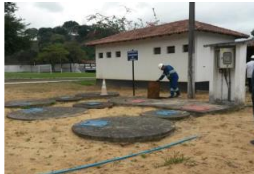
Figura 76 - Elevatória EEEB da Marinha do SES Araças sem identificação.
