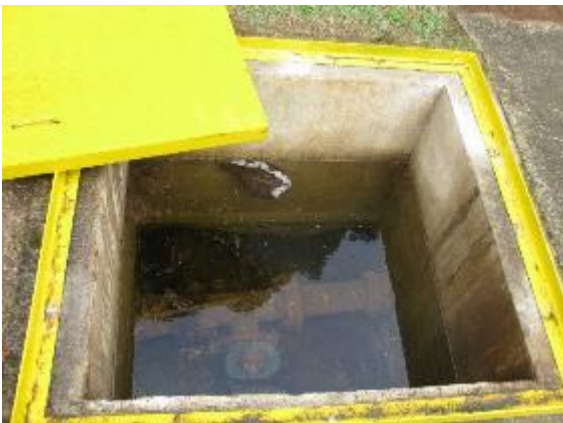
Figura 115 - Retenção de líquidos na caixa de manobra da EEEB 4.
