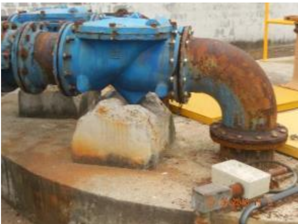
Figura 108 - Estrutura do bloco de concreto deteriorada e do poço de sucção com rebaixamento do piso lateral da Elevatória EEEB Q-IBES.
