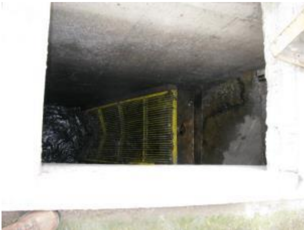
Figura 130 - Gradeamento danificado na EEEB Itaparica.
