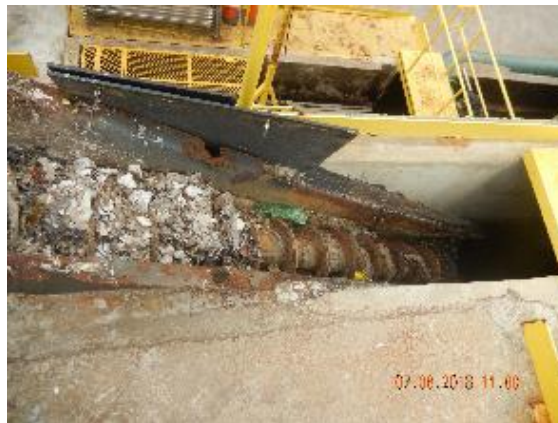
Figura 185 - Sem rosca / rosca com defeito do desarenador da ETE Araçás.
