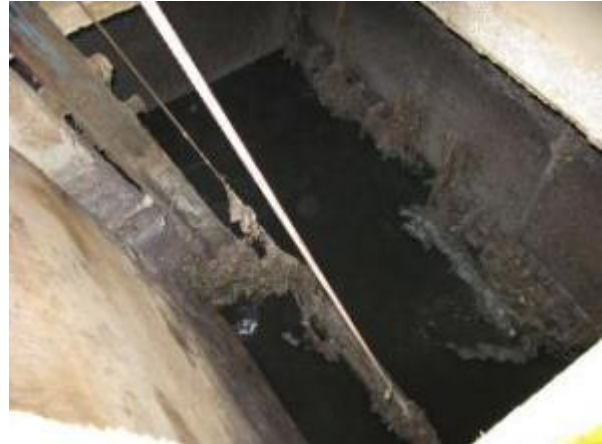
Figura 176 - Gradeamento afogado na EEEB WP Coqueiral.
