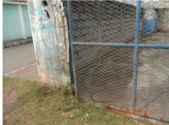
Figura 9 - Evidência de falta de manutenção nas instalações civis na Elevatória Jabaeté III.
