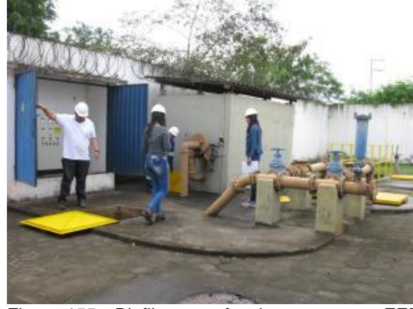
Figura 155 - Biofiltro sem funcionamento na EEEB 03 do SES Araçás.
