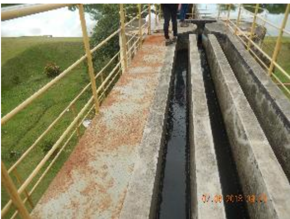
Figura 211 - Plataforma metálica superior com corrosão.
