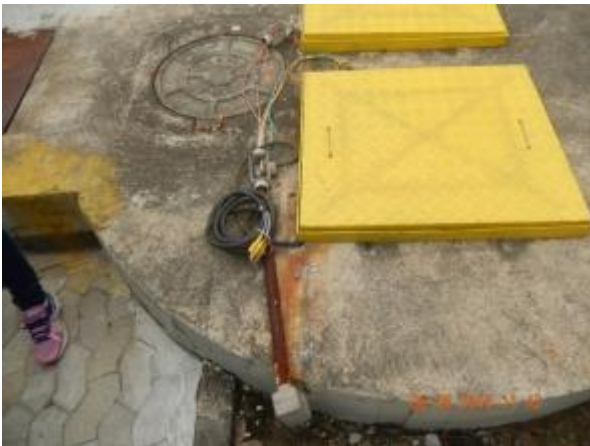
Figura 45 - Fiação exposta da elevatória João Goulart 01.
