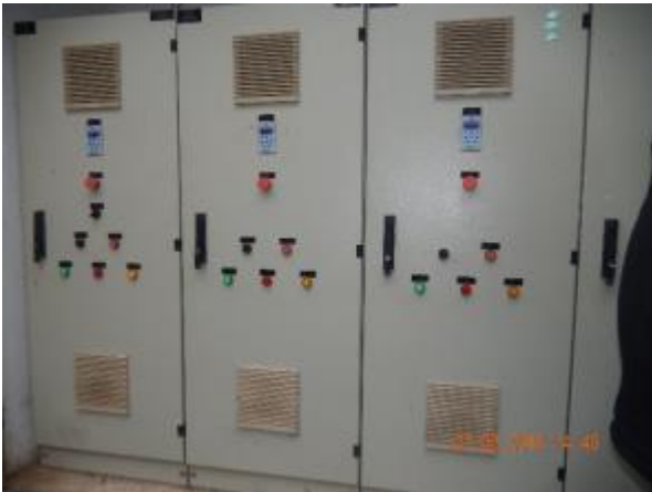
Figura 87 - Elevatória EEEB R sem sinalização de risco.
