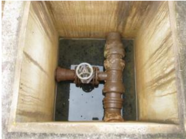
Figura 120 - Líquido retido em caixa EEEB 2 - Guaranhus I.
