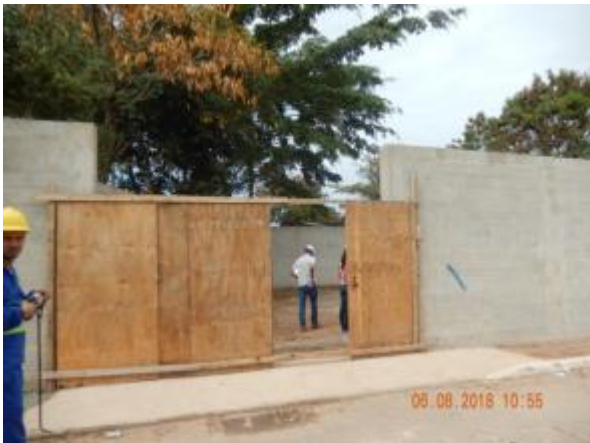
Figura 40 - Elevatória Ulisses Guimarães I / Terra Vermelha 02 sem identificação
