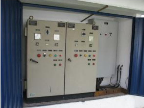
Figura 91 - Elevatória EEEB S / Soteco sem sinalização de risco.
