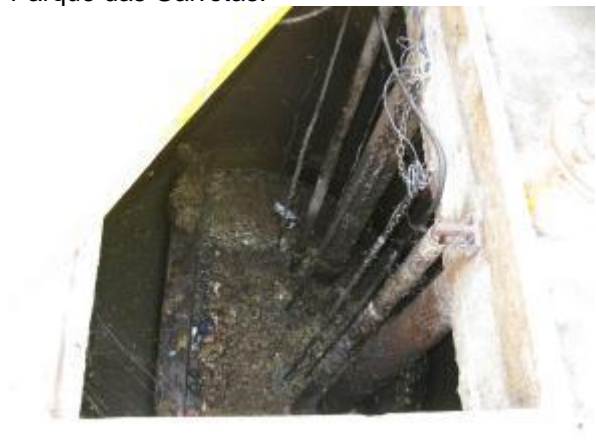
Figura 144 - Ausência de bomba reserva na EEEB 2 - Guaranhus II.
