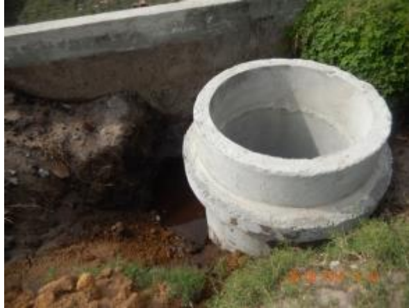
Figura 12 - Vazamentos próximos ao leito de secagem na ETE Jabaeté.
