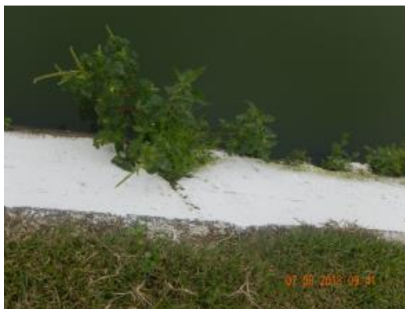
Figura 215 - Vegetação na face do talude da ETE Vale Encantado.
