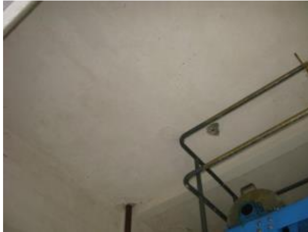
Figura 182 - Ausência de iluminação no local onde está instalado o tratamento preliminar na EEEB J (Itapuã).
