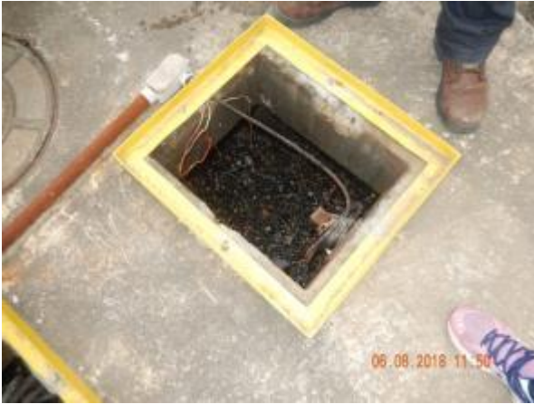
Figura 50 - Nenhuma bomba em funcionamento na elevatória João Goulart 01.
