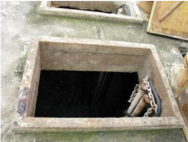
Figura 141 - Ausência de bomba reserva na EEEB Itaparica.
