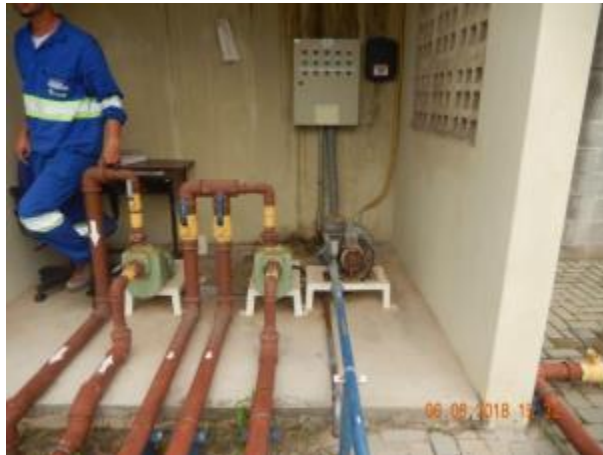
Figura 26 - Ausência de sinalização de risco no painel de controle da ETE Mar D'Ulé.
