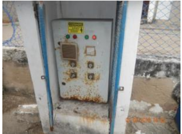
Figura 113 - Demanda de manutenção na estrutura do painel da EEEB Dom João Batista do SES Araçás
