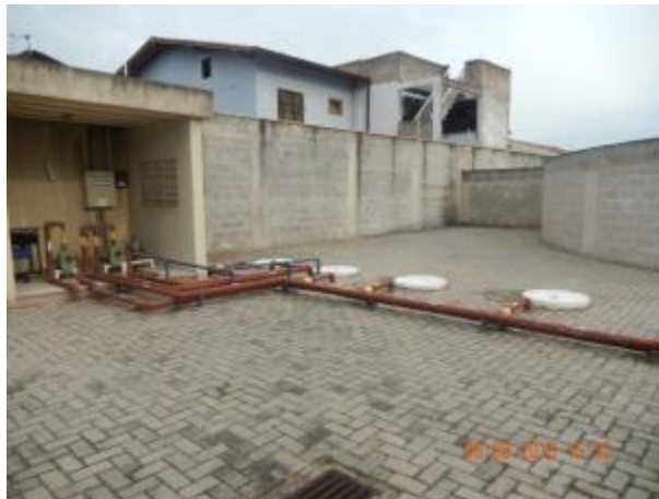
Figura 24 - Ausência de pré-tratamento na ETE Mar D’Ulé.
