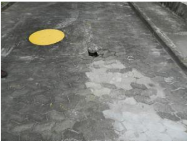
Figura 114 - Buraco no piso ao lado da caixa de passagem na EEEB R do SES Araçás
