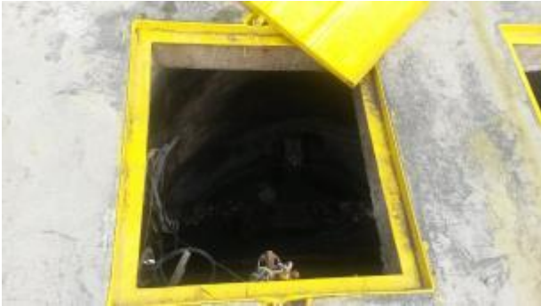
Figura 151 - Ausência de bomba reserva na EEEB Prainha.
