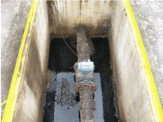
Figura 117 - Líquido em caixa da EEEB 02 / Guaranhus II.
