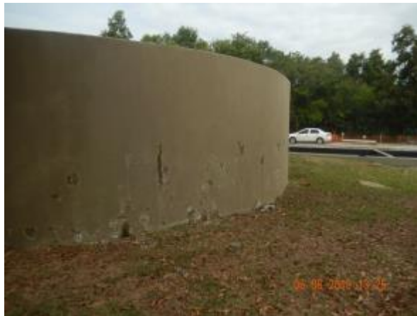
Figura 11 - Evidências de infiltrações nos tanques da ETE Jabaeté.
