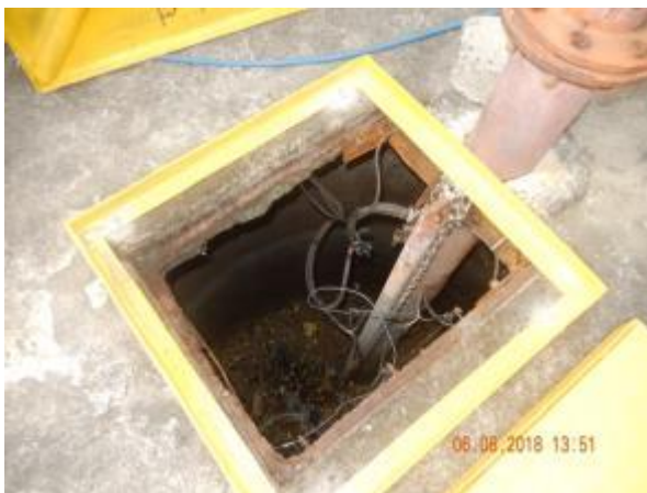
Figura 4 - Ausência de 01 (um) conjunto motobomba na Elevatória Jabaeté I.
