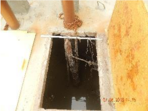
Figura 133 - Ausência de bomba reserva na EEEB COLINAS II.
