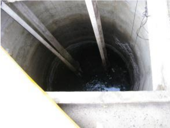
Figura 139 - Ausência de bomba reserva na EEEB4.
