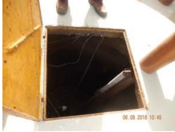
Figura 48 - Ausência de 01 (uma) bomba na elevatória Ulisses Guimarães II / Terra Vermelha 01.
