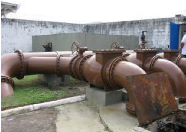
Figura 160 - Biofiltro sem funcionamento na EEEB J - Itapuã.
