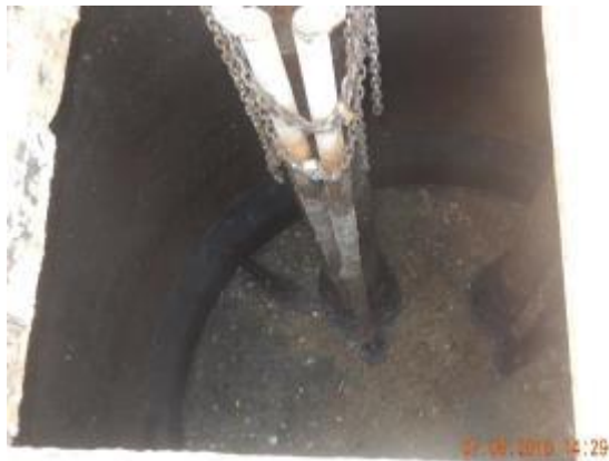
Figura 171 - Excesso de sólidos grosseiros na EEEB 04 - Dom João Batista.
