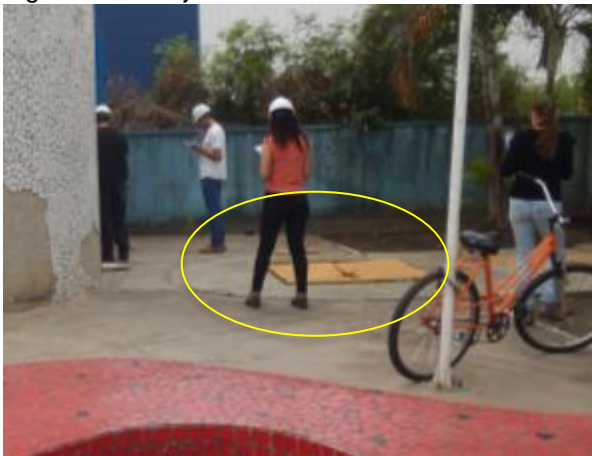
Figura 103 - EEEB L Colorado tampa danificada.
