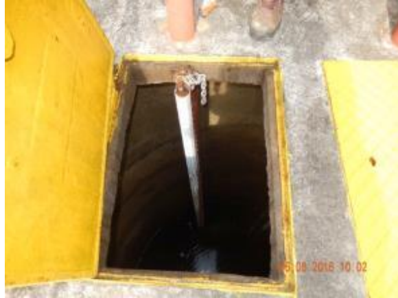
Figura 34 - Ausência de 01 (uma) bomba na elevatória EEEB C do sistema Riviera Park.
