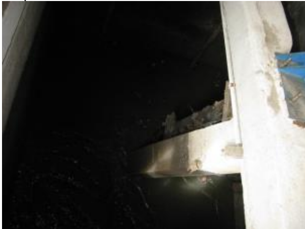
Figura 177 - Gradeamento afogado na EEEB J (Itapuã).
