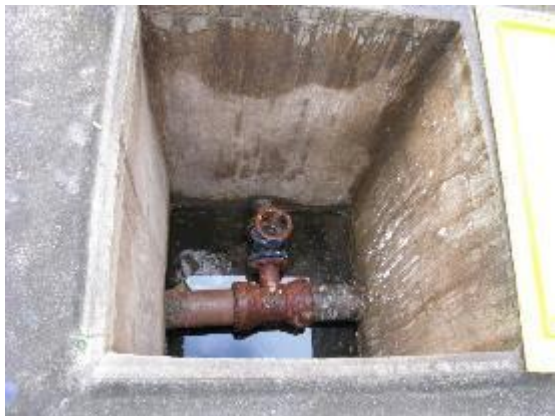
Figura 116 - Retenção de líquidos na caixa de manobra da EEEB 3
