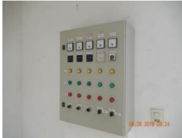
Figura 37 - Ausência de sinalização de risco de choque elétrico nos painéis da ETE Riviera Park.
