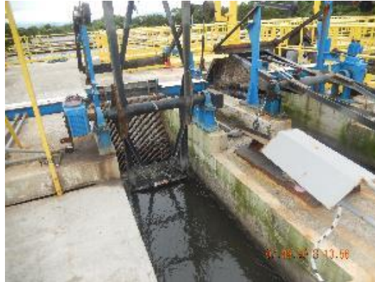
Figura 183 - Ausência de pá de limpeza em um dos gradeamentos finos da ETE Araçás.
