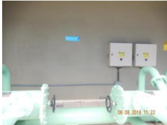
Figura 60 - Reator Ultravioleta sem funcionamento na ETE Ulisses Guimarães.
