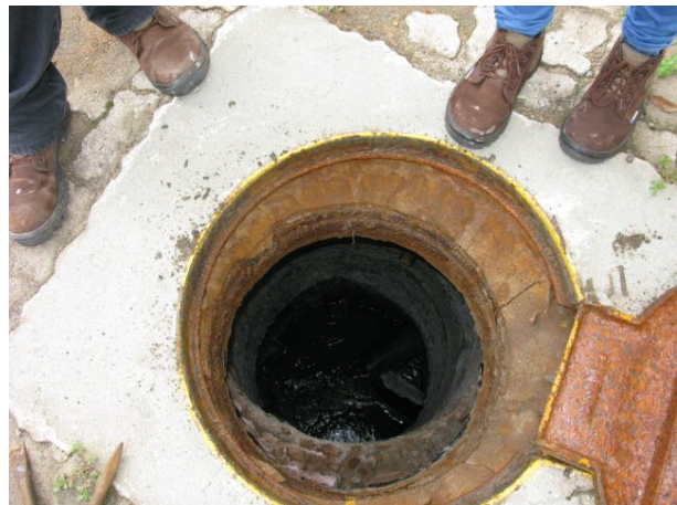
Figura 169 - EEEB Parque das Gaivotas sem Gradeamento.
