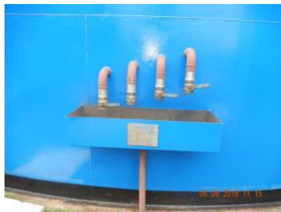
Figura 57 - Falta de 01 (um) registro no tanque do reator da ETE Ulisses Guimarães
