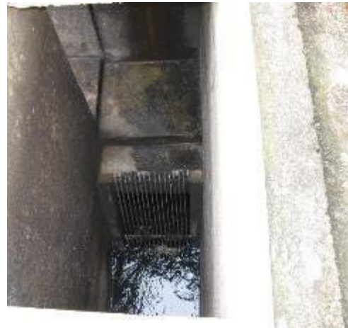
Figura 129 - Espaçamento inadequado no Gradeamento da EEEB 5.
