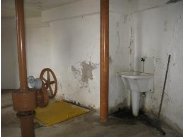
Figura 110 - Estruturas civis da EEEB WP Coqueiral de Itaparica comprometidas.
