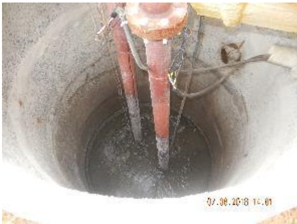
Figura 131 - Ausência de bomba reserva na EEEB EVERTON MONTENEGRO.
