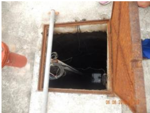
Figura 25 - Ausência de bomba reserva na EEEB da ETE Mar D'Ulé.
