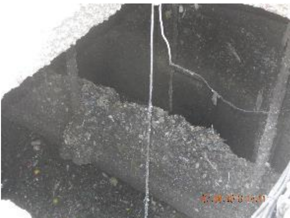
Figura 137 - Ausência de bomba reserva na EEEB Q.
