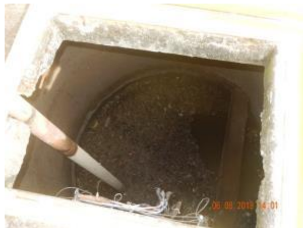
Figura 5 - Ausência de 01 (um) conjunto motobomba e verificação de passagem de sólidos na Elevatória Jabaeté III.
