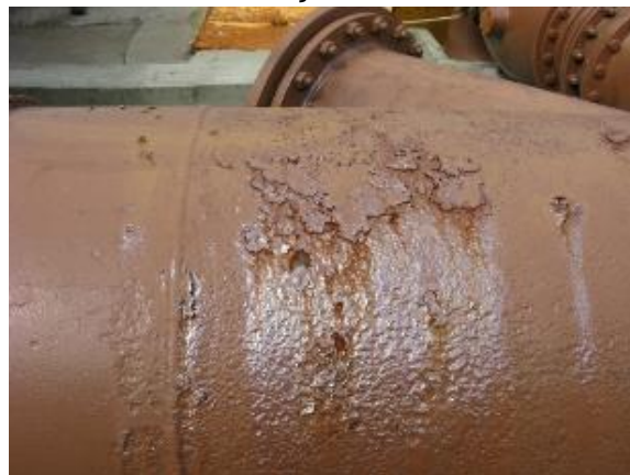
Figura 125 - Corrosão no Barrilete – EEEB J Itapoã, Rua Janine Duarte, Itapoã.
