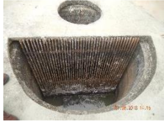
Figura 102 - Colinas II sem tampa e/ou proteção
