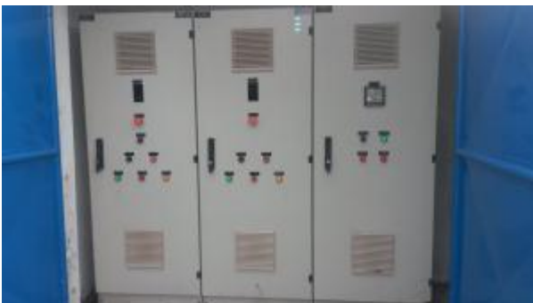
Figura 89 - Elevatória EEEB B - Prainha sem sinalização de risco.
