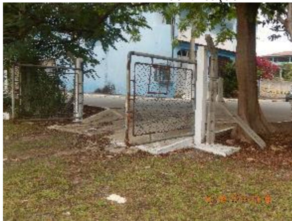
Figura 201 - ETE Vale Encantado sem identificação.
