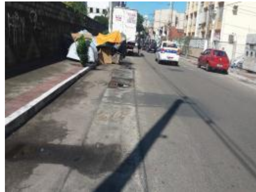
Figura 224 - Abaulamento do Asfalto em vários trechos da Rua Afonso Pena, Praia da Costa
