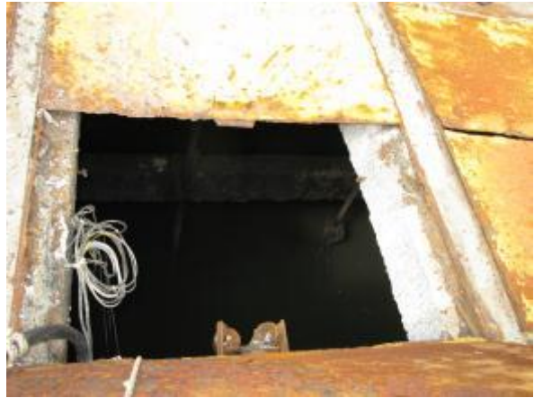
Figura 148 - Ausência de bomba reserva na EEEB J - Itapoã.
