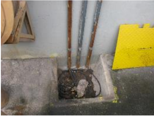
Figura 101 - Sujeira excessiva na caixa da EEEB 04.
