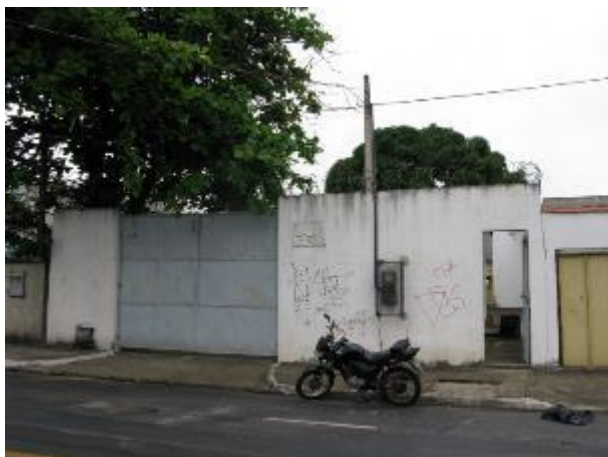
Figura 80 - Identificação da elevatória EEEB 4 do SES Araças deteriorada.
