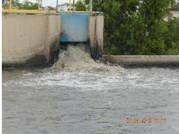
Figura 189 - ETE operando com vazão acima da capacidade de projeto.
