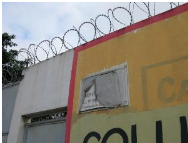
Figura 81 - Identificação da elevatória EEEB 3 do SES Araças deteriorada.
