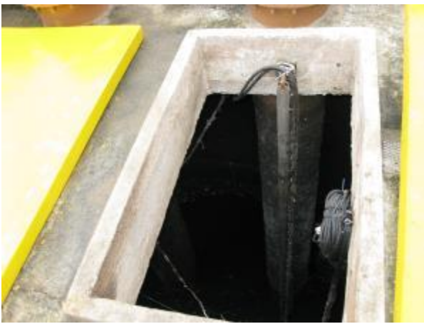
Figura 153 - - Ausência de bomba reserva na EEEB 5.
