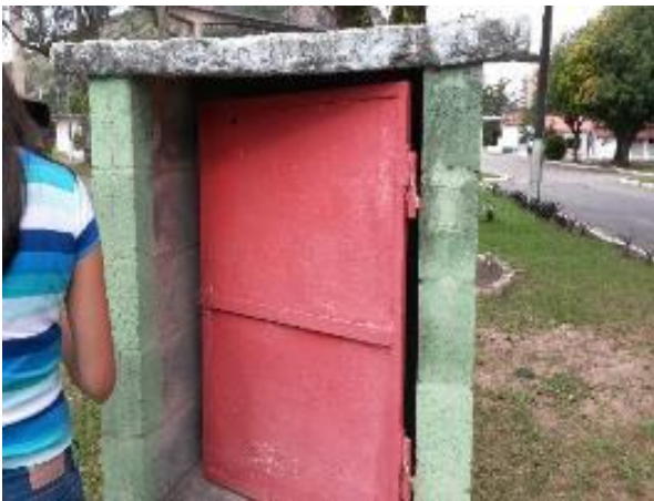
Figura 106 - Estrutura civil precária na Elevatória EEEB Exército.
