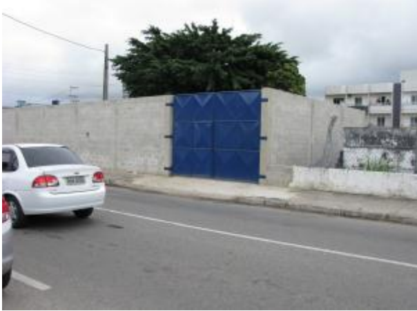
Figura 196 - Tela lateral da unidade de tratamento desativada danificada.
