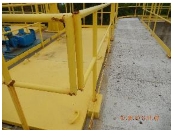
Figura 187 - Corrosão no Guarda-Corpo da ETE Araçás
