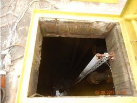
Figura 47 - Ausência de 01 (uma) bomba na elevatória João Goulart 02.
