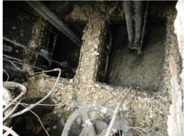
Figura 174 - Excesso de sólidos grosseiros na EEEB I – Colorado
