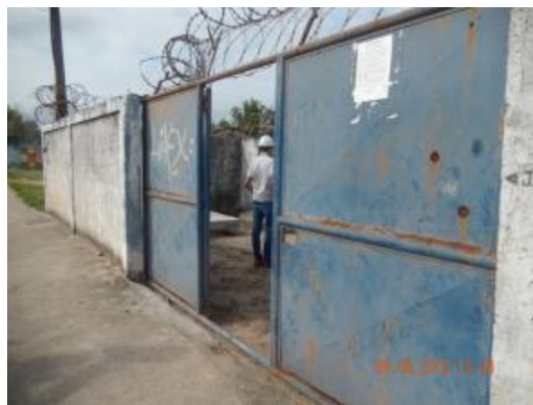
Figura 2 - Elevatória Jabaeté I sem identificação.
