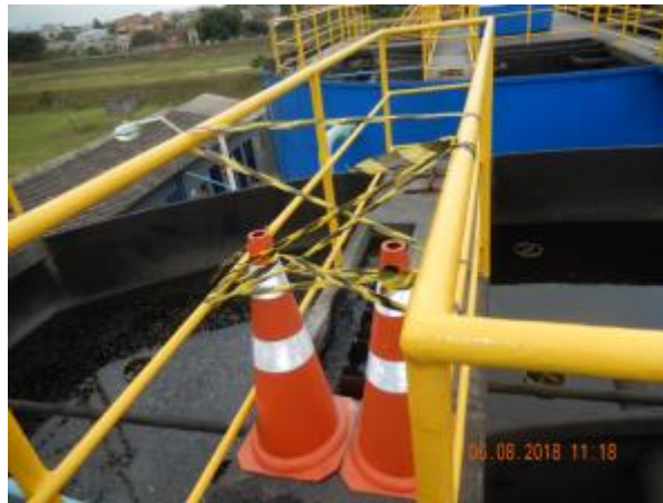
Figura 59 - Falta de manutenção na plataforma superior do reator da ETE Ulisses Guimarães.
