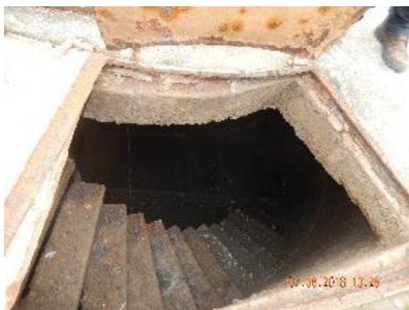
Figura 207 - Escada sem corrimão na EEEB 4 / Rio Marinho.
