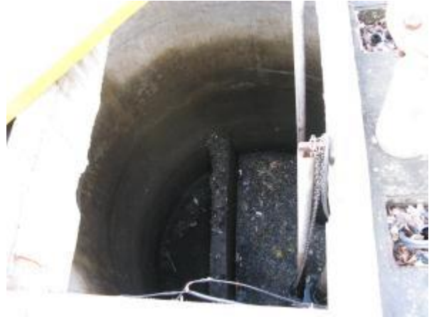
Figura 140 - Ausência de bomba reserva na EEEB3.
