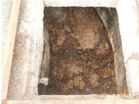
Figura 210 - Falta de limpeza no compartimento superior do UASB da ETE Vale Encantado.
