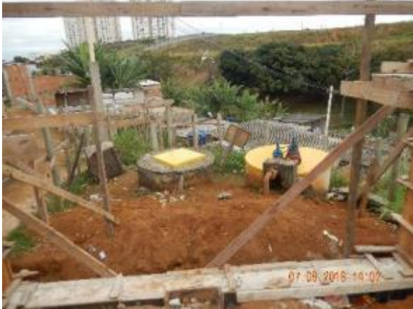
Figura 63 - Elevatória Everton Montenegro sem identificação.
