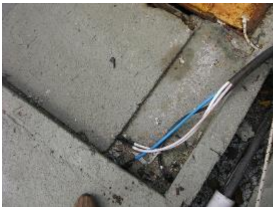
Figura 122 - Fiação exposta na Elevatória J – Itapuã.
