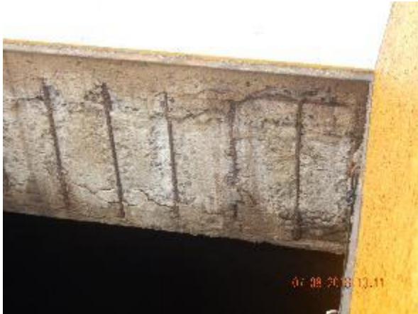
Figura 202 - Estado da estrutura civil do poço de sucção da EEEB 5 / Vale Encantado.
