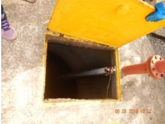
Figura 33 - Ausência de 01 (uma) bomba na elevatória EEEB A do sistema Riviera Park.
