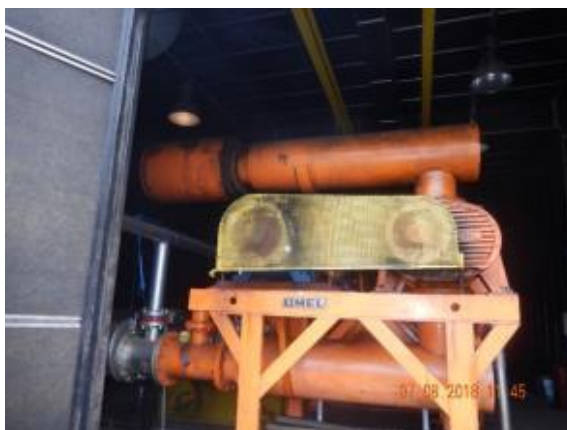
Figura 195 - 03 (três) sopradores sem funcionamento
