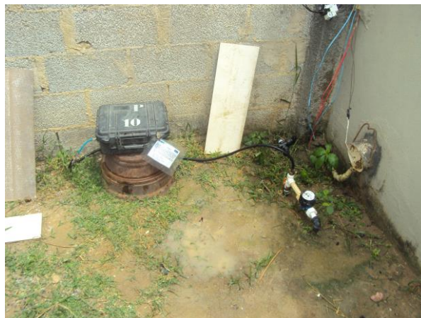
Figura 5 - Instalação do Equipamento no Ponto 05 - Município de Vila Velha, ES
