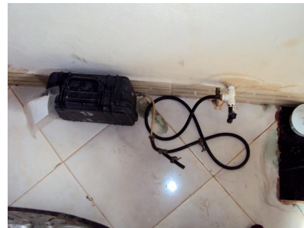
Figura 6 - Instalação do Equipamento no Ponto 06 - Município de Vila Velha, ES
