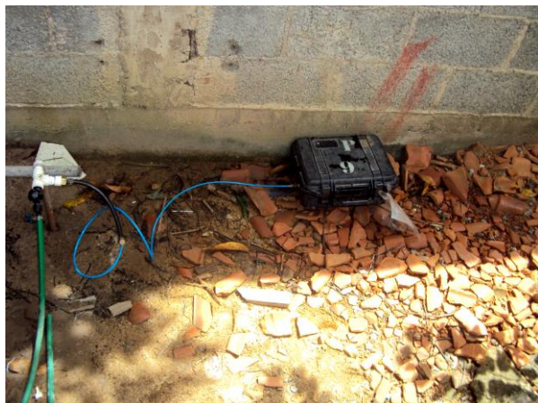
Figura 4 - Instalação do Equipamento no Ponto 04 - Município de Vila Velha, ES
