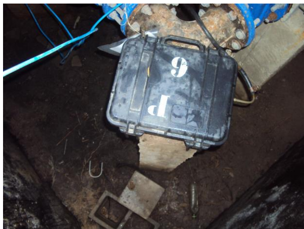
Figura 1 - Instalação do Equipamento no Ponto 01 - Município de Vila Velha, ES
