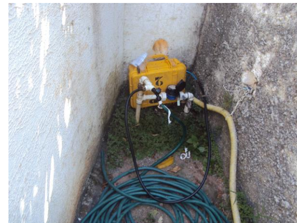
Figura 12 - Instalação do Equipamento no Ponto 12 - Município de Vila Velha, ES
