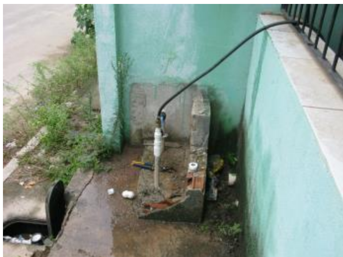
Figura 11 - Equipamento de medição instalado no Ponto 11 – Município de Vila Velha, ES
