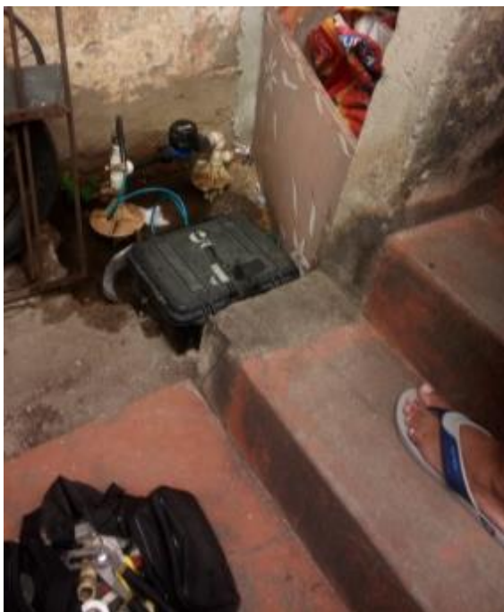
Figura 5 - Equipamento de medição instalado no Ponto 05 – Município de Vila Velha, ES
