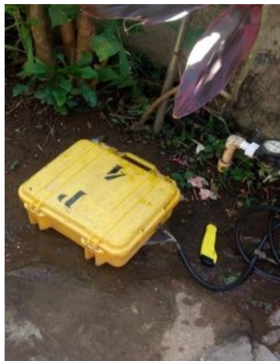
Figura 4 - Equipamento de medição instalado no Ponto 04 - Município de Vila Velha, ES
