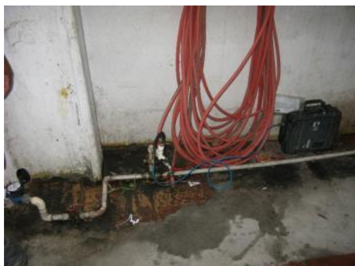
Figura 16 - Equipamento de medição instalado no Ponto 15 – Município de Vila Velha, ES
