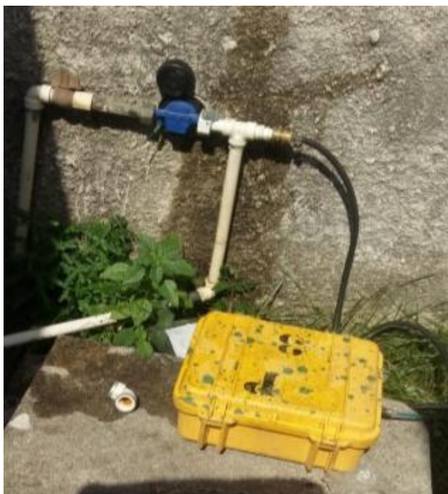
Figura 3 - Equipamento de medição instalado no Ponto 03 - Município de Vila Velha, ES
