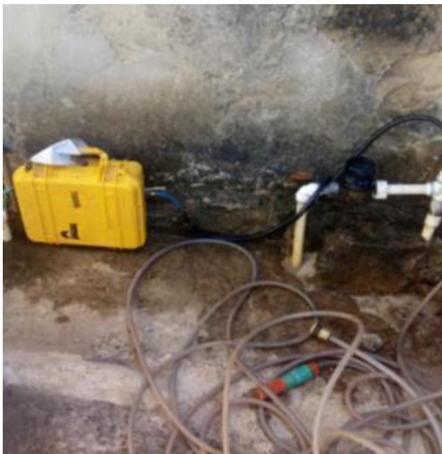
Figura 1 - Equipamento de medição instalado no Ponto 01 - Município de Vila Velha, ES
