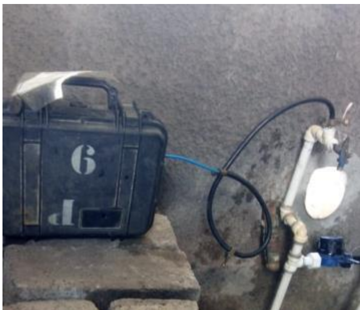
Figura 9 - Equipamento de medição instalado no Ponto 09 – Município de Vila Velha, ES
