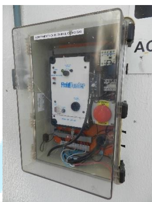
Figura 40 - Equipamento detector de cloro gás.
