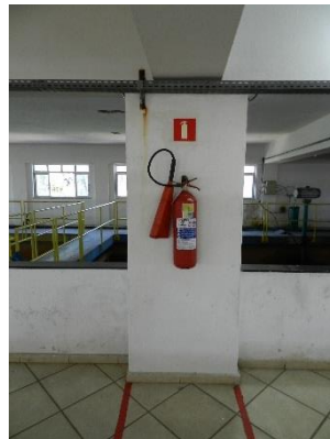
Figura 43 - Extintor próximo aos filtros.
