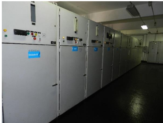
Figura 6 - Painéis de comando do Baixo Recalque.
