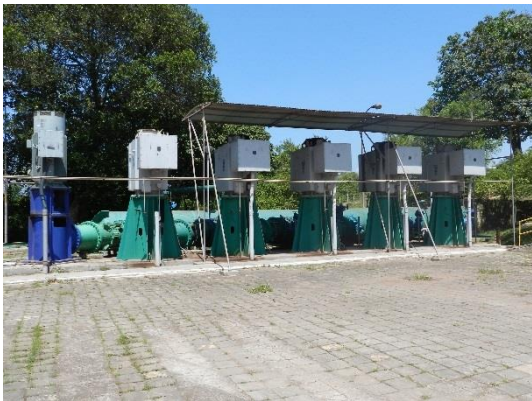
Figura 5 - Elevatórias de água bruta (Baixo Recalque).
