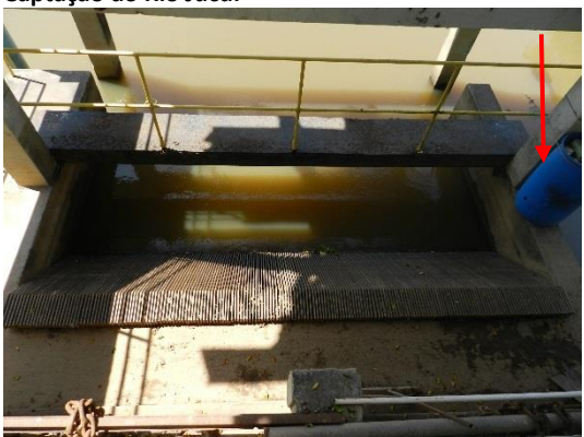
Figura 4 - Gradeamento no final do canal de captação. Detalhe para o tambor de armazenamento dos resíduos que são retirados do mesmo
