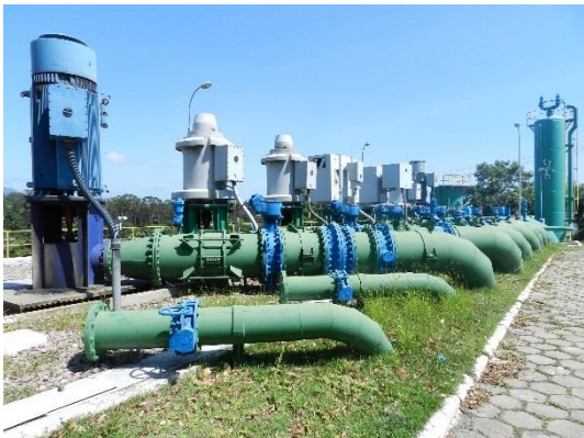
Figura 9 - Elevatória de água bruta (Alto Recalque).
