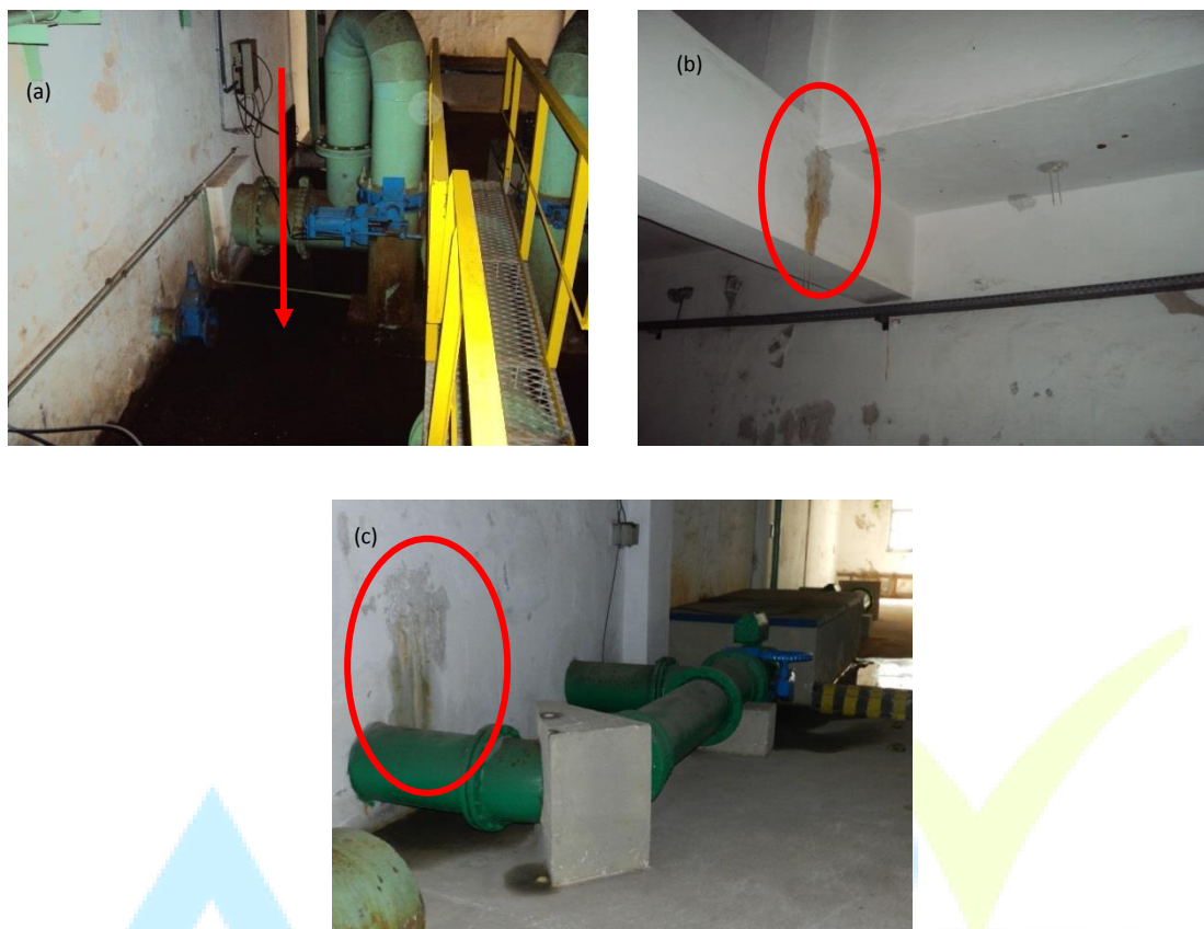
Figura 27 - (a, b e c) - Indícios de vazamento e infiltrações no local onde está instalada a elevatória da ETA Cobi.
