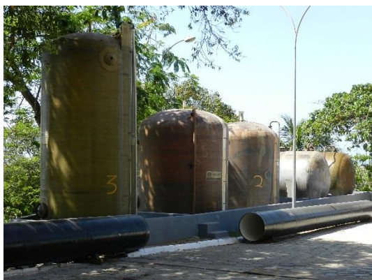
Figura 38 - Local de estoque de sulfato de alumínio, polieletrólitos e ácido flúorsilícico.
