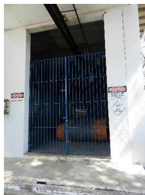
Figura 39 - Depósito de cilindro de cloro.
