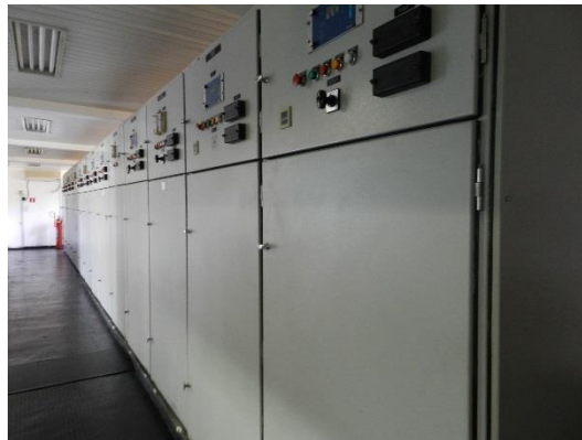
Figura 10 - Painéis de comando do Alto Recalque.
