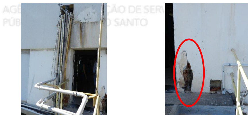
Figura 28 - Aberturas e rachaduras no portal de acesso ao local onde estão instalados os filtros.
