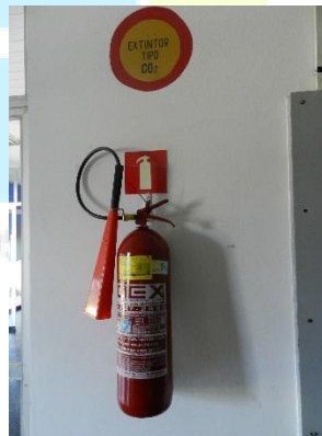
Figura 14 - Extintor de Incêndio.
