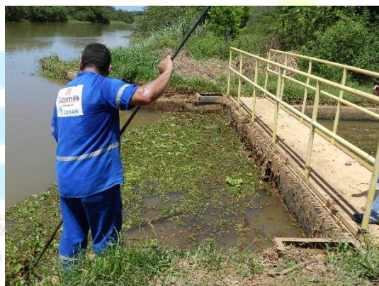
Figura 2 - Gradeamento na entrada do Canal de Captação do Rio Jucu.
