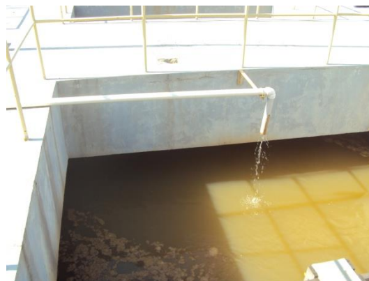
Figura 19 – Local de adição de polieletrólito no floculador da ETA Cobi.
