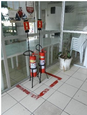
Figura 42 - Extintores na entrada da ETA Cobi.
