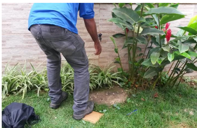
Figura 2 - Instalação do Equipamento no Ponto 02 - Município de Vila Valério, ES
