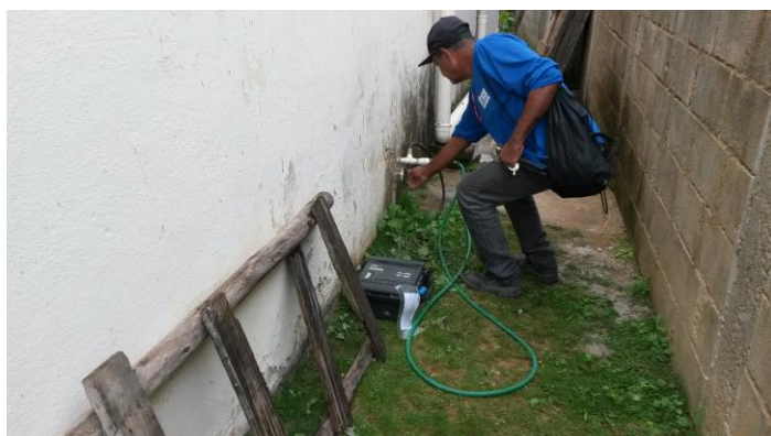
Figura 4 - Instalação do Equipamento no Ponto 04 - Município de Vila Valério, ES
