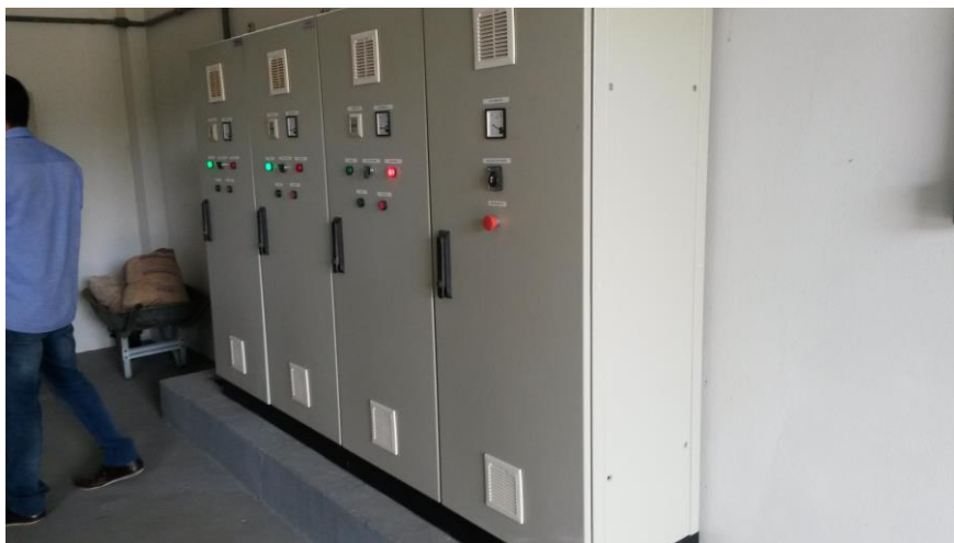
Figura 8 – Sem sinalização de Risco nos quadros elétricos da ETE.
