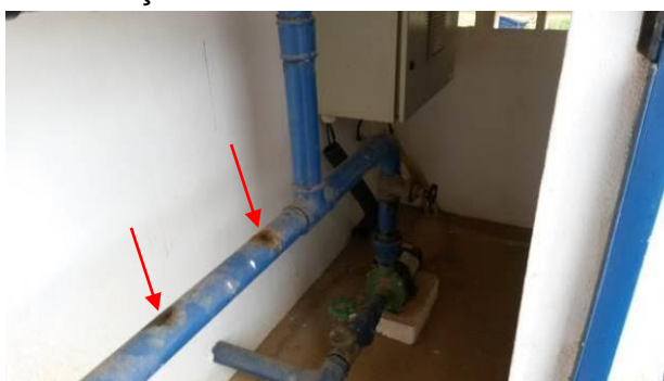
Figura 27: Tubulação do Booster Fávero demandam manutenção
