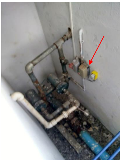
Figura 16: Quadro elétrico da EEAT existente na ETA Vila Valério (C.11.4).
