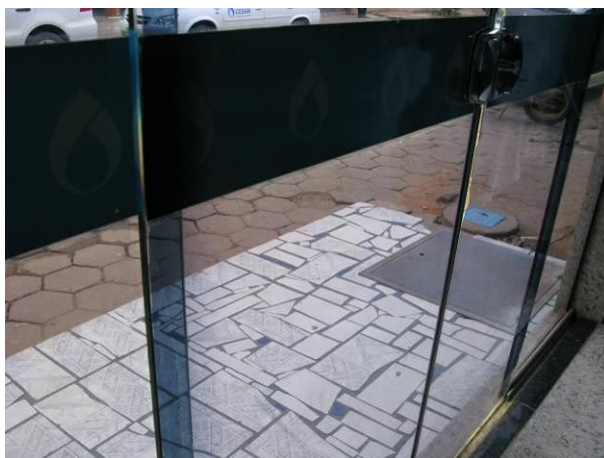
Figura 30: Calçada e acesso ao escritório carecem de rampa para acessibilidade.
