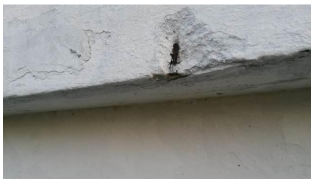
Figura 23: Sinal de corrosão no Reservatório de 300m 3
