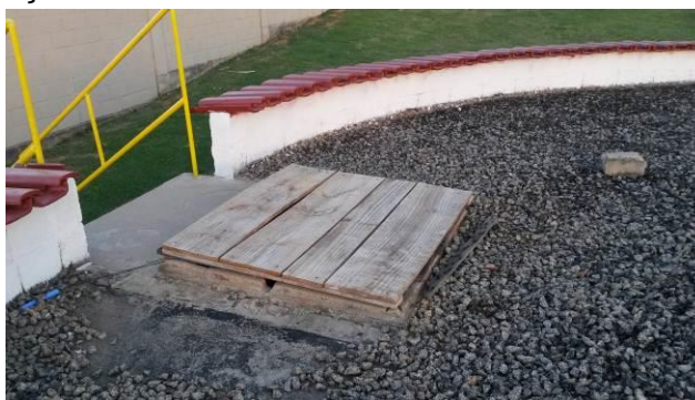
Figura 24: Ausência de Guarda-corpo na parte superior no Reservatório de 300m³
