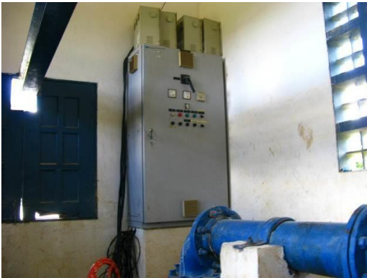
Figura 13: Quadro elétrico da Captação do Rio São José (C11.1).
