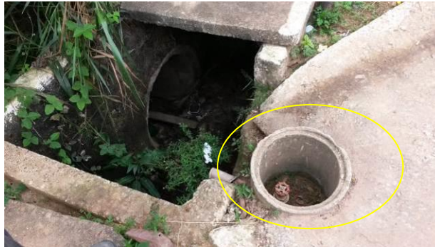
Figura 28: Ausência de tampa em caixa de descarga na rede de Vila Valério.
