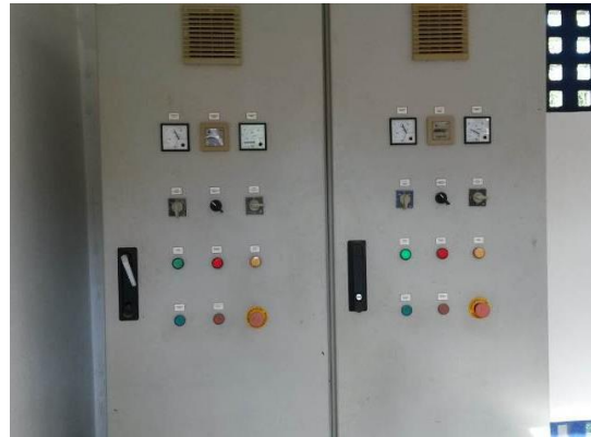
Figura 14: Quadro elétrico da Captação do Córrego Valério (C11.2).
