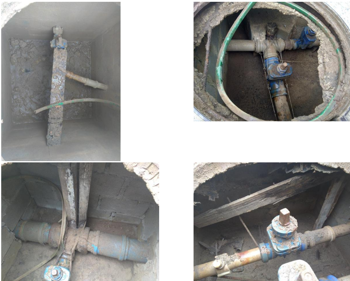
Figura 29: Tubulações de descarga de rede e registros de manobra com escoramentos inadequados
