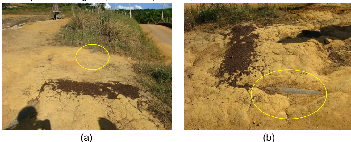
Figura 5: Pontos de exposição da adutora de água bruta da captação do Rio São José.
