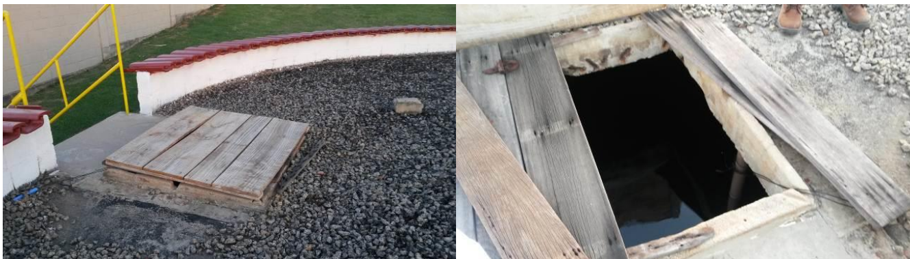
(a) (b) Figura 22: Tampa em desacordo com normas de segurança no Reservatório de 300m 3
