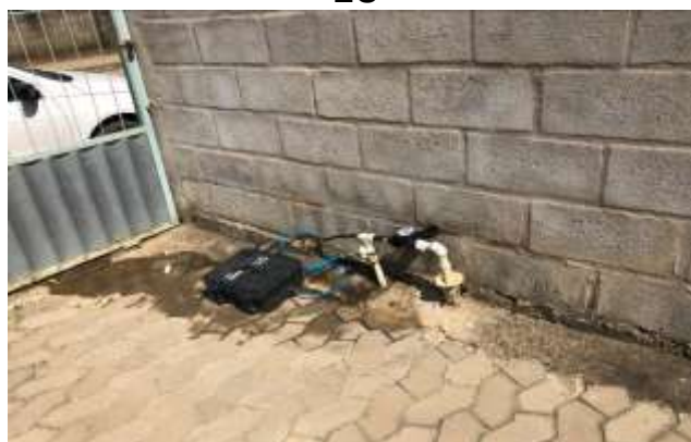
Figura 6 - Equipamento de medição instalado no Ponto 06 - Município de Viana, ES.
