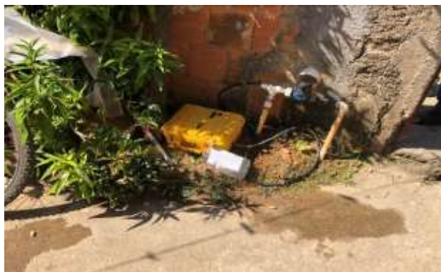
Figura 1 - Equipamento de medição instalado no Ponto 01 - Município da Viana, ES
