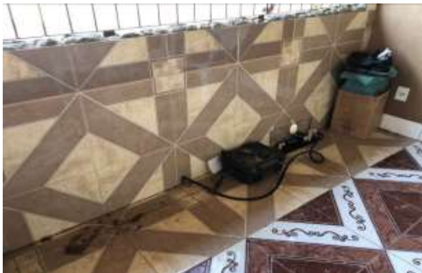
Figura 7 – Equipamento de medição instalado no Ponto 07 – Município de Viana, ES.
