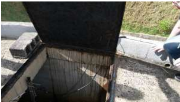
Figura 11 - Tampa enferrujada no Reservatório R3 (250m 3 ) .
