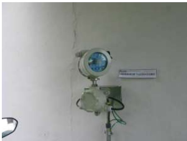
Figura 1 - Medidor de vazão de cloro .
