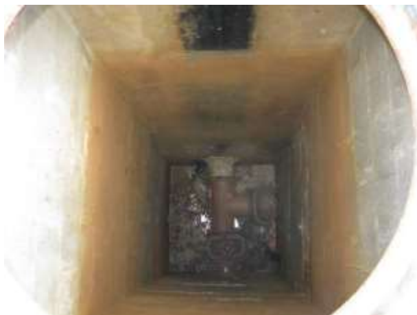
Figura 18 - Vazamento na caixa da válvula.
