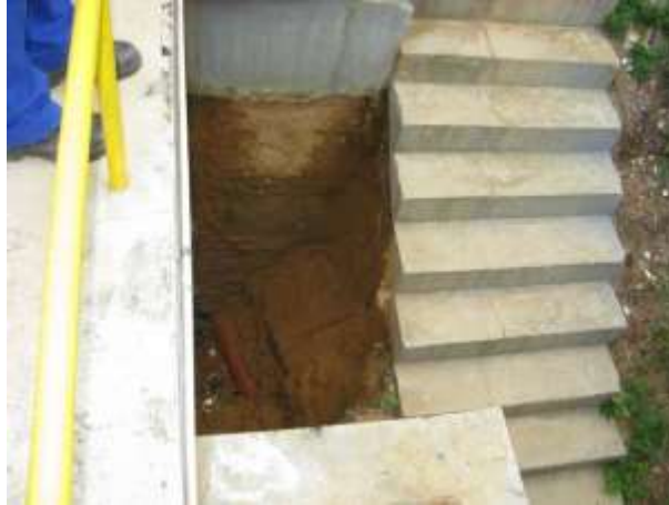
Figura 5 - Infiltração de água no Decantador.
