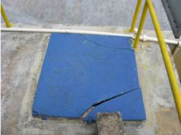
Figura 9 - Tampa do Tanque de Contato.
