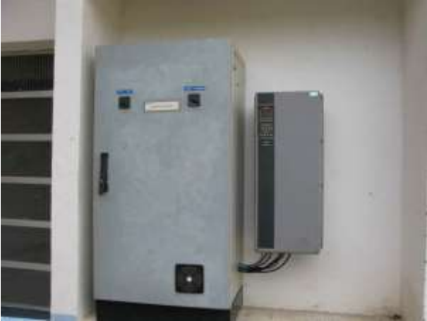
Figura 22 - EEAT do Reservatório R3 da ETA.
