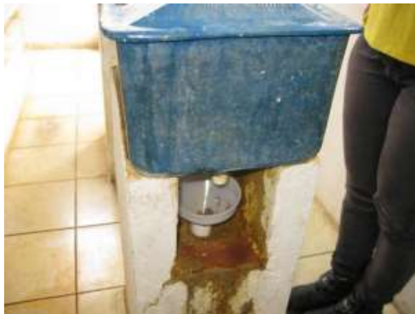
Figura 2 - Caixa dosadora de produto químico.
