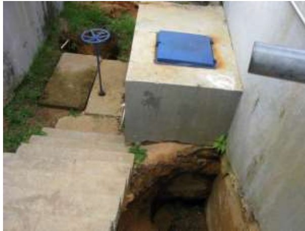
Figura 6 - Erosão na ETA Venda Nova do Imigrante.
