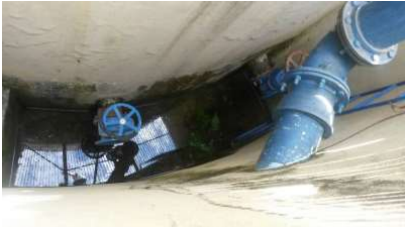
Figura 19 - Acúmulo de Água na caixa de descarga do reservatório R3 (250m 3 ) .
