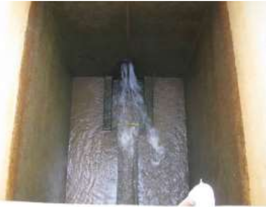
Figura 7 - Passagem de água na válvula borboleta de um dos filtros .
