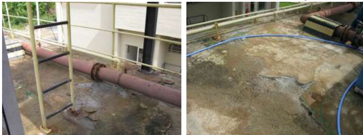
Figura 8 - Laje de concreto deteriorada no UASB+Biofiltro aerado da ETE Venda Nova do Imigrante.
