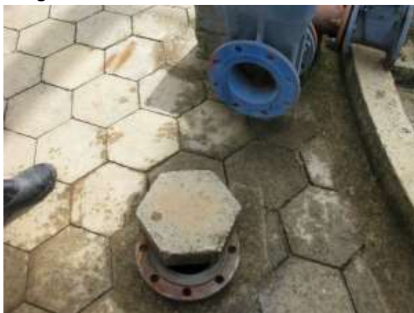
Figura 11 - Tubulação próxima à EEEB da ETE Venda Nova do Imigrante.
