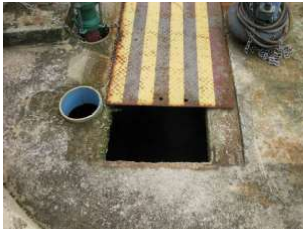
Figura 12 - EEBB de recirculação da ETE Venda Nova do Imigrante
