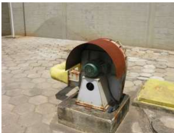
Figura 2 - Biofiltro da EEEB1
