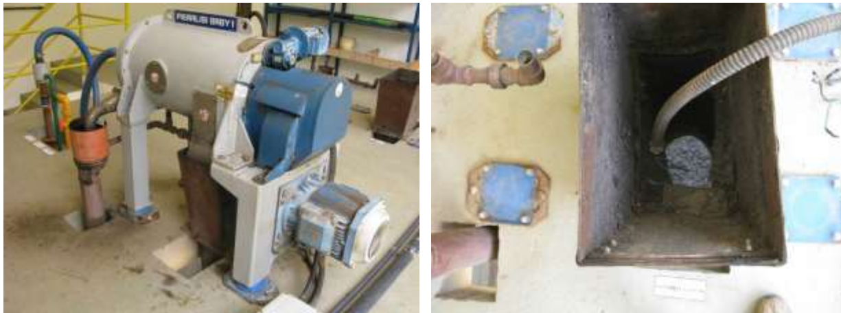
Figura 14 - Ausência da centrífuga de lodo reserva na ETE Venda Nova do Imigrante
