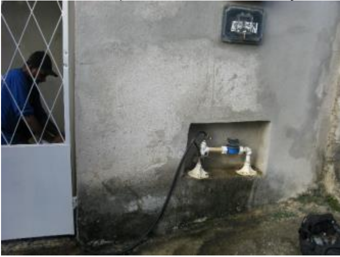
Figura 7 - Equipamento de medição instalado no Ponto 03 – Município de São José do Calçado, ES
