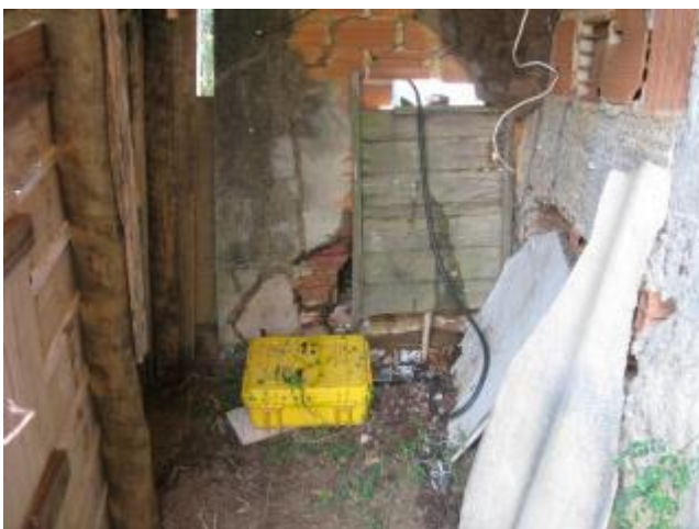
Figura 5 - Equipamento de medição instalado no Ponto 04 - Município de S. José do Calçado, ES
