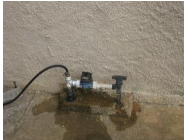
Figura 2 - Equipamento de medição instalado no Ponto 01 - Município de S. José do Calçado, ES
