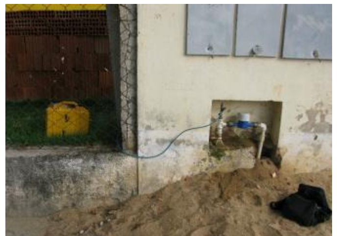
Figura 6 - Equipamento de medição instalado no Ponto 05 - Município de S. José do Calçado, ES
