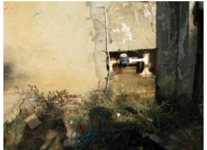
Figura 4 - Equipamento de medição instalado no Ponto 03 - Município de S. José do Calçado, ES
