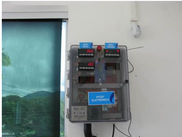
Figura 10 - ETA de São José do Calçado.
