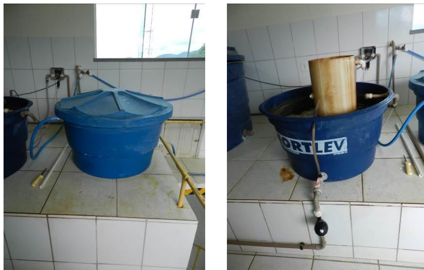
Figura 6 - Casa de química da ETA São José do Calçado.
