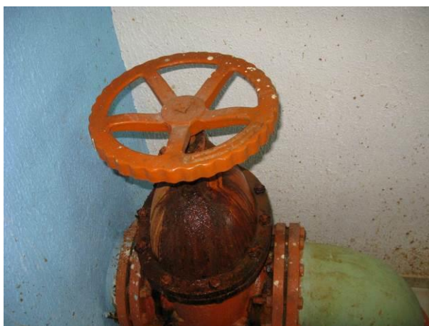
Figura 3 - Válvula de controle de limpeza do decantador 2 da ETA São José do Calçado..
