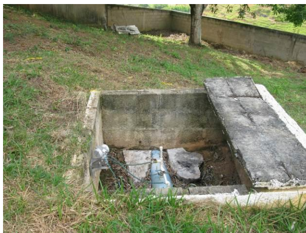
Figura 2 – ETA de São José do Calçado.
