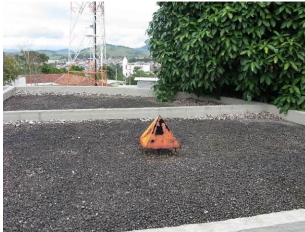
Figura 9 - Proteção da ventilação corroída no reservatório semi-enterrado (540 m 3 ).
