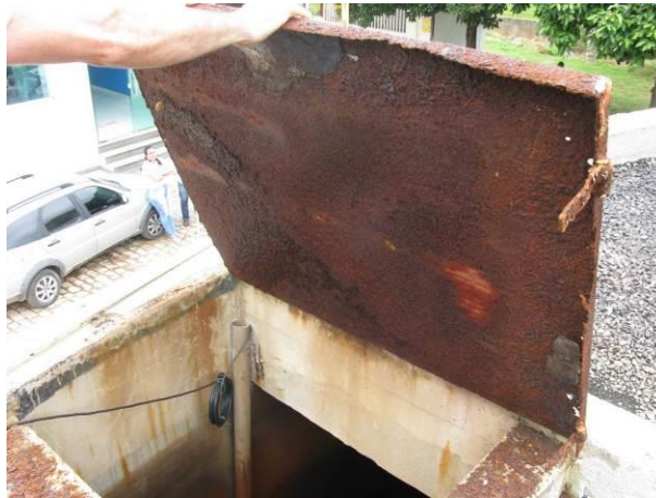
Figura 8 - Tampa do reservatório semi-enterrado (540 m 3 ) enferrujada.
