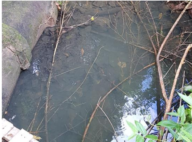
Figura 6 – Transbordamento de Efluente próximo ao PV da EEEB Europa.
