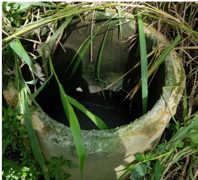
Figura 4 – PV da Rede de Esgoto ligada a EEEB Europa.
