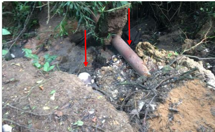
Figura 1 – Tubulação da rede de esgoto ligada a EEEB Europa.
