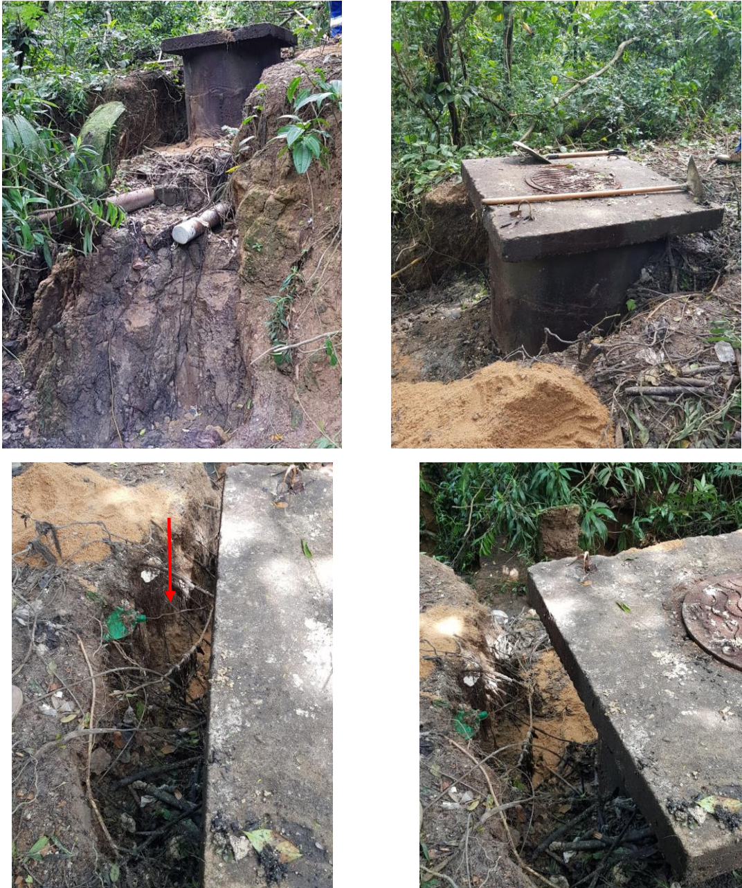
Figura 3 - PV da Rede de Esgoto ligada a EEEB Europa.
