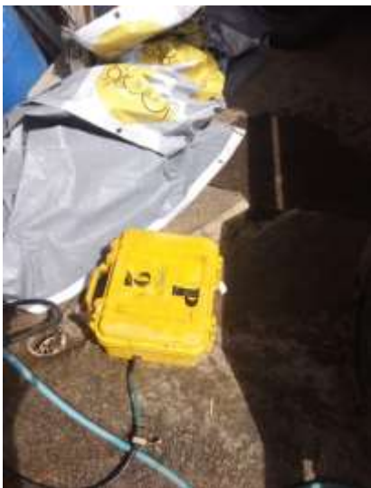
Figura 6 - Equipamento de medição instalado no Ponto 06 - Município da Serra, ES
