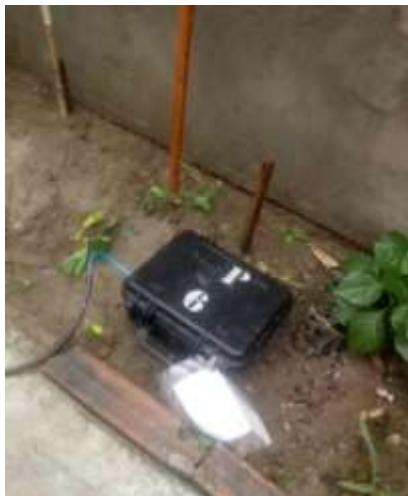
Figura 12 - Equipamento de medição instalado no Ponto 12 - Município da Serra, ES
