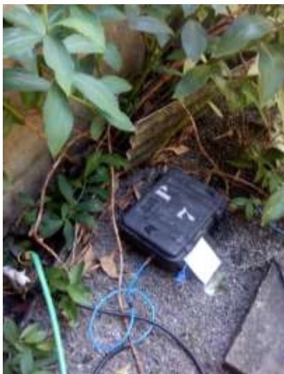
Figura 7 - Equipamento de medição instalado no Ponto 07 - Município da Serra, ES
