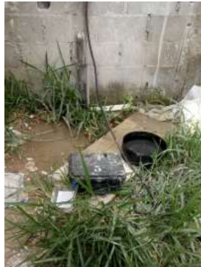
Figura 8 - Equipamento de medição instalado no Ponto 08 - Município da Serra, ES
