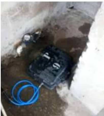
Figura 11 - Equipamento de medição instalado no Ponto 11 - Município da Serra, ES
