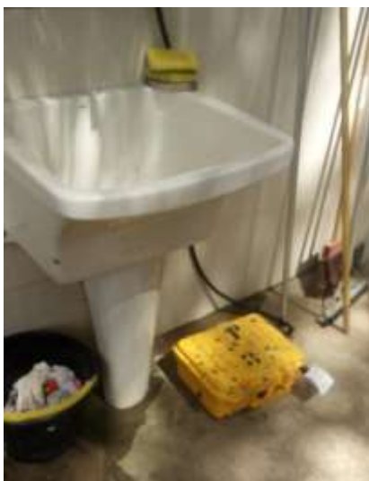
Figura 9 - Equipamento de medição instalado no Ponto 09 - Município da Serra, ES
