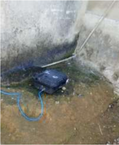
Figura 1 – Equipamento de medição instalado no Ponto 01- Município da Serra, ES
