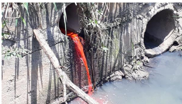
Figura 3 - Esgoto bruto originário do tratamento preliminar da ETE Nova Carapina, com traçador vermelho, sendo lançado na rede drenagem que se conecta ao Córrego Barro Branco.
