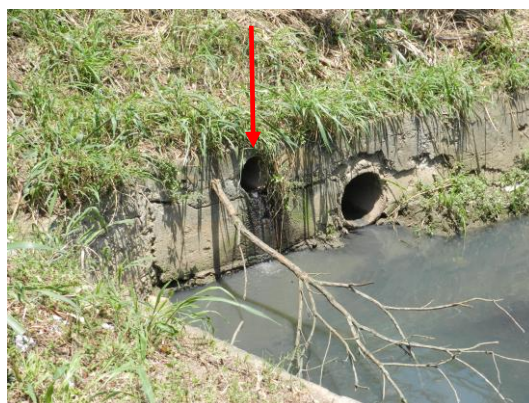
Figura 2 - Local de lançamento do extravazamento do esgoto bruto no Córrego Barro Branco.
