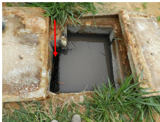
Figura 6 – Caixa de passagem afogada, com vazamento de efluente pela comporta. O traçador azul foi lançado neste local.
