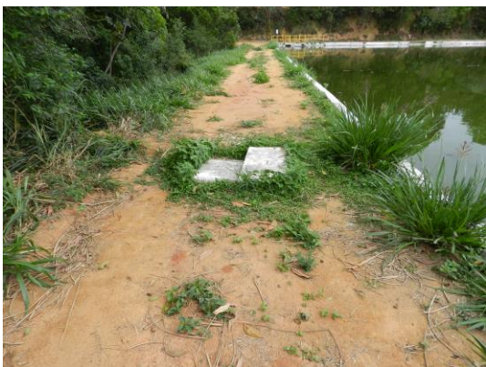
Figura 5 - Caixa de passagem localizada após a lagoa anaeróbia e antes da lagoa facultativa da ETE Jardins.
