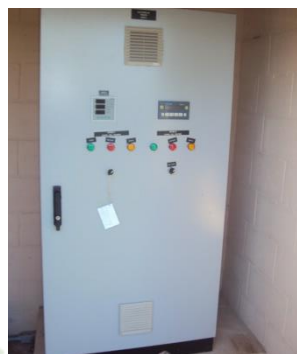
Figura 9 – - Painel da EEBB I sem sinalização de risco de choque elétrico.
