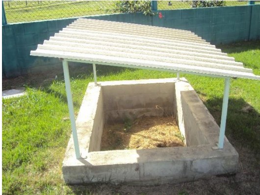
Figura 4 – Biofiltro da EEEB ETE.
