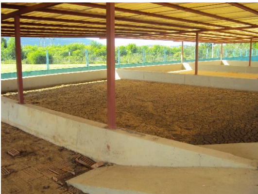
Figura 35 – Leito de Secagem da ETE Alphaville Jacuhy.
