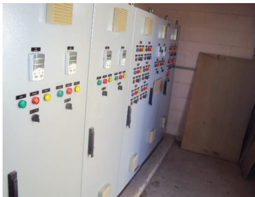
Figura 38 - Painel de controle da ETE Alphaville Jacuhy.
