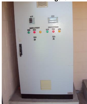
Figura 28 - Painel de controle da EEB F sem sinalização de risco de choque elétrico.
