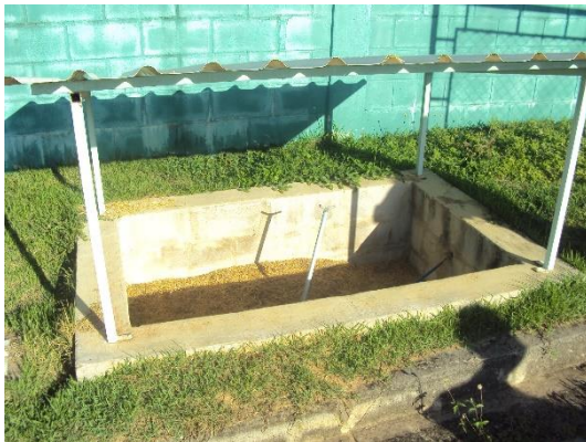
Figura 17 – Biofiltro da EEEB E.
