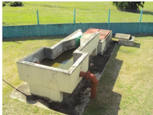
Figura 36 – Local de saída dos efluentes da ETE Alphaville Jacuhy.
