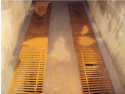
Figura 21 - Caixa de areia da EEB D.
