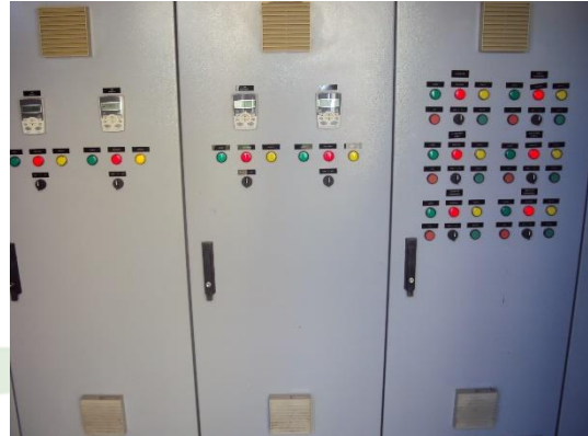
Figura 5 - Painel da EEEB ETE sem sinalização de risco de choque elétrico.
