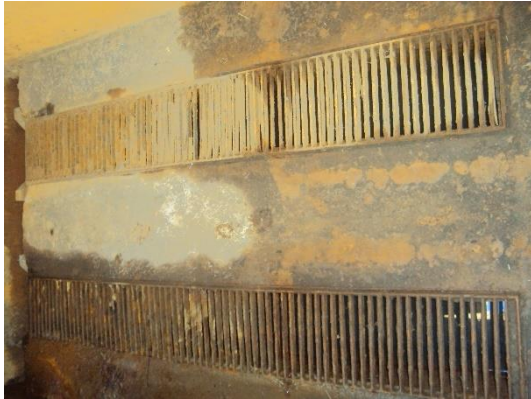
Figura 26 – Caixa de areia da EEB F.
