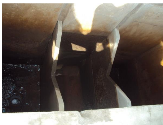
Figura 30 – Caixa de distribuição do reator UASB .
