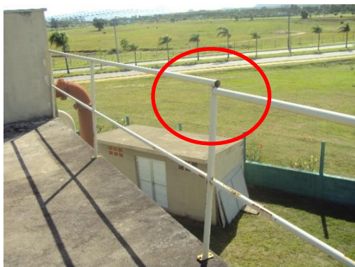
Figura 37 - Guarda-corpo do UASB demanda manutenção.
