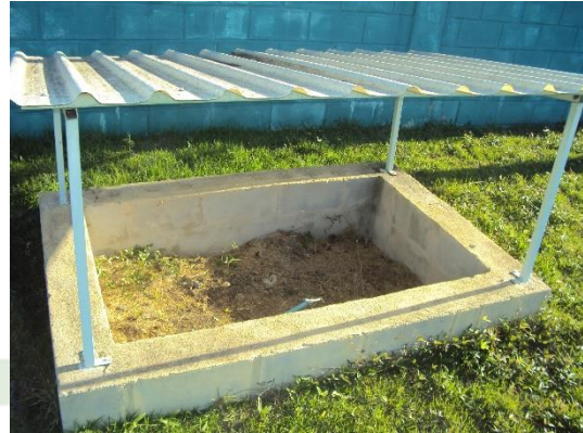
Figura 22 – Biofiltro da EEB D.
