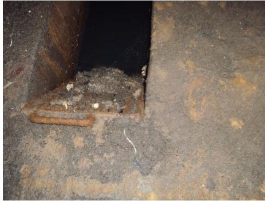
Figura 16 - Gradeamento com resíduos acumulados.
