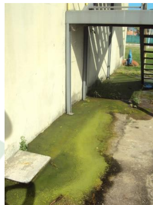
Figura 34 – Vazamento próximo à escada do reator.
