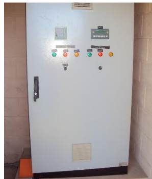
Figura 23 – Painel de controle da EEB D.
