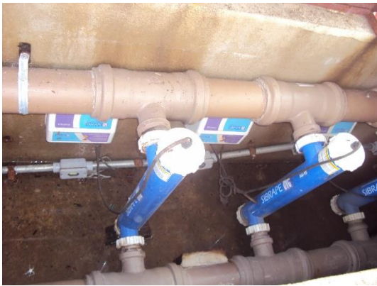
Figura 33 – Desinfecção por UV inoperante.
