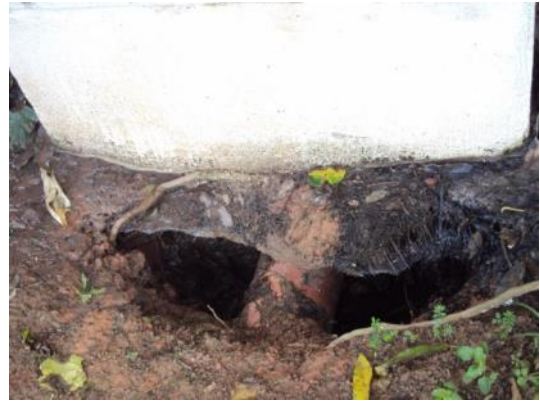
Figura 57 - Tubulação exposta próximo a entrada 1 da ETE Eldorado.
