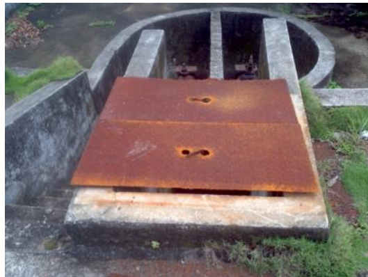
Figura 8 - Poço de sucção descoberto e tampa inadequada na EEB Nova Carapina I.
