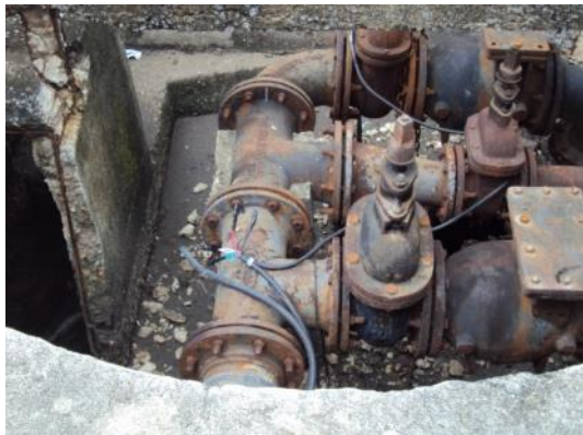
Figura 7 - Detalhe para fiação elétrica exposta na EEB Nova Carapina I.
