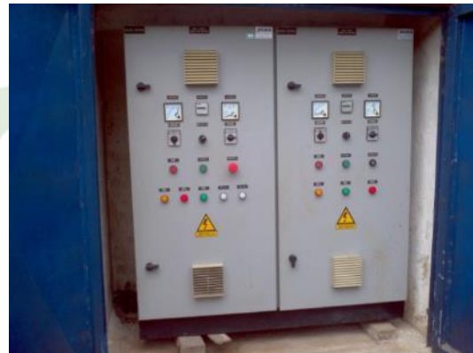
Figura 16 - Painel de controle da EEB Nova Carapina II em bom estado de conservação.
