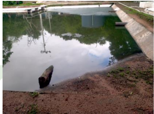
Figura 59 - Detalhe do assoreamento na lagoa anaeróbia da ETE Eldorado.
