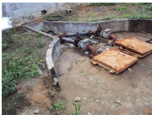
Figura 38 - Tampas do poço de sucção da EEEB Cidade Pomar.
