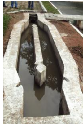
Figura 55 - Tratamento preliminar da entrada 3 de esgoto da ETE Eldorado.
