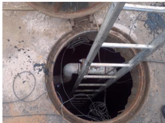
Figura 25 – Detalhe da fiação exposta na EEBB Matias Barbosa.
