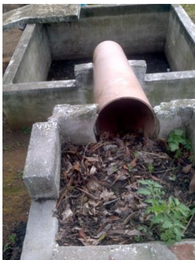
Figura 30 - Caixa de resíduos da ETE Nova Carapina com material acumulado.
