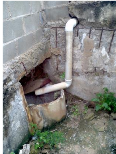
Figura 14 - Último PV antes do poço de sucção da EEB Nova Carapina II sem cobertura e com ligação irregular.
