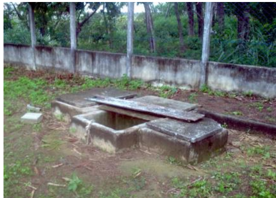
Figura 42 - Poço de sucção da EEB Novo Porto Canoa I.
