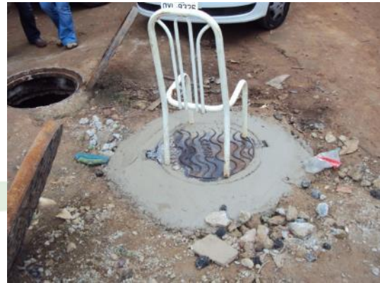
Figura 20 - Proteção improvisada da tampa do Poço de Visita da EEBB Águas Formosas.
