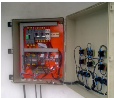
Figura 49 - Painel de controle da EEEB Novo Porto Canoa IV.
