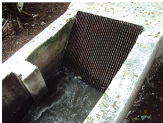
Figura 26 - Gradeamento da ETE Nova Carapina.
