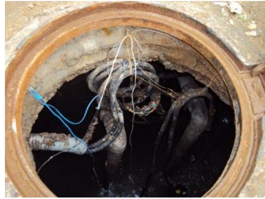
Figura 18 - Fiação exposta no Poço de Sucção da EEBB Águas Formosas.
