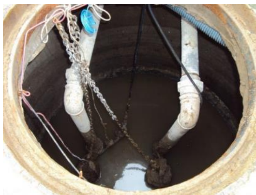
Figura 46 - Poço de sucção da EEEB Novo Porto Canoa III.
