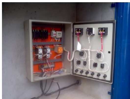
Figura 45 - Painel de controle da EEBB Novo Porto Canoa III.
