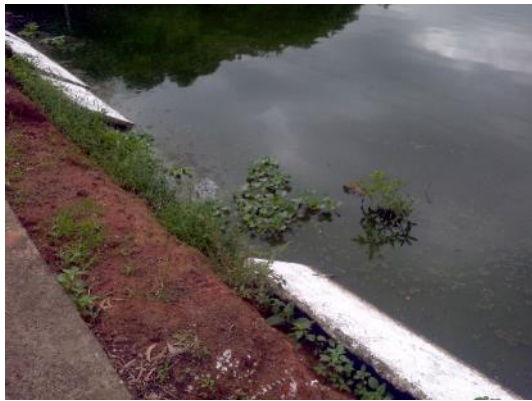
Figura 62 - Condição insatisfatória da proteção do talude interno da lagoa facultativa da ETE Eldorado.
