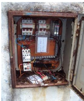
Figura 43 - Painel de controle da EEBB Novo Porto Canoa I.
