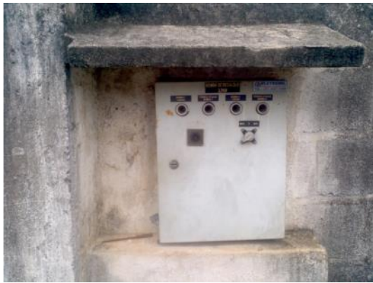
Figura 39 - Painel de controle da EEB Cidade Pomar.
