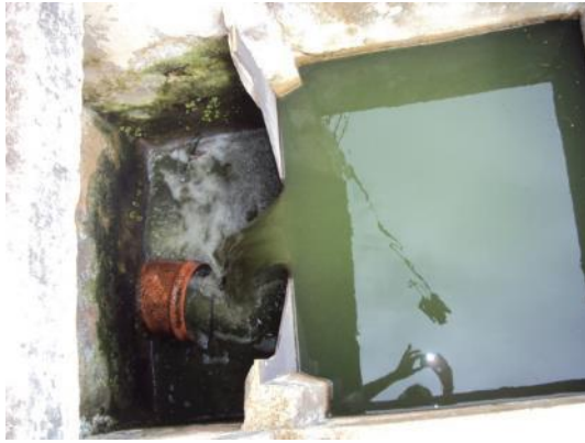
Figura 65 - Saída 1 de esgoto da lagoa facultativa da ETE Eldorado.
