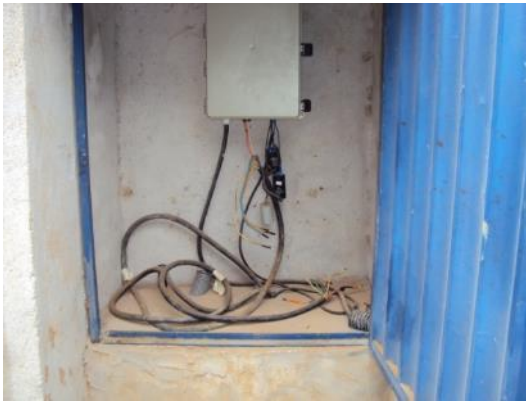
Figura 19 - Fiação exposta no Pannel de controle da EEBB Águas Formosas.
