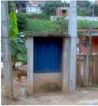
Figura 17 - EEBB Águas Formosas sem identificação.
