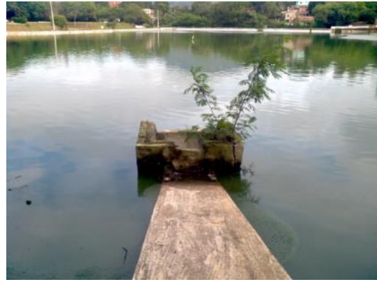
Figura 66 - Saída 2 de esgoto da lagoa facultativa da ETE Eldorado.
