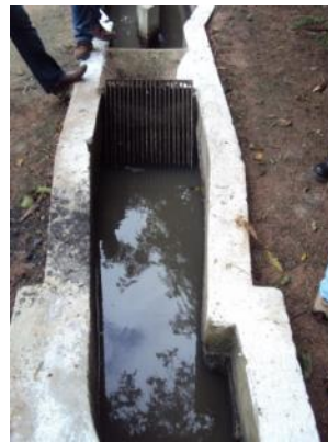
Figura 53 - Tratamento preliminar da entrada 1 de esgoto da ETE Eldorado.
