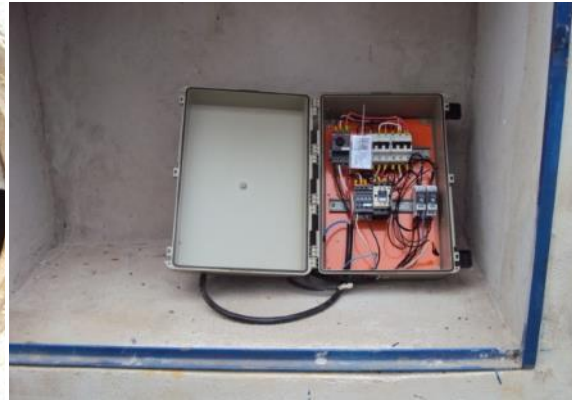
Figura 22 - Painel de controle com fixação inadequada na EEEB Andrelândia.
