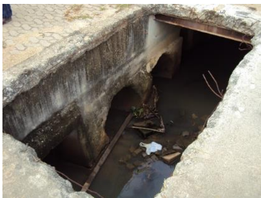
Figura 71 - Detalhamento da abertura no sistema de drenagem na área comum das ETES Eldorado e Nova Carapina.
