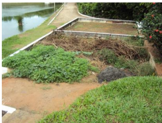
Figura 64 - Leito de secagem com ausência de desaguamento de lodo da ETE Eldorado.
