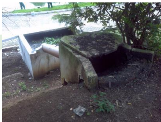
Figura 31 - Outra caixa de resíduos da ETE Nova Carapina.
