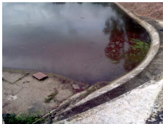
Figura 29 - Sobrenadante na lagoa facultativa da ETE Nova Carapina.
