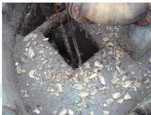
Figura 6 - Resíduos acumulados no poço da EEB Nova Carapina I.
