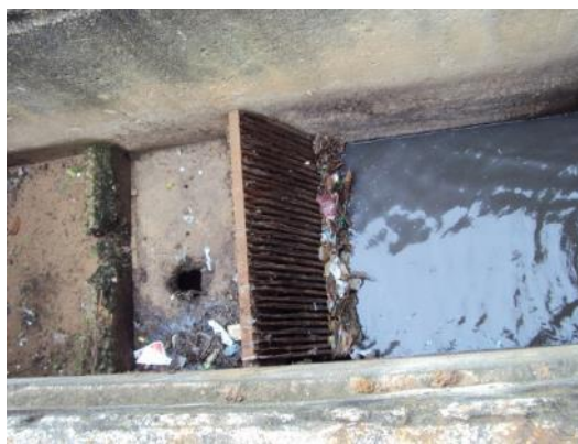
Figura 12 – Gradeamento com resíduo acumulado na EEEB Nova Carapina II.
