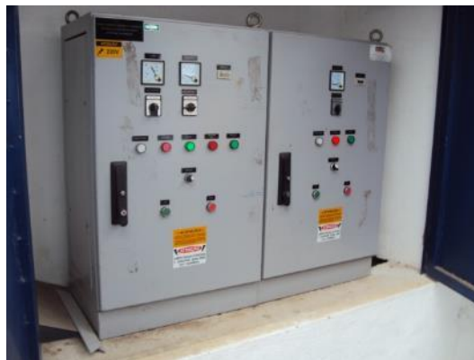
Figura 10 - Painel de controle da EEEB Nova Carapina I em bom estado de conservação.
