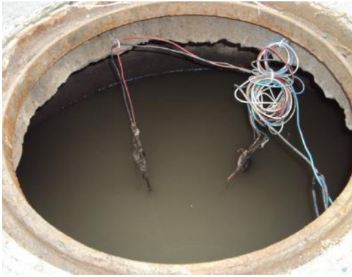
Figura 21 - Poço de sucção cheio, bomba inoperante e fiação exposta na EEEB Andrelândia.
