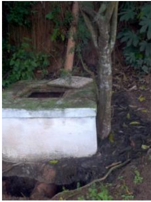
Figura 56 - Caixa de inspeção próximo à entrada 1 de esgoto da ETE Eldorado com vazamento de esgoto bruto no solo.
