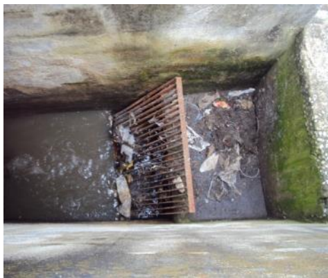
Figura 9 - Gradeamento com resíduo acumulado na EEEB Nova Carapina I.
