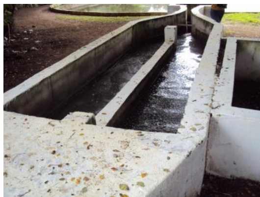
Figura 27 - Caixa de Areia da ETE Nova Carapina.
