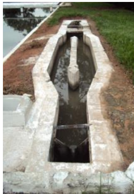
Figura 54 - Tratamento preliminar da entrada 2 de esgoto da ETE Eldorado.
