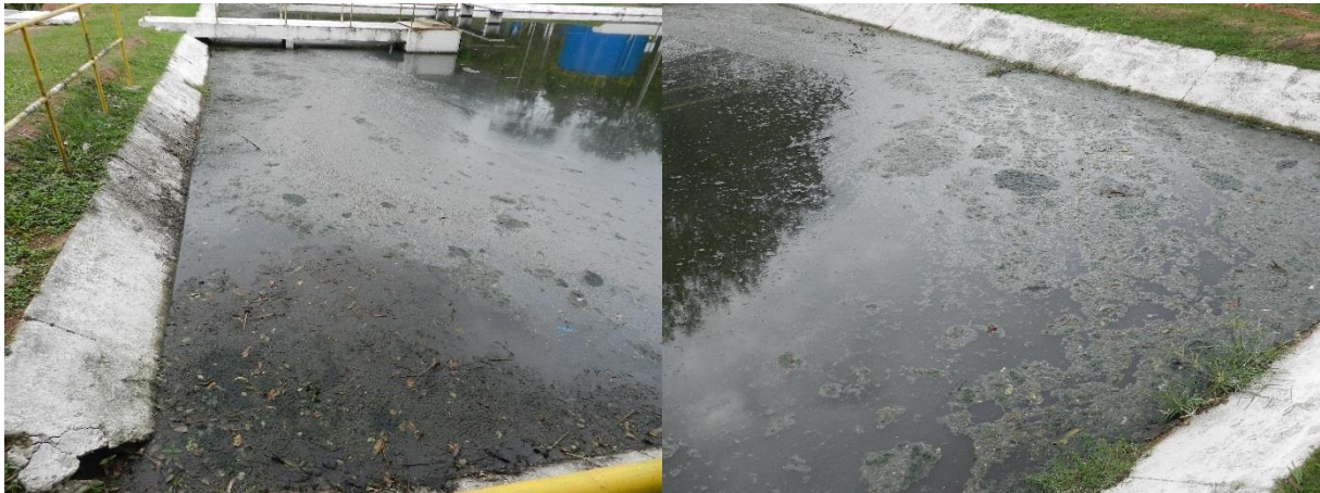
Figura 1 - Presença de lodo na lagoa anaeróbia da ETE Eldorado.
