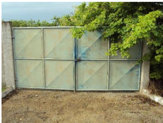
Figura 9 - Entrada sem identificação da EEBB Arquipélago de Manguinhos 2.
