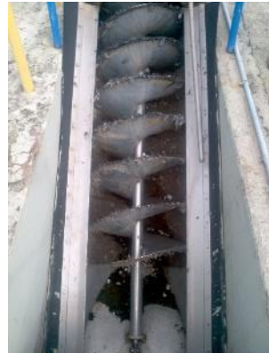
Figura 73 - Rosca do tratamento preliminar inoperante da ETE Manguinhos.
