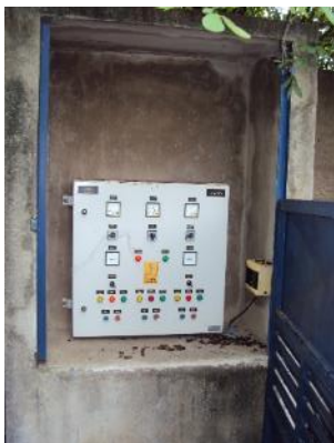
Figura 11 - Painel de controle da EEBB Arquipélago de Manguinhos 2 com sinalização de risco de choque elétrico.
