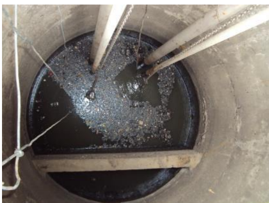
Figura 40 - Poço de sucção com resíduos grosseiros acumulados da EEEB M-2.
