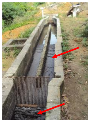
Figura 65 - Gradeamento e caixa de areia que demandam limpeza da EEBB Cidade Continental.
