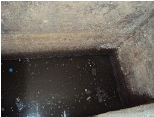
Figura 34 - Presença de resíduos sólidos grosseiros na caixa de areia da EEEB M-1.
