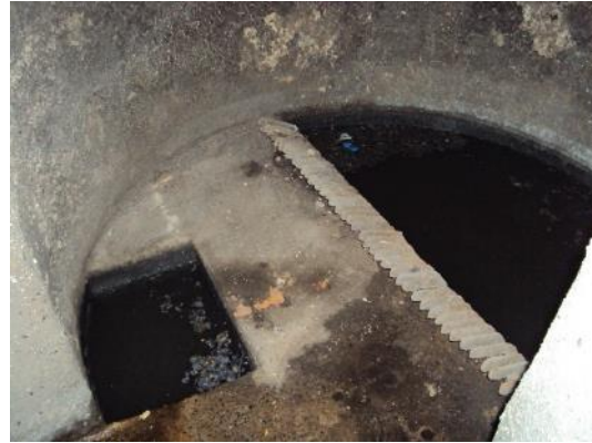
Figura 47 - Gradeamento para remoção de sólidos grosseiros da EEEB M-4.
