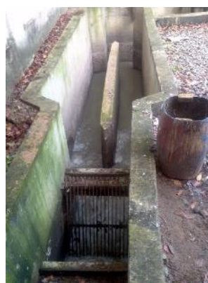
Figura 61 - Mecanismo de remoção de sólidos grosseiros da EEBB Europa.
