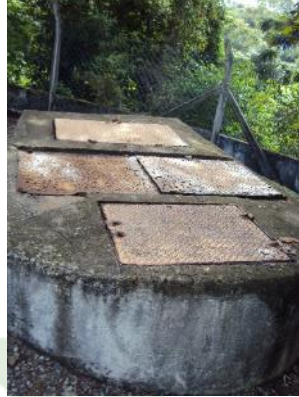
Figura 53 - Tampas do poço de sucção da EEEB Oceania demandam manutenção.
