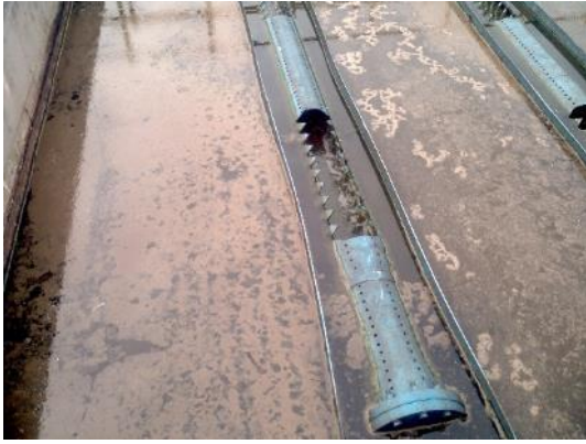
Figura 76 – Decantador da ETE Manguinhos.
