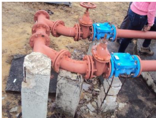
Figura 36 - Blocos de ancoragem das redes de recalque da EEEB M-1 com estrutura danificada.
