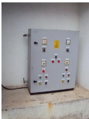
Figura 42 - Painel de controle da EEEB M-2 com sinalização de risco de choque elétrico.
