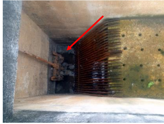
Figura 29 - Gradeamento para remoção de sólidos grosseiros da EEBB M-5.
