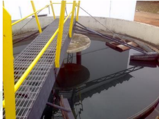
Figura 79 – Decantador da ETE Manguinhos.
