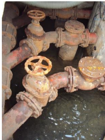
Figura 50 - Caixa de inspeção de válvulas com acúmulo de água de chuva na EEEB M-4.
