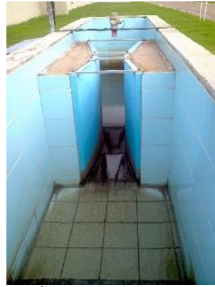
Figura 71 - Efluente Final da ETE Manguinhos.
