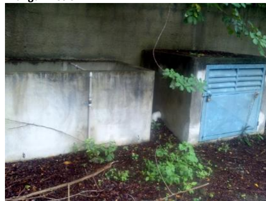
Figura 19 – Biofiltro da EEBB Arquipélago de Manguinhos 3.
