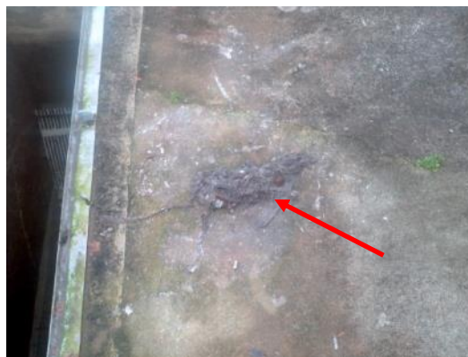
Figura 23 - Resíduos do gradeamento dispostos em local irregular na EEBB Rossi Vilas do Mar.
