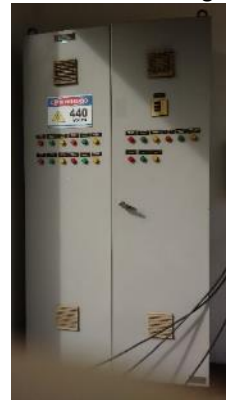
Figura 81 - Painel de Controle da ETE Manguinhos.
