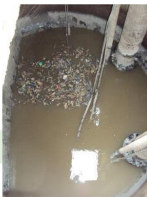
Figura 26 - Resíduos grosseiros presentes no poço de sucção da EEBB Rossi Vilas Do Mar.
