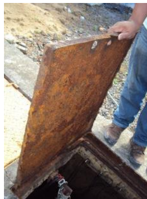
Figura 57 - Tampas do poço de sucção da EEBB Ásia enferrujadas.
