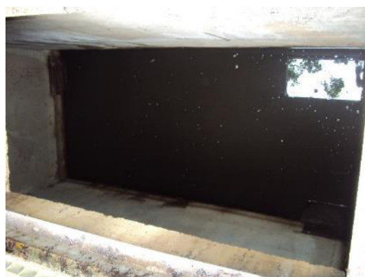
Figura 6 - Tratamento preliminar afogado da EEB Arquipélago de Manguinhos 1.
