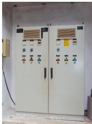
Figura 63 - Painel de controle da EEBB Europa.
