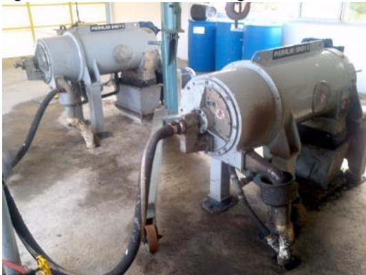
Figura 80 - Centrifuga da ETE Manguinhos.
