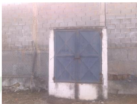
Figura 59 - Painel sem sinalização da EEBB Ásia.
