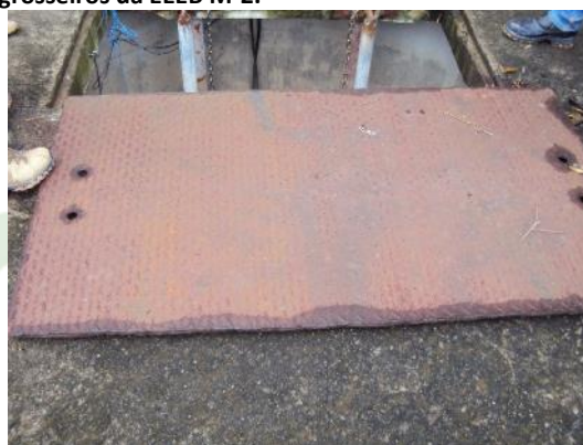
Figura 41 - Poço de sucção da EEEB M-2 sem a tampa, a qual demanda manutenção.
