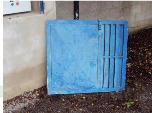
Figura 17 - Tampa do painel de controle que demanda manutenção da EEBB Arquipélago de Manguinhos 3.
