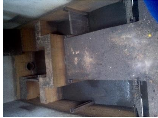
Figura 15 - Mecanismo de remoção de sólidos grosseiros da EEBB Arquipélago de Manguinhos 3.
