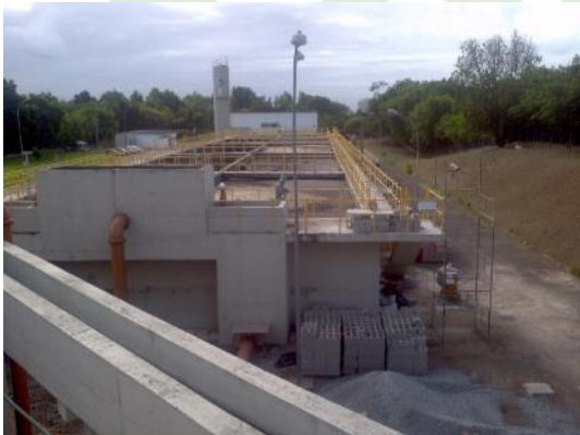
Figura 68 – Vista da ETE Manguinhos.
