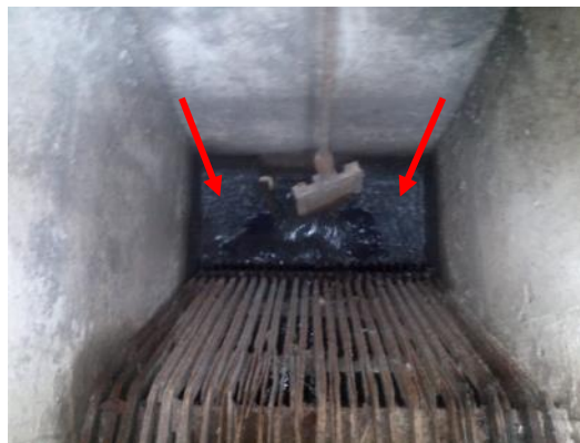
Figura 39 - Gradeamento para remoção de sólidos grosseiros da EEEB M-2.
