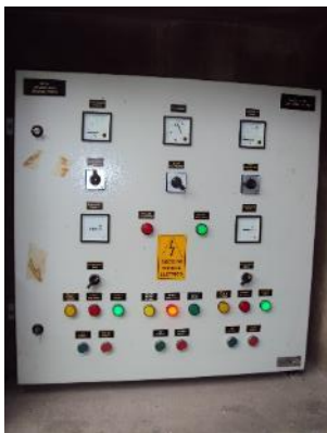
Figura 7 - Painel de Controle da EEBB Arquipélago de Manguinhos 1.
