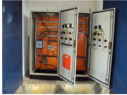
Figura 52 - Painel de controle da EEEB Oceania.
