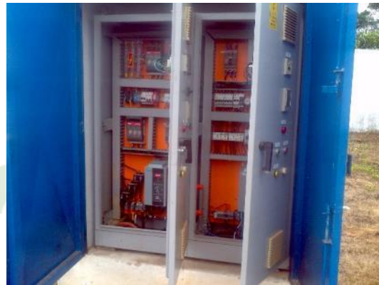
Figura 35 - Painel de controle da EEEB M-1.
