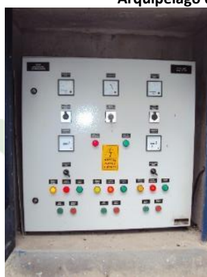
Figura 45 - Painel de Controle da EEBB Arquipélago de Manguinhos 6 com sinalização de risco de choque elétrico.
