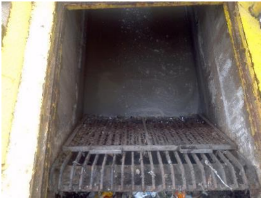
Figura 70 - Gradeamento ETE Manguinhos.
