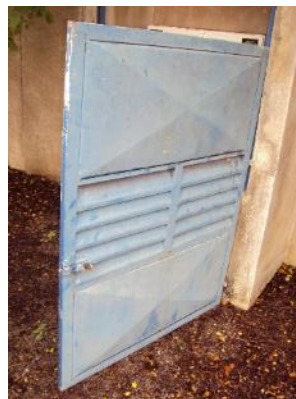
Figura 12 - Tampa do painel de controle que demanda manutenção da EEBB Arquipélago de Manguinhos 2.
