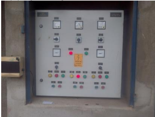
Figura 16 - Painel de Controle da EEBB Arquipélago de Manguinhos 3 com sinalização de risco de choque elétrico.
