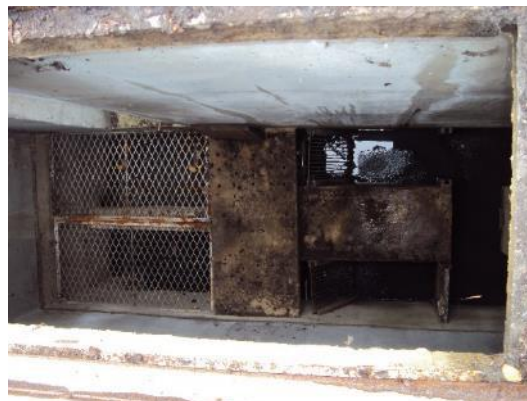
Figura 10 - Mecanismo de remoção de sólidos grosseiros da EEBB Arquipélago de Manguinhos 2.
