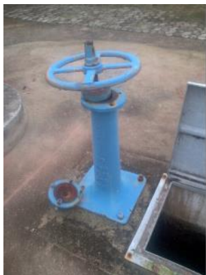
Figura 24 - Válvula do fechamento da comporta da caixa de areia da EEBB Rossi Vilas do Mar demandando manutenção.
