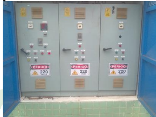
Figura 49 - Painel de controle da EEEB M-4 com sinalização de risco de choque elétrico.
