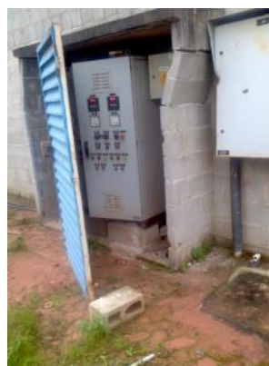
Figura 27 - Painel de controle em boas condições instalado em estrutura danificada e com tampa que demanda manutenção na EEBB Rossi Vilas do Mar.
