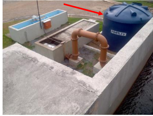
Figura 77 - Tanque para acumulação do efluente tratado da ETE Manguinhos.
