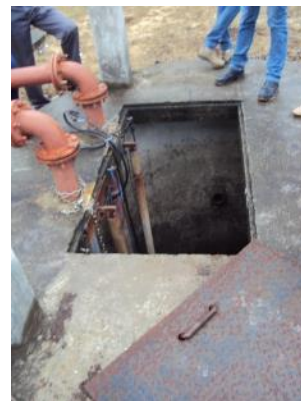
Figura 37 - Poço de sucção da EEEB M-1 sem tampa.
