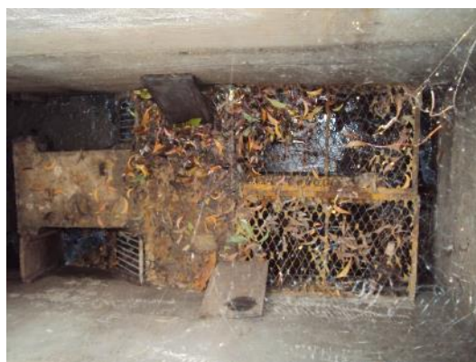
Figura 44 - Mecanismo de remoção de sólidos grosseiros com acúmulo de folhas da EEBB Arquipélago de Manguinhos 6.
