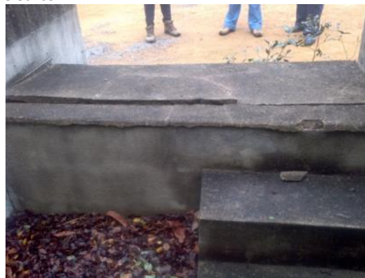
Figura 18 - Tampa da caixa de passagem entre o tratamento preliminar e o poço de sucção quebrada da EEBB Arquipélago de Manguinhos 3.
