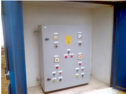
Figura 30 - Painel de controle da EEBB M-5 com sinalização de risco de choque elétrico.
