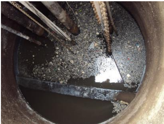
Figura 48 - Poço da EEEB M-4 com resíduos grosseiros.
