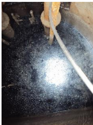
Figura 62 - Poço de sucção desativado na área da EEBB Europa com esgoto acumulado.
