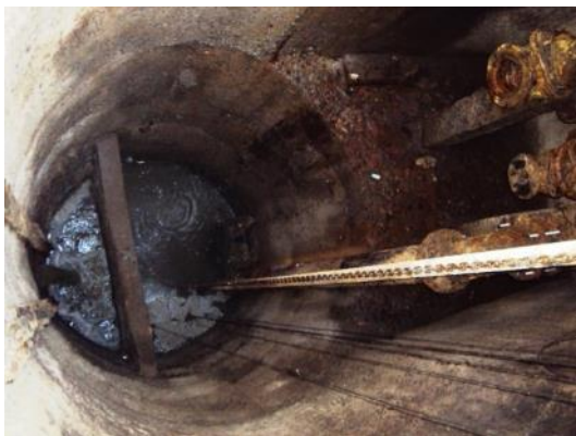
Figura 56 - Poço de sucção da EEBB Ásia com grande quantidade de resíduos sólidos grosseiros.
