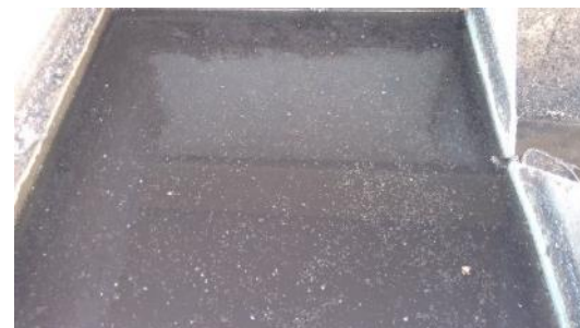
Figura 82 - Vermes no tanque de retirada do lodo.
