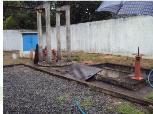
Figura 31 - Poço de sucção da EEBB M-5 sem tampa.
