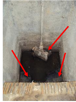
Figura 33 - Gradeamento da EEEB-M-1 para remoção de sólidos grosseiros. Detalhe para acúmulo de gordura e comporta de fechamento demandando manutenção.
