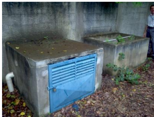
Figura 8- Biofiltro da EEBB Arquipélago de Manguinhos 1.
