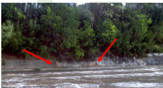
Figura 32 - Talude próximo à lagoa aerada da ETE Valpaíso com cobertura danificada e com presença de árvores de grande porte.
