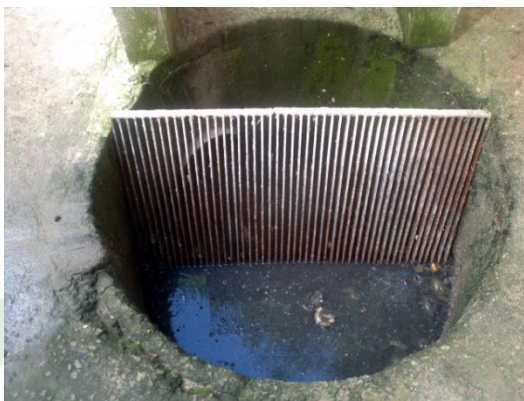
Figura 27 - Unidades de gradeamento inoperantes da ETE Valparaíso com acúmulo de esgoto.
