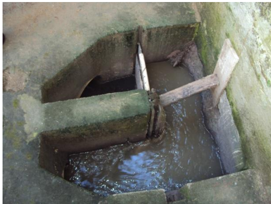
Figura 24 – Chegada de efluente na ETE Valparaíso com estrutura de madeira improvisada.
