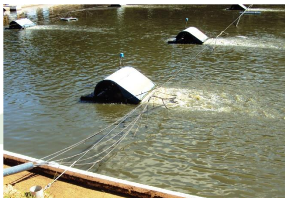
Figura 10 - Detalhe para fiação elétrica dos aeradores submergida na lagoa da ETE Laranjeiras.
