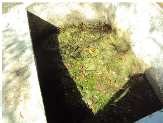
Figura 14 - Caixa de resíduos da lagoa facultativa da ETE Laranjeiras.
