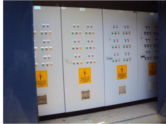
Figura 16 – Painel elétrico dos aeradores da ETE Laranjeiras.
