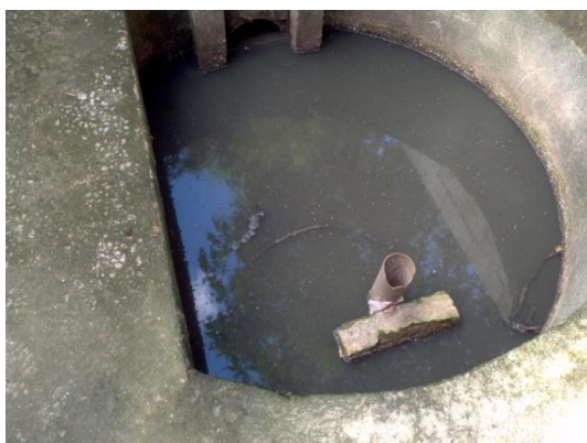
Figura 28 - Unidades de caixa de areia inoperantes da ETE Valparaíso com acúmulo de esgoto.
