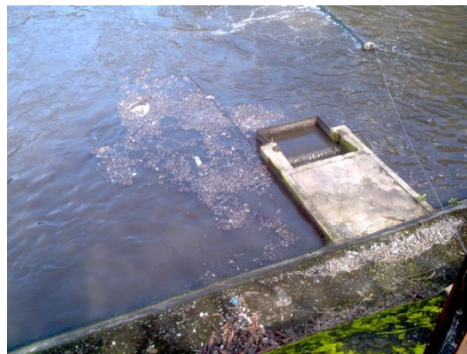
Figura 31 - Presença de material sólido grosseiro próximo à caixa de saída da lagoa aerada da ETE Valparaíso.
