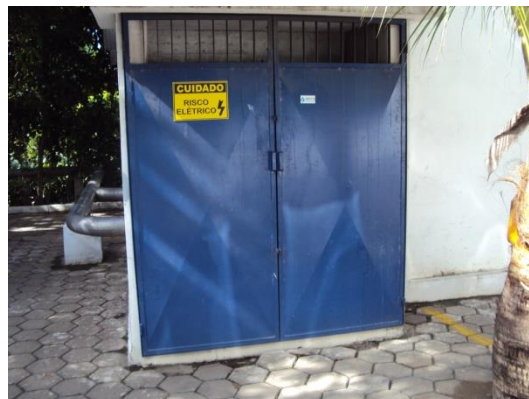
Figura 43 – Painel elétrico dos aeradores da ETE Valparaíso.
