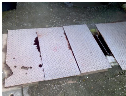
Figura 29 - Cobertura da caixa de passagem entre o tratamento preliminar e a lagoa aerada.
