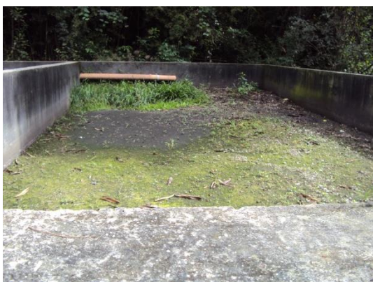
Figura 40 - Segundo leito de secagem da ETE Valparaíso.
