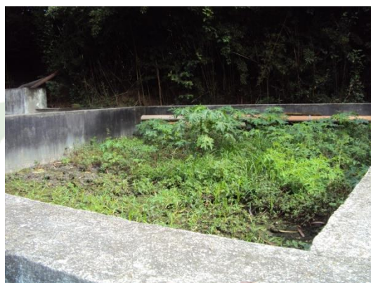
Figura 41 - Terceiro leito de secagem da ETE Valparaíso. Detalhe para o crescimento de mato, demandando manutenção.
