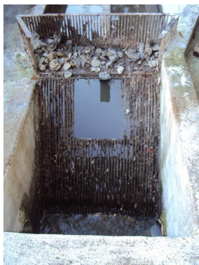
Figura 7 - Gradeamento ETE Laranjeiras. Detalhe para as grades quebradas.
