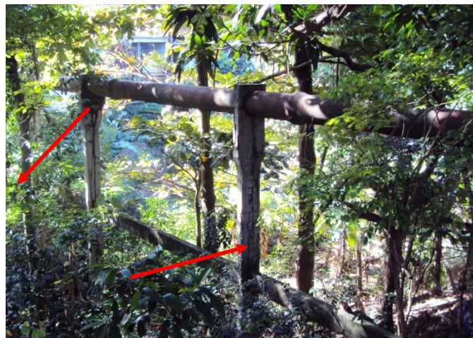
Figura 6 - Estrutura de suporte de uma das chegadas de esgoto bruto à ETE Laranjeiras. Detalhe para cupinzeiro e ferro estrutural exposto.
