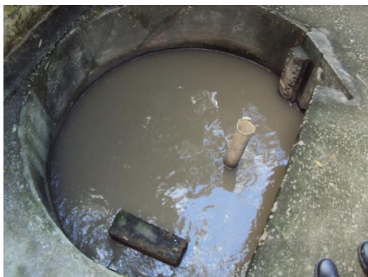
Figura 26 - Caixa de areia em operação na ETE Valparaíso.
