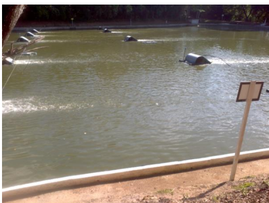
Figura 9 - Lagoa aerada da ETE Laranjeiras.
