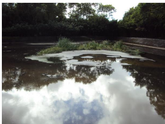
Figura 34 - Lagoa de decantação da ETE Valparaíso com acúmulo de lodo e crescimento de vegetação em seu interior.
