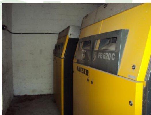
Figura 33 - Compressores de ar da lagoa aerada da ETE Valparaíso instalados em local fechado.
