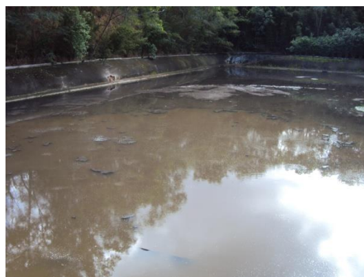
Figura 35 - Lagoa de decantação da ETE Valparaíso com acúmulo de lodo.
