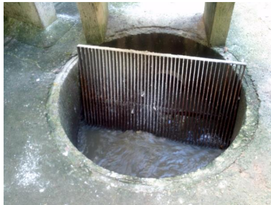
Figura 25 – Gradeamento em operação na ETE Valparaíso.
