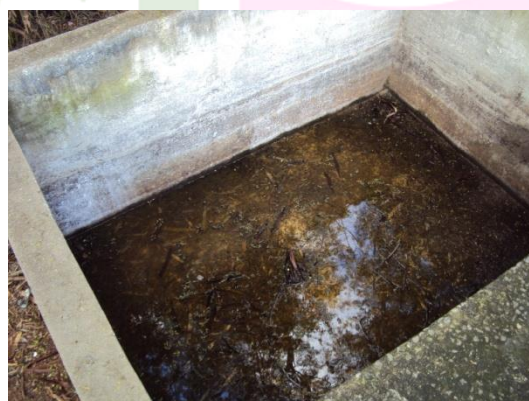
Figura 37 - Caixa de resíduos da lagoa de decantação da ETE Valparaíso com acúmulo de água.
