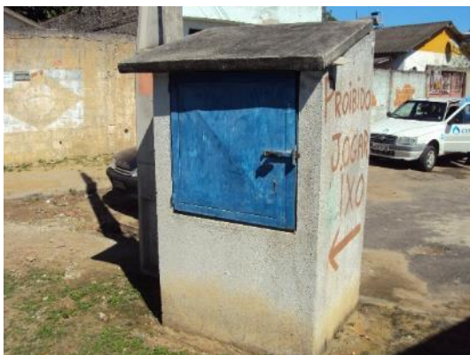
Figura 58 - EEEB Magnólia sem identificação e sem sinalização de risco de choque elétrico.
