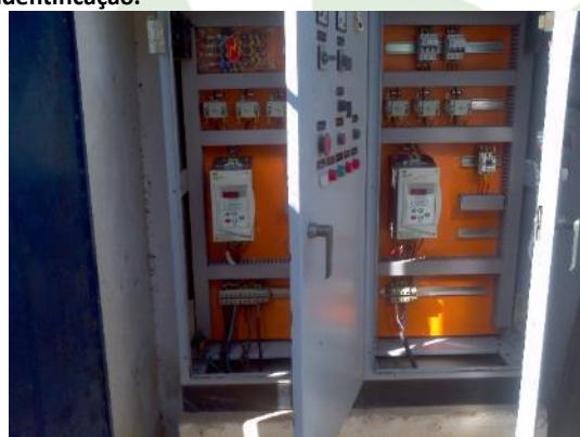
Figura 14 - Painel de controle da EEBB Jardim Bela Vista.
