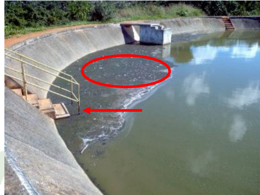
Figura 31 - Resíduos grosseiros na lagoa anaeróbia da ETE Jardins e guarda corpo da escada enferrujado na base.
