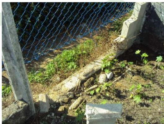
Figura 9 - Abertura no cercamento da EEB São Domingos.
