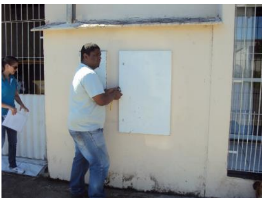
Figura 49 - EEEB Coral Esquerda sem identificação e sem sinalização de risco de choque elétrico.
