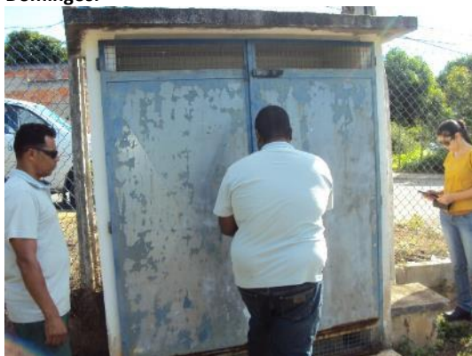
Figura 10 - Painel de controle da EEB São Domingos sem sinalização de risco de choque elétrico.
