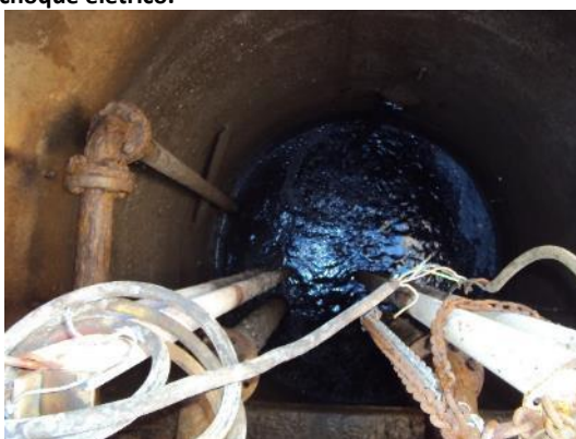
Figura 54 - Poço de sucção da EEEB Rio de Janeiro com fiação exposta e sem trancamento.
