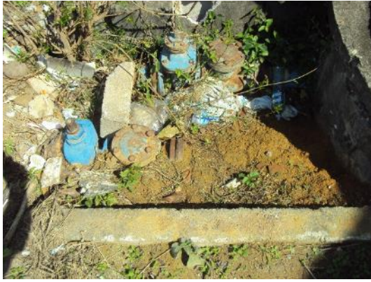
Figura 60 - Válvula da EEEB Magnólia exposta.
