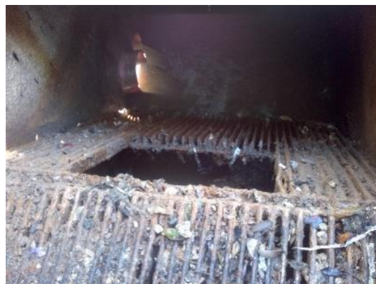
Figura 82 – Gradeamento do primeiro tratamento preliminar da ETE Serra Dourada.
