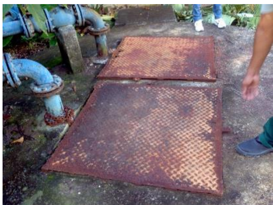
Figura 16 - Tampas do poço de sucção da EEBB Jardim Bela Vista.
