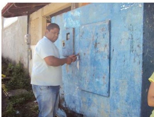
Figura 46 - EEEB Coral Direita sem identificação e sem sinalização de risco de choque elétrico.
