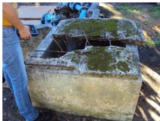
Figura 21 - Estrutura de proteção da tubulação com rachadura na EEEB Jardim Primavera.
