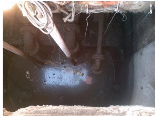
Figura 63 - Poço de sucção da EEEB Goiânia.
