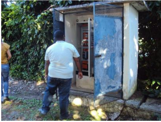
Figura 22- Painel de controle sem sinalização de risco de choque elétrico na EEB Jardim Primavera.
