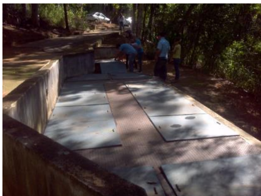
Figura 81 – Local do primeiro tratamento preliminar da ETE Serra Dourada.
