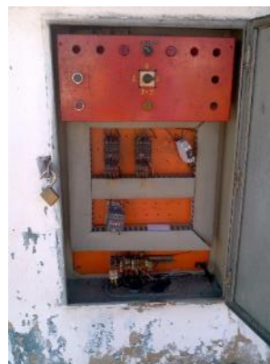
Figura 53 - Painel de controle da EEEB Rio de Janeiro.
