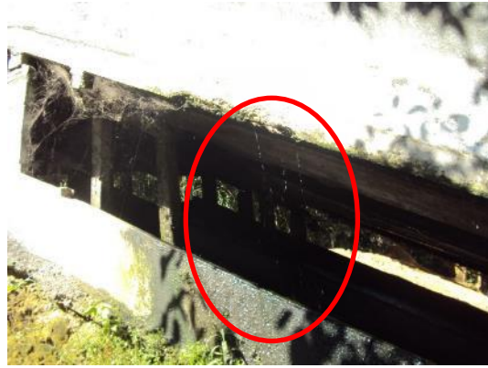
Figura 88 - Vazamento na cascata de aeração da ETE Serra Dourada.
