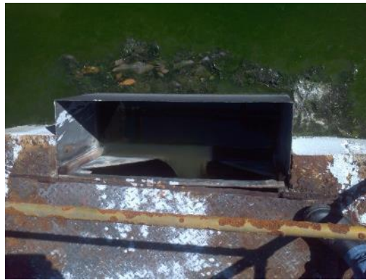
Figura 91 - Vertedouro triangular da saída da lagoa facultativa da ETE Serra Dourada.
