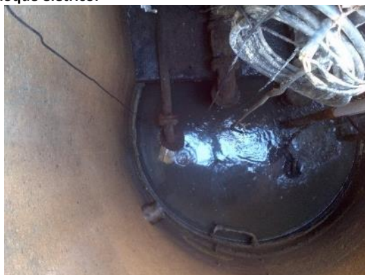
Figura 51 - Poço de sucção da EEEB Coral Esquerda com fiação exposta.
