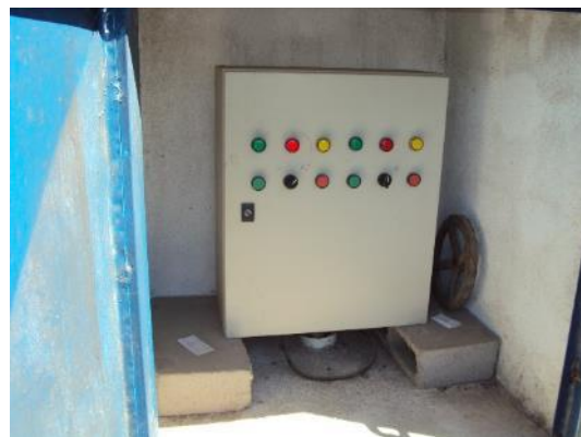
Figura 59 - Painel da EEEB Magnólia.
