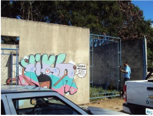
Figura 68 - Entrada da EEB Porto Canoa II sem identificação.
