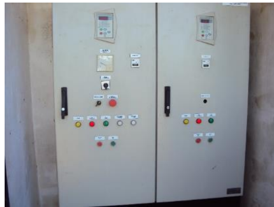
Figura 25 - Painel de controle da EEB Jardim Guanabara.
