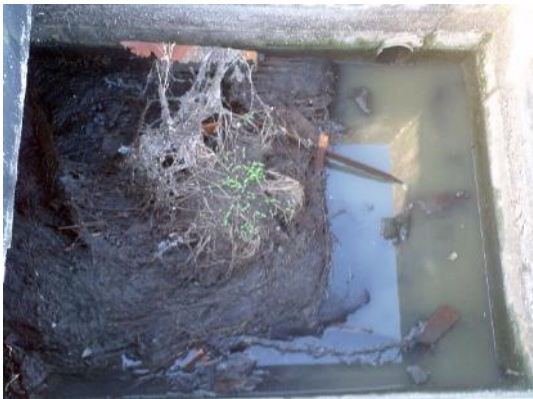
Figura 26 - Gradeamento da EEBB Jardim Guanabara danificado e com resíduos.
