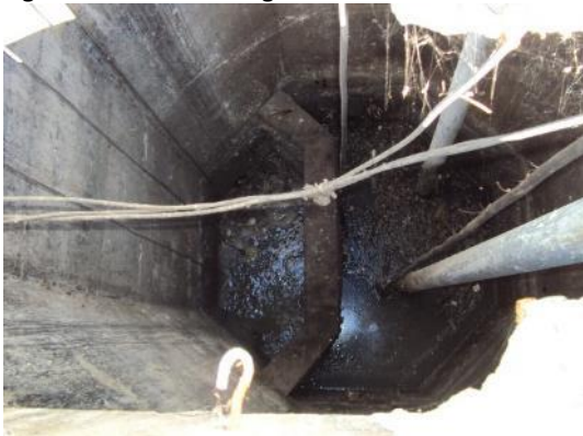
Figura 72 - Poço de sucção da EEB Porto Canoa II com resíduos grosseiros.
