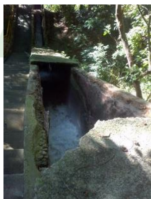
Figura 83 - Escada de aeração com tampas e paredes quebradas da ETE Serra Dourada.
