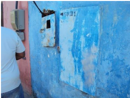
Figura 62 - EEEB Goiânia sem identificação e sem sinalização de risco de choque elétrico.
