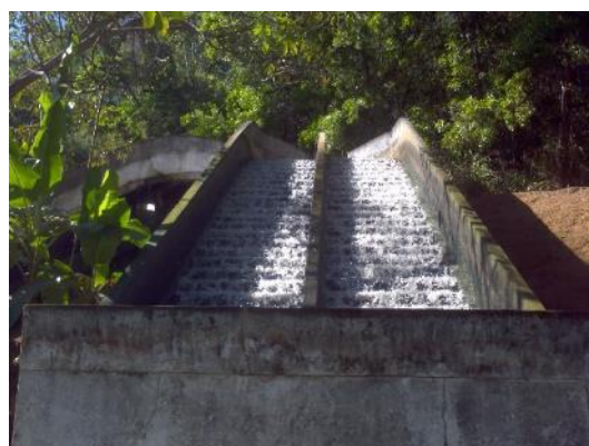
Figura 86 - Cascata de aeração da ETE Serra Dourada.
