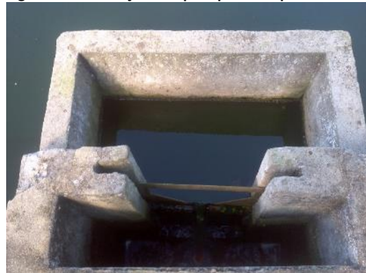
Figura 39 - Medidor de vazão na saída da lagoa de maturação.
