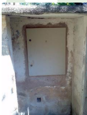
Figura 77 - Painel de controle da EEEB Irerê sem sinalização de risco de choque elétrico.
