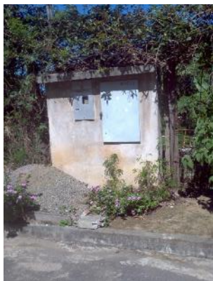
Figura 64 - EEEB Cuminã sem identificação e sem sinalização de risco de choque elétrico.
