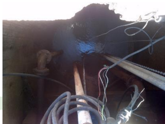
Figura 67 - Fiação exposta na EEEB Cuminã.
