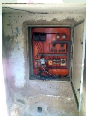
Figura 78 - Painel de controle da EEEB Irerê.
