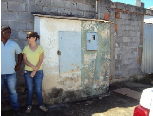
Figura 55 - EEEB Pororoca sem identificação e sem sinalização de risco de choque elétrico.
