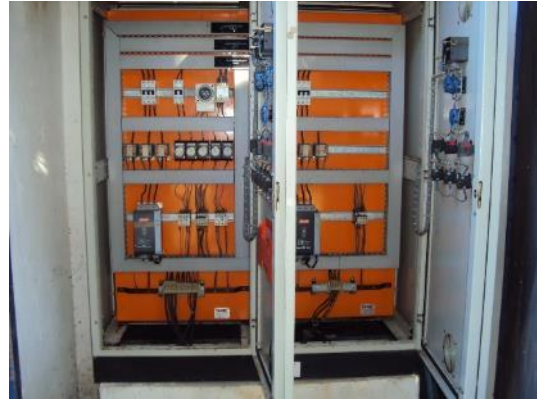
Figura 23 - Painel de controle da EEB Jardim Primavera.
