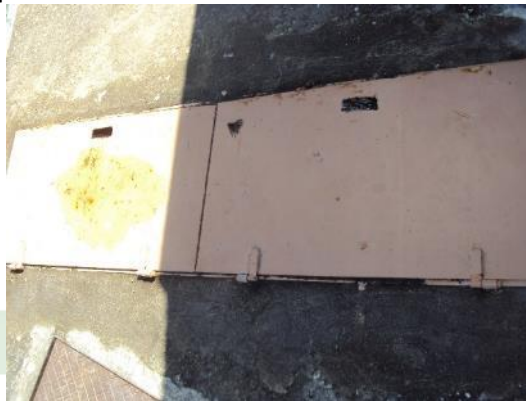
Figura 57 - Tampa do poço de sucção sem trancamento.
