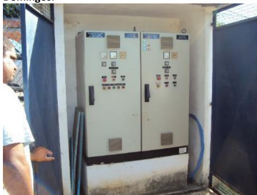
Figura 11 - Painel de controle da EEB São Domingos.
