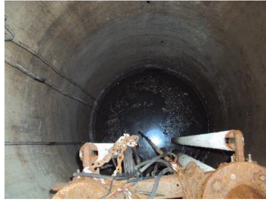
Figura 61 - Poço de sucção da EEEB Magnólia com excesso de resíduos grosseiros.
