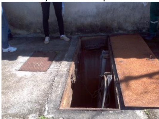
Figura 66 - Poço de sucção da EEEB Cuminã.
