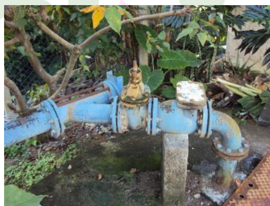
Figura 15 - Válvula do barrilete com vazamento.
