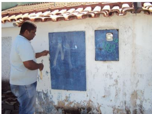
Figura 52 - EEEB Rio de Janeiro sem identificação e sem sinalização de risco de choque elétrico.
