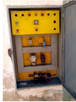
Figura 56 - Painel de controle da EEEB Pororoca.
