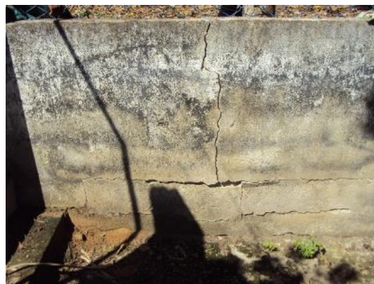
Figura 76 - Muro do entorno da EEEB Irerê com rachadura.
