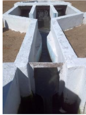
Figura 29 - Caixa de areia e medidor de vazão da ETE Jardins.
