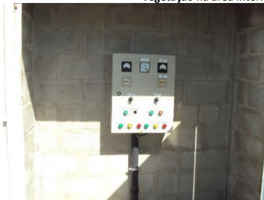
Figura 74 - Painel de controle da EEB Porto Canoa II.
