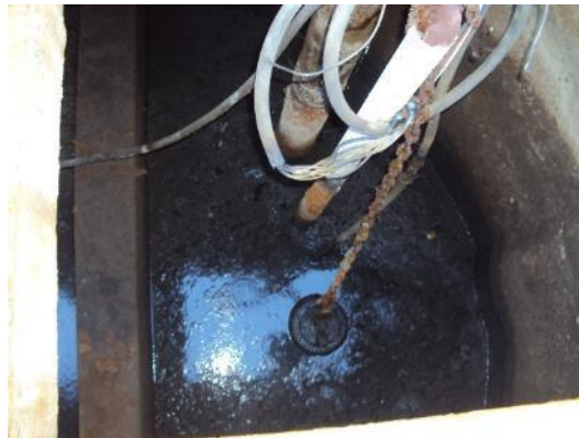
Figura 27 - Poço de sucção da EEBB Jardim Guanabara com fiação exposta e resíduos grosseiros.
