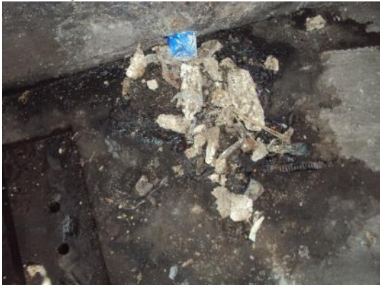
Figura 70 - Resíduos do gradeamento.
