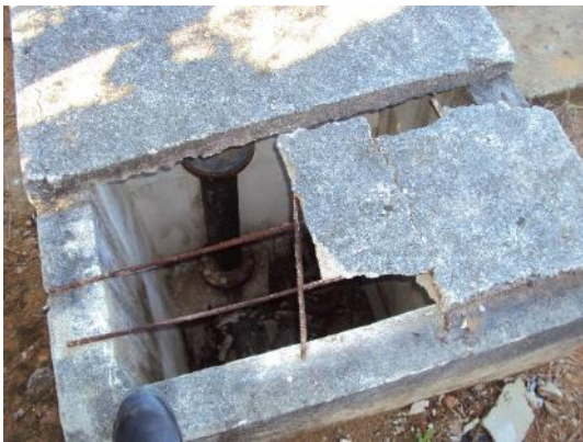
Figura 24 - Tampa da estrutura de proteção da tubulação danificada da EEB Jardim Guanabara.
