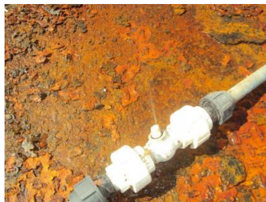
Figura 39 - Vazamento de água observado na área interna da EEEB São Paulo.
