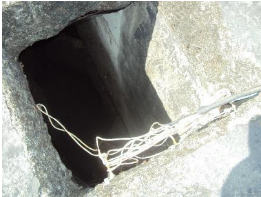
Figura 18 – Fiação exposta no poço de sucção da EEB Jacaraípe Velha II.
