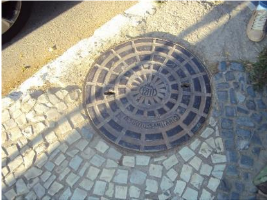
Figura 74 - Poço de visita com identificação do SES Nova Almeida.
