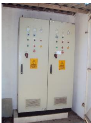
Figura 69 - Painel de controle com sinalização de risco de choque elétrico.
