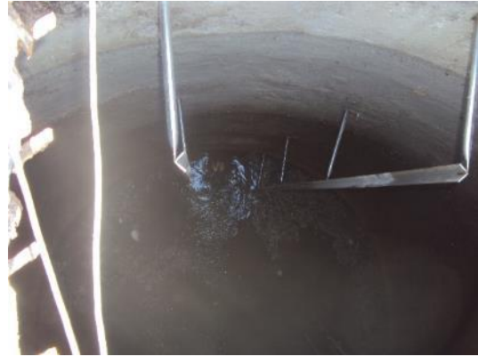
Figura 41 - Poço de sucção da EEEB Timbiras com resíduos grosseiros.
