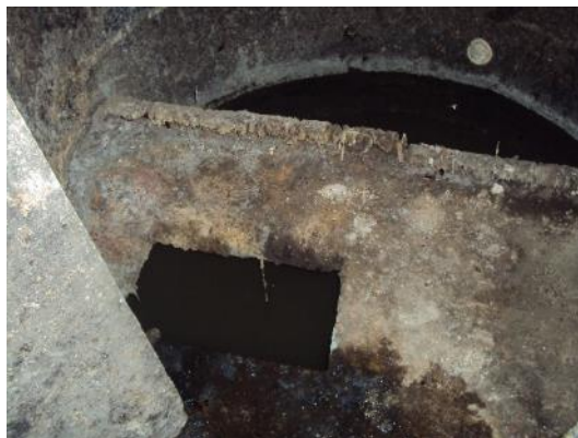
Figura 79 – Mecanismo de remoção de sólidos grosseiros da NA 01.
