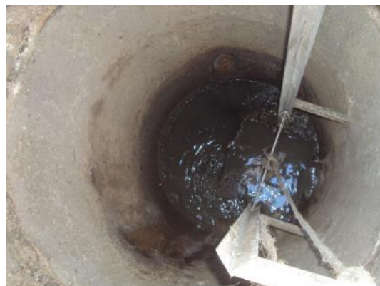
Figura 49 - Poço de sucção com cesto obstruído.
