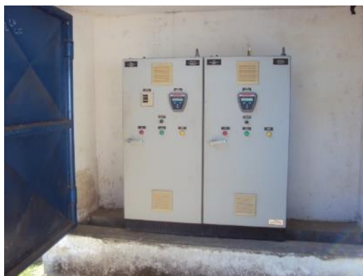
Figura 81 – Painel sem sinalização de risco de choque elétrico.
