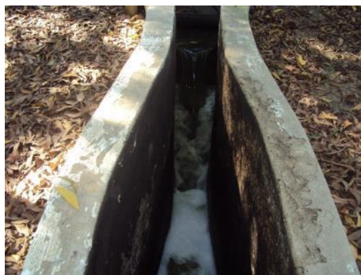
Figura 70 - Local de saída dos efluentes.
