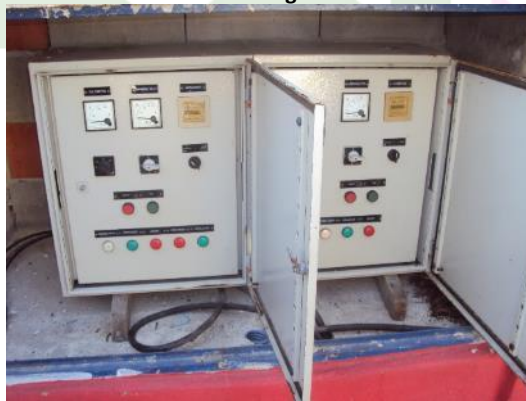
Figura 33 - Painel de controle da EEEB Goitacazes.
