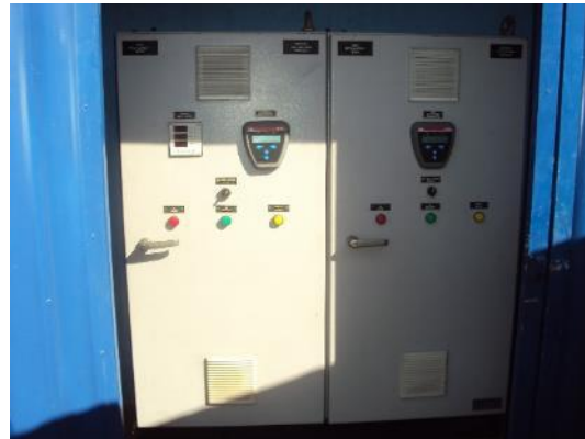
Figura 77 – Painel sem sinalização de risco de choque elétrico.
