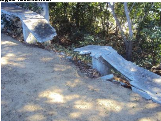
Figura 68 - Rampa de acesso à caixa de resíduos danificada.
