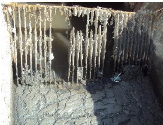
Figura 55 – Gradeamento danificado e com acúmulo de gordura.
