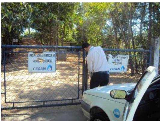
Figura 52 – Placas quebradas da entrada da ETE Jacaraípe.
