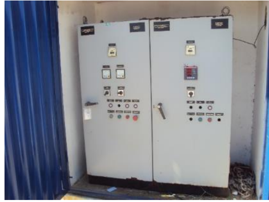
Figura 26 - Painel de controle da EEEB Jacaraípe praia.
