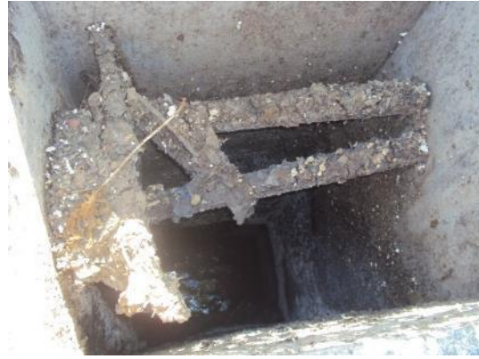
Figura 9 - Poço de sucção da EEEB do Campo com excesso de resíduos grosseiros.
