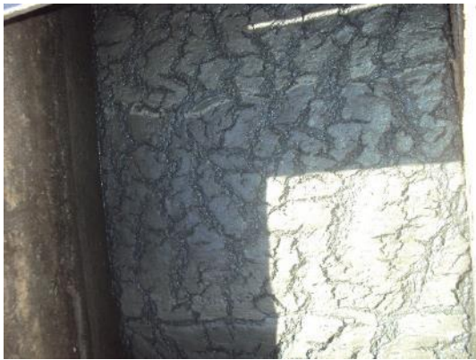
Figura 56 – Caixa de areia com acúmulo de gordura.
