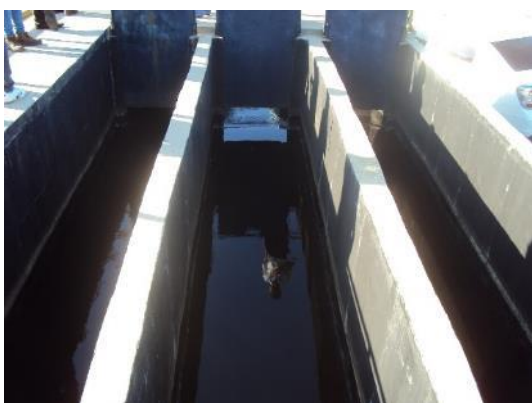
Figura 93 – Caixa de areia da ETE Nova Almeida.
