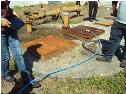
Figura 36 - Tampas do poço da EEEB São Paulo enferrujadas.
