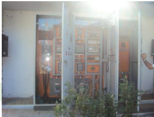
Figura 88 - Painel sem sinalização de risco de choque elétrico.
