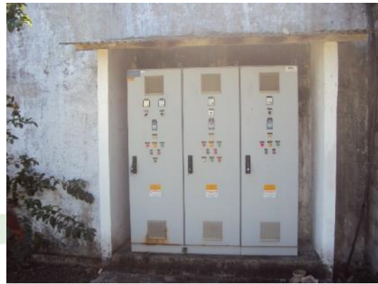
Figura 23 - Painel de Controle da EEB Jacaraípe Velha III.
