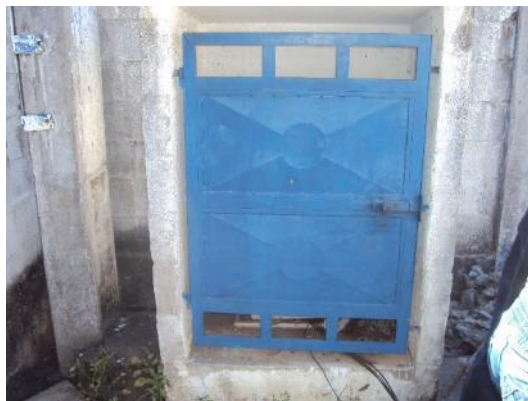
Figura 44 - Painel de controle da EEEB Timbiras sem sinalização de risco de choque elétrico.
