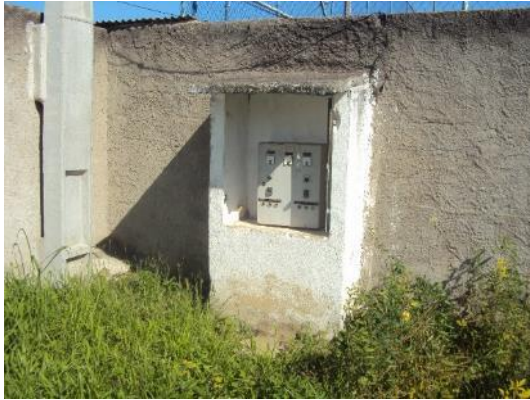
Figura 50 - Painel de controle da EEBB Nossa Senhora da Conceição sem tampa de proteção e com ferrugem.
