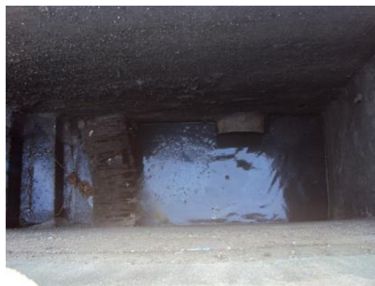
Figura 7 - Gradeamento danificado da EEEB do Campo.
