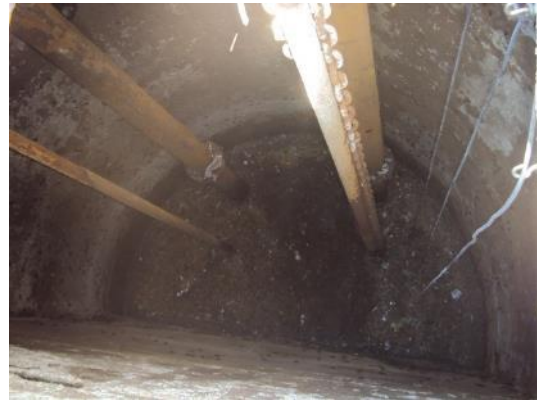
Figura 28 - Poço da EEEB Carijós com excesso de resíduos grosseiros.
