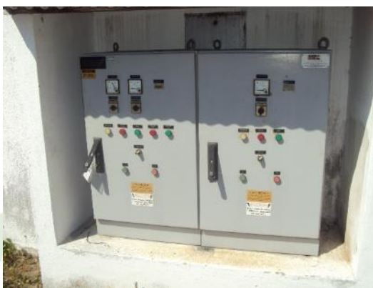
Figura 15 – Painel de controle da EEB Jacaraípe Velha I sem tampas de proteção e sem sinalização de risco de choque elétrico.
