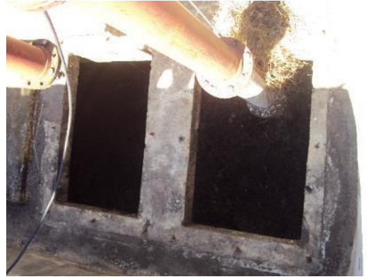
Figura 17 – Poço de sucção da EEB Jacaraípe Velha II sem tampas.
