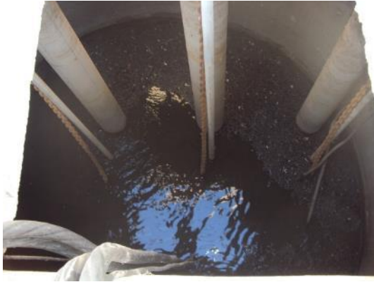
Figura 86 – Poço com resíduos grosseiros.
