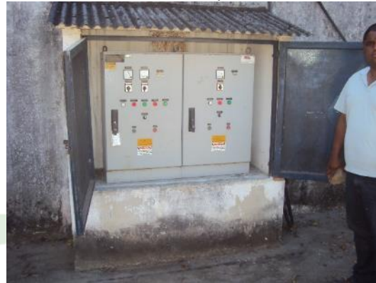
Figura 19 - Painel de controle da EEB Jacaraípe Velha II sem sinalização de risco de choque elétrico.
