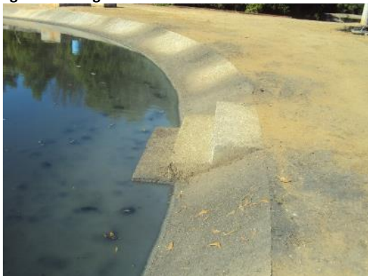
Figura 62 – Escada sem guarda corpo na lagoa anaeróbia.
