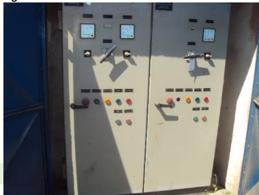
Figura 37 - Painel de controle da EEEB São Paulo.
