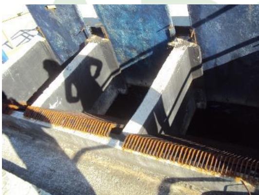
Figura 91 – Gradeamento da ETE Nova Almeida.
