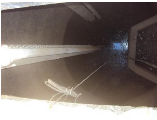
Figura 83 – Poço com resíduos grosseiros.
