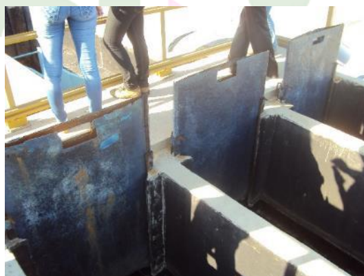
Figura 92 – Comportas do tratamento preliminar da ETE Nova Almeida enferrujadas.
