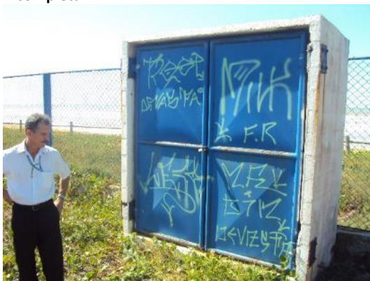
Figura 29 - Painel de controle da EEEB Carijós sem sinalização de risco de choque elétrico.
