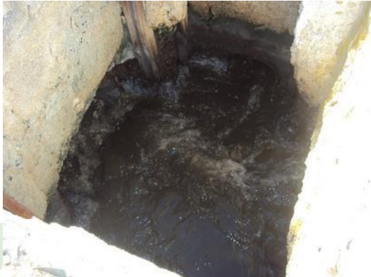
Figura 59 – Caixa de passagem para a lagoa anaeróbia.
