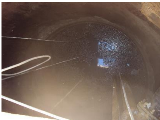
Figura 78 – Poço de sucção da EEBB NA 01 com resíduos grosseiros.
