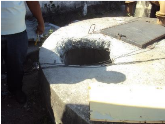
Figura 42 - Abertura no poço de sucção da EEEB Timbiras.
