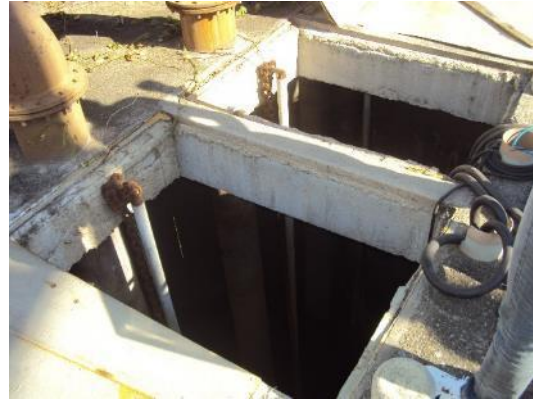
Figura 87 – Poço de sucção sem tampas.
