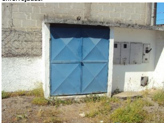
Figura 38 - Painel da EEEB São Paulo sem sinalização de risco de choque elétrico.
