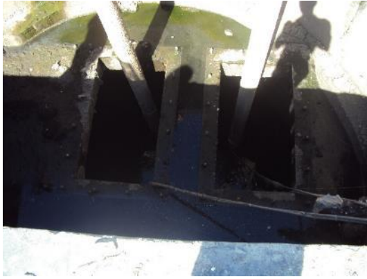
Figura 8 – Poço de sucção da EEEB do Campo sem tampas.
