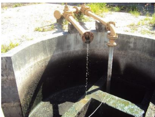
Figura 14 – Vazamento no poço de sucção da EEB Jacaraípe Velha I.
