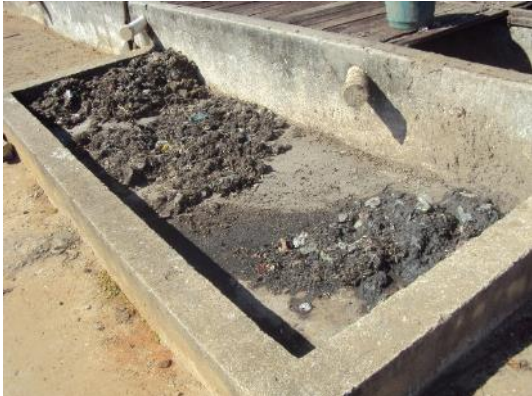
Figura 58 – Caixa de resíduos localizada ao lado do preliminar.
