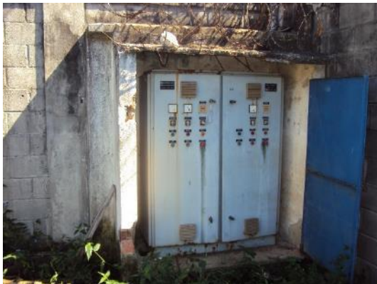
Figura 10 – Painel da EEEB do Campo sem sinalização de risco de choque elétrico e com tampas demandando manutenção.
