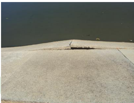
Figura 67 – Abertura no talude da lagoa facultativa.
