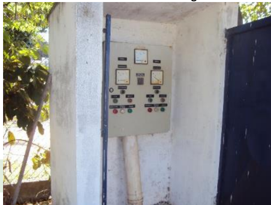
Figura 47 - Painel de controle da EEEB Magistrados.
