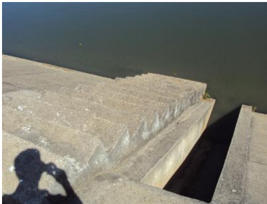
Figura 65 – Escada da lagoa facultativa sem guarda-corpo.
