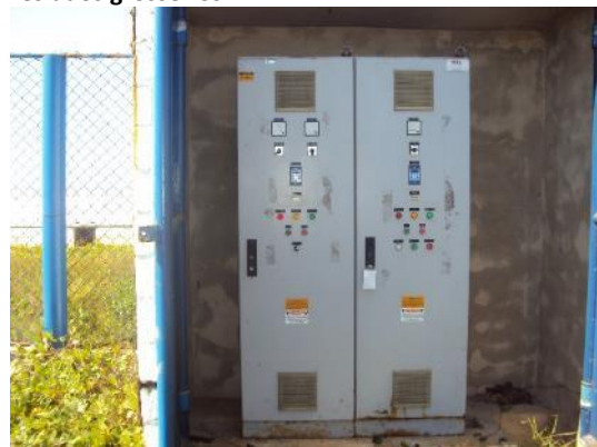
Figura 30 - Painel de controle da EEEB Carijós.
