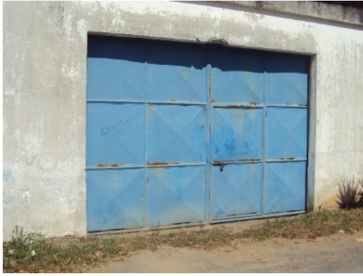
Figura 16 - Entrada da EEB Jacaraípe Velha II sem identificação.
