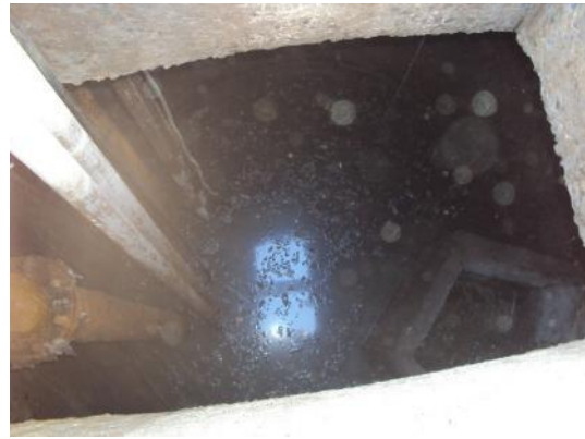
Figura 32 - Poço da EEEB Goitacazes com resíduos grosseiros.
