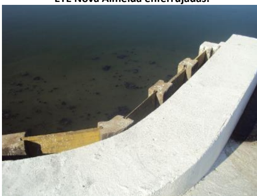
Figura 94 – Lagoa anaeróbia da ETE Nova Almeida.
