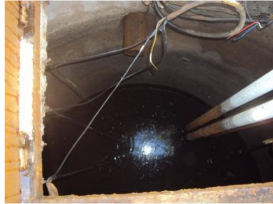
Figura 46 - Fiação exposta no poço de sucção da EEEB Magistrados.
