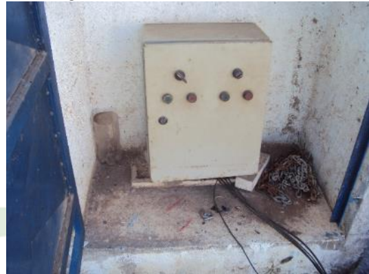
Figura 43 - Painel de controle da EEEB Timbiras.
