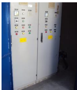
Figura 12 - Painel de controle da EEEB PB I.
