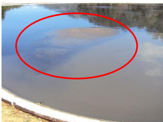
Figura 84 - Lagoa Anaeróbia ETE Furnas com excesso de areia.
