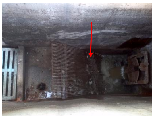
Figura 7 - Gradeamento da EEEB PB I demandando limpeza.
