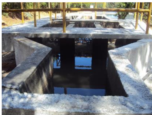
Figura 78 - Gradeamentos da ETE Furnas.
