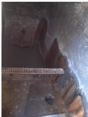
Figura 8 - Infiltração na parede lateral interna do gradeamento da EEEB PB I.
