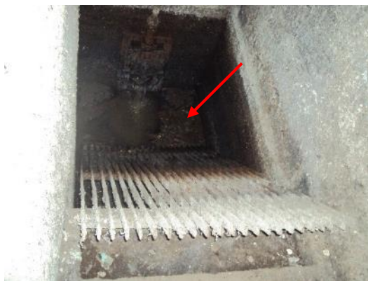
Figura 15 - Gradeamento da EEBB PB II demandando limpeza de fundo.
