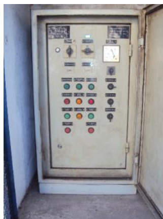
Figura 23 - Painel de controle da EEB Bairro de Fátima.
