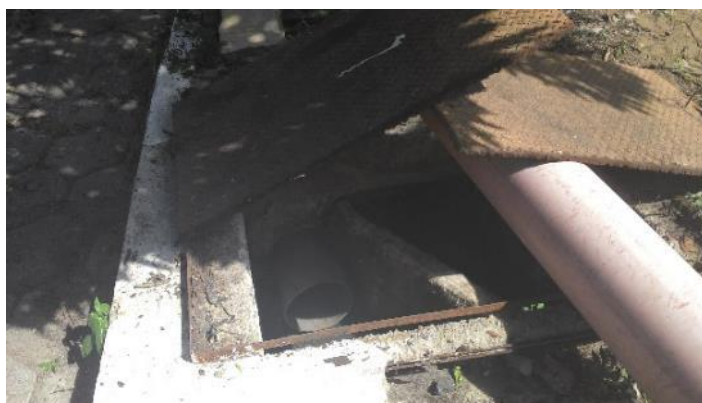
Figura 27 - Caixa de drenagem localizada próximo a área de lazer com tampa danificada.
