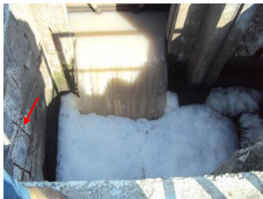
Figura 51 - Desgaste da estrutura de concreto dos pontos intermediários entre as lagoas e formação de espuma.
