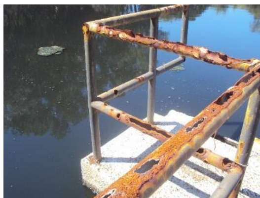
Figura 85 – Guarda corpo da interligação da lagoa anaeróbia enferrujado da ETE Furnas.
