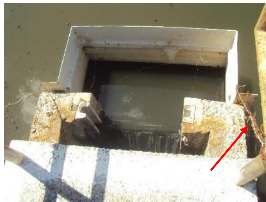
Figura 89 - Ponto de saída da lagoa facultativa com estrutura improvisada.
