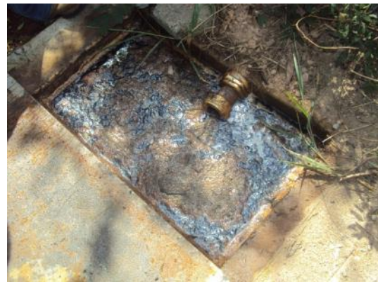
Figura 44 - Bombeamento inoperante do líquido drenado do leito de secagem.
