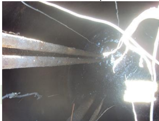
Figura 75 - Poço de sucção com fiação exposta da EEBB Estados Unidos/Central Carapina.
