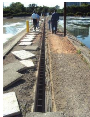
Figura 46 - Canaleta da fiação dos aeradores sem cobertura.
