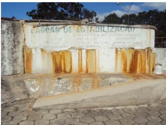
Figura 32 - Rachaduras e infiltrações no tratamento preliminar.
