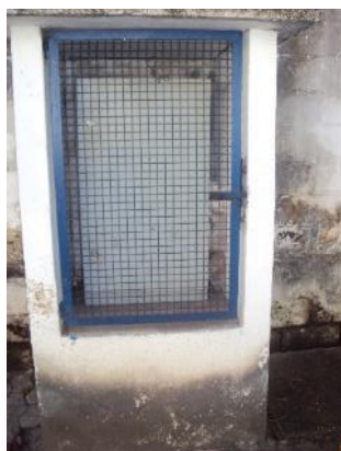
Figura 24 – Painel de controle da EEB Bairro de Fátima sem sinalização de risco de choque elétrico.
