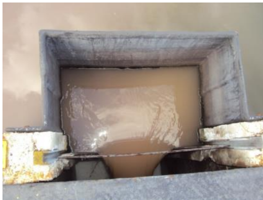
Figura 55 - Vertedouro triangular na saída da lagoa facultativa para medição de vazão.
