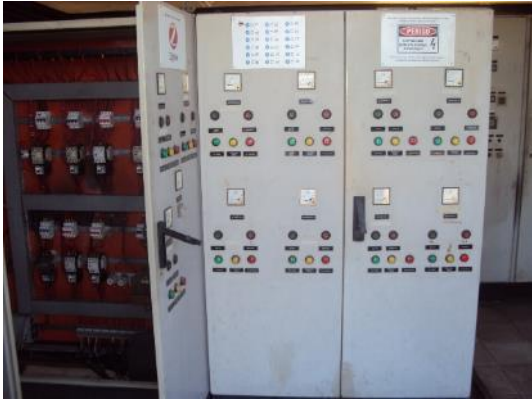
Figura 47 - Painel de controle dos aeradores.
