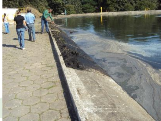
Figura 37 – Resíduos grosseiros sendo retirados da primeira lagoa aerada.
