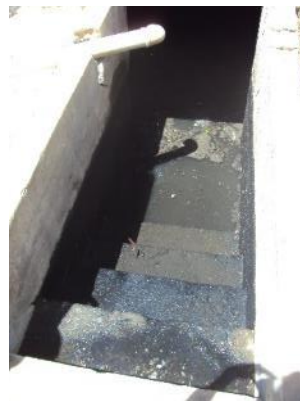
Figura 65 - Tratamento preliminar da EEBB José de Anchieta afogado.
