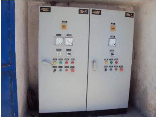
Figura 66 - Painel de controle da EEEB José de Anchieta sem sinalização de risco de choque elétrico.
