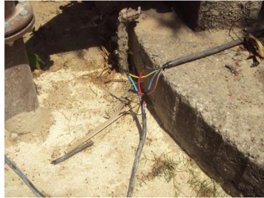
Figura 67 - Fiação exposta próximo ao poço de sucção.
