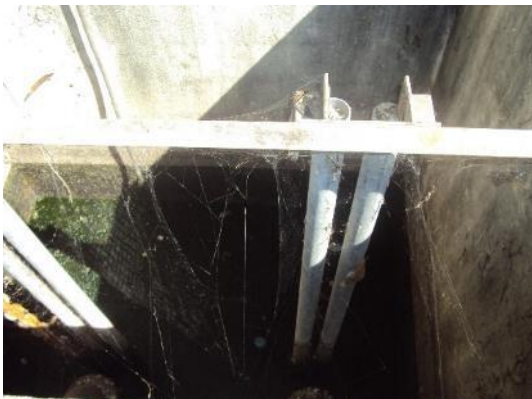
Figura 54 - Poço de sucção do bombeamento para a recirculação do efluente das lagoas.
