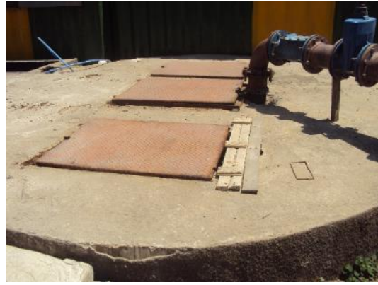
Figura 71 - Tampas do poço de sucção danificadas.
