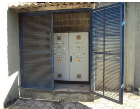
Figura 18 - Painel de controle da EEBB PB II sem sinalização de risco de choque elétrico.
