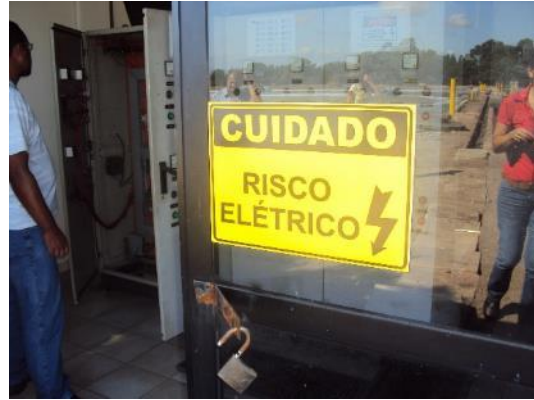
Figura 48 - Sinalização de risco de choque elétrico no painel de controle dos aeradores.
