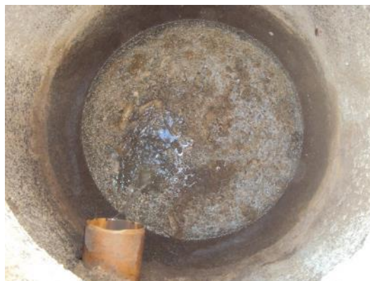
Figura 5 - Poço de visita parcialmente obstruído do SES Hélio Ferraz.
