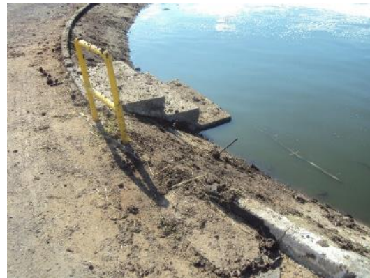
Figura 39 – Escada sem guarda corpo.
