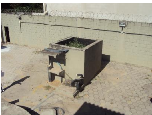
Figura 10 - Biofiltro da EEEB PB I inoperante.
