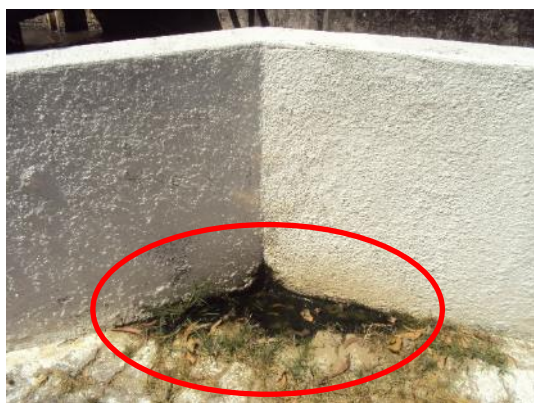
Figura 82 - Infiltração na estrutura externa do tratamento preliminar.
