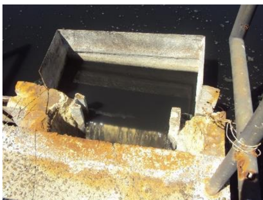
Figura 86 - Estrutura improvisada no ponto de interligação da lagoa anaeróbia da ETE Furnas.
