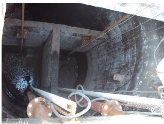
Figura 16 - Poço de sucção da EEBB PB II com resíduos grosseiros.
