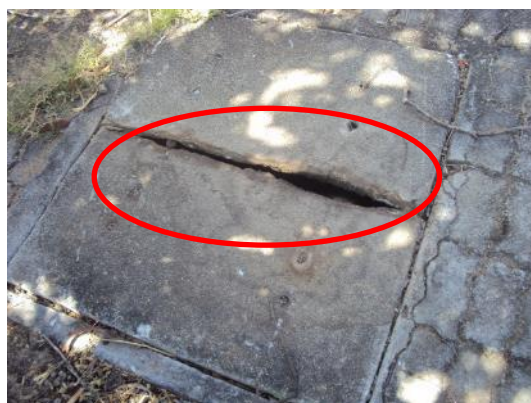
Figura 83 - Caixa de passagem danificada.
