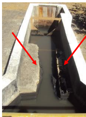
Figura 81 - Calha Parshall danificada da ETE Furnas.
