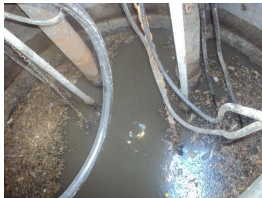
Figura 9 - Poço de sucção da EEEB PB I com excesso de resíduos grosseiros.
