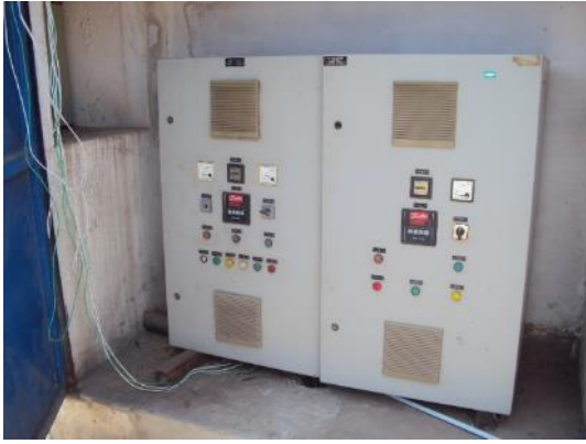
Figura 70 - Painel de controle sem sinalização de risco de choque elétrico.
