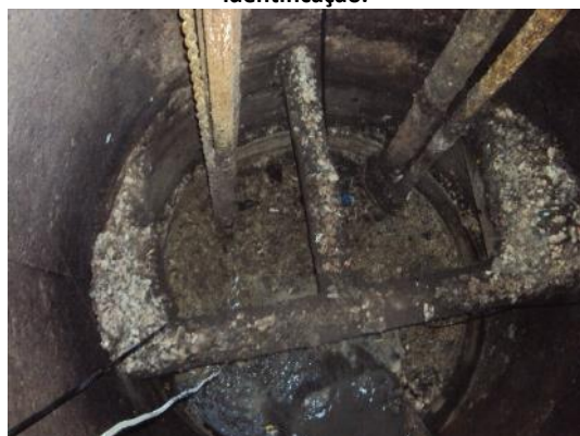
Figura 22 – Poço de sucção da EEB Bairro de Fátima com resíduos grosseiros e gordura.
