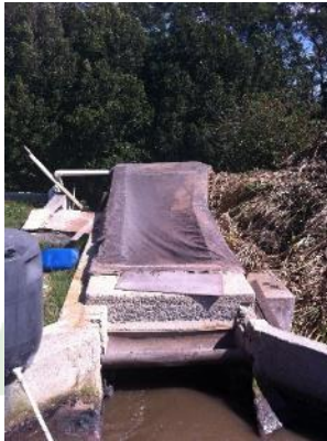
Figura 30 - Cobertura improvisada no final do tratamento preliminar.
