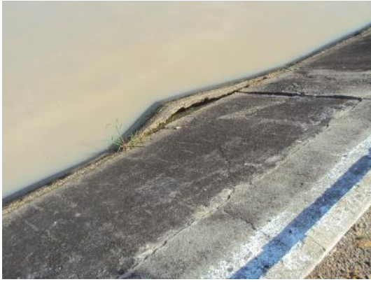
Figura 40 - Fissura no talude interno da lagoa.
