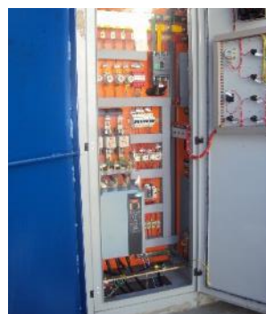
Figura 13 – Interior do Painel de controle da EEEB PB I.
