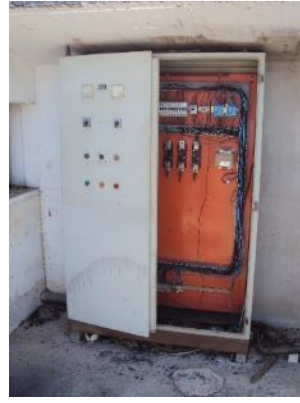
Figura 61 - Painel de controle da EEBB Furnas danificado.
