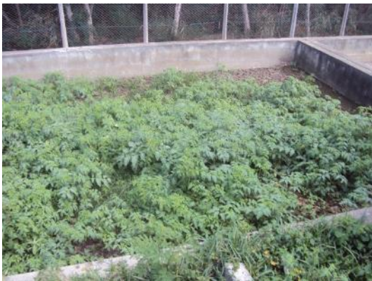
Figura 43 - Leito de secagem com excesso de vegetação.
