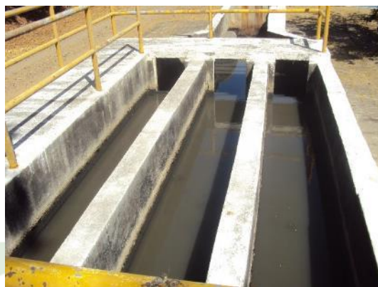
Figura 79 - Caixas de Areia da ETE Furnas.
