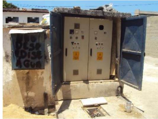
Figura 74 - Painel de controle com sinalização de risco de choque elétrico da EEBB Estados Unidos/Central Carapina.
