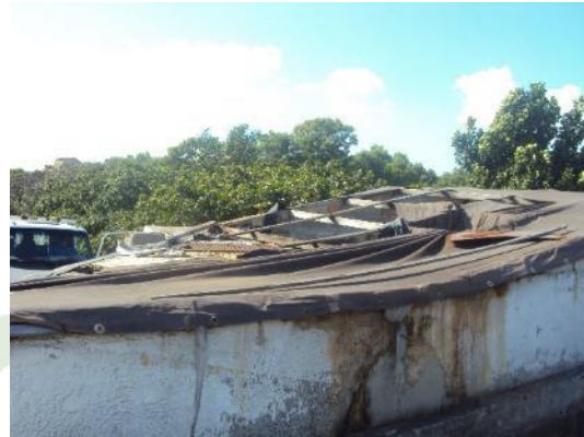
Figura 31 - Cobertura improvisada da caixa de recepção de esgoto no tratamento preliminar.
