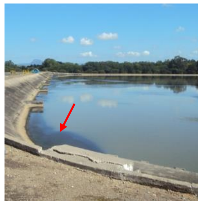
Figura 52 - Pontos de assoreamento na lagoa facultativa.
