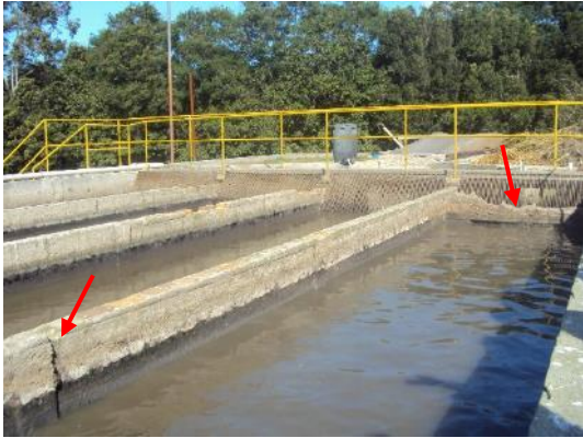
Figura 28 – Caixa de areia e gradeamento do tratamento preliminar com estrutura de concreto danificada.
