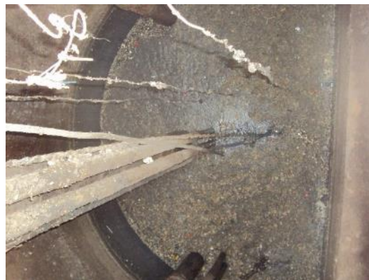
Figura 101 - Poço de sucção com resíduos grosseiros na ETE Feu Rosa.
