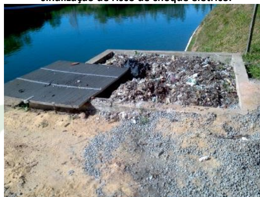
Figura 83- Caixa de resíduos demandando limpeza.
