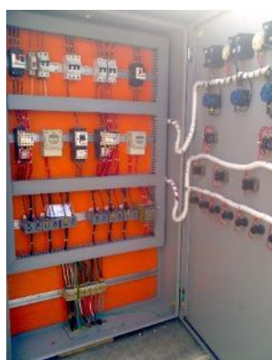
Figura 14 - Painel de Controle da EEEB Boulevard Lagoa II.
