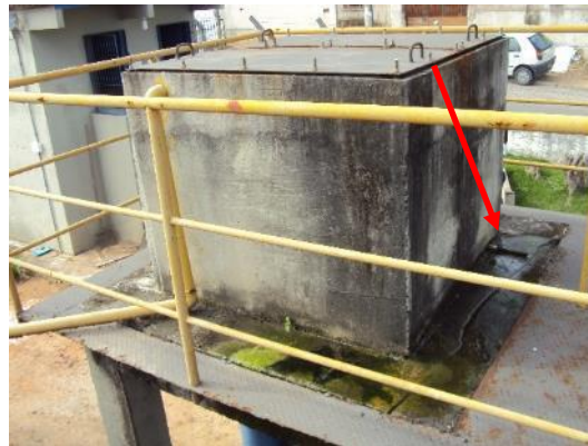
Figura 105 - Caixa de distribuição dos reatores com vazamento da ETE Feu Rosa.
