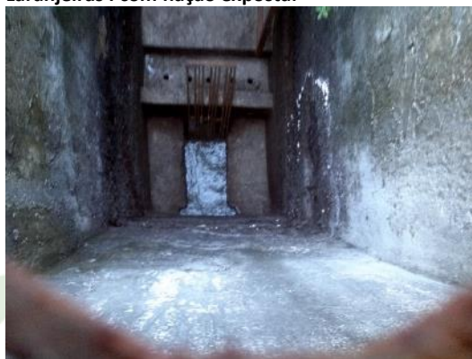
Figura 70 – Gradeamento da EEB Colina de Laranjeiras I.
