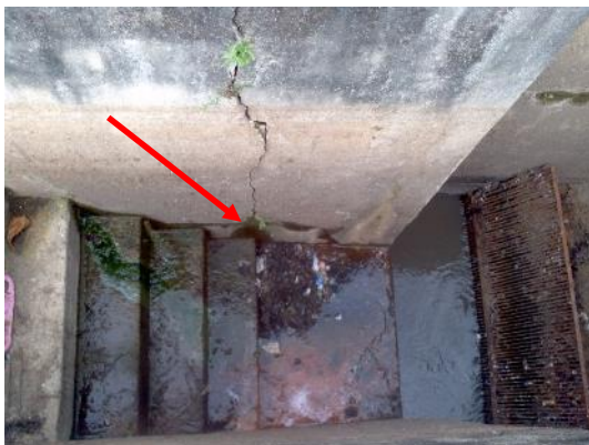
Figura 26 - Vazamento e rachadura na escada de acesso ao gradeamento da EEB Vila Nova de Colares II.
