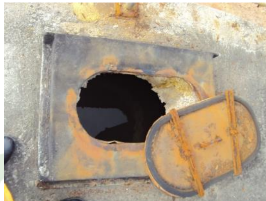
Figura 107 - Tampa do reator enferrujada da ETE Feu Rosa.
