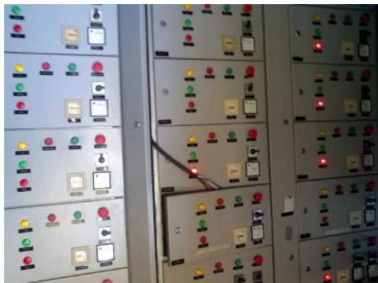
Figura 80 - Painel dos aeradores da ETE Civit II.
