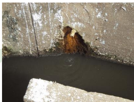
Figura 99 - Infiltração na caixa de areia da ETE Feu Rosa.
