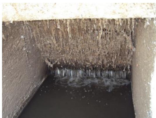
Figura 98 - Gradeamento demandando limpeza da ETE Feu Rosa.
