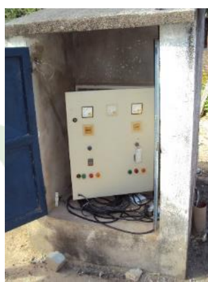
Figura 95 - Painel de controle da EEB Mar Azul.
