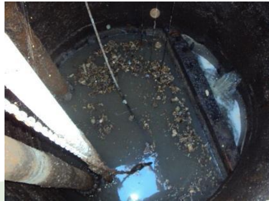
Figura 64 - Poço da EEEB Fazendinha com resíduos.
