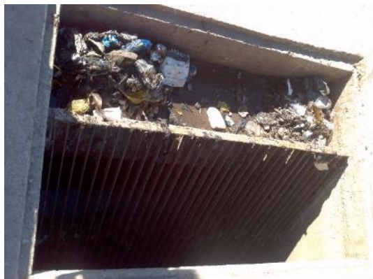
Figura 74 – Gradeamento da ETE Civit II.
