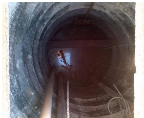
Figura 55 - Poço de sucção da EEB Copacabana.
