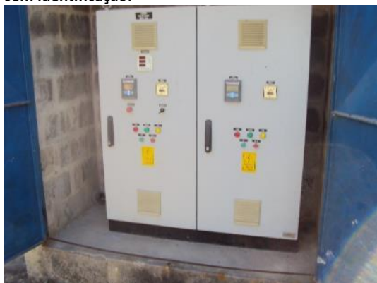
Figura 49 - Painel de Controle da EEB Portal de Manguinhos V.
