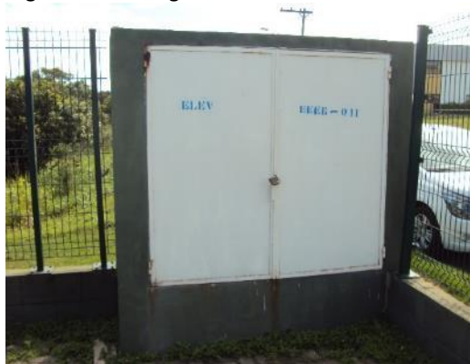
Figura 15 - Painel da EEEB Boulevard Lagoa II, sem sinalização de risco de choque elétrico.
