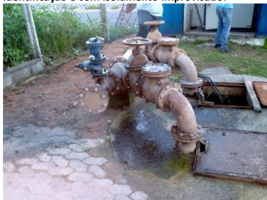
Figura 69 - Vazamento na tubulação do poço de sucção da EEB Colina de Laranjeiras I.
