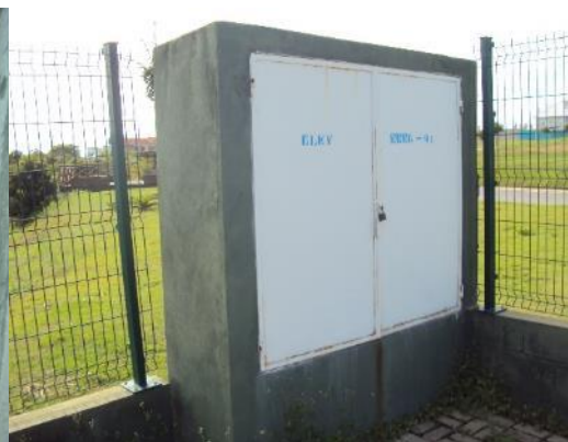
Figura 9 - Painel, da EEEB Boulevard Lagoa I, sem sinalização de risco de choque elétrico.
