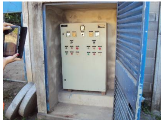
Figura 66 - Painel de controle da EEEB Fazendinha.
