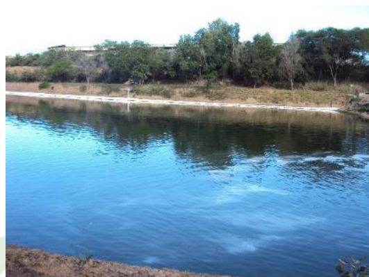
Figura 77 - Lagoa Facultativa da ETE Civit II.
