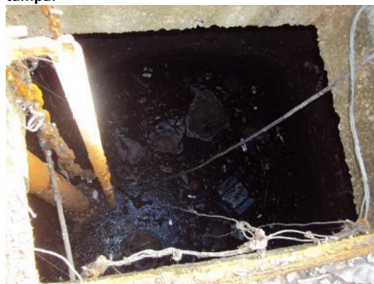
Figura 92 - Poço da EEB Mar Azul com resíduos grosseiros.
