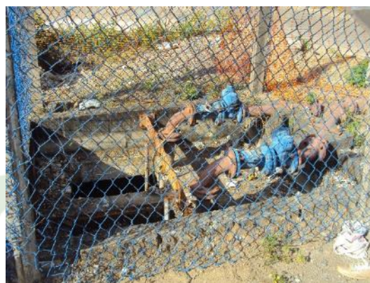
Figura 90 - Poço de sucção da EEB Mar Azul sem tampa.
