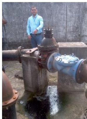
Figura 27 - Vazamento na válvula do barrilete da EEB Vila Nova de Colares II.
