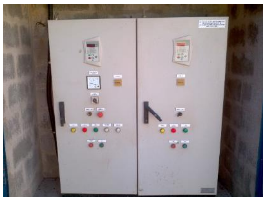
Figura 45 - Painele de controle da EEEB Portal de Manguinhos VI.
