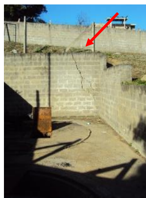
Figura 46 - Rachadura no muro do entorno da EEEB Portal de Manguinhos VI.
