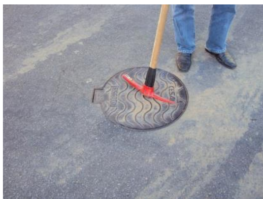
Figura 4 - Poço de Visita com identificação na Rua Minas Gerais do Sistema CIVIT II.
