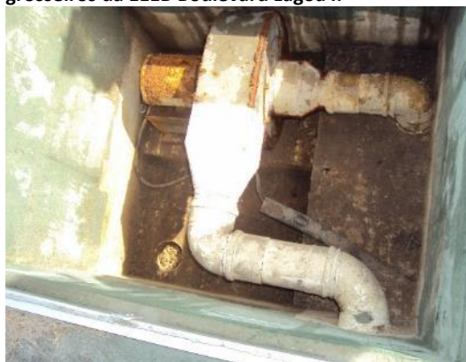
Figura 8 - Bomba do biofiltro com ferrugem da EEEB Boulevard Lagoa I.
