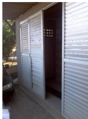
Figura 81 - Entrada do painel dos aeradores sem sinalização de risco de choque elétrico.
