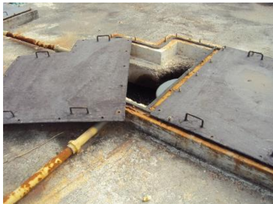
Figura 106 - Tampa do reator aberta da ETE Feu Rosa.
