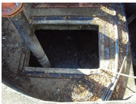
Figura 52 - Poço de sucção da EEB Laranjeiras II.
