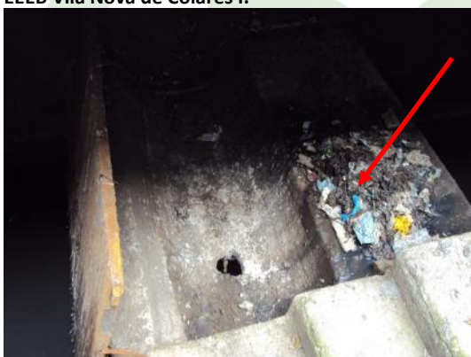
Figura 18 - Resíduos do gradeamento dispostos em local inadequado da EEEB Vila Nova de Colares I.
