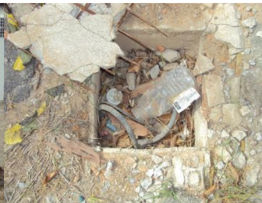
Figura 31 - Fiação exposta na área do entorno da EEEB R-7.
