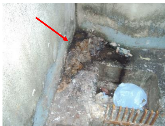
Figura 57 - Resíduos do gradeamento dispostos em local inadequado na EEB Copacabana.
