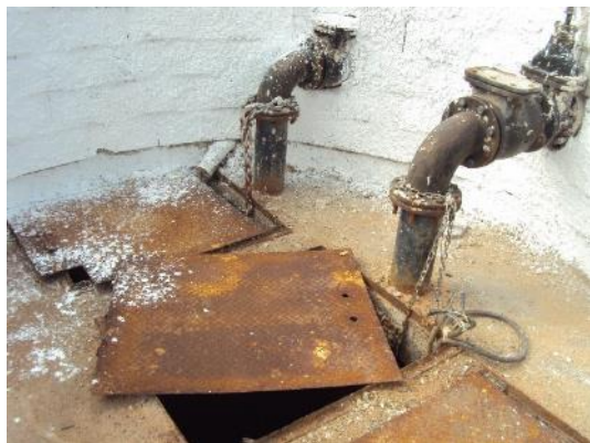
Figura 100 - Poço de sucção com tampas enferrujadas na ETE Feu Rosa.
