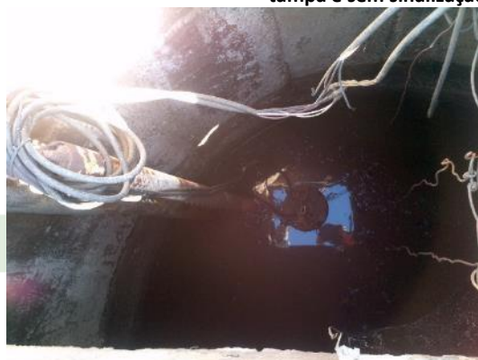
Figura 36 - Fiação exposta no poço de sucção da EEB Dório Silva.
