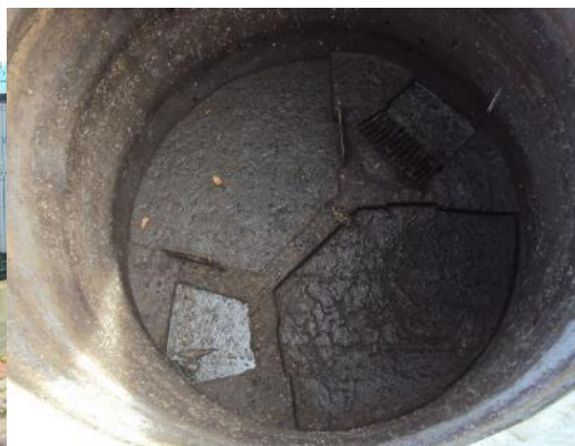
Figura 11 - Mecanismo de remoção de sólidos grosseiros da EEEB Boulevard Lagoa II.
