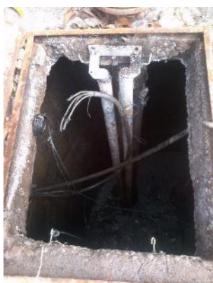
Figura 20 - Fiação exposta no poço de sucção da EEEB Vila Nova de Colares I.
