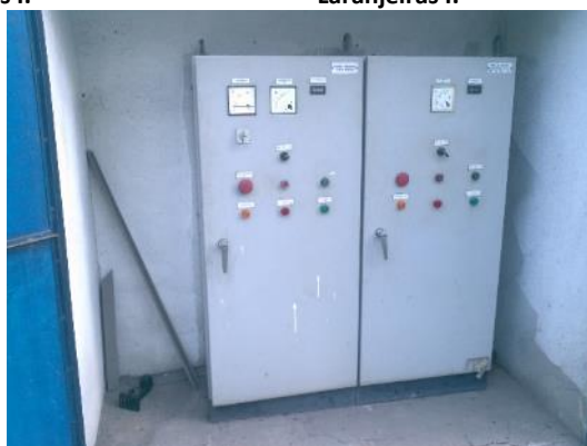
Figura 71 - Painel de controle da EEB Colina de Laranjeiras I.
