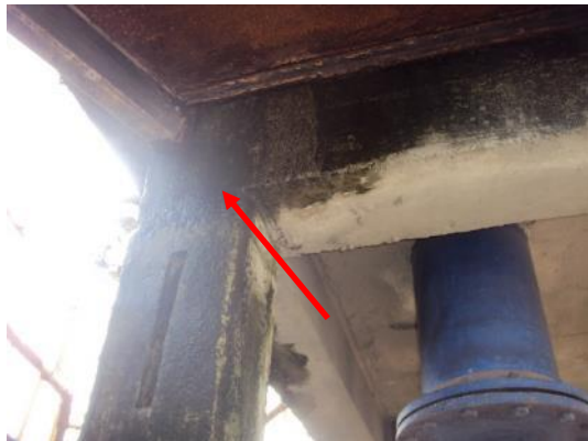
Figura 104 - Vazamento na caixa de distribuição dos reatores da ETE Feu Rosa.
