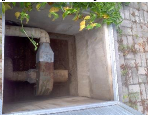
Figura 13 - Bomba do biofiltro da EEEB Boulevard Lagoa II com ferrugem.
