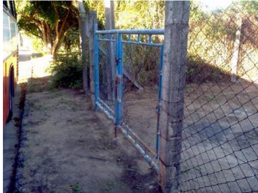
Figura 58 - Entrada da EEEB Morada de Laranjeiras sem identificação e com abertura no alambrado.
