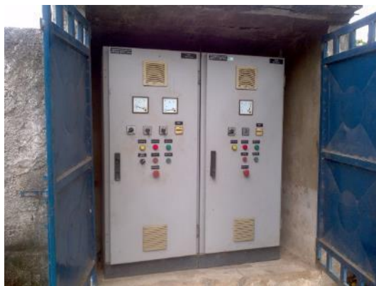
Figura 17 - Painel de controle da EEEB Vila Nova de Colares I.
