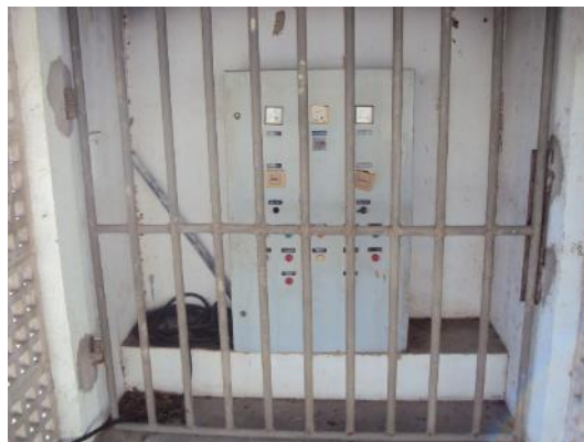
Figura 53 - Painel de Controle da EEB Laranjeiras II.
