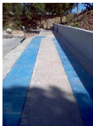
Figura 73 - Gradeamento e caixa de areia da ETE Civit II.
