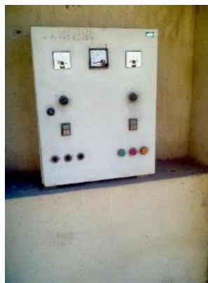
Figura 35 - Painel da EEB Dório Silva estava sem tampa e sem sinalização de risco de choque elétrico.
