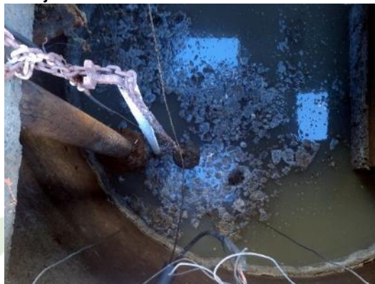
Figura 40 - Resíduos grosseiros e fiação exposta no poço de sucção da EEBB Aldeia de Laranjeiras.
