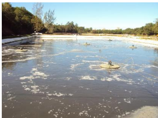
Figura 76 - Lagoa aerada em funcionamento da ETE Civit II.
