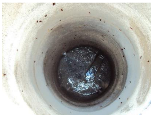
Figura 5 - Interior do poço de visita da Rua Minas Gerais do sistema CIVIT II.
