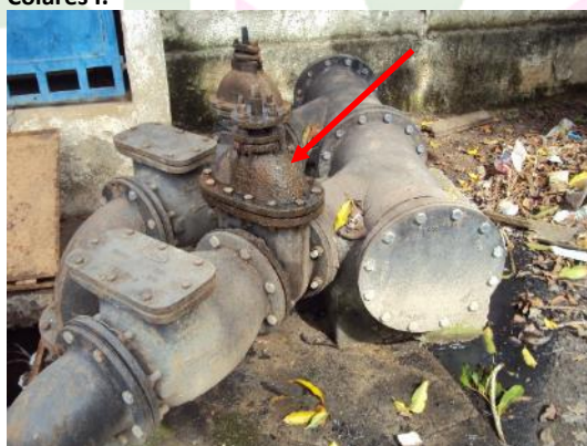
Figura 19 - Vazamento na válvula do barrilete da EEEB Vila Nova de Colares I.
