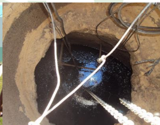
Figura 33 - Poço da EEEB R-6 com fiação exposta.
