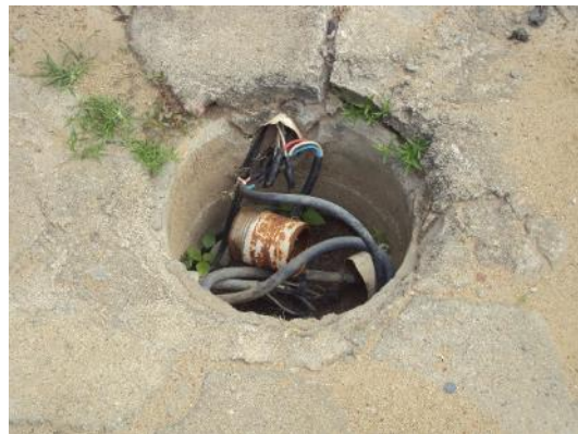
Figura 25 - Fiação exposta na área interna da EEB Vila Nova de Colares II.
