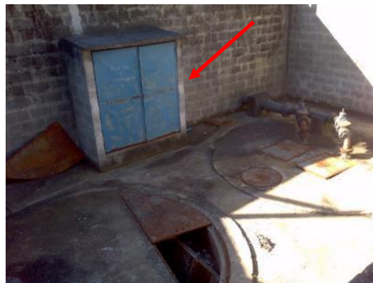
Figura 44 - Painele de controle, da EEEB Portal de Manguinhos VI, sem sinalização de risco de choque elétrico.
