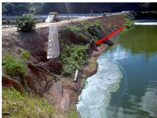
Figura 82 - Lagoa facultativa sem os taludes de proteção contra erosão e com vegetação.
