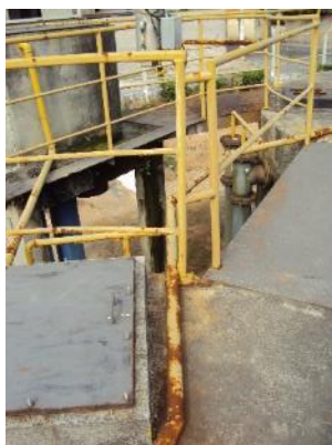
Figura 108 - Guarda corpo do reator enferrujado da ETE Feu Rosa.
