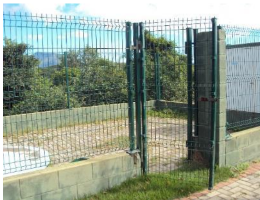
Figura 10 - EEEB Boulevard Lagoa II sem identificação.
