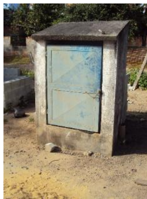
Figura 94 - Painel da EEB Mar Azul sem sinalização de risco de choque elétrico.
