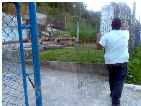
Figura 67 – Entrada da EEB Colina de Laranjeiras I sem identificação e com isolamento improvisado.
