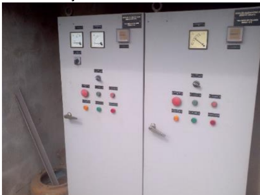
Figura 24 - Painel de Controle da EEB Vila Nova de Colares II.
