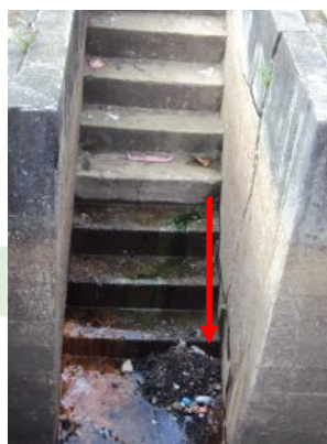
Figura 29 - Resíduos do gradeamento dispostos em local inadequado na EEB Vila Nova de Colares II.
