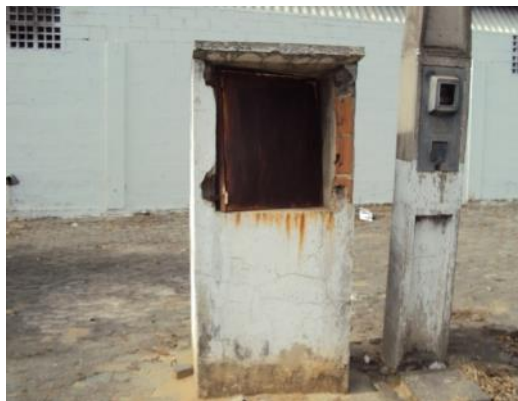
Figura 30 - EEEB R-7 sem identificação e em condições precárias de conservação.
