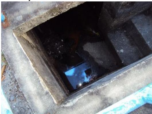
Figura 65 - Infiltração na escada de acesso ao gradeamento da EEEB Fazendinha.
