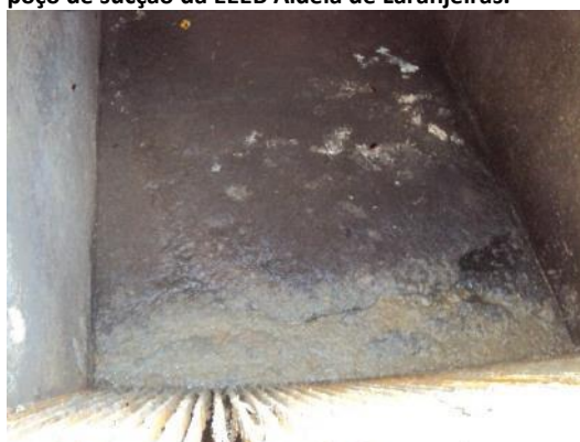
Figura 42 - Grande quantidade de gordura antecedendo ao gradeamento da EEBB Aldeia de Laranjeiras.
