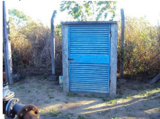
Figura 61 - Painel de controle, EEEB Morada de Laranjeiras, sem sinalização de risco de choque elétrico.
