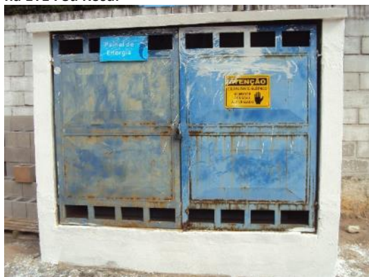
Figura 102 - Painel de controle com sinalização de risco de choque elétrico na ETE Feu Rosa.
