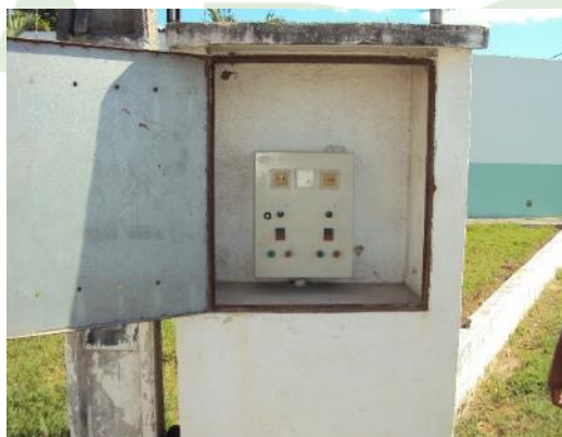
Figura 32 - Painel de Controle da EEEB R-6.
