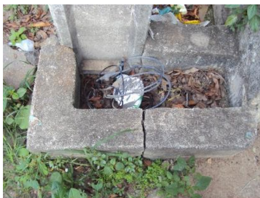
Figura 21 - Fiação exposta na área interna da EEEB Vila Nova de Colares I.
