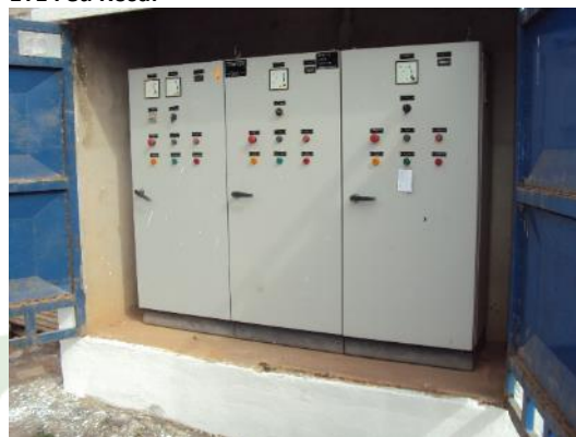
Figura 103 - Painel de controle da ETE Feu Rosa.
