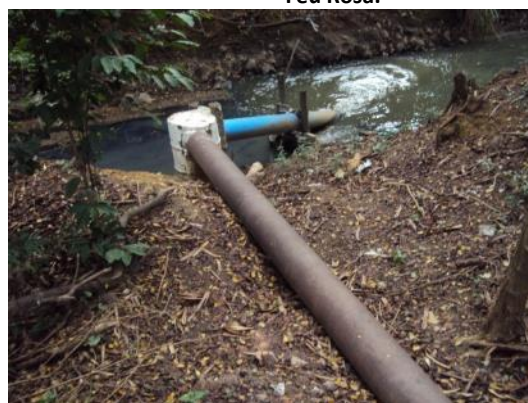
Figura 112 - Ponto de lançamento da ETE Feu Rosa.
