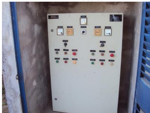
Figura 62 - Painel de controle da EEEB Morada de Laranjeiras.
