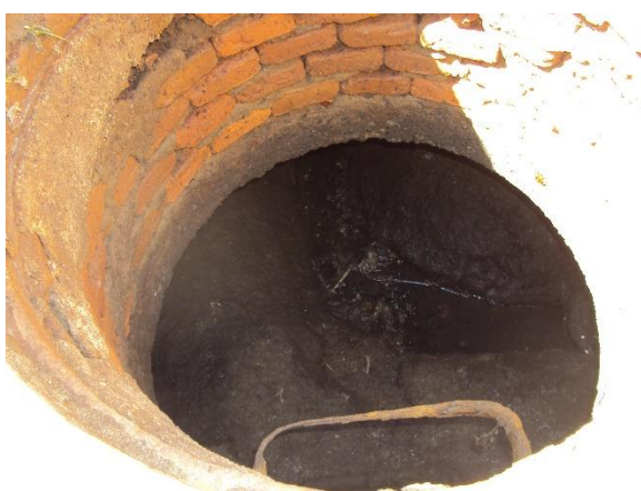
Figura 38 - Poço de Visita – Rua Limoeiro.
