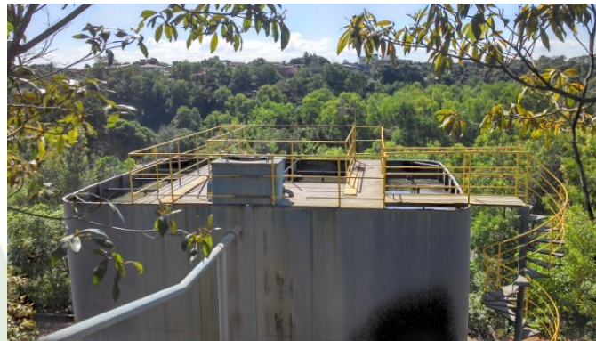
Figura 56 - Estrutura superior do reator UASB da ETE Barcelona.
