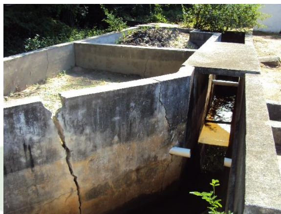
Figura 53 - Caixa de resíduo com rachadura na ETE Barcelona.
