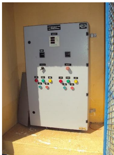
Figura 19 - Quadro de força da EEBB meio do SES André Carloni.
