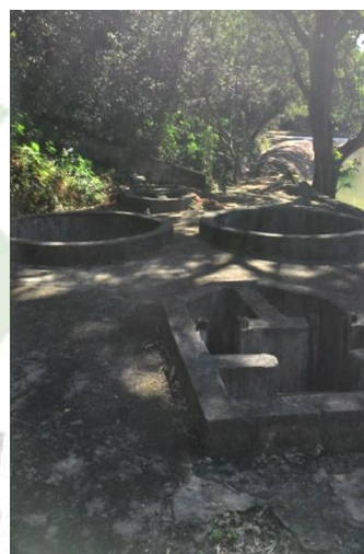
Figura 49 - Chegada 2 de esgoto bruto da ETE Barcelona.
