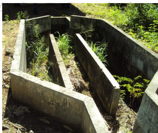
Figura 40 - Gradeamento e caixa de areia inoperantes da EEBB Colégio.
