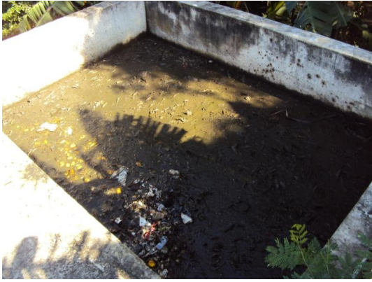
Figura 30: Caixa de Resíduos da ETE André Carloni.
