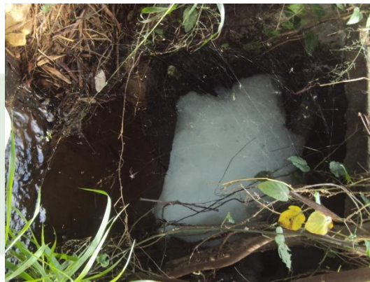
Figura 32: Lançamento do efluente da ETE André Carloni.
