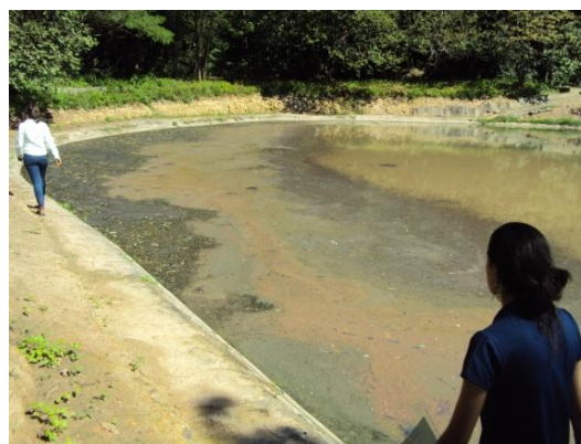
Figura 60 - Sobrenadante na lagoa facultativa da ETE Barcelona.
