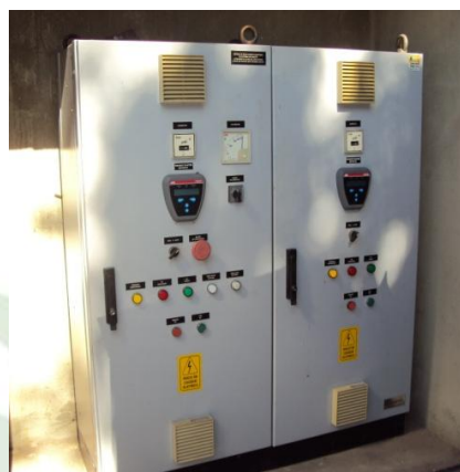
Figura 45 - Quadro de força da EEB Colinas II.
