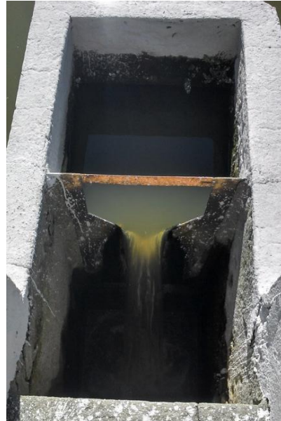
Figura 31: Vertedouro triangular na saída da lagoa facultativa da ETE André Carloni.
