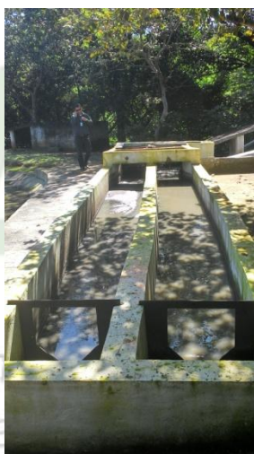
Figura 48 - Chegada 1 de esgoto bruto da ETE Barcelona.
