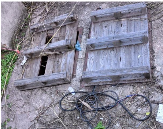
Figura 12: Tampas do poço de sucção da EEBB 4 provisória.
