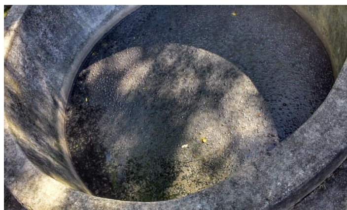
Figura 50 - Caixa de areia da chegada 2 de esgoto bruto demandando limpeza na ETE Barcelona.
