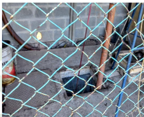
Figura 15 - Ausência de tampa no poço de sucção na EEBB 5.
