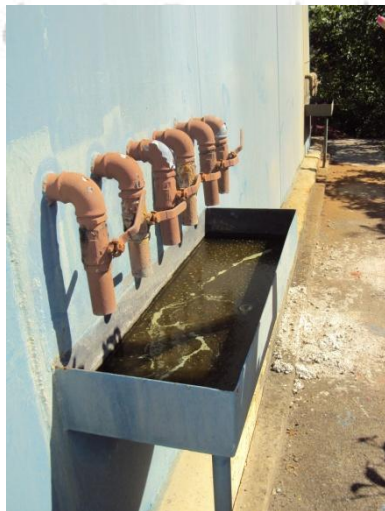
Figura 57 - Válvulas para teste de lodo com incrustações e bandeja com represamento de líquido no reator UASB da ETE Barcelona.
