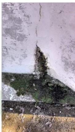
Figura 52 - Vazamento na caixa de areia da chegada 3 de esgoto bruto da ETE Barcelona.
