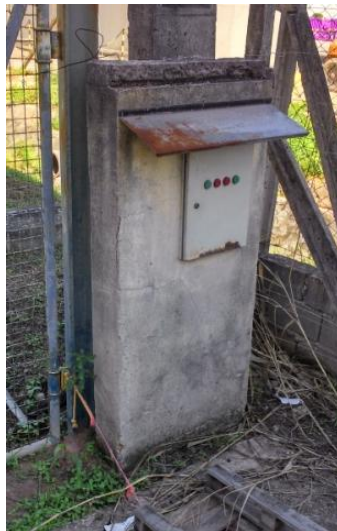
Figura 13 - Paine de controle de EEBB 4 com início de ferrugem.
