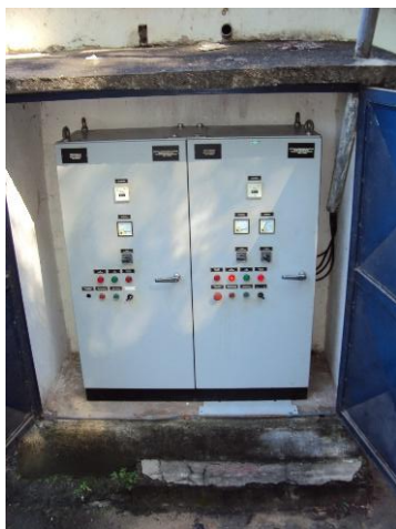
Figura 42 - Quadro de força da EEB Delegacia.
