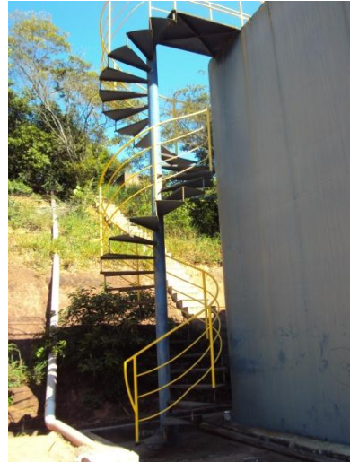
Figura 55 - Escada de acesso a parte superior do UASB onde não foi possível o acesso devido a corrosão.
