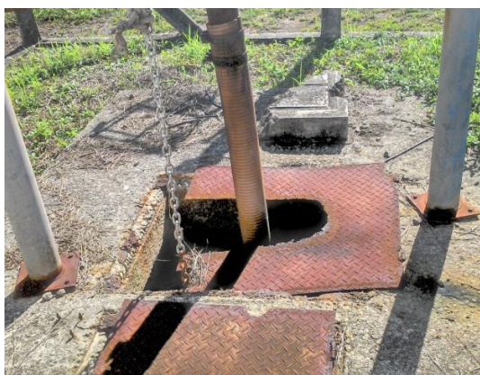
Figura 8 - Tampas do poço de sucção da EEEB 2 deterioradas.
