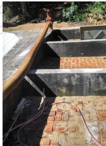
Figura 58 - Leito de secagem inoperante do reator UASB da ETE Barcelona.
