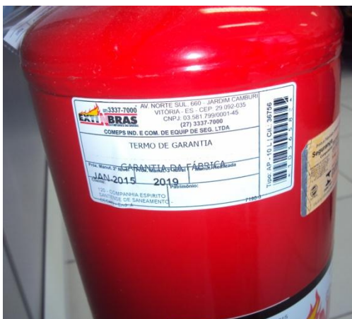
Figura 7 - Extintor de incêndio do Escritório.
