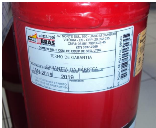
Figura 8 - Segundo extintor de incêndio.
