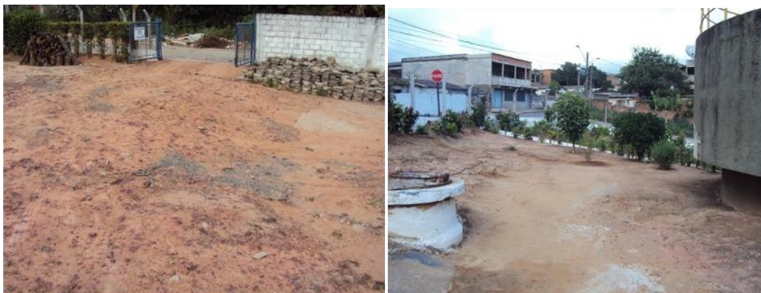
Figura 3: Pátio na entrada da ETE Feu Rosa sem calçamento.
