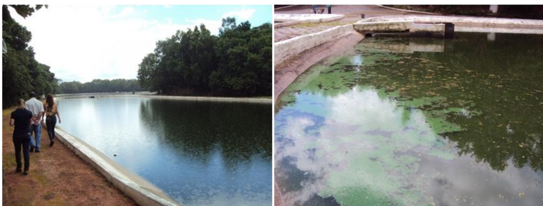
Figura 16: Lagoa facultativa 01 apresentando excesso de lodo.
