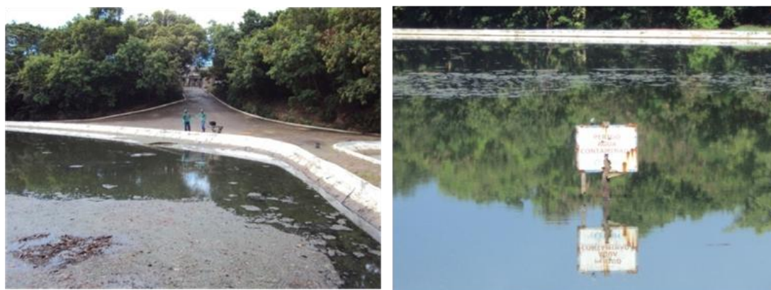
Figura 17: Lagoa facultativa 02 apresentando assoreamento e excesso de lodo.
