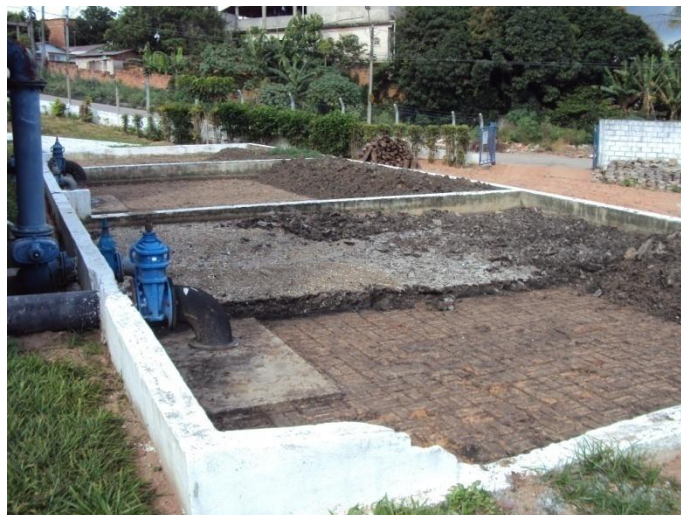
Figura 15: Leitos de secagem.
