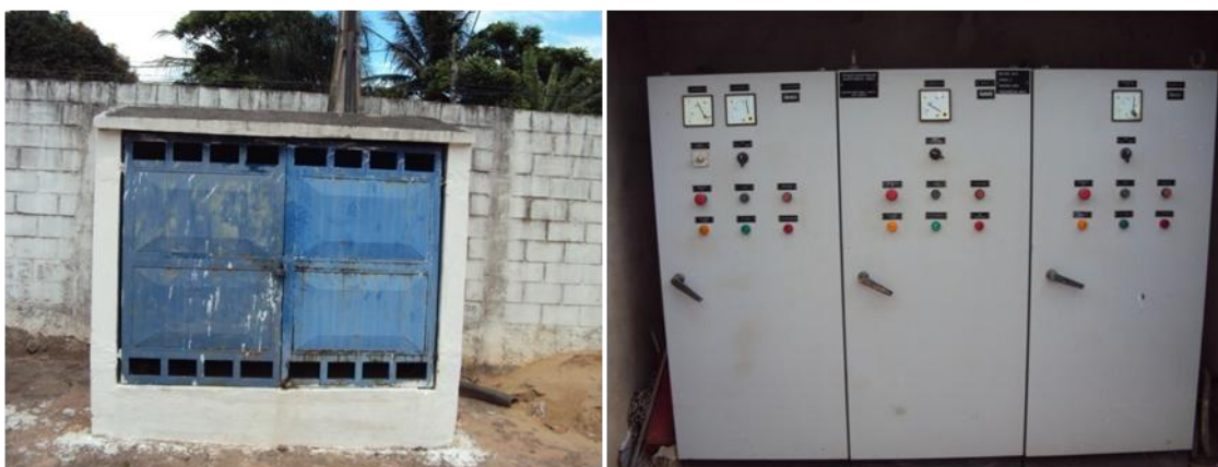
Figura 11: Painel de controle da EEEB.
