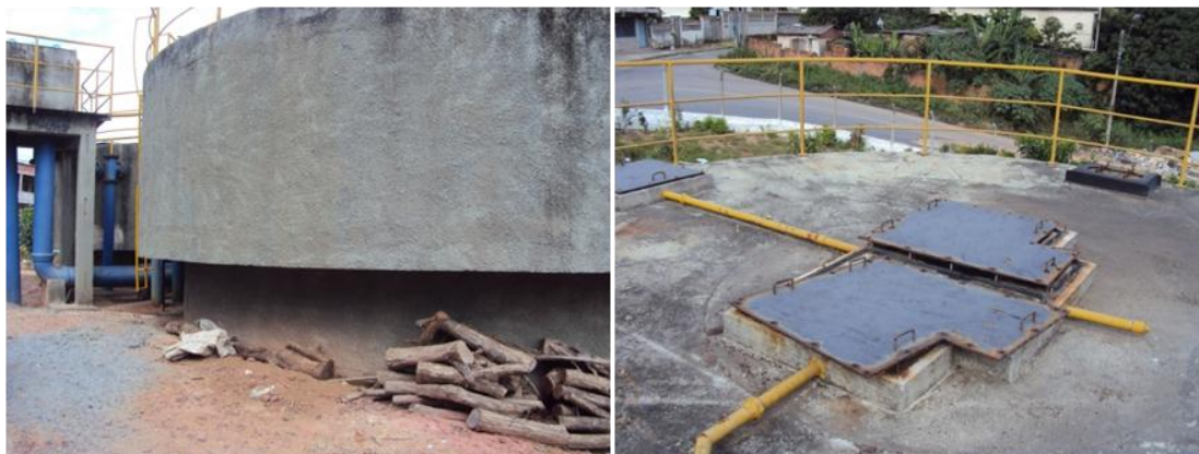
Figura 13: Vista lateral do RAFA e tampas abertas com corrosão.
