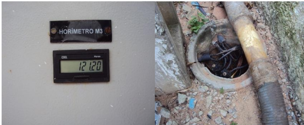
Figura 12: Horímetro e cabos de energia da EEEB.
