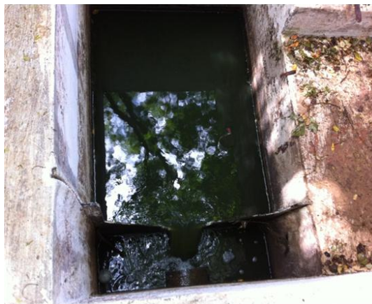
Figura 19: Vertedouro para medição de vazão antes do ponto de lançamento.
