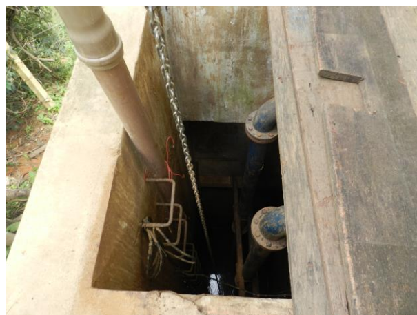
Figura 28 – Captação do Santa Maria.
