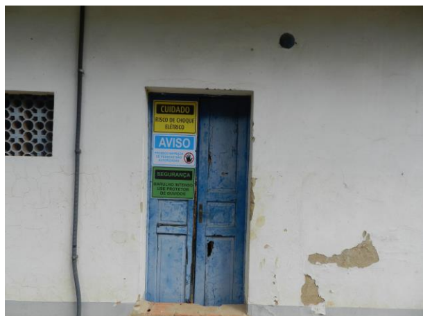
Figura 14 – Captação do Santa Maria.
