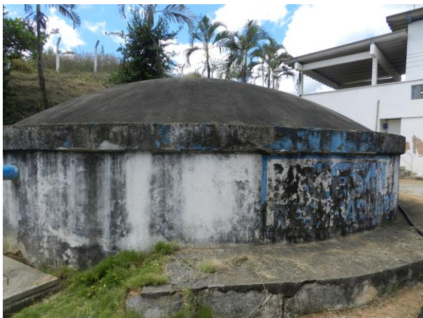
Figura 20 - RAT da ETA São Roque do Canaã.
