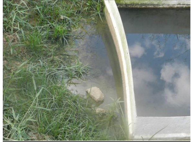
Figura 12 - Caixa de saída do efluente final da ETE de São Gabriel da Palha.
