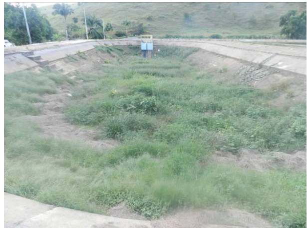
Figura 10 – Lagoa anaeróbia da ETE São Gabriel da Palha.
