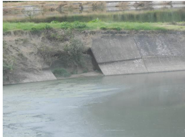
Figura 8 - Talude da lagoa da ETE Coqueiral.
