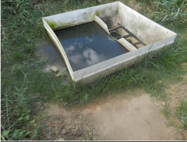
Figura 11 - Caixa de saída do efluente final da ETE de São Gabriel da Palha.
