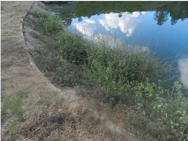
Figura 7 - Talude da lagoa da ETE São Gabriel da Palha.
