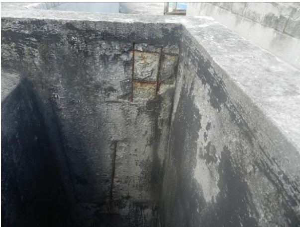
Figura 9 – Tratamento Preliminar da ETE São Gabriel da Palha.
