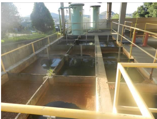
Figura 26 - Flocladores da ETA São Gabriel da Palha.
