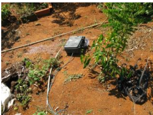
Figura 5 - Equipamento de medição instalado no Ponto 04 - Município de Santa Teresa, ES
