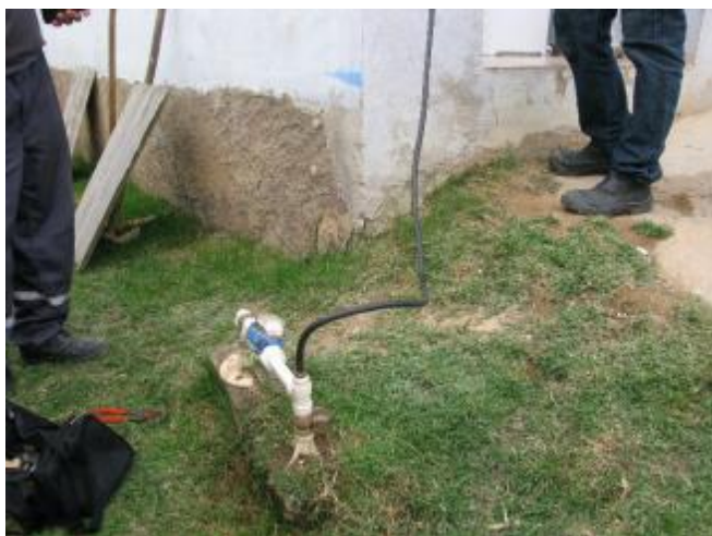
Figura 3 - Equipamento de medição instalado no Ponto 03 - Município de Santa Teresa, ES
