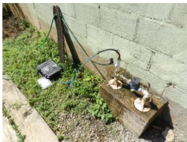
Figura 6 - Equipamento de medição instalado no Ponto 05 - Município de Santa Teresa, ES
