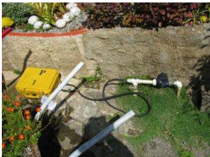
Figura 1 - Equipamento de medição instalado no Ponto 01 - Município de Santa Leopoldina, ES
