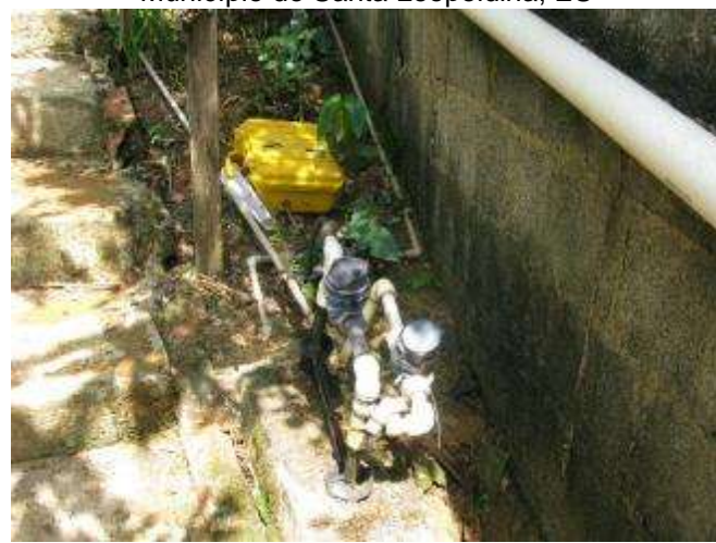
Figura 4 - Equipamento de medição instalado no Ponto 04 - Município de Santa Leopoldina, ES
