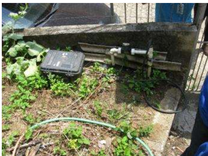
Figura 5 - Equipamento de medição instalado no Ponto 05 - Município de Santa Leopoldina, ES
