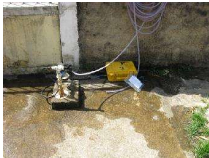
Figura 2 - Equipamento de medição instalado no Ponto 02 - Município de Santa Leopoldina, ES
