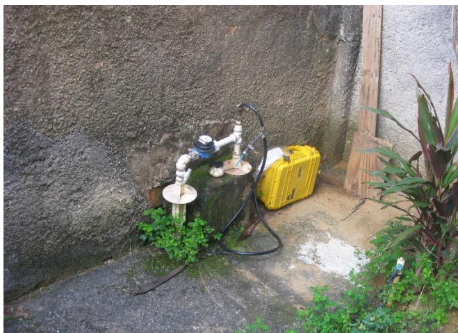
Figura 1 - Equipamento de medição instalado no Ponto 01 - Município de Rio Novo do Sul, ES
