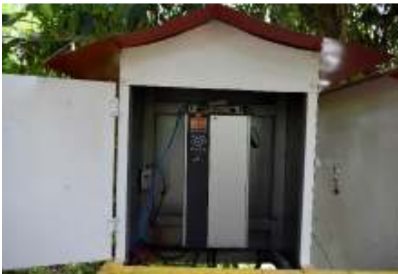
Figura 15 - Inversor de frequência da EEAB do Córrego São Caetano.
