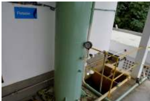
Figura 26 – Flotador da ETA Rio Novo do Sul.
