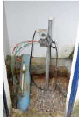
Figura 54 - Pitot de água tratada.
