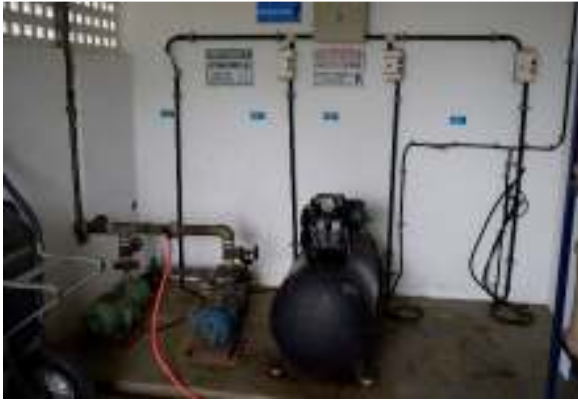
Figura 51 - Área dos compressores.
