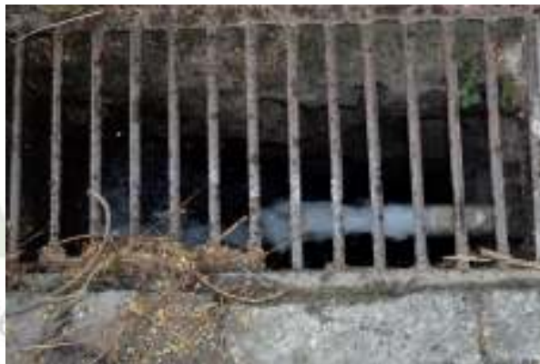
Figura 71 - Descarga 4 operando em condições satisfatórias.
