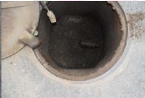
Figura 67 - Excesso de resíduos na descarga 3.
