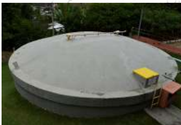
Figura 58 – Reservatório circular apoiado da ETA Rio Novo do Sul.
