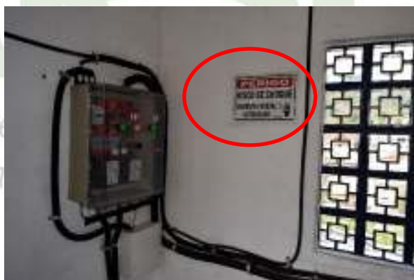
Figura 76 - Sinalização de risco de choque elétrico no interior do booster Santo Antônio.
