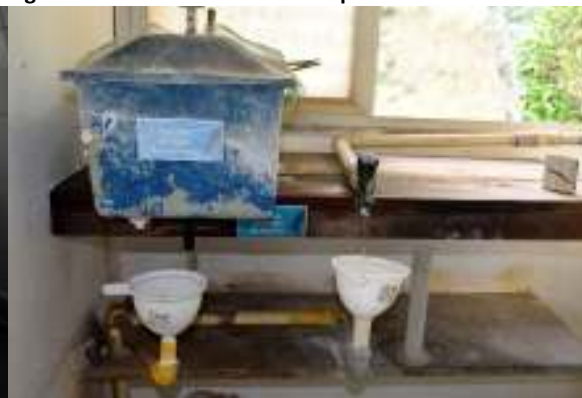
Figura 24 - Dosador de sulfato de alumínio e flúor.
