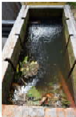
Figura 7 - Tratamento preliminar (gradeamento) do Córrego São Vicente.
