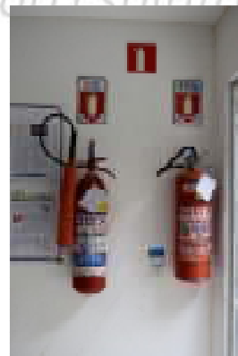
Figura 56 - Extintor no laboratório da ETA Rio Novo do Sul.
