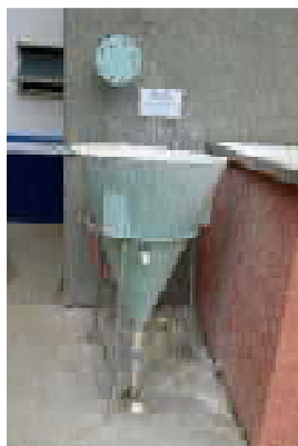
Figura 21 - Estrutura de adição de Cal.
