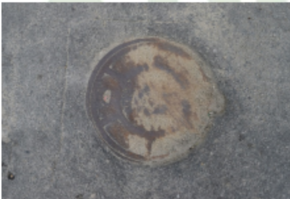
Figura 66 - Descarga 3 com tampa.
