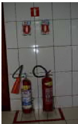
Figura 89 - Extintores disponíveis no escritório de atendimento de Rio Novo do Sul.
