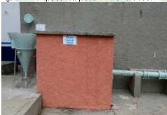
Figura 29 - Tanque de contato da ETA Rio Novo do Sul.
