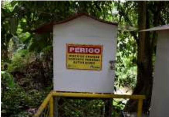
Figura 17 - Sinalização de risco.
