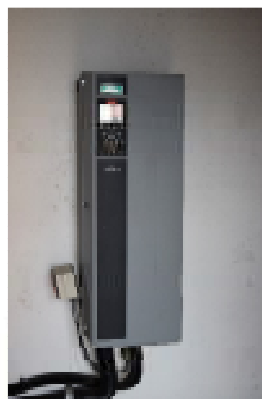
Figura 75 - Inversor de frequência do booster Santo Antônio.
