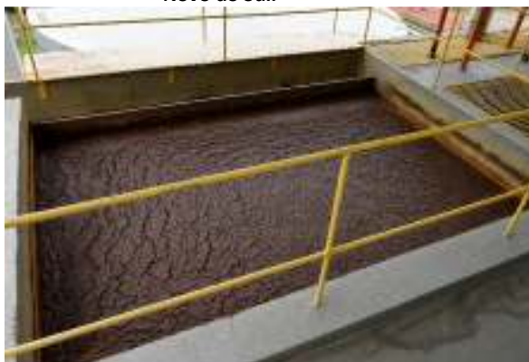
Figura 27 - Tanque de flotação da ETA Rio Novo do Sul.
