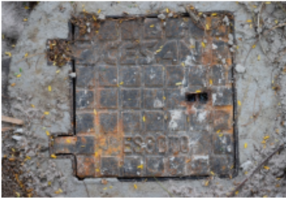
Figura 69 - Descarga 4 com tampa de proteção.
