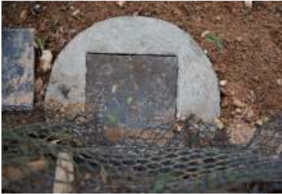
Figura 64 - Descarga 2 com tampa e identificação.
