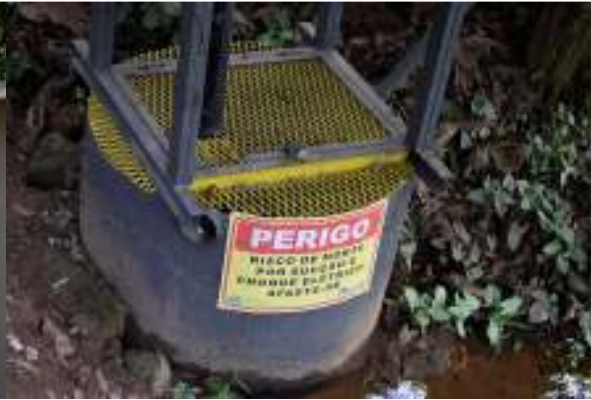
Figura 18 - Sinalização de risco.
