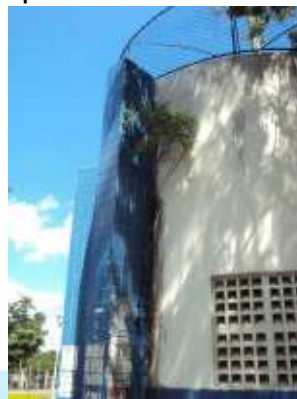
Figura 167 - Presença de vegetação na estrutura física da EEAT Caratoira.
