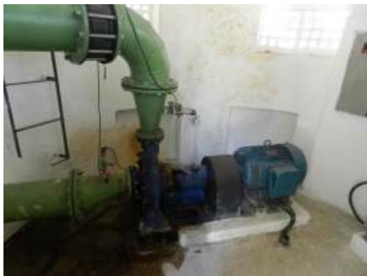
Figura 166 - Ausência de bomba reserva.
