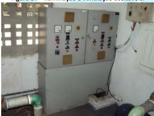
Figura 16 - Painel de comando/quadro de força sem sinalização de risco.
