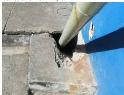
Figura 171 - Tampa da caixa de proteção danificada.
