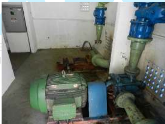
Figura 83 – Ausência de bomba reserva.
