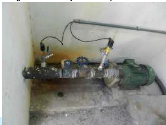
Figura 78 - Ausência de bomba reserva.
