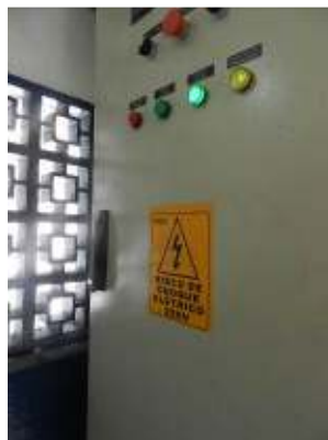
Figura 161 - Painel de comando/quadro de força com sinalização de risco.
