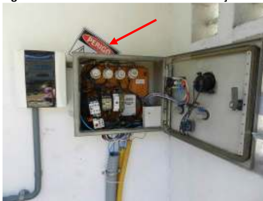
Figura 104 - Sinalização de risco em local inadequado.
