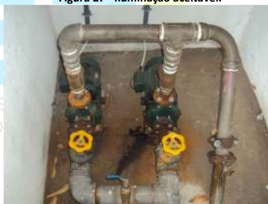
Figura 29 - Conjunto motor-bomba da EEAT Hélio Ferraz.
