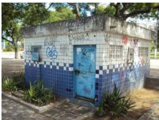
Figura 21 - EEAT Ilha do Frade sem identificação.
