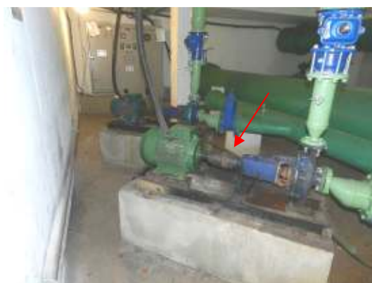
Figura 132 - Ausência de capa de proteção no eixo de acoplamento do motor com a bomba hidráulica.
