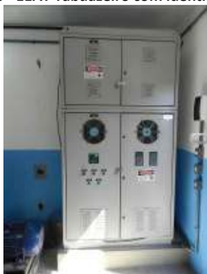
Figura 108 - Painel de comando/Quadro de força com sinalização de risco.
