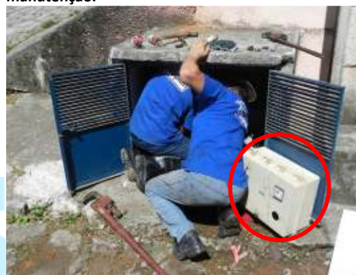
Figura 97 - Painel de comando/quadro de força sem sinalização de risco.
