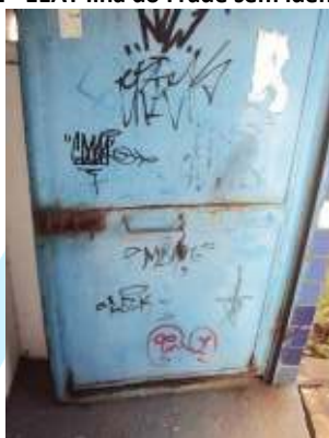
Figura 23 - Porta necessitando de manutenção.
