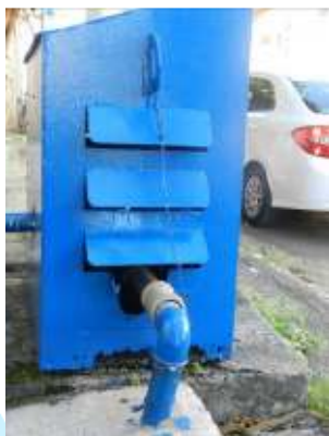
Figura 178 - Entradas para ventilação e base danificada.
