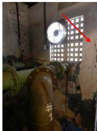
Figura 63 - Rachadura na estrutura física da EEAT de Gurigica.
