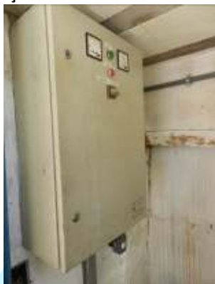
Figura 100 - Painel de comando/quadro de força sem sinalização de risco.
