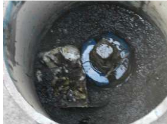
Figura 181 – Acúmulo de resíduos no Interior da caixa de proteção da descarga.
