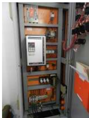
Figura 143 – Interior do Painel de comando/quadro de força.
