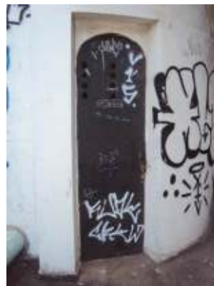
Figura 4 - Ausência de identificação.
