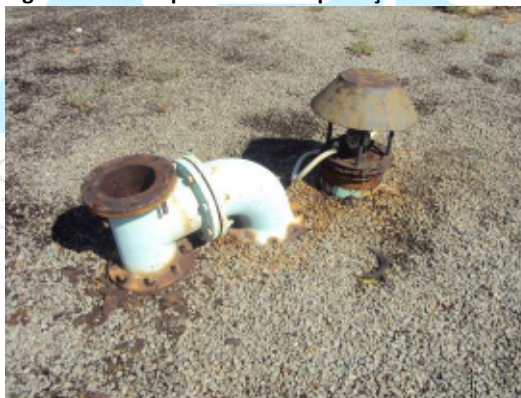
Figura 126 - Tubulação de ventilação enferrujada e sem tela de proteção.
