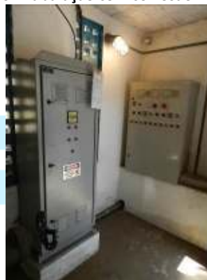
Figura 88 - Sinalização de risco de choque elétrico parcial.
