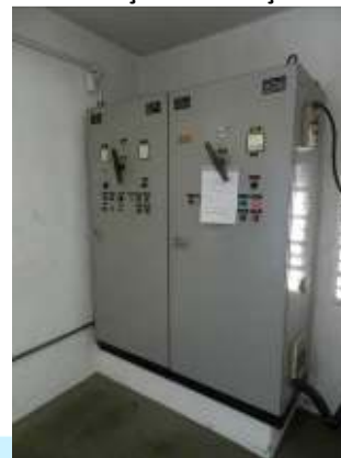
Figura 82 - Paine de comando/quadro de força sem sinalização de risco.
