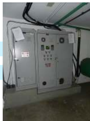
Figura 131 - Painel de comando/quadro de força com sinalização de risco.
