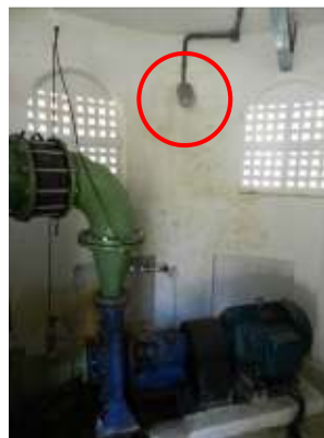
Figura 165 - Entradas para ventilação e lâmpada queimada.
