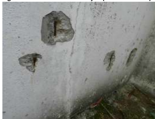
Figura 121 - Ferro estrutural exposto.
