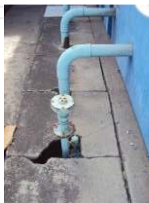
Figura 40 - Tampa de inspeção danificada.
