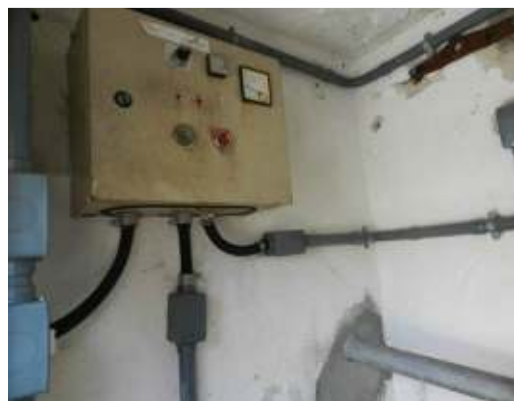
Figura 69 – Painel de comando/Quadro de força sem sinalização de risco.
