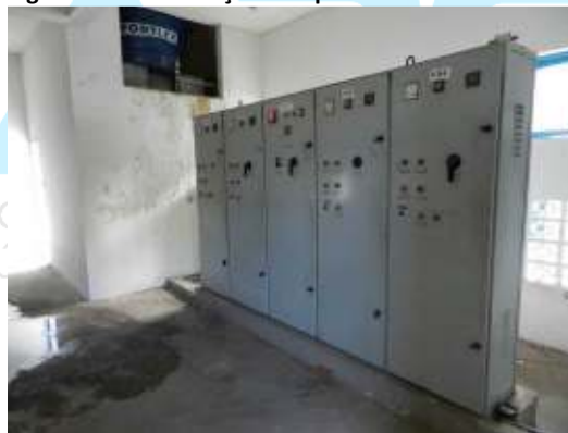
Figura 153 - Painel de comando/quadro de força sem sinalização de risco.
