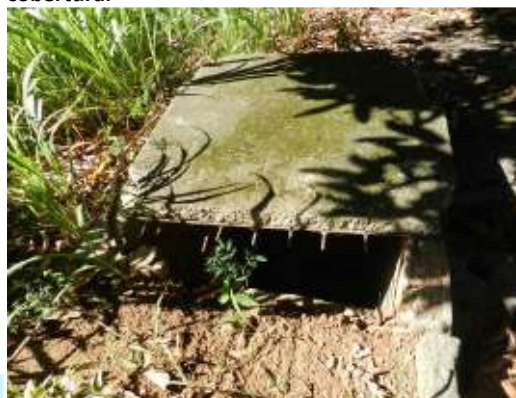
Figura 125 - Tampa da caixa de proteção.
