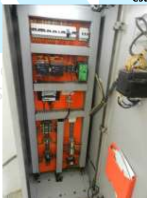
Figura 168 - Painel de comando/quadro de força da EEAT Caratoira.
