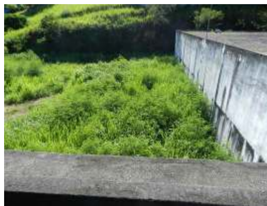
Figura 117 - Excesso de vegetação na área interna.
