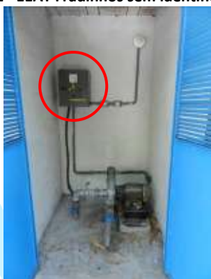
Figura 114 - Painel de comando/quadro de força sem sinalização de risco e ausência de bomba reserva.
