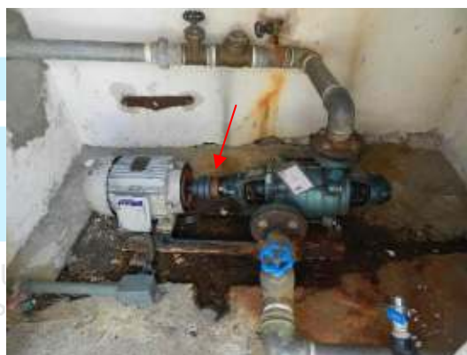
Figura 70 – Ausência de bomba reserva e Ausência de capa de proteção no eixo de acoplamento do motor elétrico com a bomba hidráulica.
