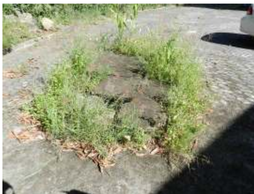
Figura 124 - Tampa da caixa de proteção.
