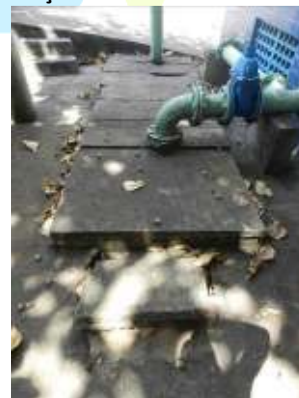
Figura 84 – Tampas de inspeção demandando manutenção.
