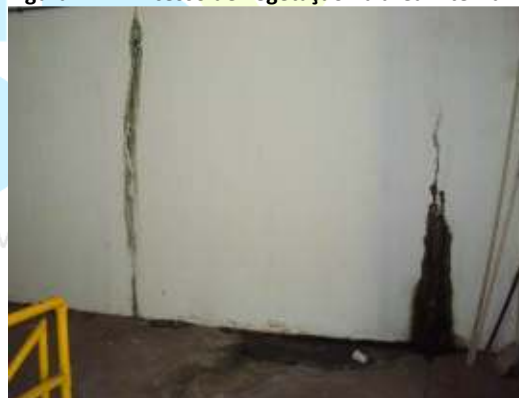
Figura 119 - Pontos de infiltração (área das EEATs).
