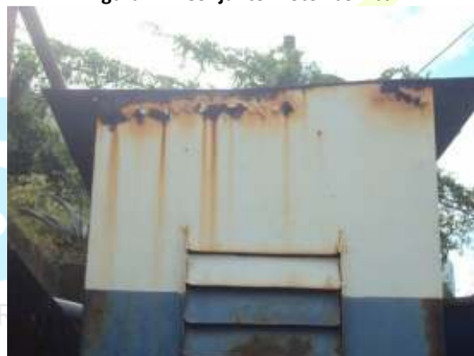
Figura 44 - Estrutura física que comporta o conjunto motor-bomba danificada.
