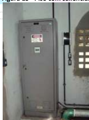
Figura 17 - Quadro de força com sinalização de risco.
