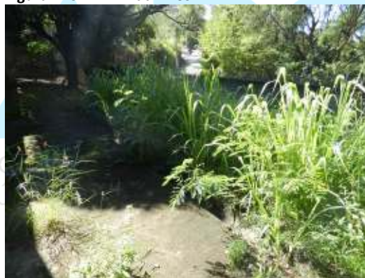
Figura 118 - Excesso de vegetação na área interna.
