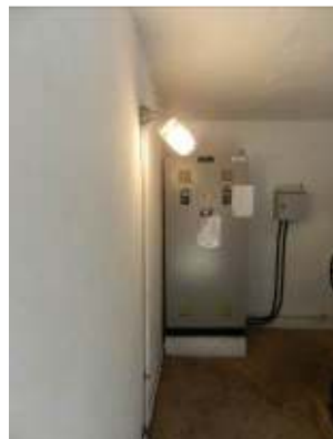
Figura 51 – Iluminação satisfatória e painel de comando/quadro de força sem sinalização de risco.
