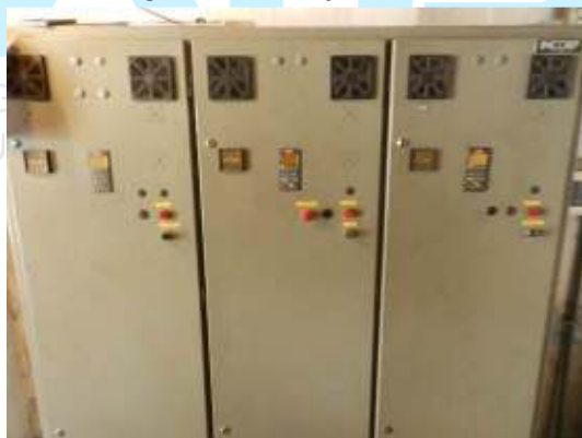
Figura 66 - Painéis de comando sem sinalização de risco.
