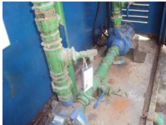
Figura 42 - Conjunto motor bomba.
