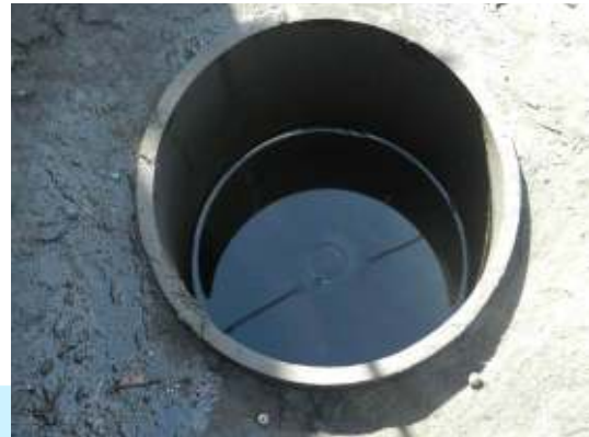
Figura 183 - Acúmulo de água pluvial no interior da caixa de proteção da descarga.
