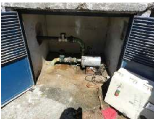
Figura 96 - Ausência de bomba reserva e condições de iluminação/ventilação naturais.
