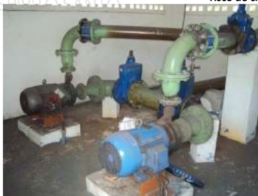
Figura 25 - Conjunto motor-bomba da EEAT Ilha do Frade.
