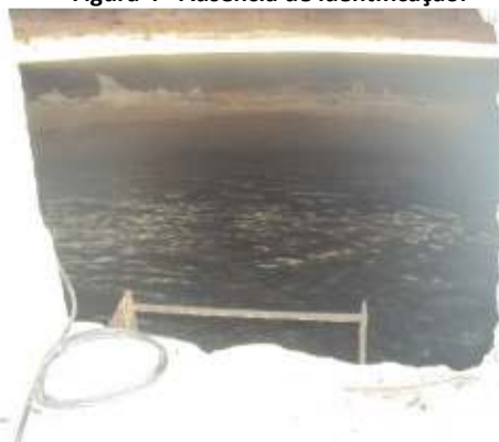
Figura 6 - Ausência de Tampa de inspeção.
