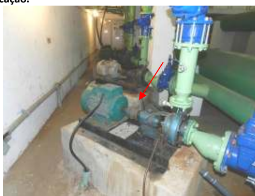
Figura 136 – Ausência de capa de proteção no eixo de acoplamento do motor com a bomba hidráulica.
