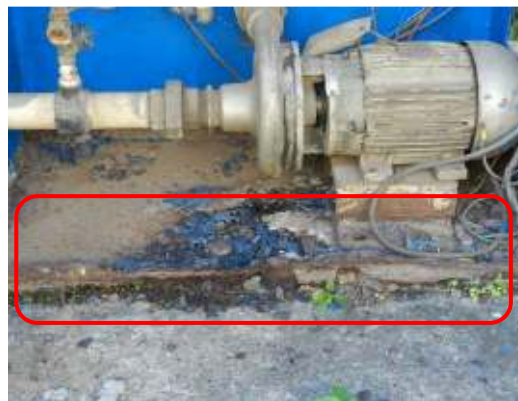
Figura 177 - Danificação da estrutura física que comporta o conjunto motor-bomba.
