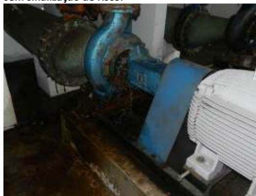
Figura 155 - Vazamento na bomba.
