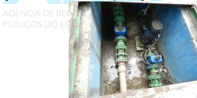
Figura 49 - Ausência de bomba reserva.
