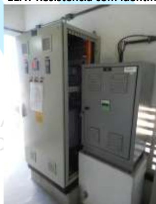
Figura 92 - Sinalização de risco parcial.
