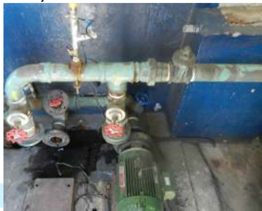
Figura 163 - Ausência de bomba reserva.
