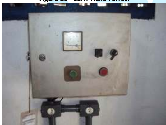
Figura 28 - Painel de comando/quadro de força.
