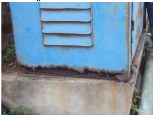
Figura 43 - Estrutura física que comporta o conjunto motor-bomba danificada.
