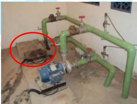
Figura 34 - Ausência de bomba reserva.
