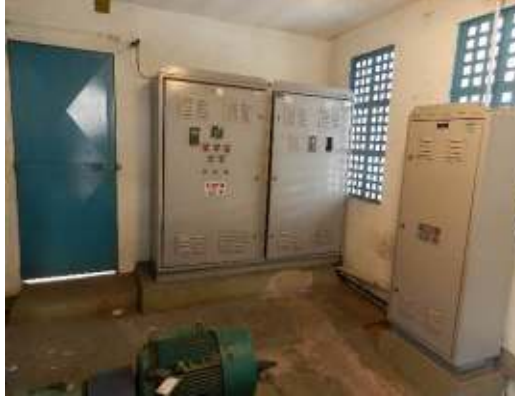
Figura 73 - Painel de comando/quadro de força com sinalização de risco.
