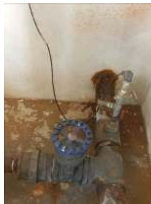
Figura 86 - Tubulação com corrosão.
