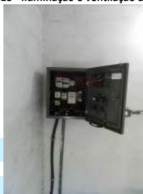
Figura 115 - Interior do painel de comando/quadro de força.
