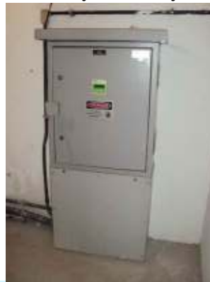
Figura 33 - Quadro de força com sinalização de risco.
