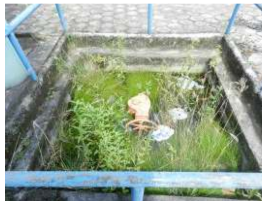
Figura 156 - Ausência de sistema de drenagem.
