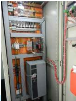
Figura 162 - Interior do painel de comando/quadro de força.
