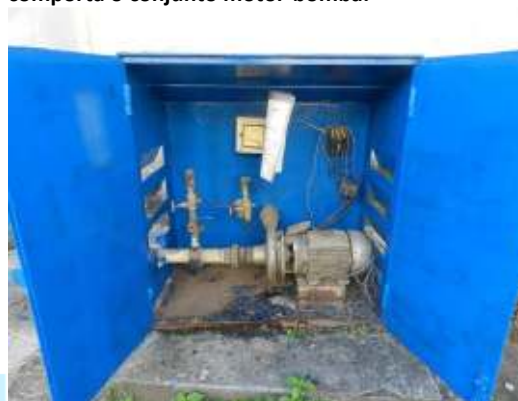
Figura 179 - Ausência de sinalização de risco e ausência de bomba reserva.
