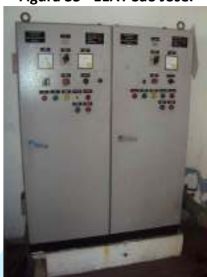
Figura 37 - Painel de comando/quadro de força sem sinalização de risco.
