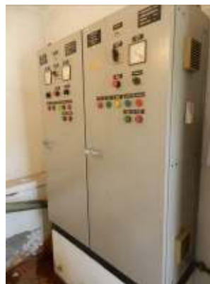
Figura 142 - Painel de comando/quadro de força sem sinalização de risco.
