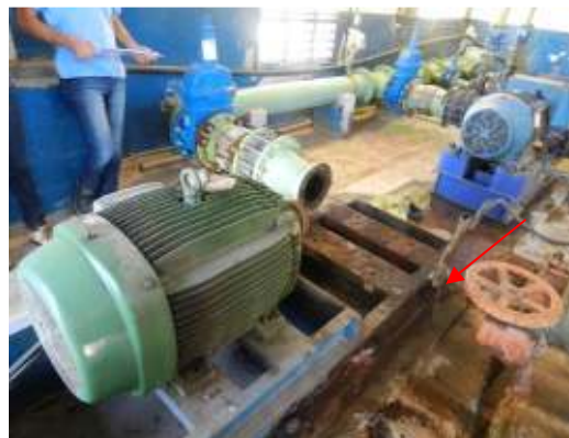
Figura 174 - Ausência de bomba reserva e vazamento na tubulação.
