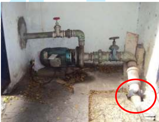
Figura 20 - Ausência de bomba reserva e saliência no piso.
