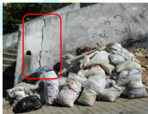
Figura 111 - Rachadura no muro da EEAT de Tabuazeiro.
