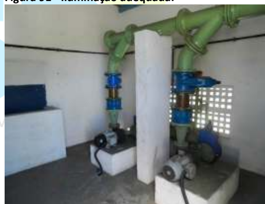
Figura 93 - Conjunto motor bomba e entradas para ventilação.
