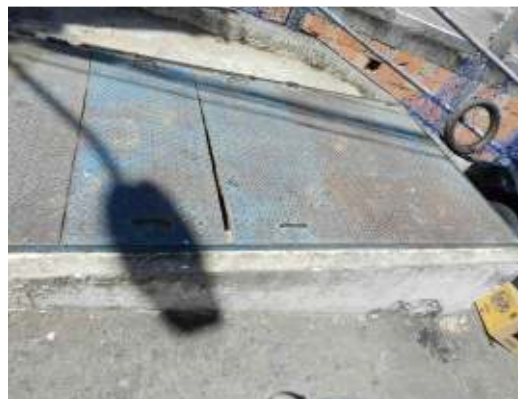
Figura 146 - Ausência de entradas de ventilação.
