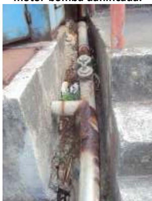
Figura 45 - Tubulação com corrosão.
