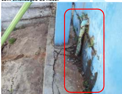
Figura 110 - Infiltração na EEAT Tabuazeiro.
