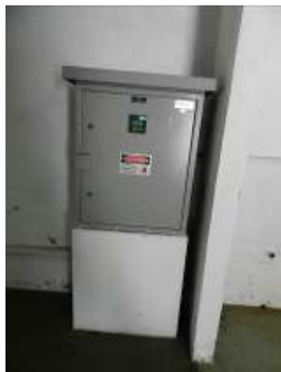
Figura 81 - Quadro de força com sinalização de risco.
