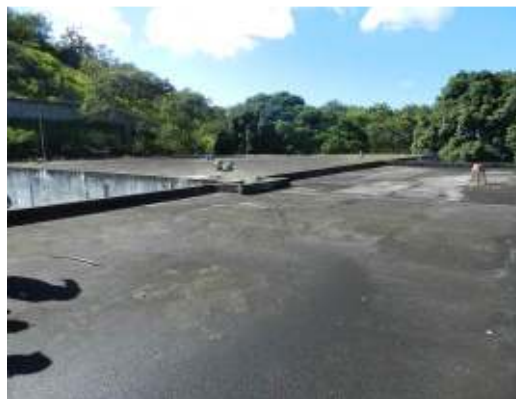
Figura 123 - Ausência de guarda-corpo na laje de cobertura.
