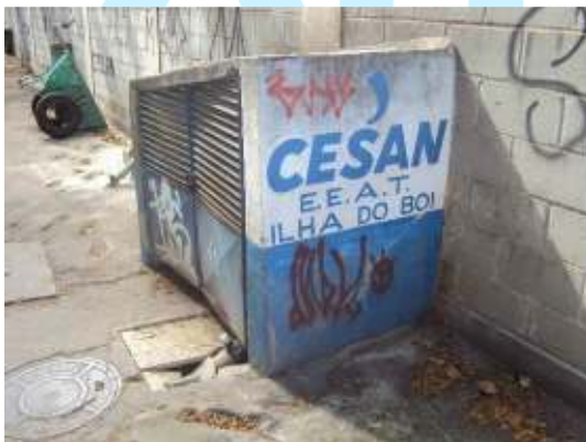
Figura 19 - EEAT Ilha do Boi identificada e ausência de sinalização de risco de choque elétrico.
