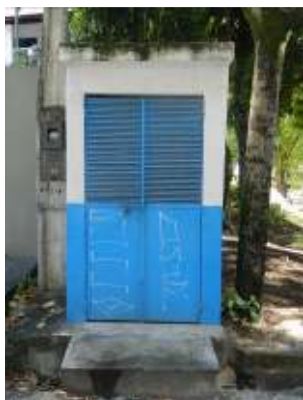
Figura 112 - EEAT Fradinhos sem identificação.
