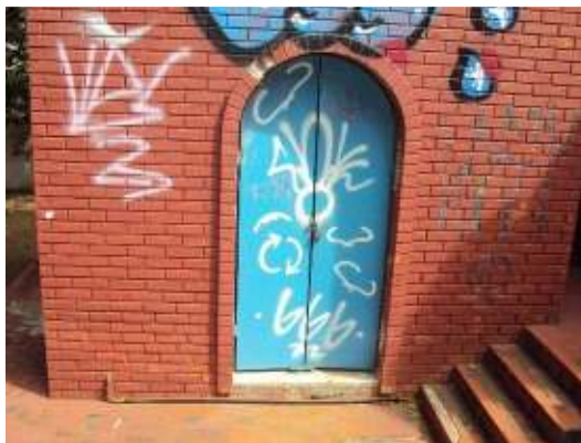
Figura 13 - Ausência de Identificação.
