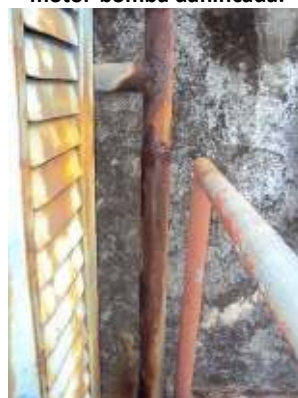
Figura 46 - Tubulação com corrosão.
