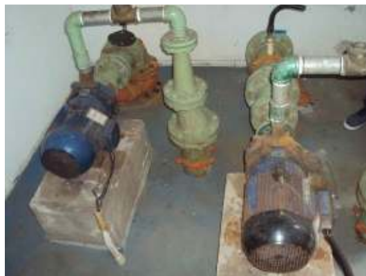
Figura 18 - Conjunto motor-bomba da EEAT Castelinho.
