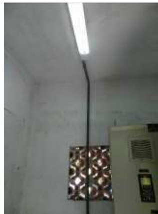
Figura 76 - Iluminação e ventilação razoável.
