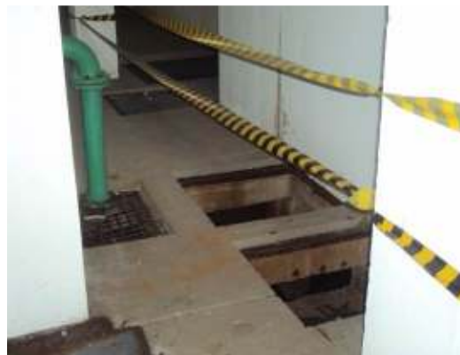
Figura 129 - Ausência de tampas de proteção.
