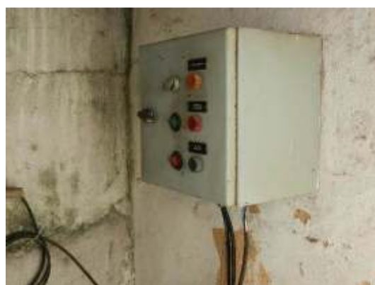
Figura 57 - Painel de comando/quadro de força sem sinalização de risco.
