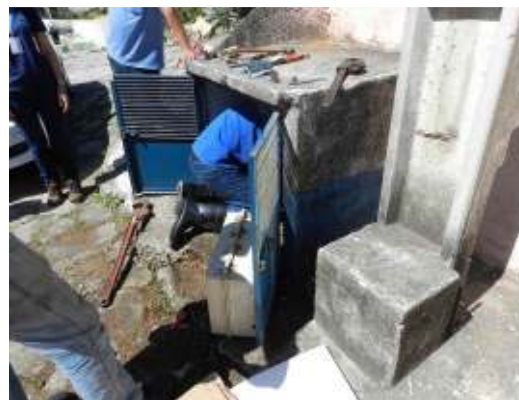
Figura 95 - Pouco espaço para serviços de manutenção.
