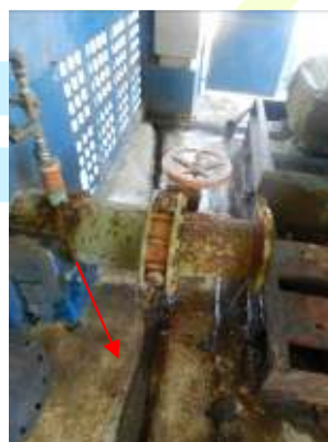
Figura 170 - Canaletas de drenagem sem grade de proteção.
