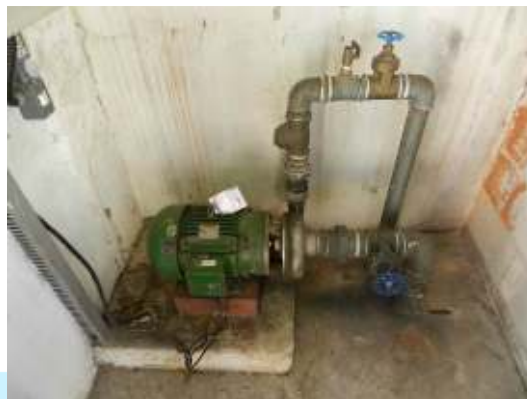
Figura 101 - Ausência de bomba reserva.
