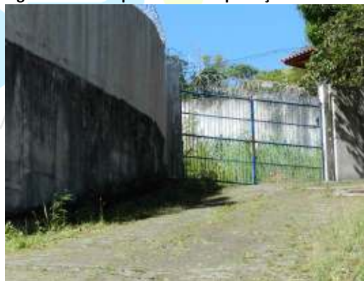
Figura 127 - Portão de isolamento.
