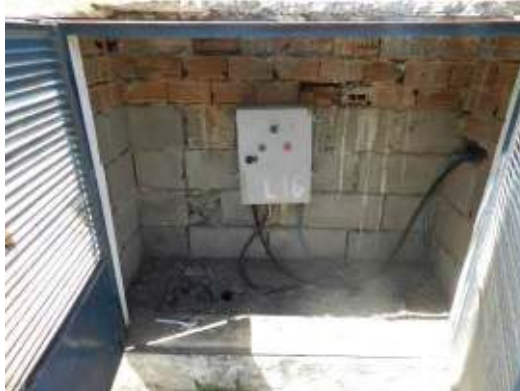
Figura 147 - Ausência de sinalização de risco.
