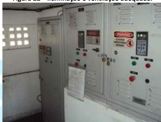
Figura 24 - Painéis de comando com sinalização de risco de choque elétrico.
