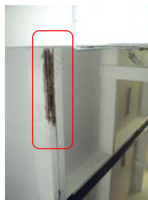
Figura 133 - Ferro estrutural exposto.
