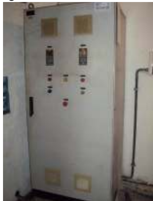
Figura 32 - Painel de comando/quadro de força sem sinalização de risco.
