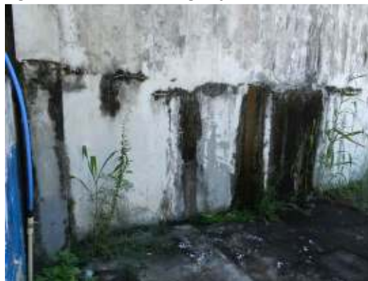
Figura 120 - Pontos de infiltração (Parede externa).
