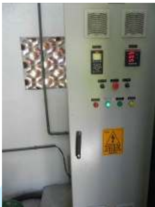
Figura 77 - Painel de comando/quadro de força com identificação de risco.
