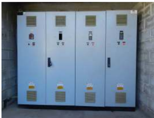
Figura 173 - Painel de comando/quadro de força com sinalização de risco.
