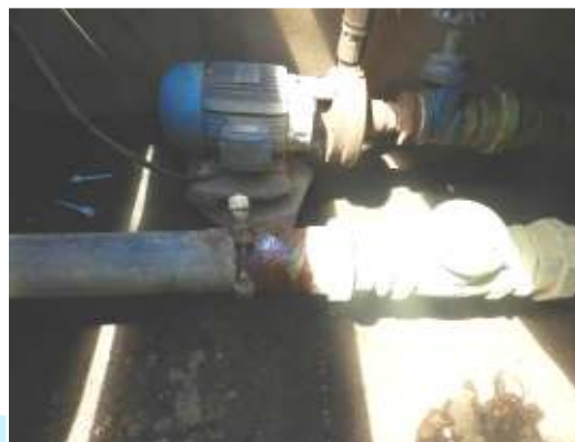
Figura 148 - Ausência de bomba reserva.
