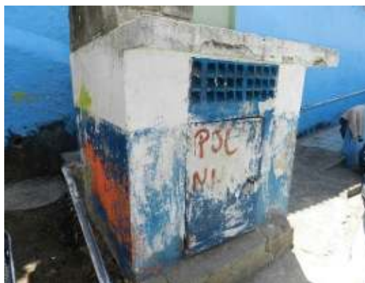
Figura 68 – EEAT São Benedito sem identificação.
