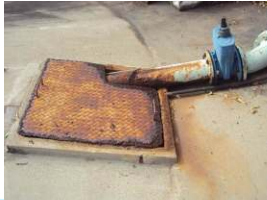
Figura 10 - Tampa de inspeção enferrujada.
