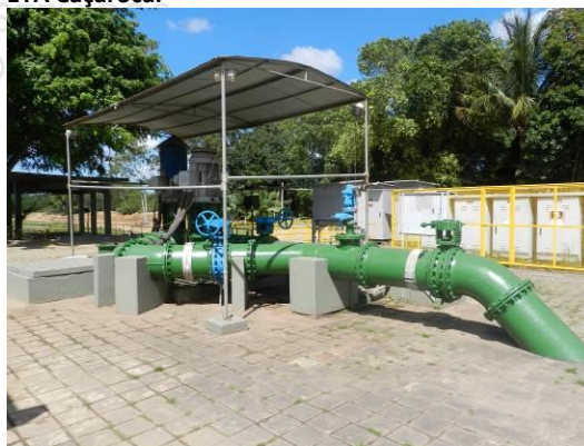
Figura 36 - EEAB da ETA Caçaroca.
