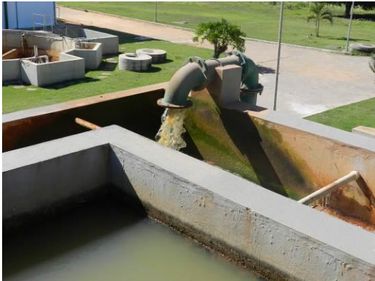
Figura 53 - Recirculação de água da lavagem dos filtros.
