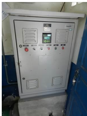
Figura 11 - Pannel de comando/quadro de força sem sinalização de risco.
