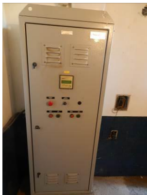
Figura 5 - Painel de comando/quadro de força sem sinalização de risco.
