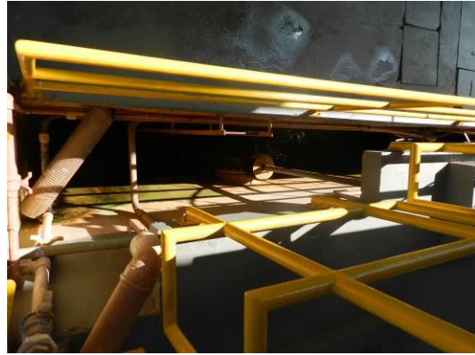
Figura 52 - Local do pequeno vazamento (Filtro 01).
