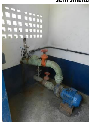
Figura 32- Ausência de bomba reserva.
