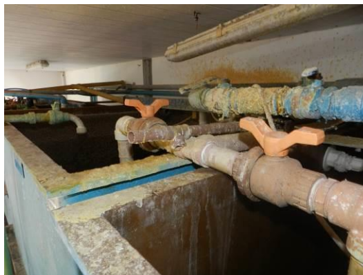
Figura 70 - Tubulação dos tanques de produtos químicos.
