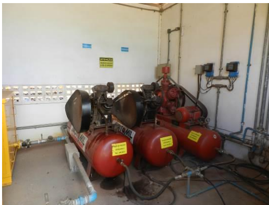
Figura 81 - Compressores de ar.
