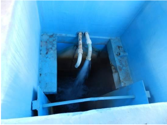
Figura 45 - Local de dosagem do flúor.
