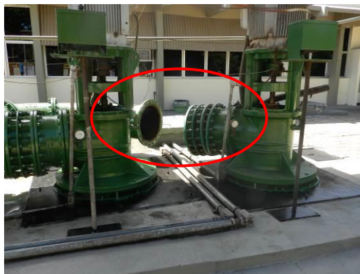
Figura 38 - Bomba reserva inoperante.
