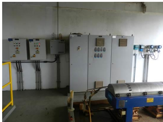
Figura 58 - Painel de controle/quadro de força da unidade de desaguamento sem sinalização de risco de choque elétrico.
