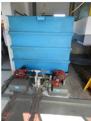
Figura 71 - Tanque de Cal e bomba dosadora inoperante.
