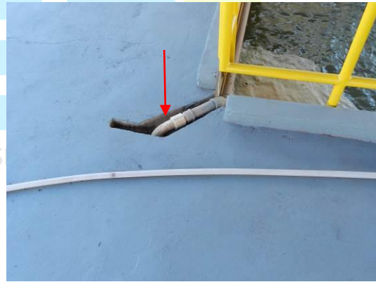
Figura 44 - Local de dosagem do cloro.
