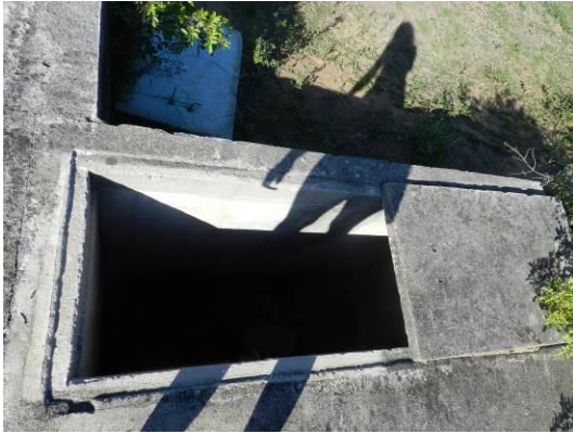
Figura 23 - Ausência de tampa de proteção/inspeção.
