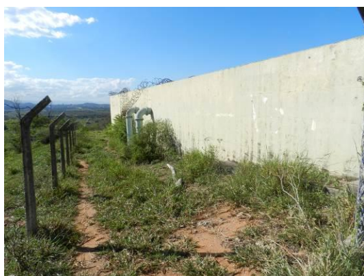
Figura 19 - Excesso de vegetação.
