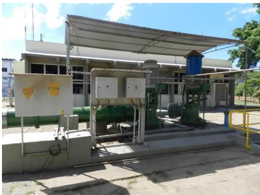
Figura 37 - Ausência de sinalização de risco de choque elétrico da EEAB.
