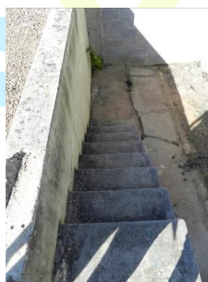
Figura 20 - Ausência de corrimão na escada.
