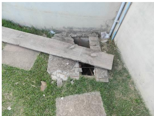
Figura 82 - Tampa de inspeção/proteção danificada.
