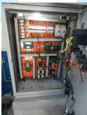
Figura 12 – Interior do Pannel de comando/quadro de força.
