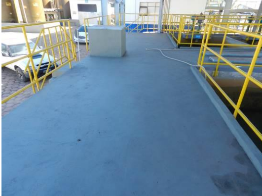
Figura 47 - Tanque de contato.
