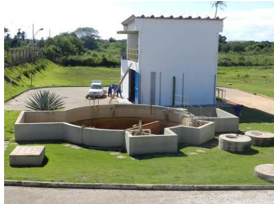
Figura 54 - Tanque de sedimentação da água de lavagem dos filtros.
