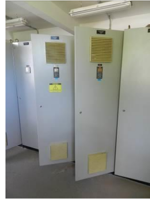
Figura 15 - Painel de comando/quadro de força com sinalização de risco.
