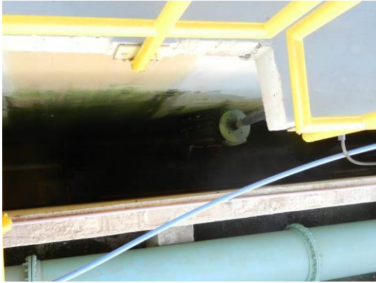
Figura 51 - Local do pequeno vazamento (Filtro 06).
