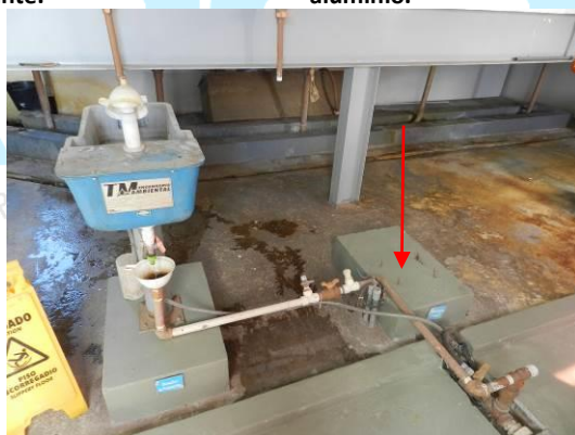
Figura 73 - Dosador e ausência de bomba dosadora de polieletrólito.
