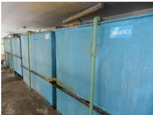
Figura 69 - Tanques de Sulfato e Pac.
