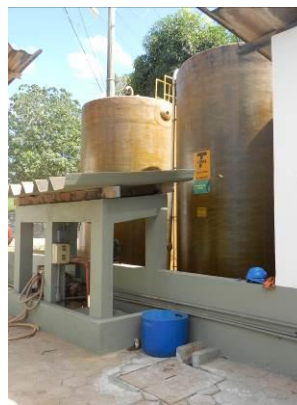
Figura 75 - Depósito de polieletrólito.
