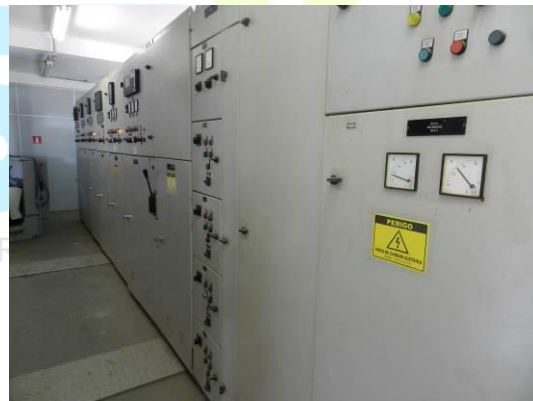
Figura 26 - Painel de comando/quadro de força com sinalização de risco.
