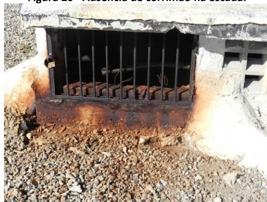
Figura 22 - Grade enferrujada e ausência de tampa de inspeção.
