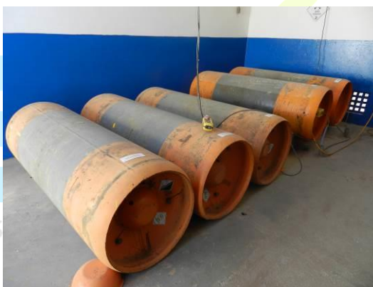
Figura 77 - Armazenamento de cilindros de cloro gás.
