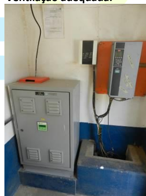
Figura 31 - Painel de comando/quadro de força sem sinalização de risco.
