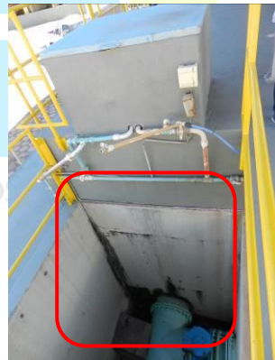
Figura 50 - Infiltrações no tanque de contato.
