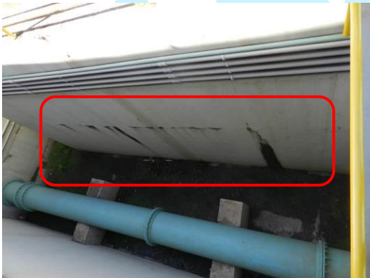
Figura 49 - Infiltrações no tanque de contato.
