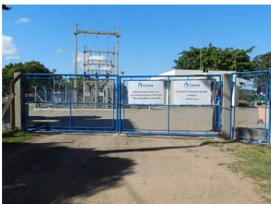
Figura 33 - Identificação da ETA Caçaroca.
