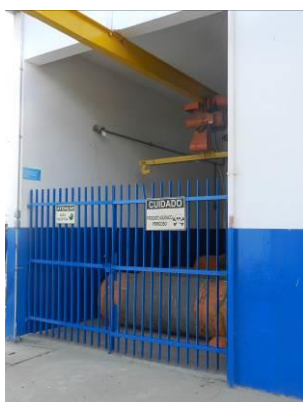
Figura 78 - Sala de depósito de cloro gás com sinalização de risco.
