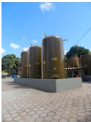
Figura 74 - Local de estoque de sulfato de alumínio.
