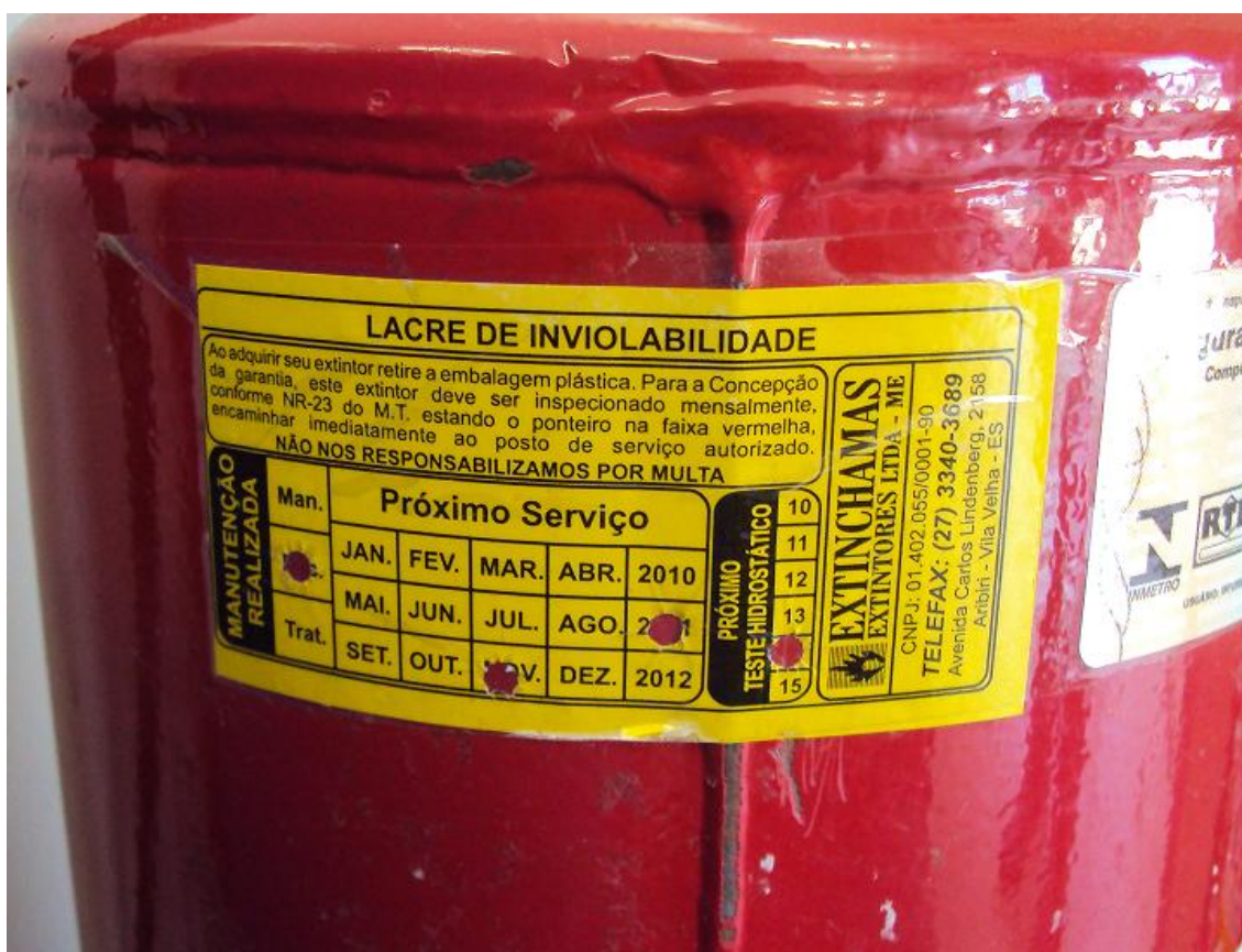
Figura 9: Extintor do escritório de Vila Velha
