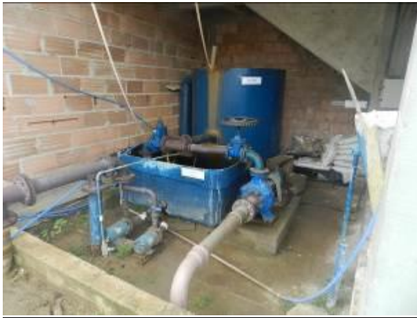
Figura 12 - Filtro da ETA.
