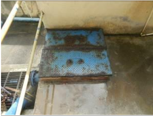
Figura 17 - Tampas na ETA.
