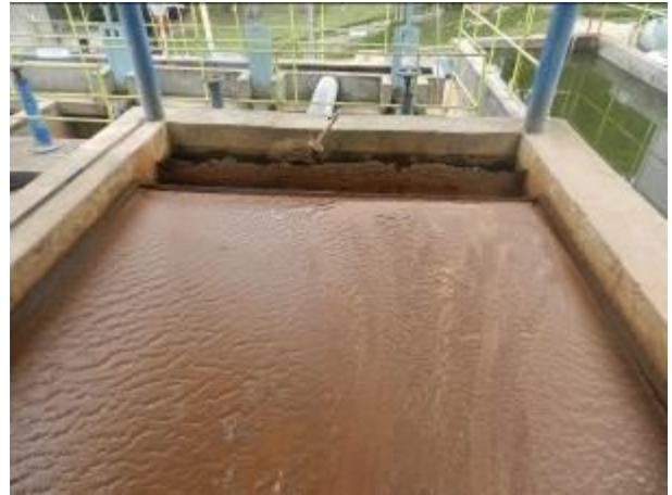
Figura 8 - Flotador da ETA de Cristal do Norte.
