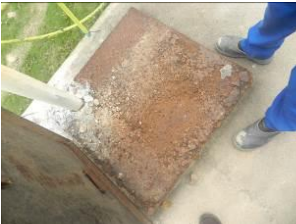
Figura 9 - Tampa do tanque de contato.
