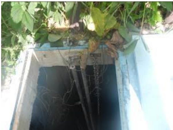
Figura 3 - Poço da EEEB D.
