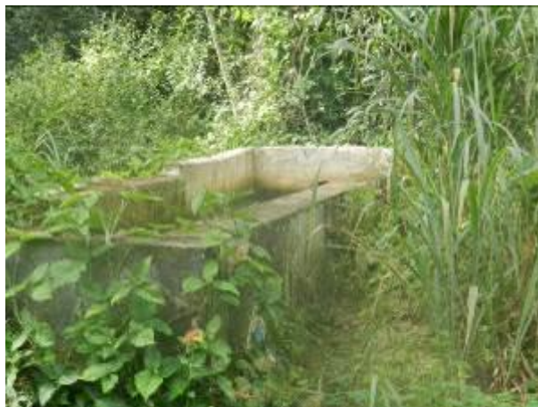
Figura 1 – Captação Pancas - Sede.
