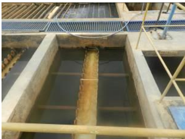
Figura 17 - Decantador ETA Pancas - Sede.
