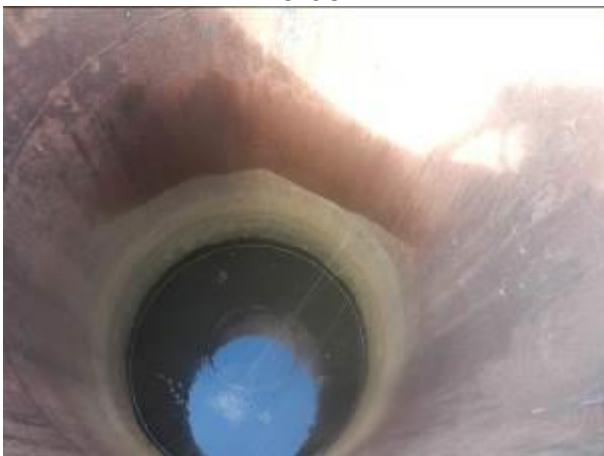
Figura 15 - Ferrugem na ETA Vila Verde.
