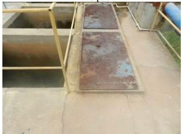
Figura 16 - ETA Pancas - Sede.
