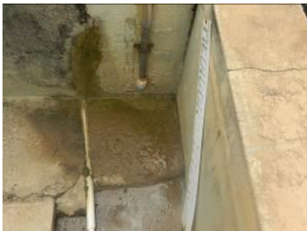
Figura 9 – ETA Pancas - Sede.
