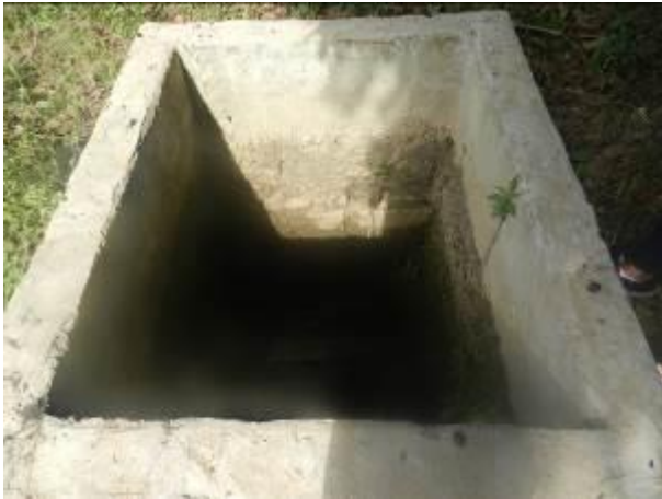
Figura 20 – Poço da Captação de Vila Verde.
