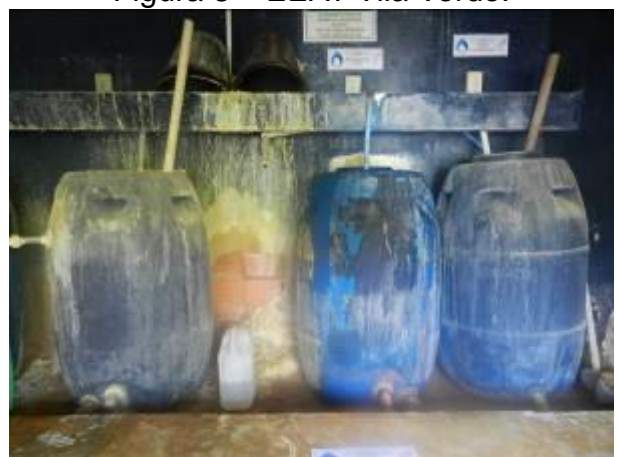
Figura 10 – Casa de química da ETA Vila Verde.
