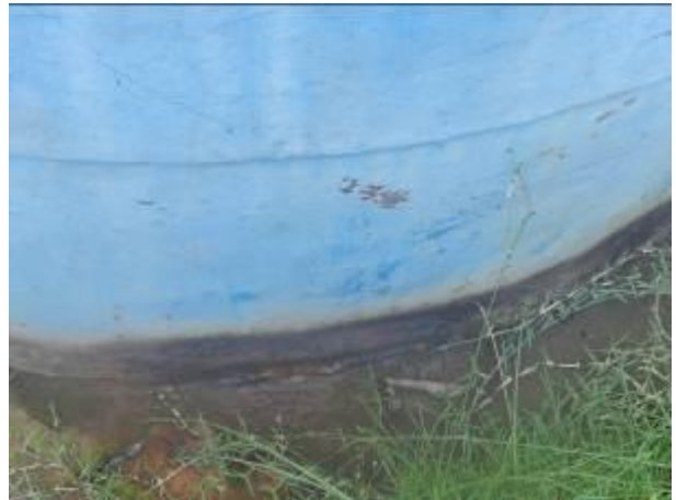
Figura 14 - Base da ETA Vila Verde com infiltração.
